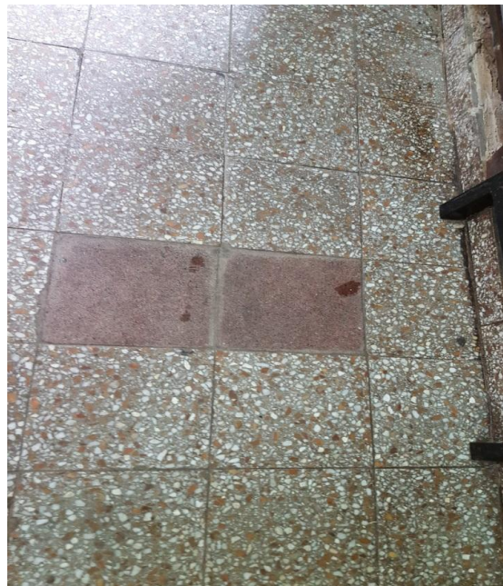
Se observa baldosa tapando lo que era el desagüe con rejilla.
