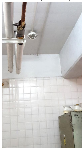
Caño roto, mal reparado dentro del baño de niños y personal.
