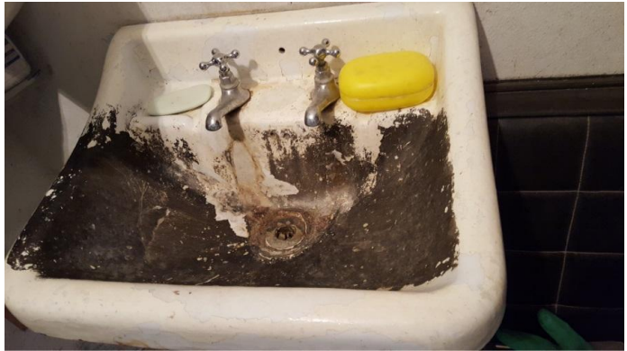
Pileta lavamanos del baño del personal.
