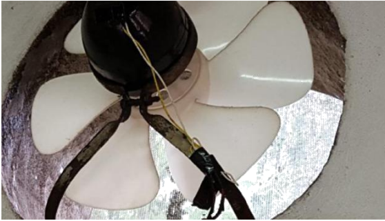
Extractor de aire de cocina con cables sin aislamiento.
