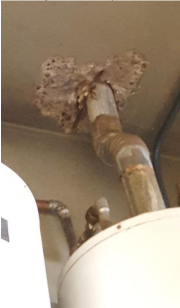
Caño abierto en el techo de la cocina por donde caen sustancias no identificadas por las paredes de la misma
