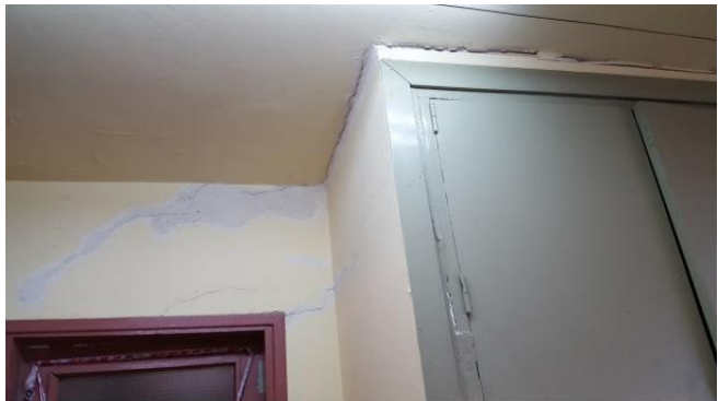
Rajaduras que van de pared a techo, pese al intento de reparación.
