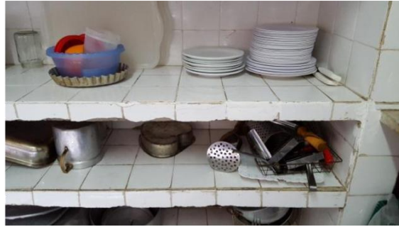
Estanterías de cocina rotas.
