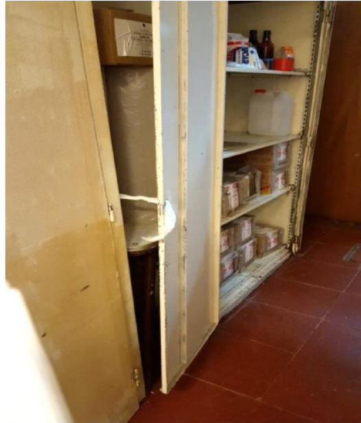
Placar de cocina donde se almacenan víveres secos, oxidado y sin cierre adecuado.
