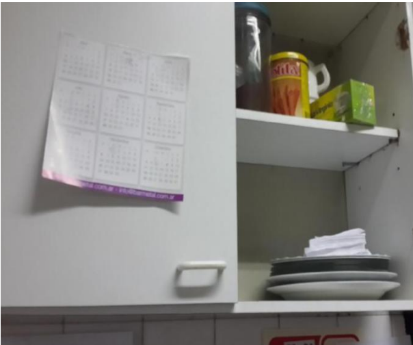
Alacena con faltante de puerta
