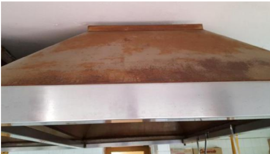
Parte externa de campana oxidada.
