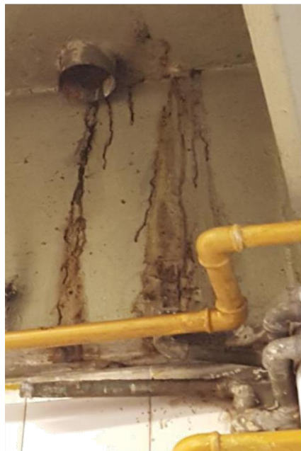
Techo de cocina roto con tubería mal empotrada.
