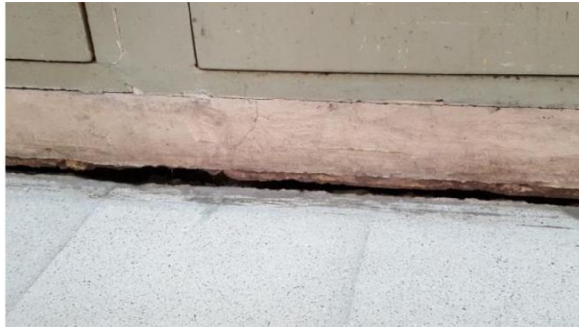
Hundimiento del piso del comedor.
