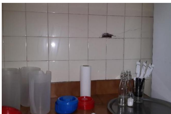
Cerámicos rotos en paredes de cocina
