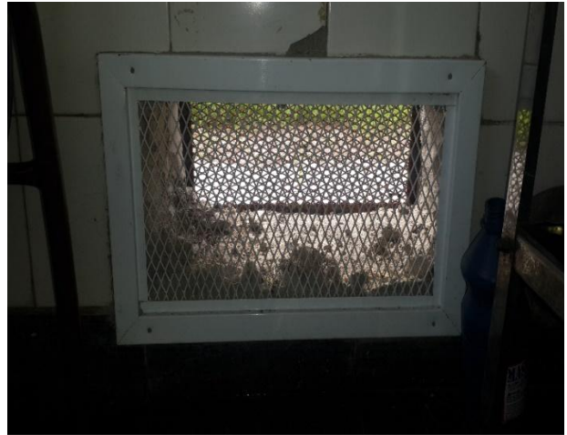
Rejilla de ventilación con escombros en su interior
