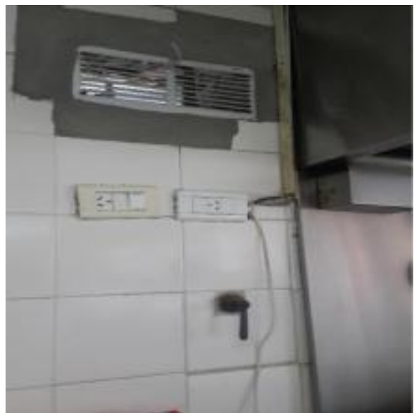
Rejillas de ventilación y conexiones eléctricas precarias
