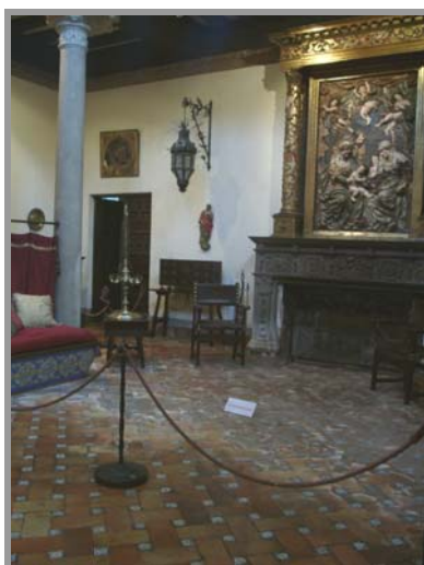
Foto Nro.1: Humedad de cimientos en sala principal
