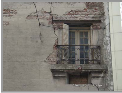
Foto Nro. 1: Fachada Casa Girondo-Fisuras estructurales
