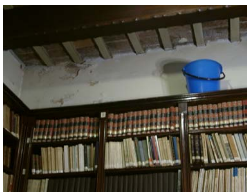
Foto Nro. 1: Filtraciones en Pabellón administrativo
