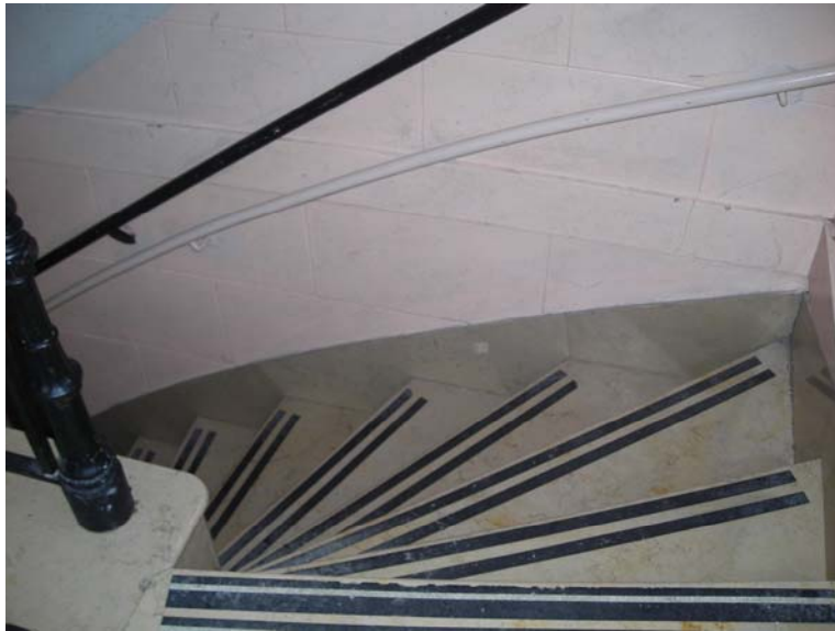
Foto N° 1 Jardin de Infantes Integral N° 8 DE 6 Acceso a las aulas del Jardín a través de una escalera compensada
