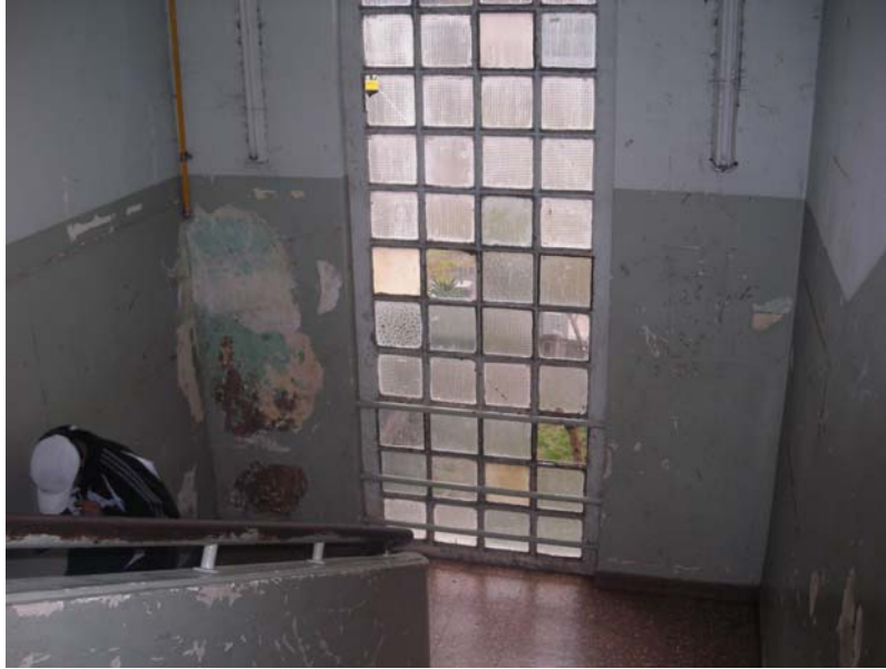
Foto N° 6 Escuela Tecnica N° 17 DE 13 Medio exigido de salida con pared de vidrio al nivel del piso
