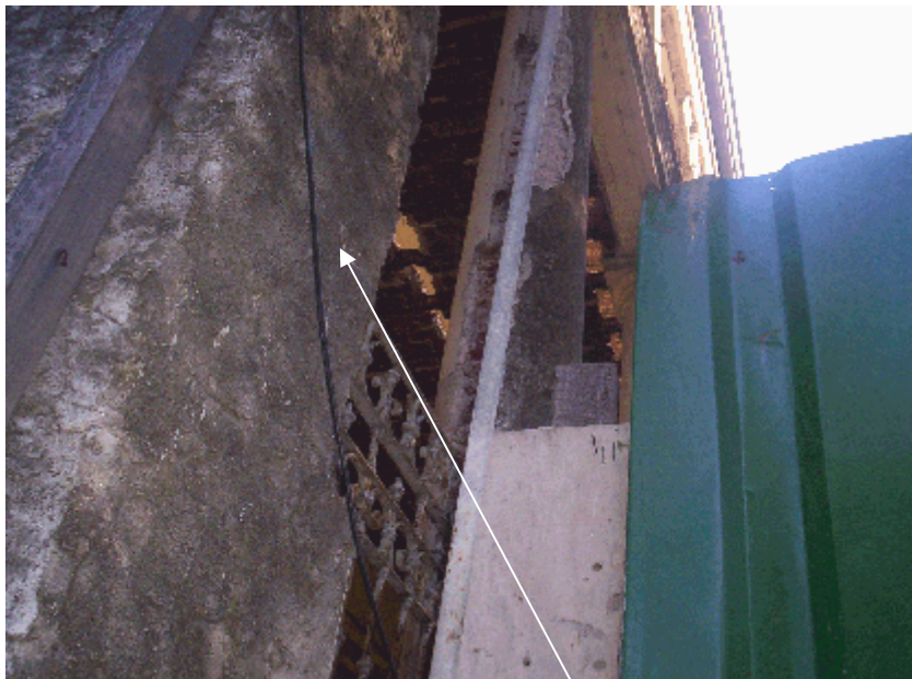
Se observa que la estructura se encuentra deteriorada
