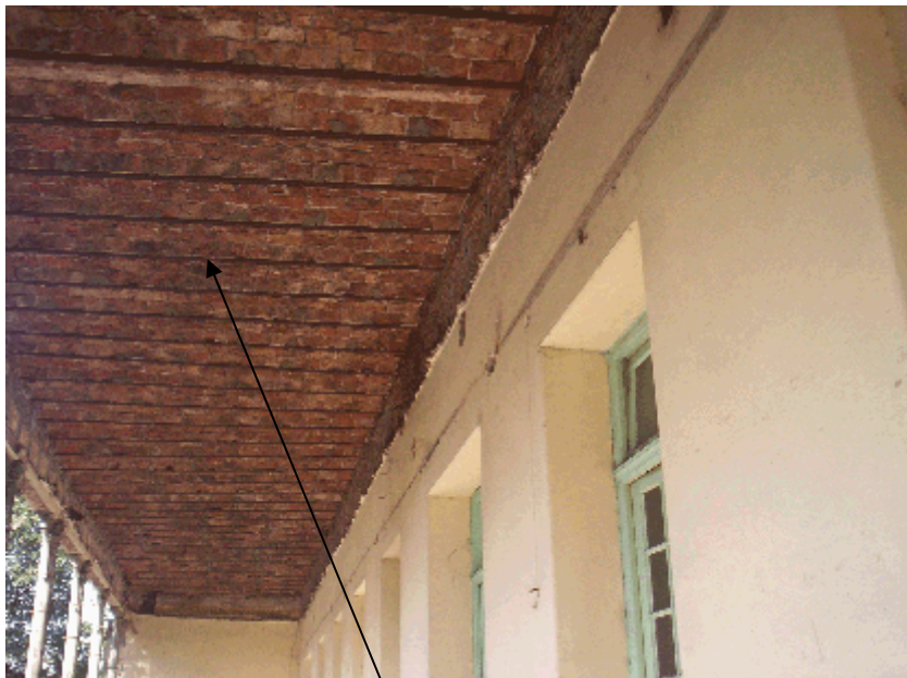
Se observa el deterioro en las bovedillas
