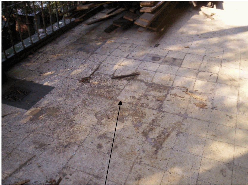
Se observa deformaciones en el piso
