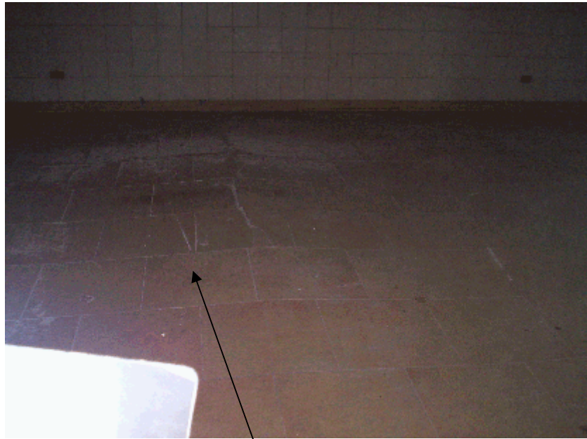
Se observa problemas de rajaduras en piso
