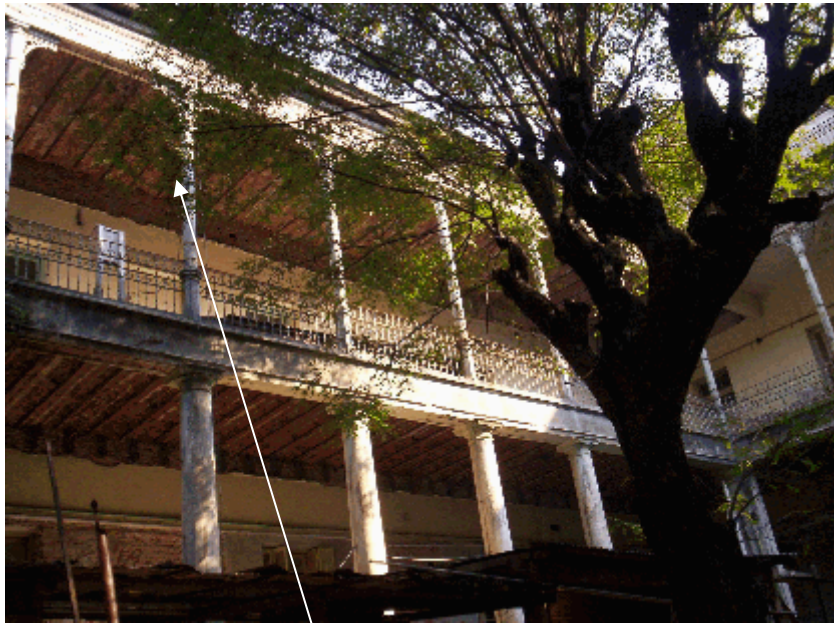
Se observa el deterioro en la estructura
