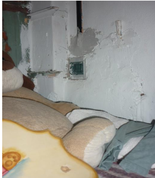
Foto "Niño Jesús dormitorio tablero seccional"
