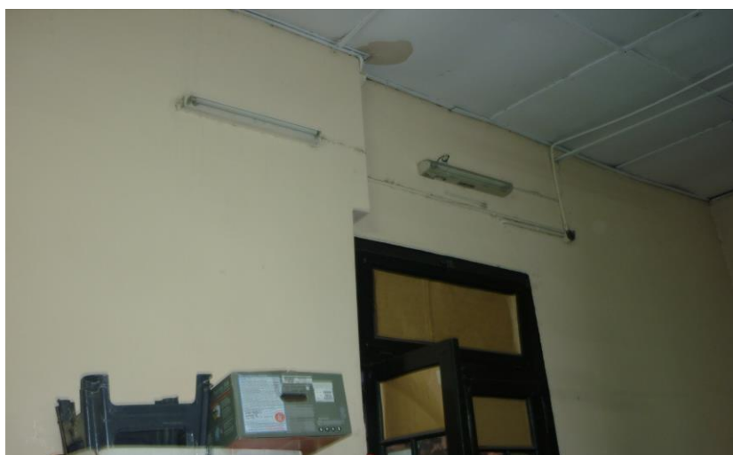
Foto "Refugio dormitorio N° 2 planta baja falta de vidrios"
