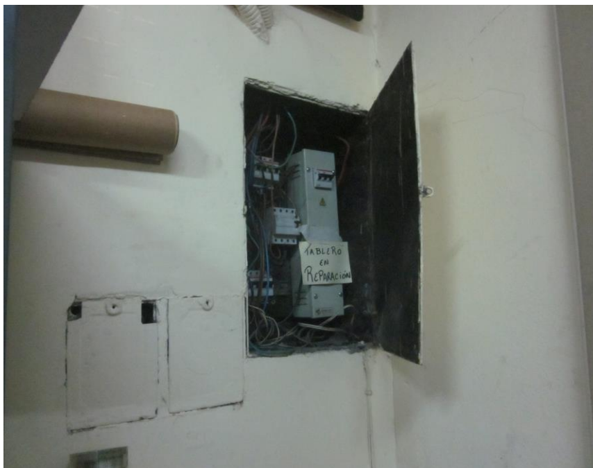
Foto "Proyecto 7 tablero eléctrico"
