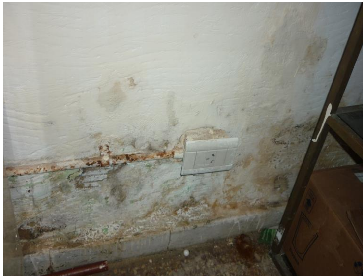
Foto "Niño Jesús consultorio humedad y electricidad"
