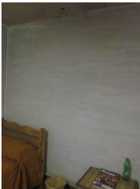
Foto "El Amparo 2do piso gotera en dormitorio"
