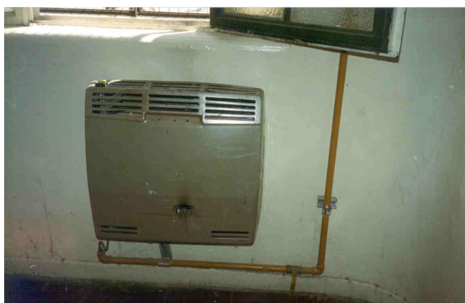
Foto N° 3 y 4: Vista de la ventilación y de la estufa de tiro balanceado instalada Escuela Esteban Echeverría.
