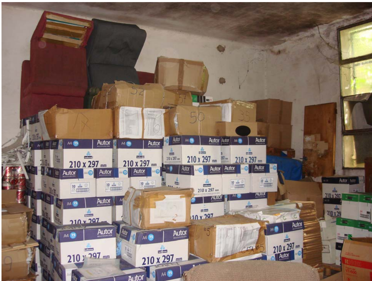
Foto N° 13: En la presente vista (continuación de la foto N° 8) se pueden observar; en una zona de depósito, cajas con documentaciones del organismo sobre pallets de madera, algunas sobre el piso. En el rincón cerca del cielorraso de este depósito se observan manchas de humedad en las paredes.
