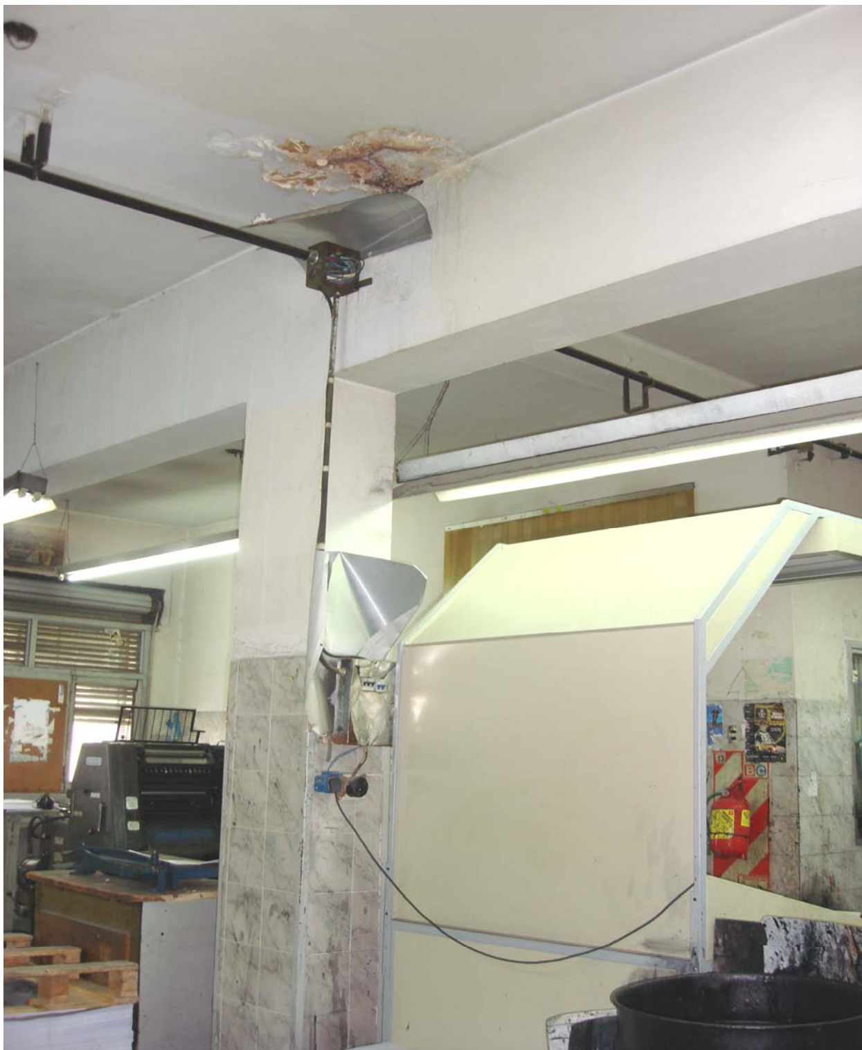
Foto N° 29: En la presente vista se pueden observar cables de electricidad expuestos y encintados que salen de una caja de derivación eléctrica cerca del cielorraso y por encima una chapa los cubre por las filtraciones de agua que salen del cielorraso, mas abajo se repite este caso con una caja de lleves de corte de electricidad.
