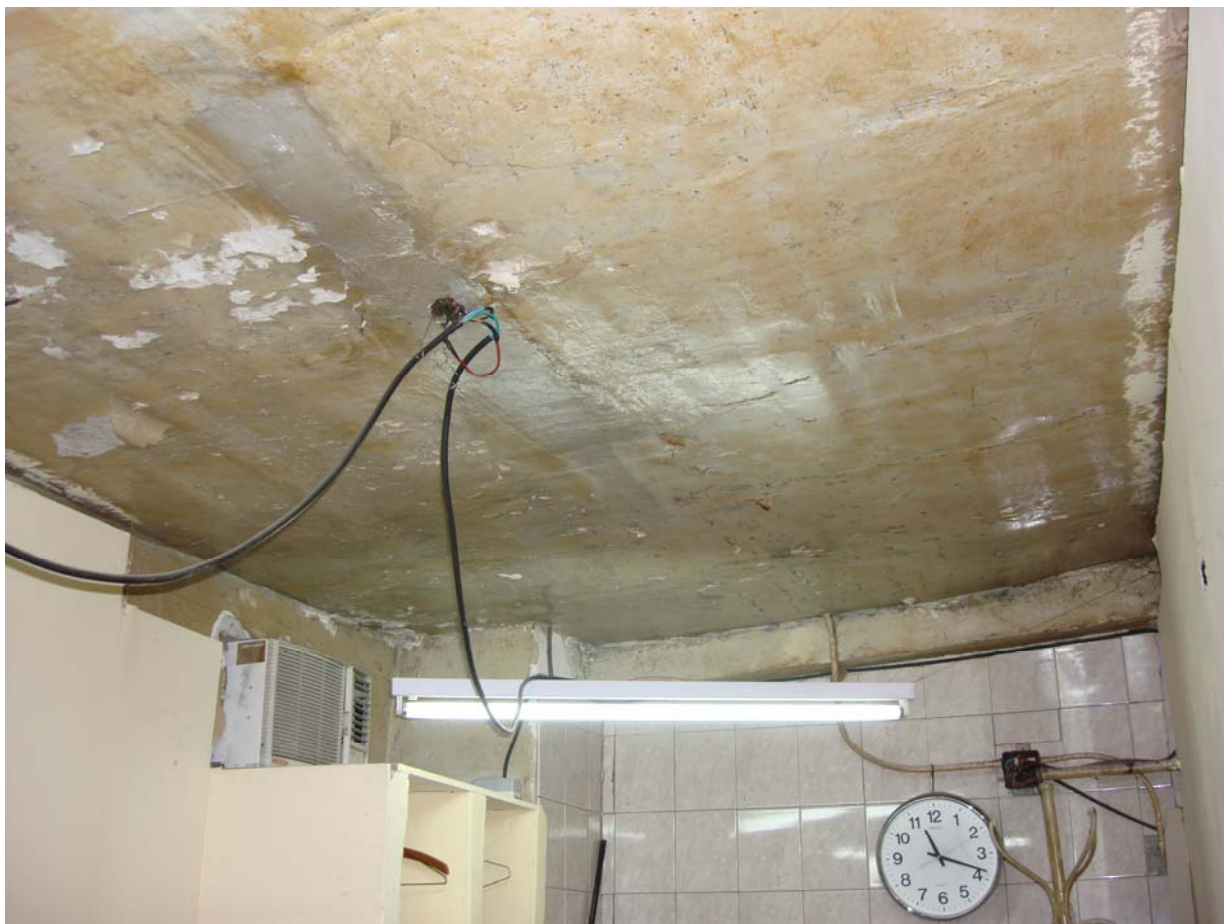
Foto N° 9: En la presente vista se pueden observar en el cielorraso cables de electricidad que salen de una boca de inspección de electricidad, expuestos y encintados y cuelgan hacia un equipo de AA y a un artefacto de iluminación con tubos fluorescentes.
