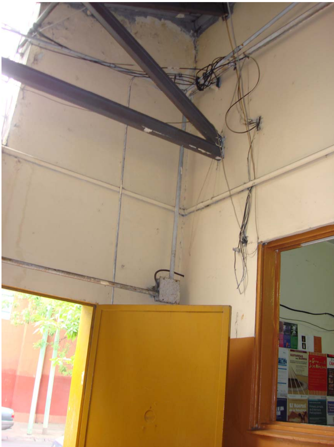
Foto Nº 6: En la presente vista se pueden observar cables de electricidad y de sistemas expuestos que salen de una boca de inspección en la pared y cuelgan hacia el techo en forma aérea. En la pared del frente hay una caja de derivaciones de electricidad de la cual sale un cable que pasa a través de la pared hacia el interior de otra oficina en forma aérea.
