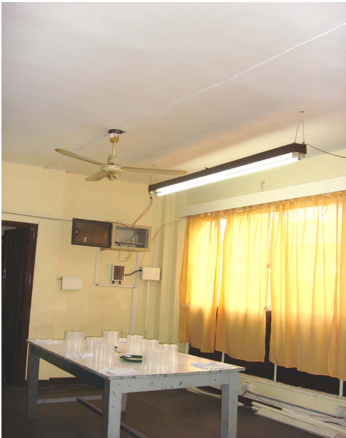
Foto N° 44: En la presente vista se pueden observar en la pared de fondo cables de electricidad expuestos y encintados que salen de un tablero de electricidad, alimentan un artefacto con dos tubos fluorescentes y siguen en forma aérea y en el zócalo de la pared de la derecha cables expuestos que salen de una caja hacia un tomacorriente exterior.
