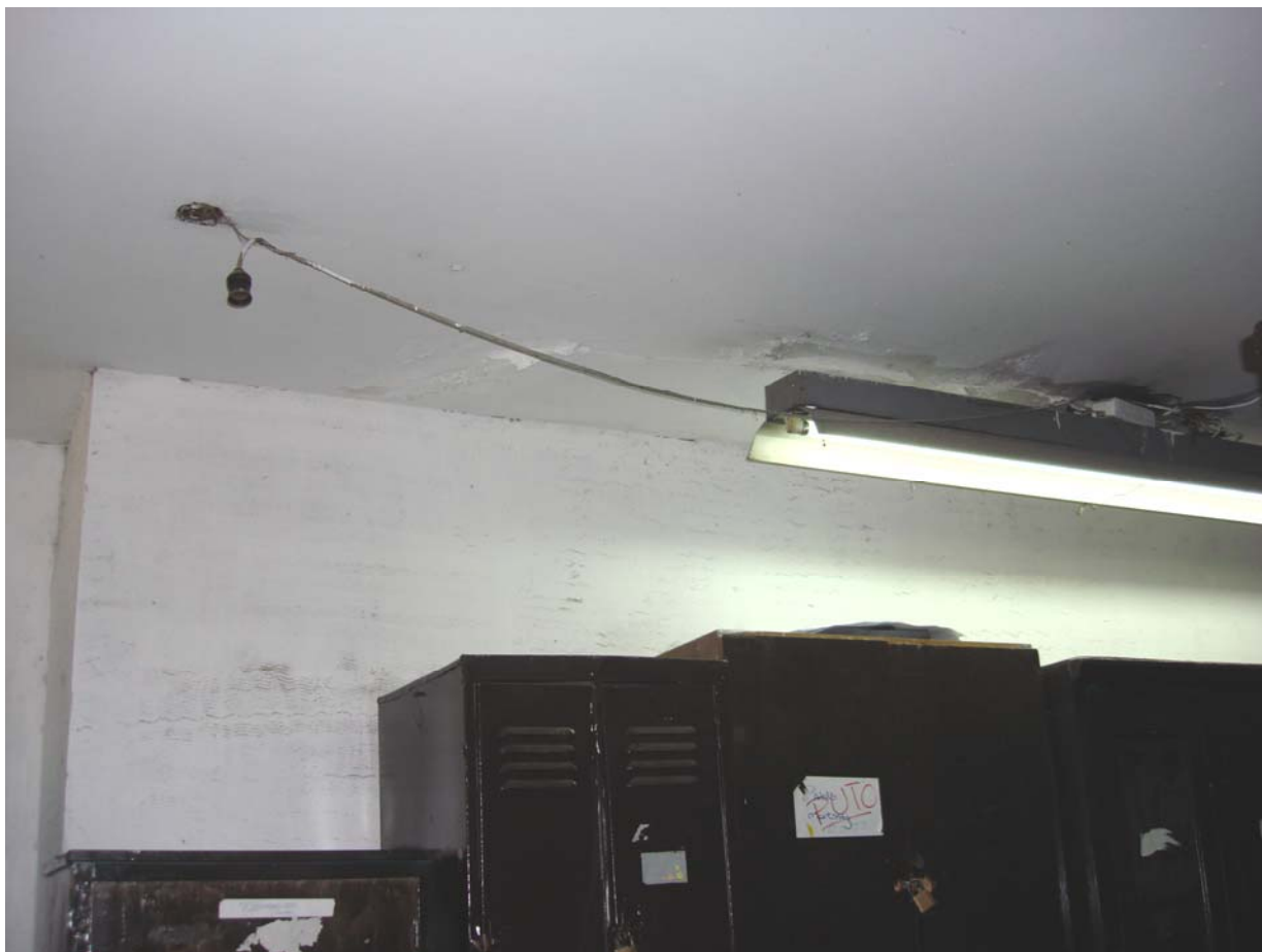
Foto N° 41: En la presente vista se pueden observar cables de electricidad expuestos y encintados que salen de un centro de electricidad en el cielorraso y alimentan dos tubos fluorescentes.
