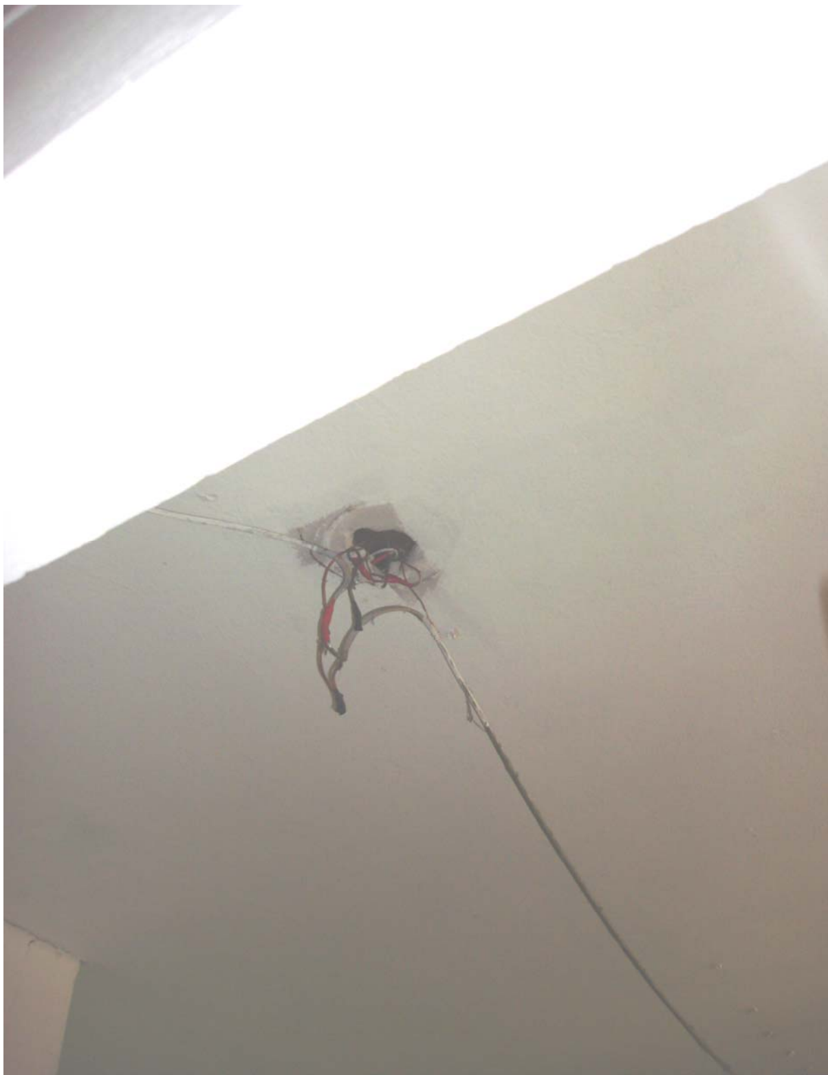
Foto N° 42: En la presente vista se pueden observar cables de electricidad expuestos y encintados que salen de un centro de electricidad en el cielorraso y cuelgan hacia abajo.
