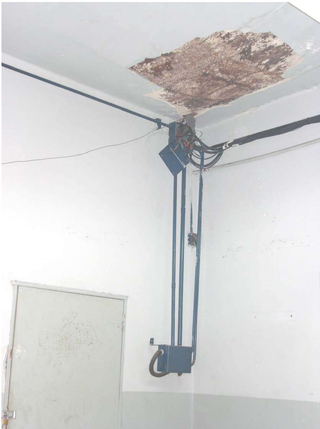
Foto N° 26: En la presente vista se puede observar en el rincón del cielorraso una caja de derivación eléctrica abierta y de la cual salen cables expuestos y encintados, mas abajo se pude ver otra caja más pequeña sin tapa y con cables expuestos y encintados. El cielorraso de este sector le falta el yeso por efectos de la humedad por filtraciones.
