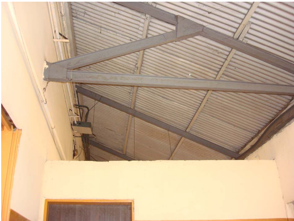
Foto N° 8: En la presente vista se pueden observar en la parte superior del techo bajo las chapas cables de electricidad que salen de una caja de derivación en forma aérea.
