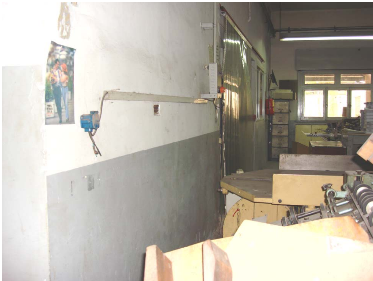
Foto N° 32: En la presente vista se pueden observar cables de electricidad expuestos y encintados que salen de un toma exterior de electricidad y entra en un cablecanal, a la derecha a la misma altura una caja de derivación eléctrica sin tapa presenta cables de electricidad expuestos.
