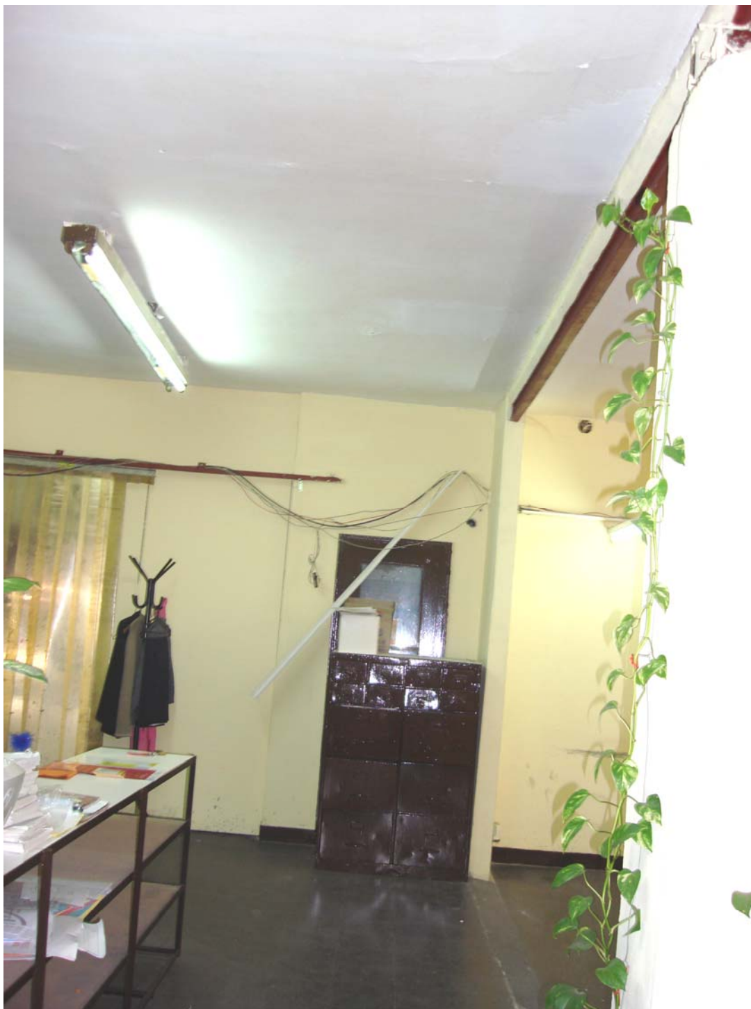
Foto Nº 43: En la presente vista se pueden observar en la pared de fondo cables de electricidad expuestos y encintados que cuelgan y se enganchan en un caño de gas y en el cielorraso a la derecha cables expuestos y encintados salen y corren por un dintel hacia la pared de fondo.
