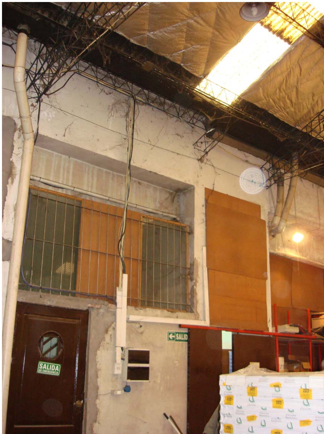
Foto N° 19: En la presente vista se puede observar en la zona de depósitos: una puerta con el cartel de “salida de emergencia” y a la derecha un tablero de electricidad del que salen cables de electricidad expuestos .
