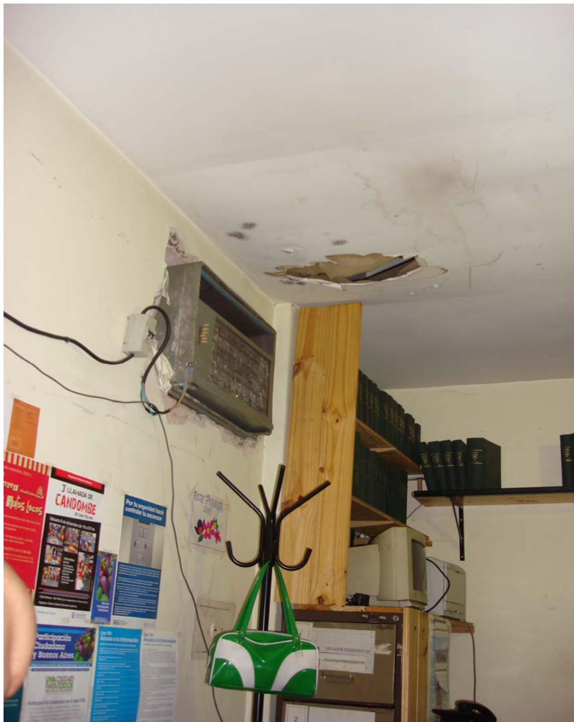
Foto N° 7: En la presente vista se pueden observar cables de electricidad expuestos que salen de una llave de corte térmica exterior y alimentan un equipo de AA embutido en la pared y otro cable pasa a través de los anteriores y cuelgan hacia el piso. Es de notar que el cielorraso presenta muestras de deterioro por efecto de filtraciones de agua justo sobre los cables antes mencionado, asimismo el equipo de AA que esta embutido en la pared no presenta terminaciones de albañilería correctamente realizadas.
