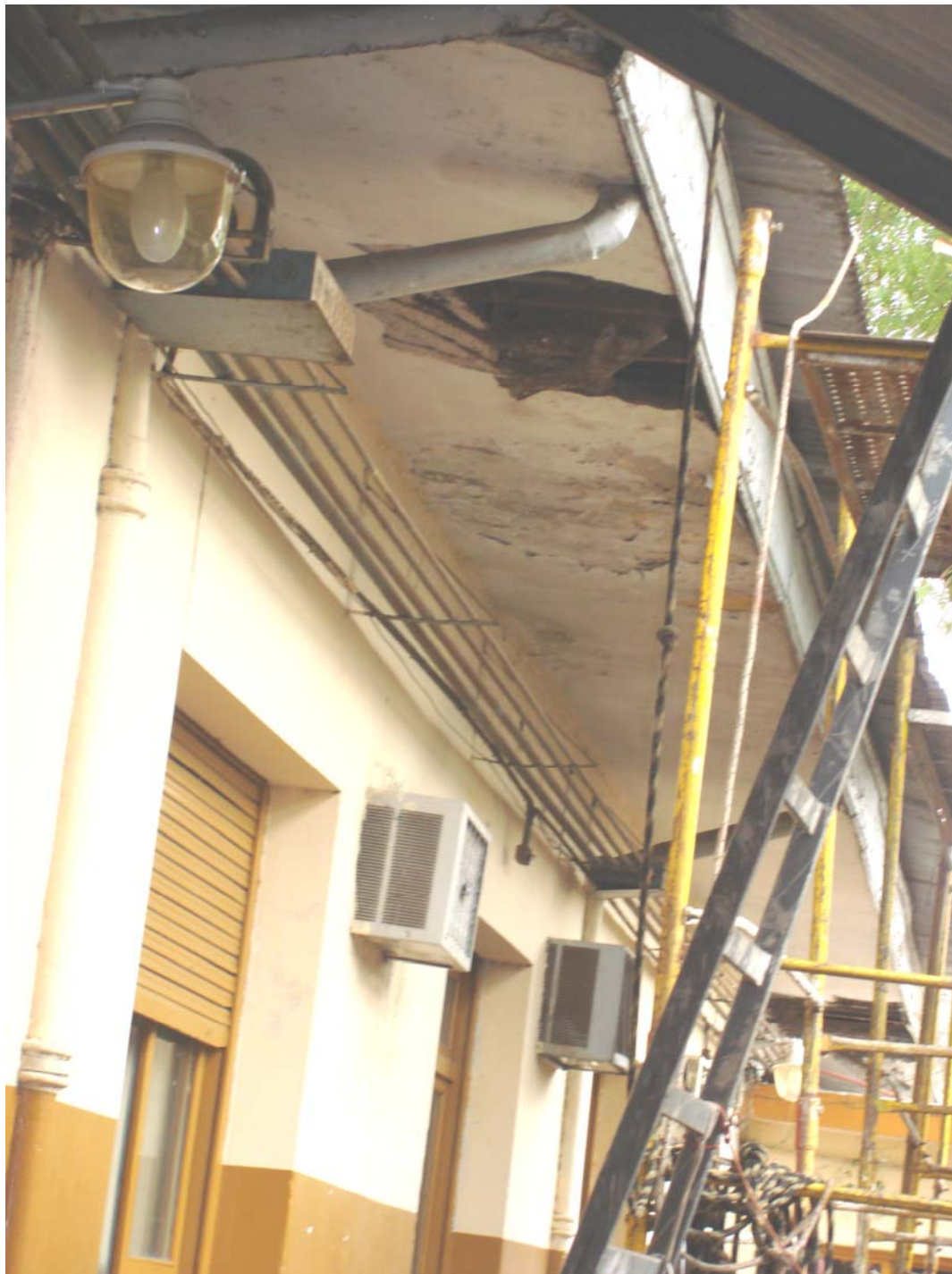
Foto N°10 En la presente vista se pueden observar; en el patio de la entrada un alero que corre al costado de la pared con roturas y deterioros producidos por efecto de la humedad, un artefacto de iluminación con el vidrio roto y en el rincón superior pasan en forma exterior cables de electricidad expuestos.
