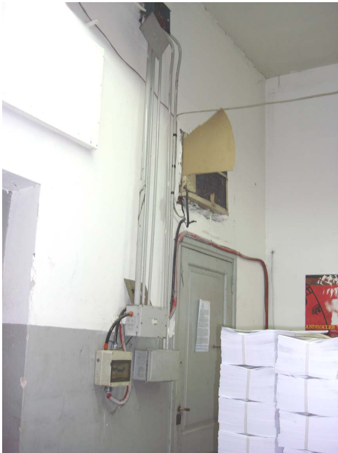
Foto N° 34: En la presente vista se pueden observar cables de electricidad expuestos y encintados que salen de un equipo de AA y suben encintados a un caño de electricidad y cerca del cielorraso cuelgan en dos direcciones, es de notar que debajo sobre el piso hay pilas de resmas de papel de imprenta.
