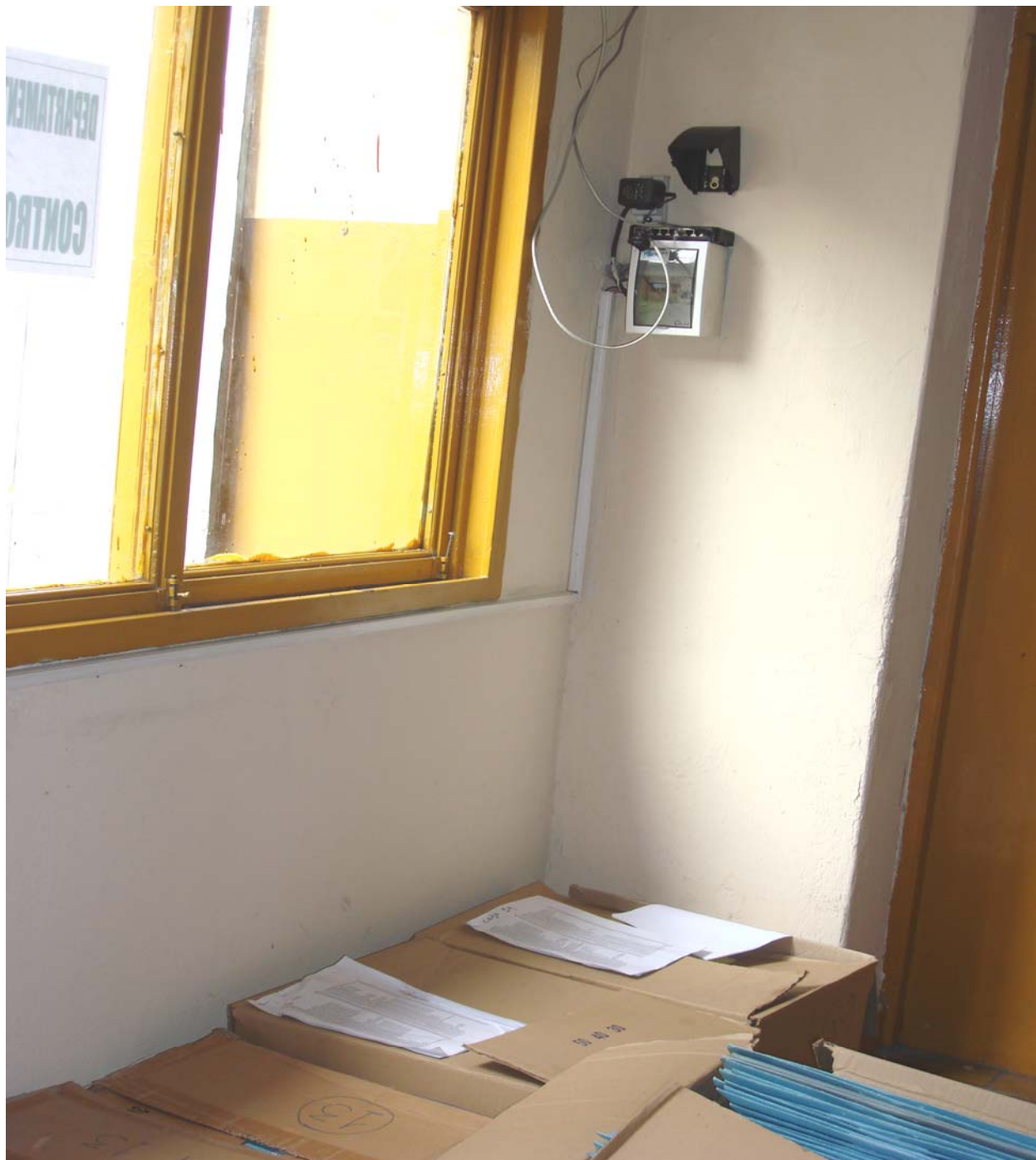
Foto N° 25: En la presente vista se puede observar en la oficina de control, sobre el piso cajas con documentación del Organismo mas arriba a la derecha de la ventana se pueden ver cables expuestos que salen de una caja con llaves térmicas.
