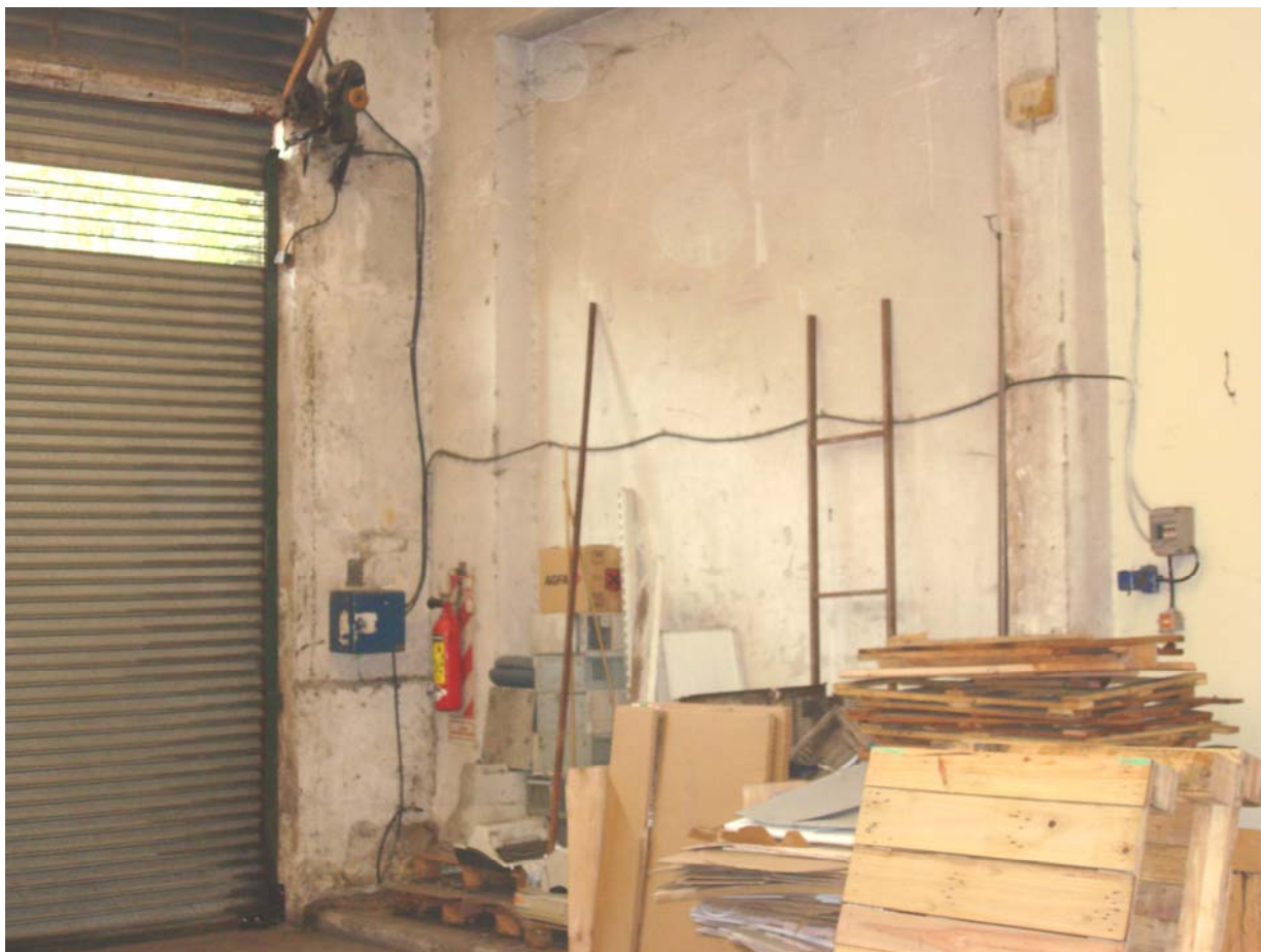
Foto N° 20: En la presente vista se puede observar: en la zona interior del acceso de vehículos, la presencia de materiales en desuso depositados en el piso, detrás, en la pared de fondo se pueden observar cables expuestos que entran y salen del tablero de la entrada y corren por la pared adheridos a la misma con grapas; a) hasta un tablero con llaves térmicas y b) suben hasta el motor que acciona la cortina metálica. A la derecha del tablero de la entrada hay un matafuego con la carga vigente el que se encuentra colocado sobre una chapa reglamentaria.
