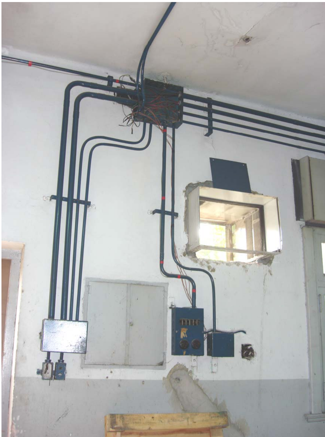
Foto N° 28: En la presente vista se pueden observar cables de electricidad expuestos y encintados que salen de tableros y de cajas de derivación, a la derecha mas arriba de los tableros de la parte inferior se puede ver un boquete en la pared donde debía estar un equipo de AA.
