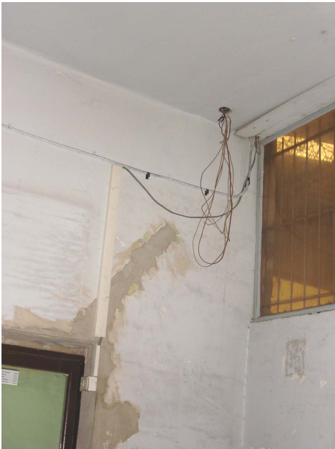
Foto N° 22: En la presente vista se pueden observar cables de electricidad expuestos y encintados que salen y cuelgan de dos centros ubicados en el cielorraso. Es de notar que se están realizando obras para ubicar los conductores eléctricos en cablecanal exteriores.
