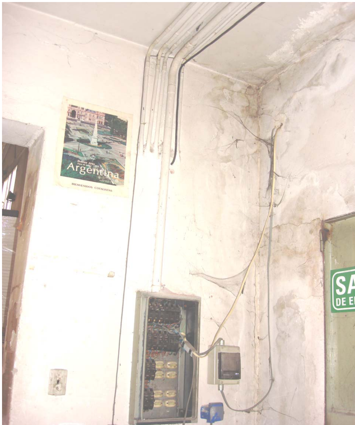
Foto N° 18: En la presente vista se puede observar: en la zona de depósitos un tablero sin tapa con varias llaves de electricidad térmicas y algunas llaves simples. Es de notar que de estas llaves térmicas salen cables expuestos que alimentan una caja de control y de esta suben expuestos por la pared la que presenta fuertes signos de deterioro por humedad.
