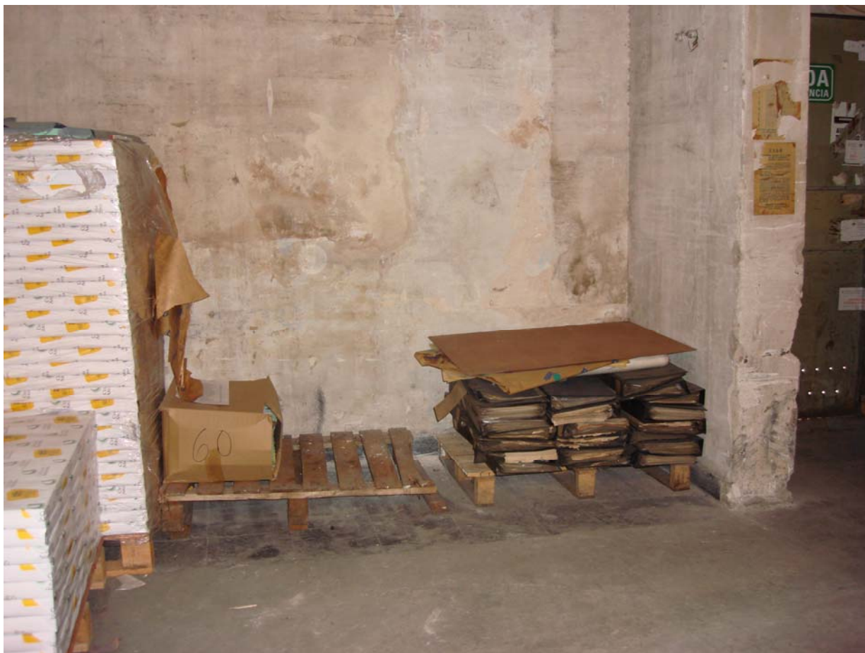
Foto Nº 11: En la presente vista se pueden observar; en una zona de depósito resmas de papel para la imprenta colocados sobre tablas de madera y a la derecha también sobre maderas carpetas con documentaciones del organismo. Es de notar el estado de las paredes con revoques deteriorados y con humedad.
