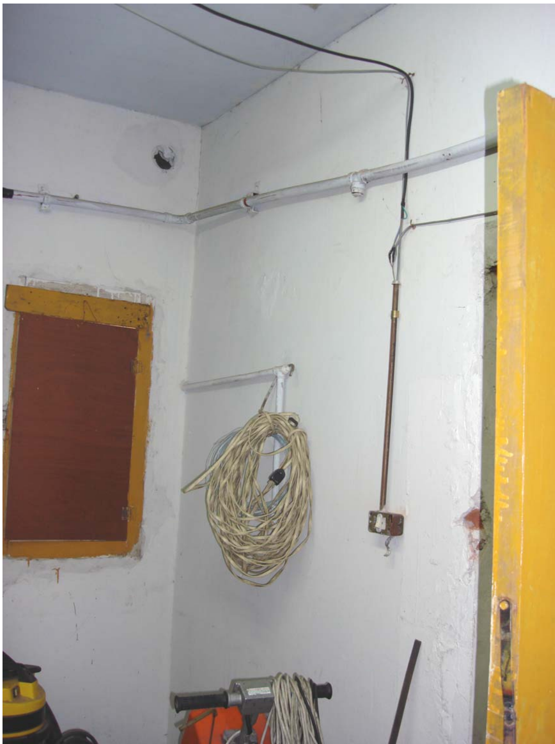
Foto N° 38: En la presente vista se pueden observar cables de electricidad expuestos y encintados; en una caja de electricidad exterior con una llave de corte y más arriba en una bifurcación del cable que viene de la caja antedicha.
