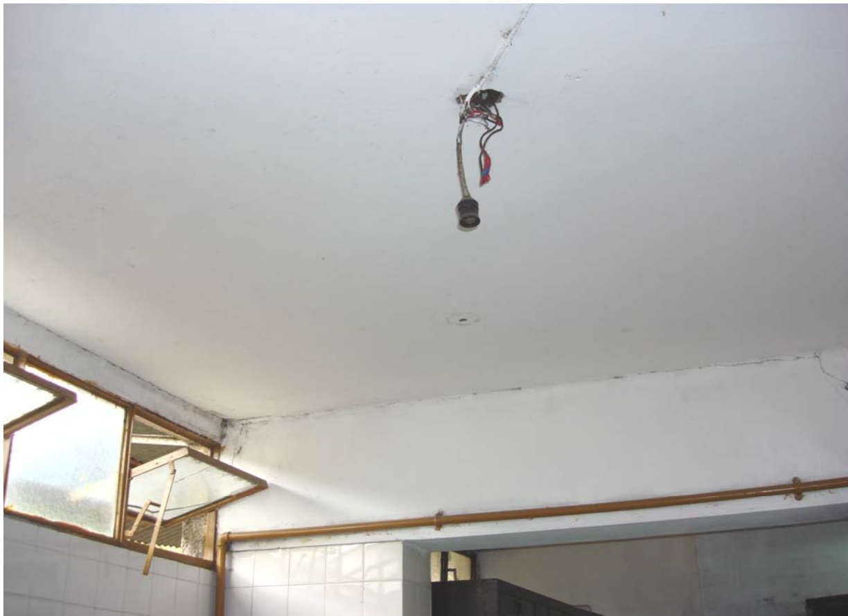
Foto N° 40: En la presente vista se pueden observar cables de electricidad expuestos y encintados que salen de un centro de iluminación sin tapa en el cielorraso y un portalámpara que cuelga de los cables.
