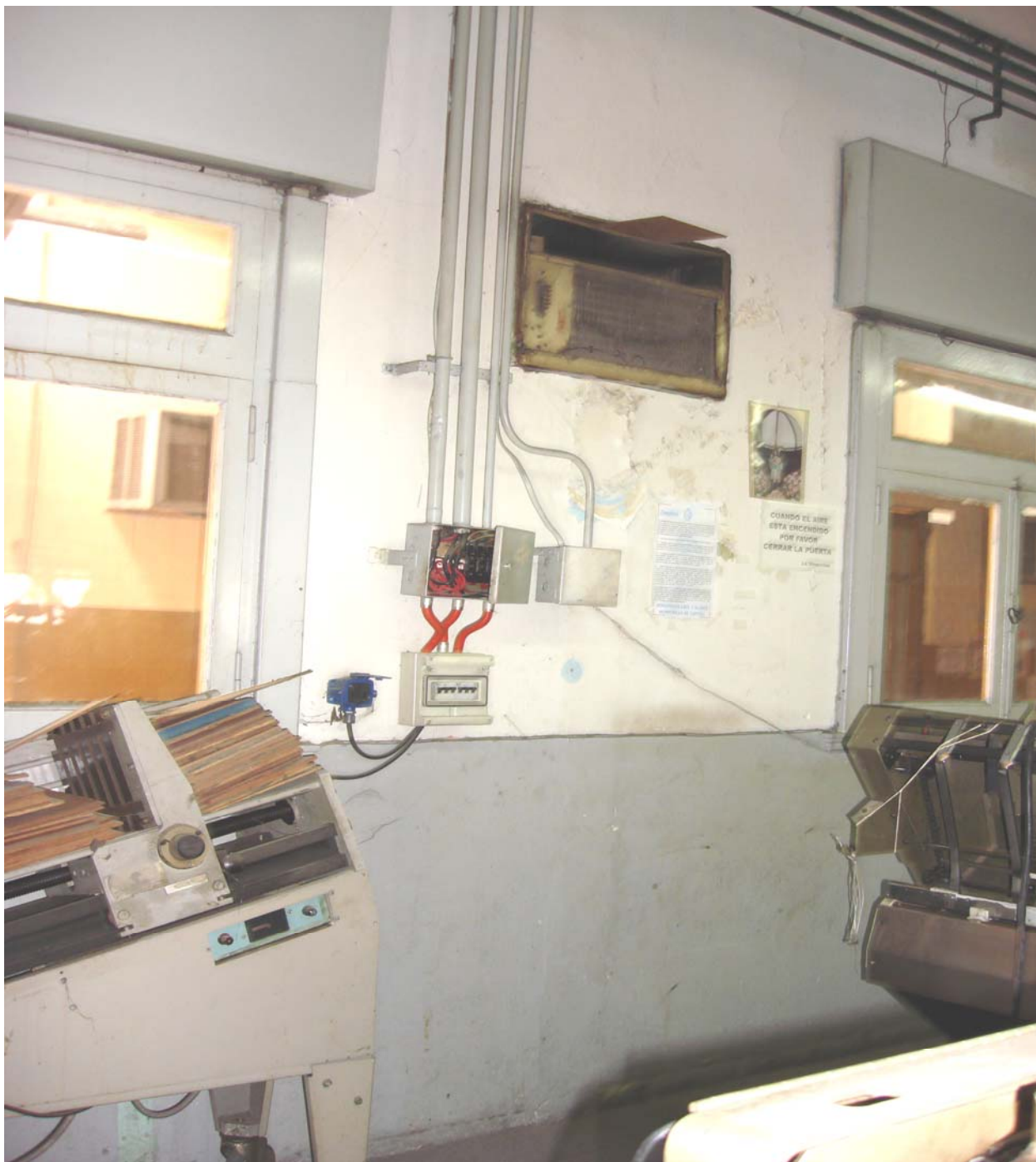
Foto N° 36: En la presente vista se pueden observar cables de electricidad expuestos y encintados que salen de una caja de derivación eléctrica y alimentan una máquina de la imprenta, también en la parte superior sobre la ventana se ven dos cables expuestos. Es de notar que toda esta pared presenta rastros de humedad.
