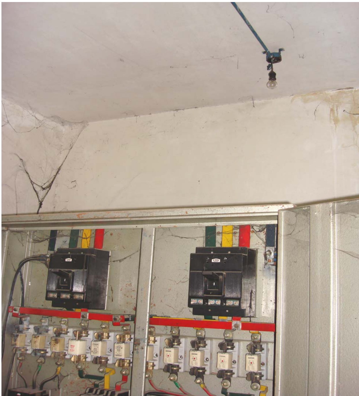
Foto N° 47: En la presente vista se pueden observar el tablero general de electricidad con las llaves de corte térmicas, sin la contratapa y en la parte superior se puede observar en el cielorraso un caño de electricidad que termina en un centro exterior con una lámpara colgando del mismo y los cables expuestos y encintados.
