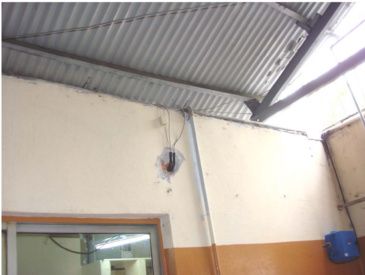
Foto N° 5: En la presente vista se pueden observar en la zona del acceso al organismo cables de electricidad que salen de una abertura en la pared sin ninguna terminación y cuelgan hacia el techo en forma aérea. A la derecha se encuentra el tablero general del mismo sale un cable de electricidad que sube por el rincón de la pared hacia el techo en forma exterior.
