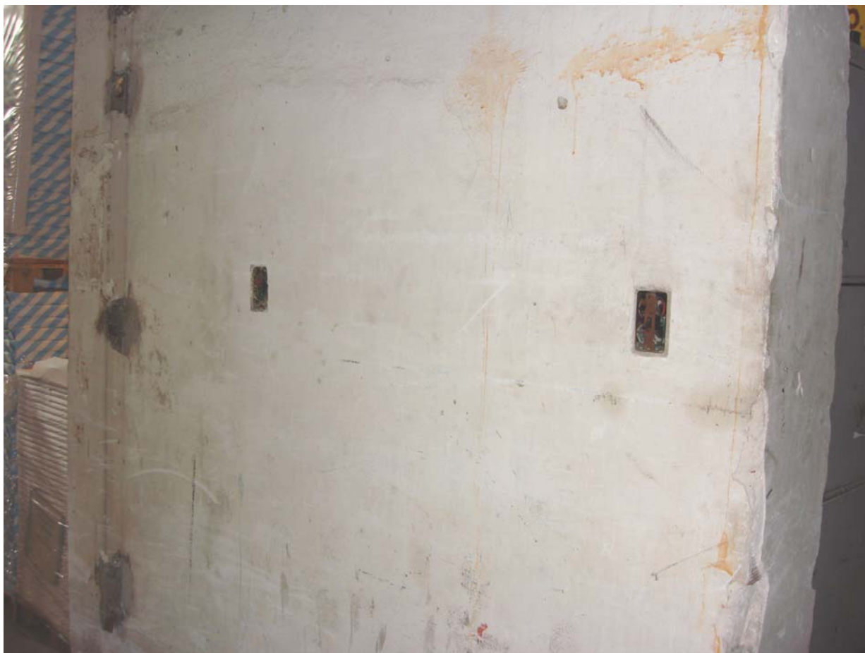
Foto N° 14: En la presente vista se puede observar sobre una pared del depósito (bastante deteriorada) dos bocas de electricidad sin las tapas y con cables expuestos.
