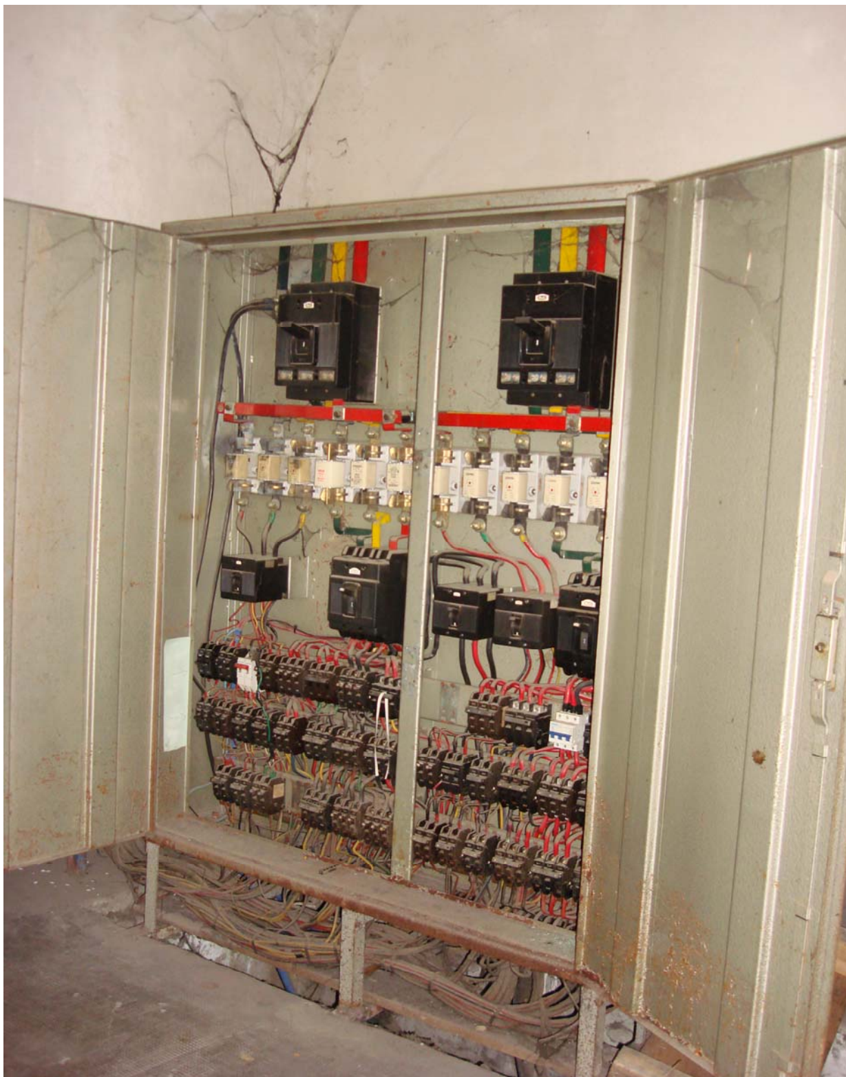
Foto N° 46: En la presente vista se pueden observar el tablero general de electricidad con las llaves de corte térmicas, sin la contratapa y en la parte inferior deja a la vista todos los cables de salida expuestos.
