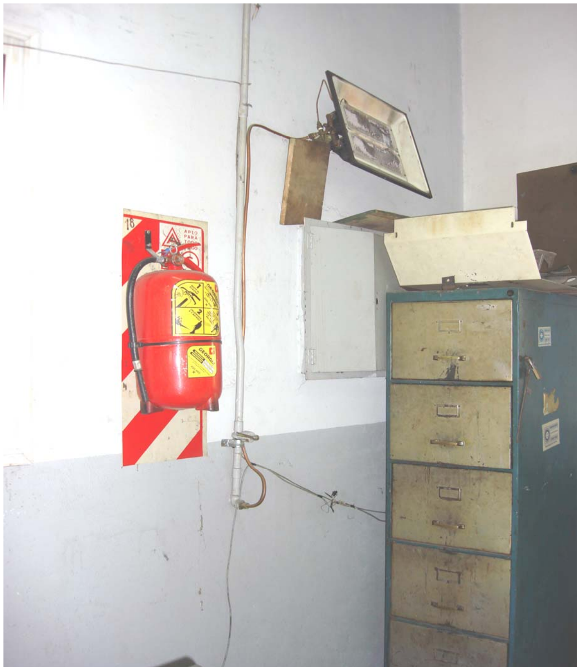
Foto N° 35: En la presente vista se pueden observar cables de electricidad expuestos y encintados que vienen desde la parte alta a la izquierda, y baja encintado a un caño de gas, al llegar abajo uno sale detrás de un mueble de oficina y el otro sigue hasta el piso. Es de notar que el caño de gas antes mencionado alimenta una pantalla a gas de rayos infrarrojos la que esta en el aire haciendo equilibrio sobre una tabla que se apoya en el marco de un tablero de electricidad. A la izquierda hay un matafuegos con la carga vigente colocado sobre una chapa reglamentaria.
