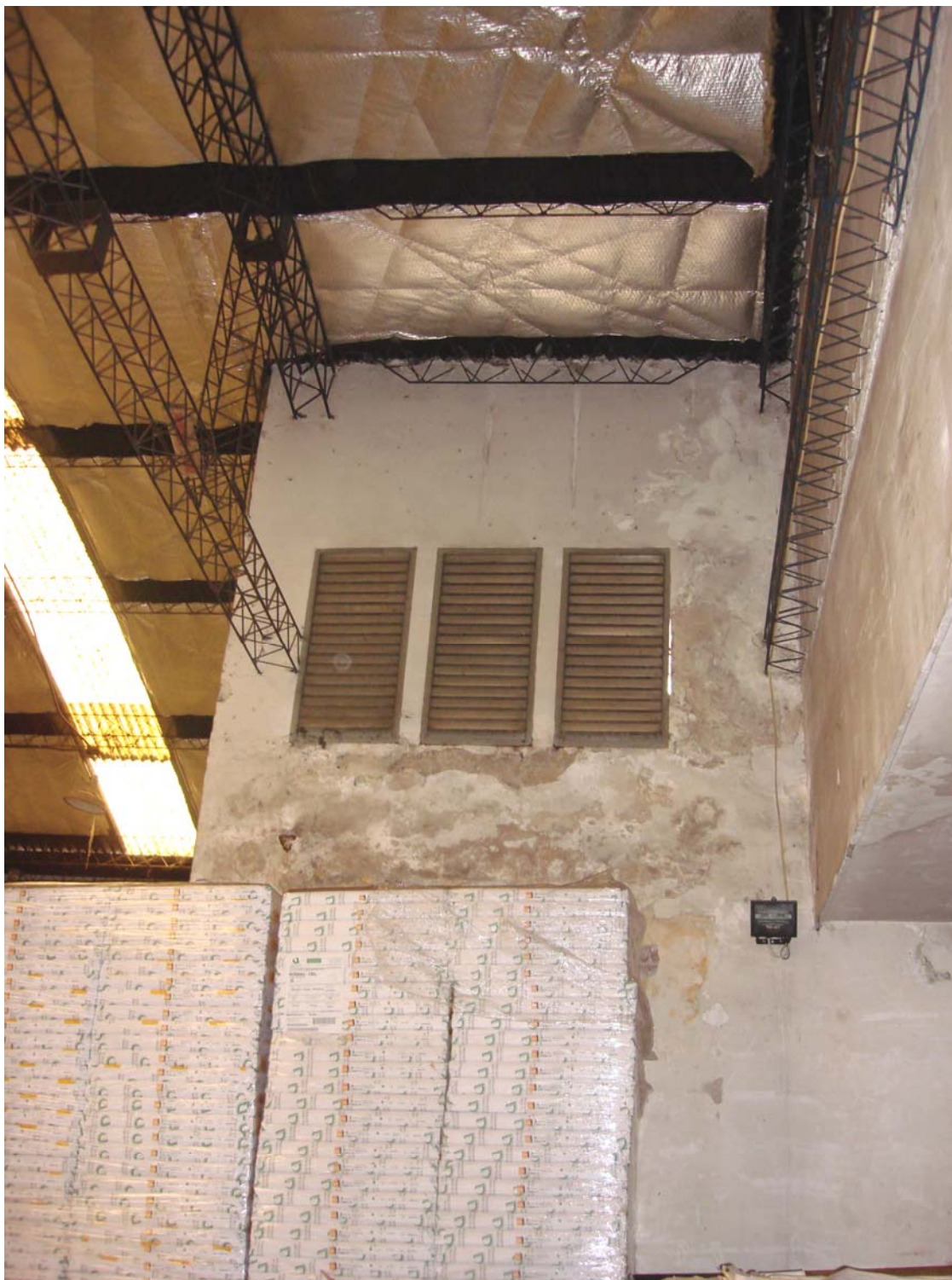
Foto N° 17: En la presente vista se puede observar: en la zona de depósitos y cerca de las pilas de resmas de cartulinas, una caja exterior de electricidad apoyada en la pared, la misma presenta fuertes signos de humedad y gran deterioro de su superficie.
