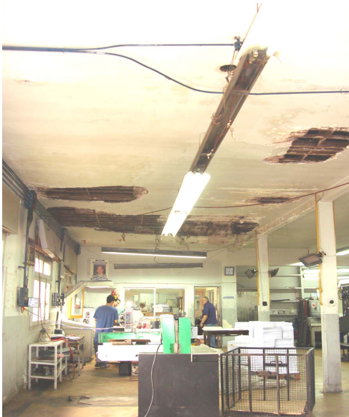
Foto N° 27: En la presente vista se puede observar el taller de la imprenta donde vemos cables de electricidad expuestos que cuelgan desde las llaves térmicas hasta las mesas de trabajo, otro sobre una columna que sale de una caja de derivación expuesto, otros alimentan los artefactos de iluminación con tubos fluorescentes y otro en un artefacto de iluminación sin los tubos y con los cables expuestos y encintados. Es de notar que gran parte del ciellorraso está desprendido por efecto de filtraciones de agua y debajo están las máquinas de la imprenta.
