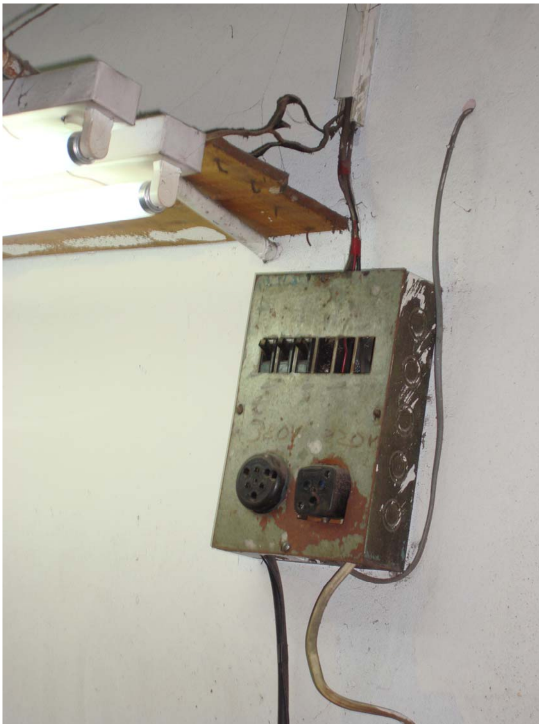
Foto N° 37: En la presente vista se pueden observar cables de electricidad expuestos y encintados que salen de un cablecanal y alimentan dos tubos fluorescentes colocados bajo unas tablas de madera, y de allí a una caja exterior mal amuradas a la pared, con llaves de corte.
