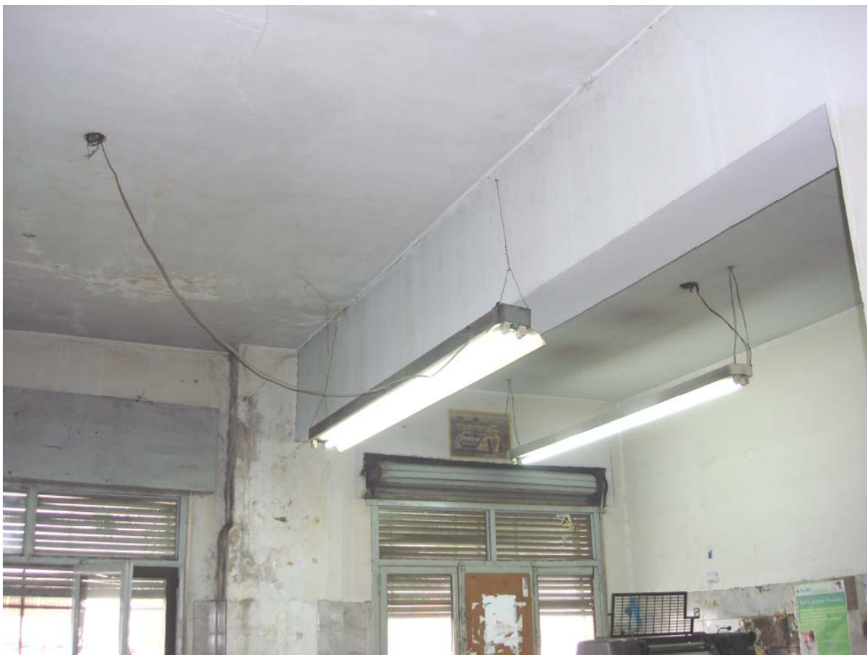
Foto N° 30: En la presente vista se pueden observar cables de electricidad expuestos y encintados que salen de centros de iluminación y alimentan tubos fluorescentes, en la pared del fondo y en el cielloraso se pueden ver rastros de humedad.
