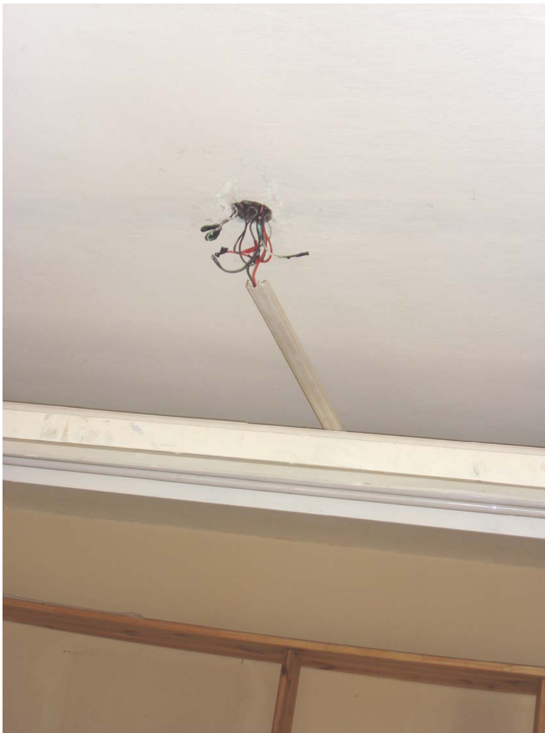
Foto N° 24: En la presente vista se puede observar en el cielorraso de este local cables expuestos y encintados que salen de un centro en el cielorraso y entran a una tira de cablecanal adherido al techo.
