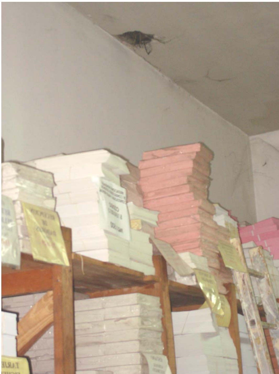
Foto N° 33: En la presente vista se pueden observar cables de electricidad expuestos y encintados que salen de una abertura en el cielorraso por encima de una estantería con resmas de cartulinas y papeles de la imprenta.
