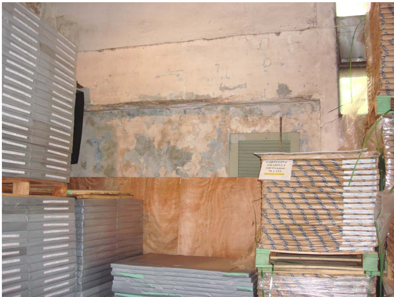
Foto N° 15: En la presente vista se puede observar pilas de resmas de cartulinas y papel para la imprente sobre pallets de madera, detrás se puede ver la pared de fondo con gran deterioro en su superficie y con humedad.
