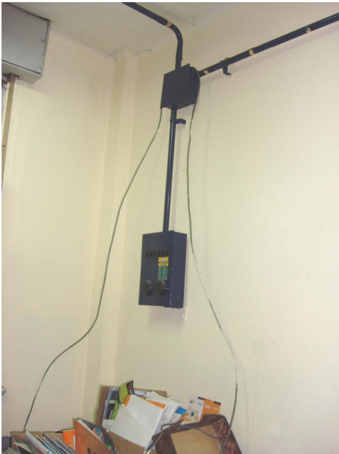
Foto N° 45: En la presente vista se pueden observar en la pared de fondo cables de electricidad expuestos que salen de una caja de derivación eléctrica, y cuelgan hacia el piso y pasan sobre un fichero.
