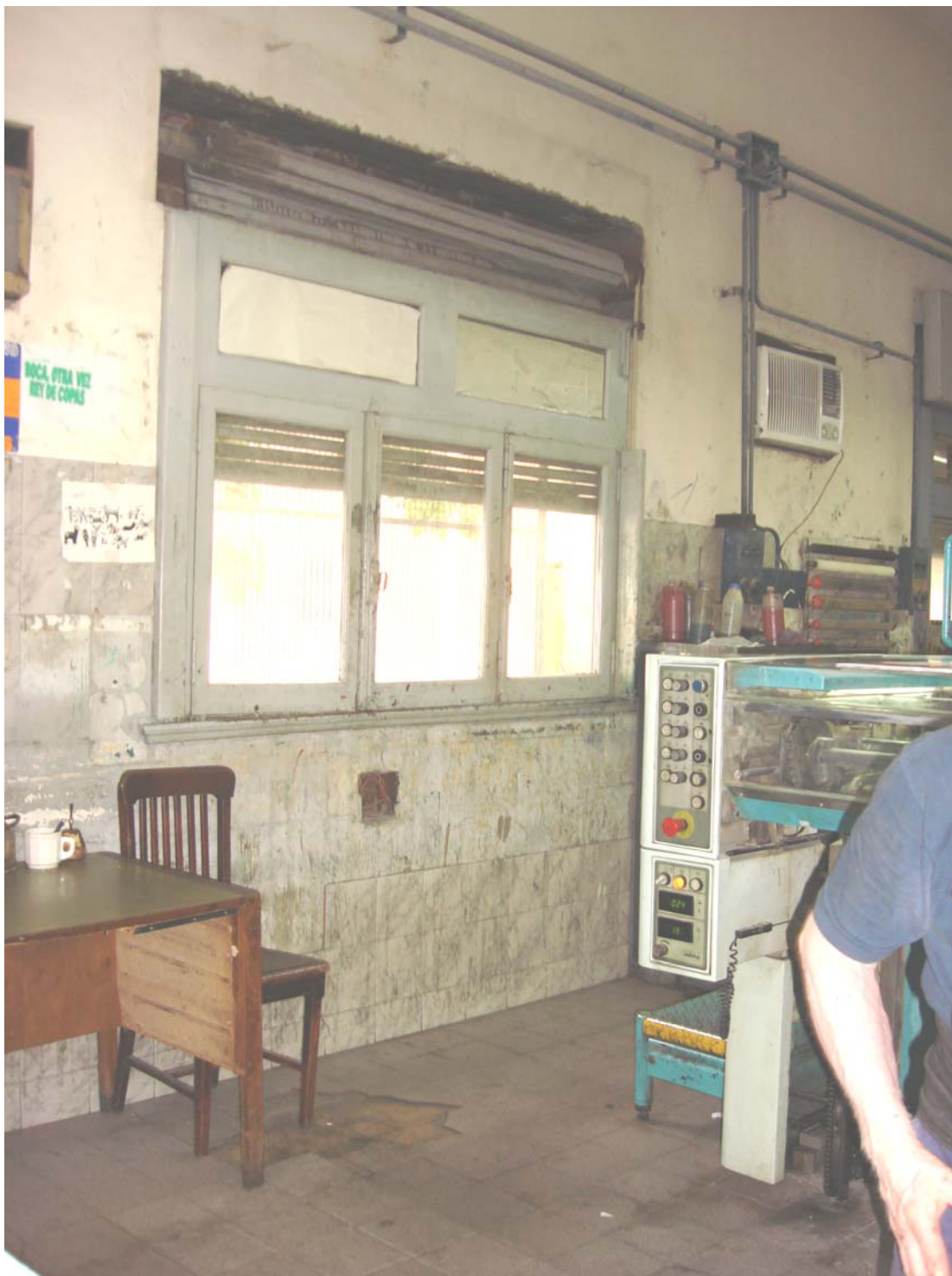
Foto N° 31: En la presente vista se pueden observar cables de electricidad expuestos y encintados que salen de una caja de derivación eléctrica debajo de la ventana, y en el piso varios mosaicos rotos.
