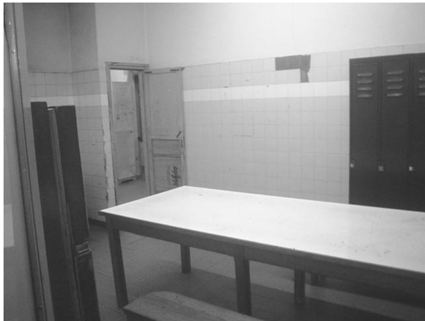
Foto N° 20 – Al acceder al interior de este sector se pueden observar revestimientos dañados, puertas rotas y falta de mantenimiento de las instalaciones en general.
