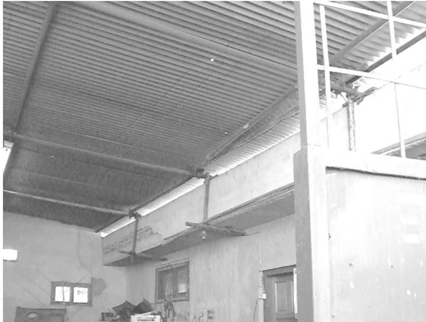
Foto N° 15 – idem foto anterior. La presencia de cables de electricidad expuestos sobre la pared desde la llave hacia los tubos de iluminación, junto a uno de los caños en el techo y en el fondo junto a la ventana.
