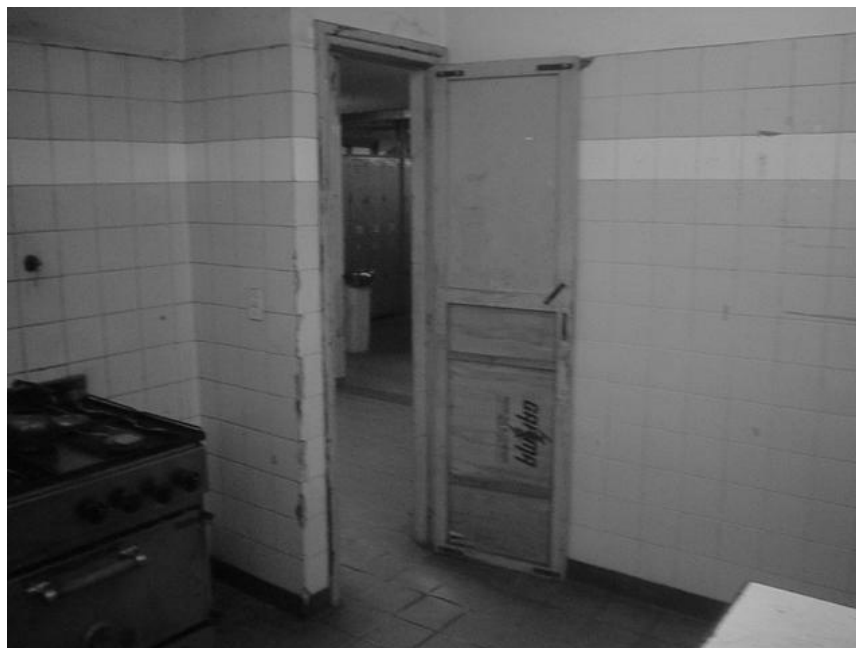
Foto N° 21 –Vista del acceso al sector de archivo y vestuario donde se puede observar el estado de los revestimientos y de la puerta. Es de notar que por este lugar en que se accede al archivo está el vestuario de los operarios masculinos, por lo tanto las mujeres administrativas no pueden usar este paso.
