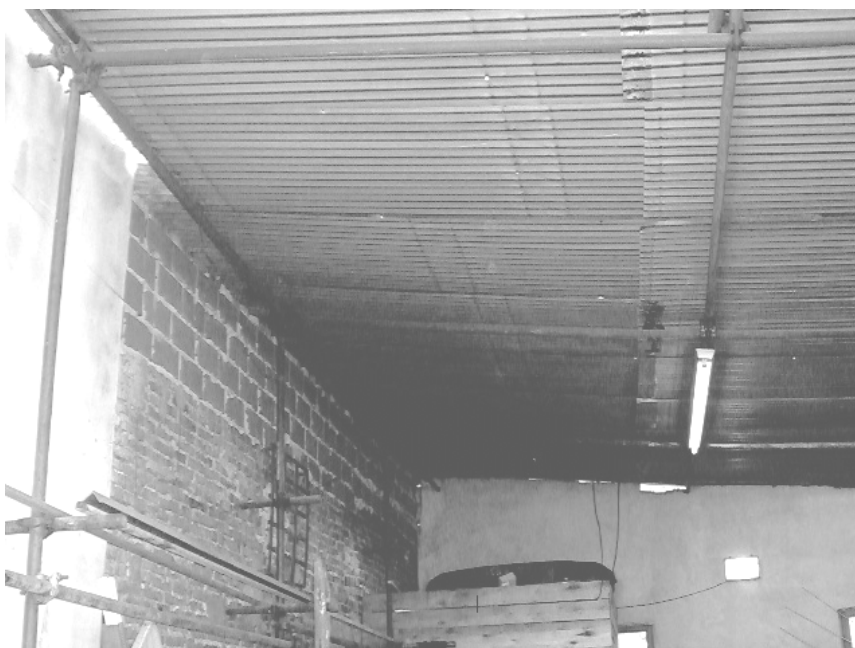
Foto N° 14 – En la presente vista se puede observar el interior de un tinglado precario armado en la parte posterior del galpón-taller, construido en base a una estructura tubular de las que se usan habitualmente en andamios. Es de notar la curvatura que presentan los caños transversales del techo, estos elementos no están diseñados para trabajar a la flexión como ocurre en este caso (como vigas) en la práctica se usan como soporte de un andamio donde el esfuerzo que soportan es a la compresión (como columnas) o a la tracción (como tensores). La precariedad de esta estructura acompaña a las paredes sin revocos, la presencia de cables de electricidad expuestos colgando desde el techo y la conexión expuesta de los tubos de iluminación.
