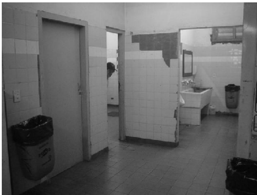
Foto N° 28 – Vista del acceso al archivo a través de este sector de vestuarios y baños. En la presente vista se puede observar el estado de mantenimiento de los revestimientos (rotos y faltantes).
