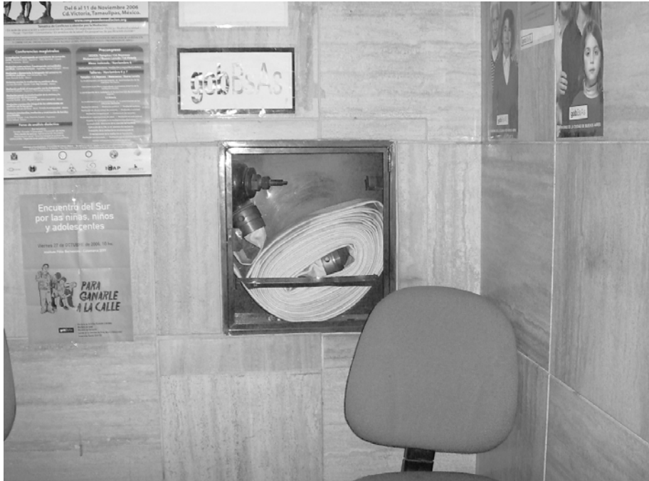
Foto N° 25 – En esta foto se observa la cabina con la manguera contra incendio sin la lanza, con lo que es inoperable.
