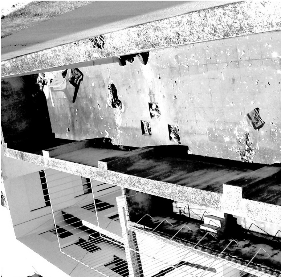
Foto N° 21 – En la presente vista tomada desde el piso 12 hacia abajo se observa el estado de abandono de la terraza del piso 11 con parte del piso destruido y basura por todos lados.
