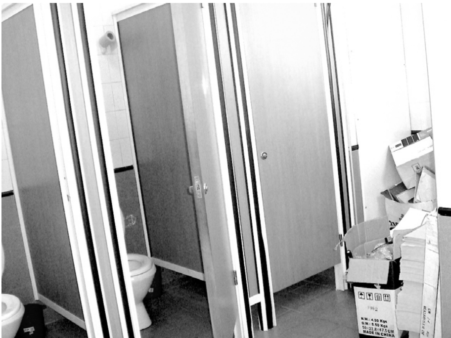
Foto N° 20 – En esta vista se puede observar las cabinas del baño de damas donde funcionan dos de las cuatro existentes. Una cabina ocupada por artículos de librería y la otra clausurada.
