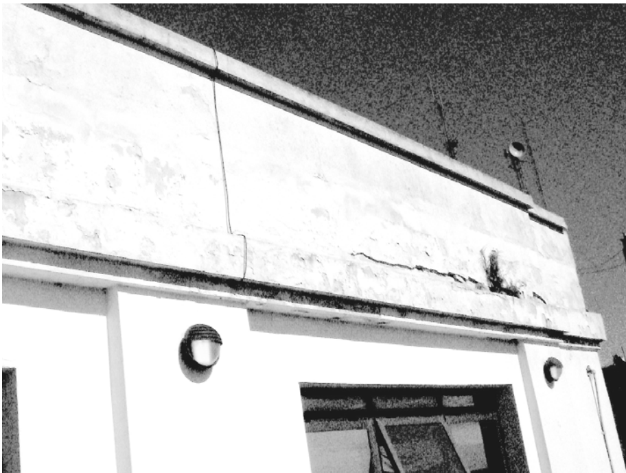
Foto N° 16 – Aquí se observa una grieta sobre el dintel y todo el entorno dañado.
