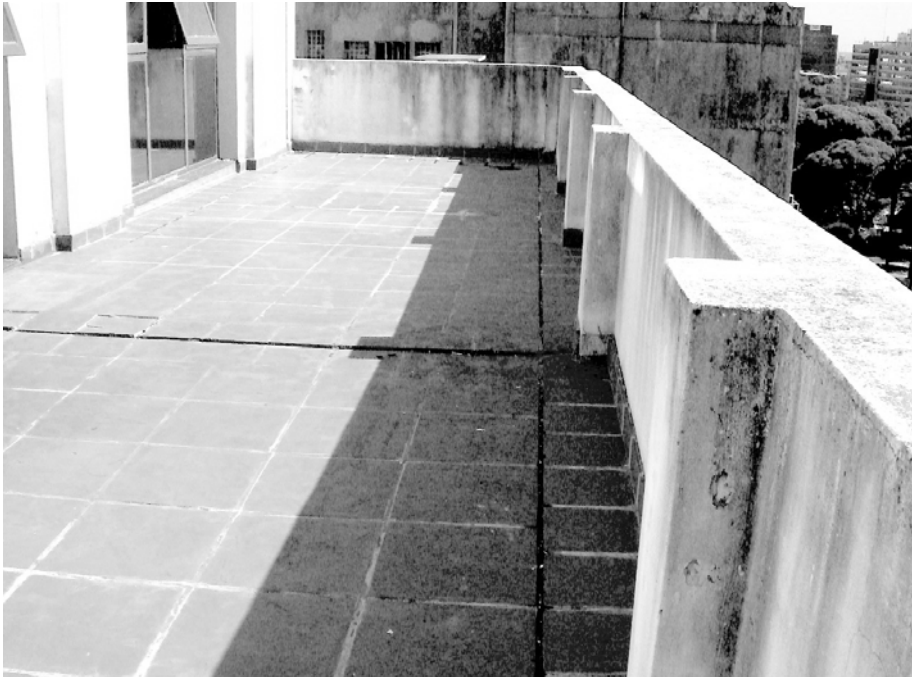
Foto N° 17 – En esta terraza se puede observar el piso levantado junto a la junta de dilatación.
