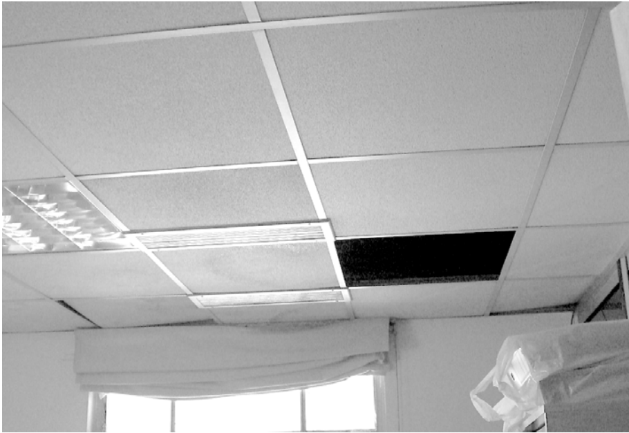
Foto N° 3 – Rastros de humedad por filtración en el cielorraso, con paneles deteriorados y faltantes.
