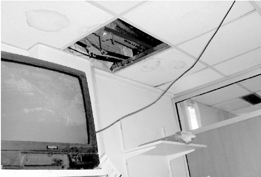
Foto N° 9 - Rastros de humedad en el cielorraso con algunos paneles deteriorados, un panel faltante donde quedan expuestos cables de electricidad y otras instalaciones y el cable de alimentación del televisor colgando del cielorraso.
