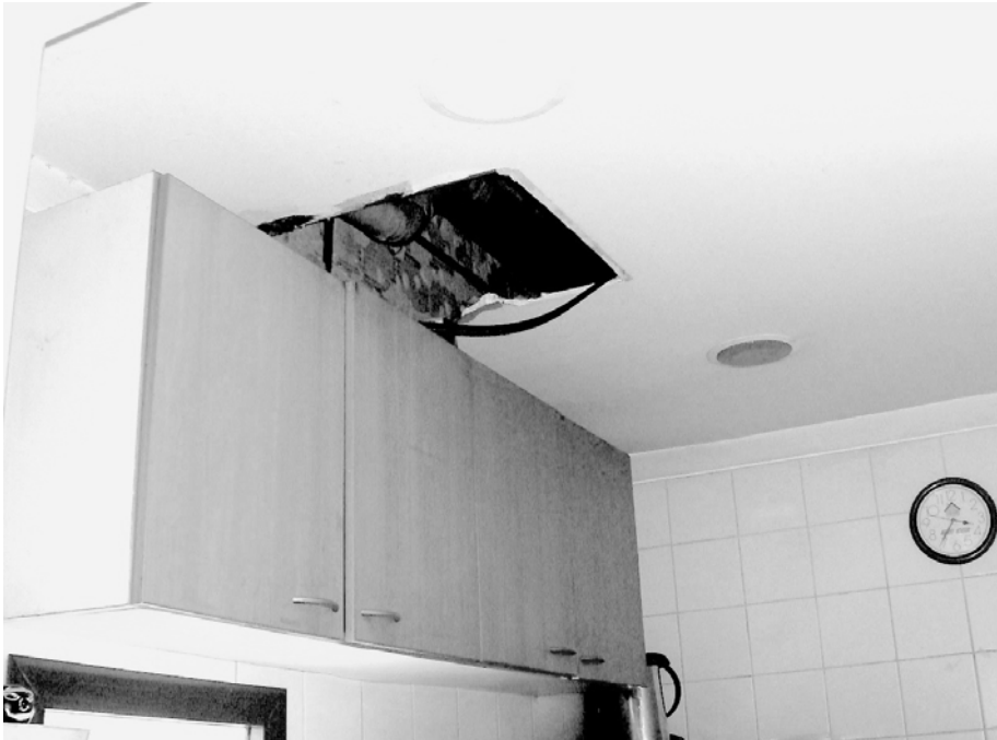
Foto N° 19 – Detalle del cielorraso de la cocina con manchas de humedad y una gran abertura producida por la acción del agua.
