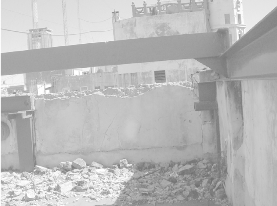
Foto N° 27 – Vista de la terraza sobre el piso 12 con grandes destrozos en la mampostería. Este es uno de los lugares por los que filtra el agua de lluvia al piso inferior.
