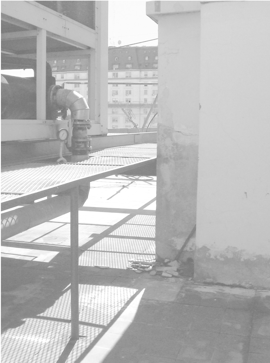
Foto N° 29 – En la presente vista se puede observar en la terraza sobre el piso 12, la pared exterior del sobrerrecorrido del palier de escaleras con perforaciones y daños producidos por el agua. Este es otro de los lugares por donde filtra agua a la planta inferior.
