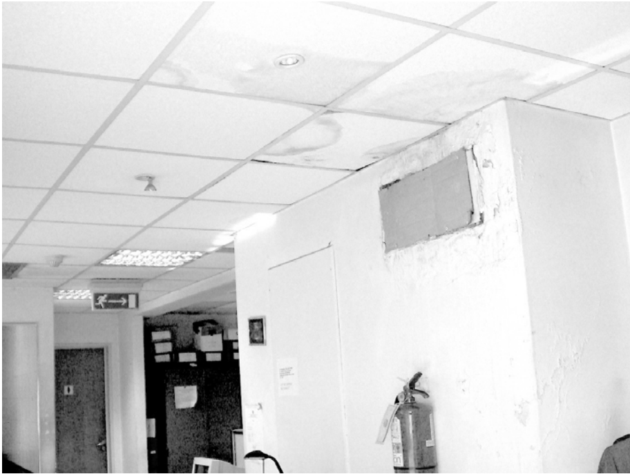
Foto N° 13 – En la presente vista se puede observar los daños producidos por el agua.
