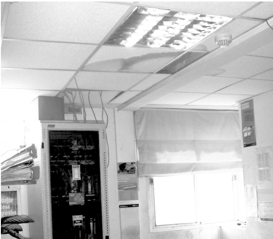
Foto N° 6 – Rastros de humedad por filtración en el cielorraso, con paneles deteriorados y conductores de telefonía y electricidad “expuestos” colgando.
