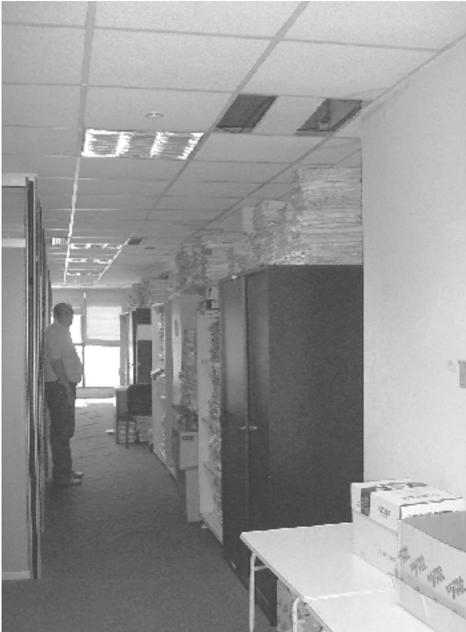
Foto N° 11 – Pasillo con gran cantidad de cajas y carpetas y en el cielorraso rastros de humedad.
