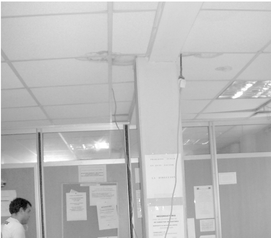
Foto N° 4 – Rastros de humedad por filtración en el cielorraso, con paneles deteriorados y conductores de electricidad “expuestos” colgando.
