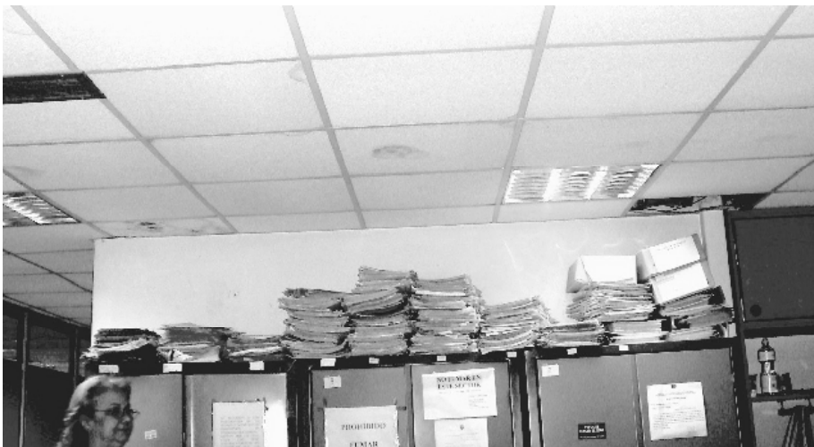
Foto N° 10 - Rastros de humedad en el cielorraso con algunos paneles deteriorados, un panel faltante, por este lugar se aprecian cables de electricidad expuestos y instalaciones de otros servicios, por debajo vemos gran cantidad de cajas y carpetas apiladas.
