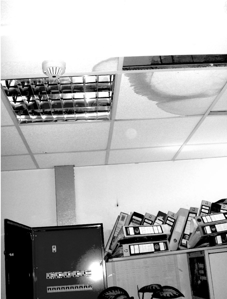
Foto N° 7 – Rastros de humedad en el cielorraso, con un panel faltante, varios deteriorados y biblioratos apilados, en este lugar se halla un tablero de electricidad con el cable canal que lleva los conductores por sobre el cielorraso (donde esta la filtración de agua).
