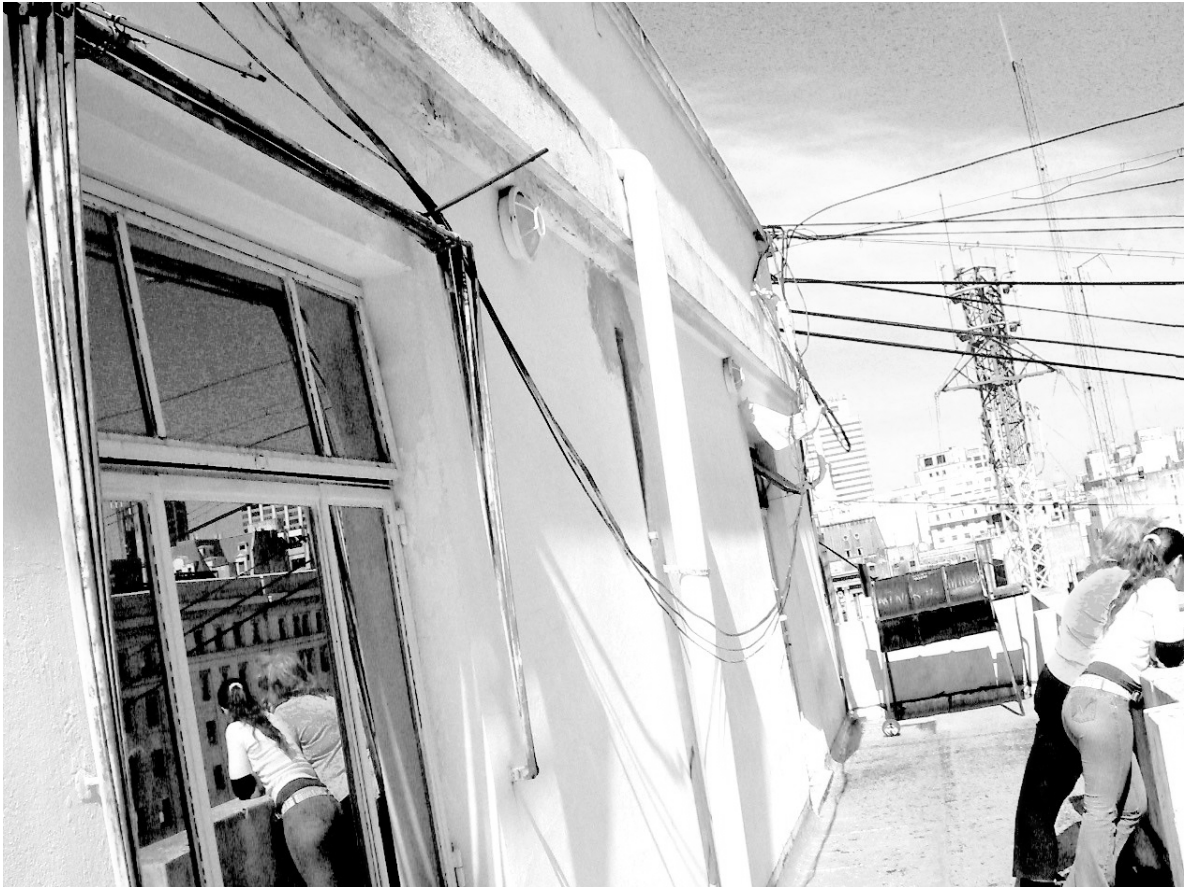
Foto N° 23 – En esta foto se observan los daños sobre la parte superior de la pared con cables expuestos colgando.
