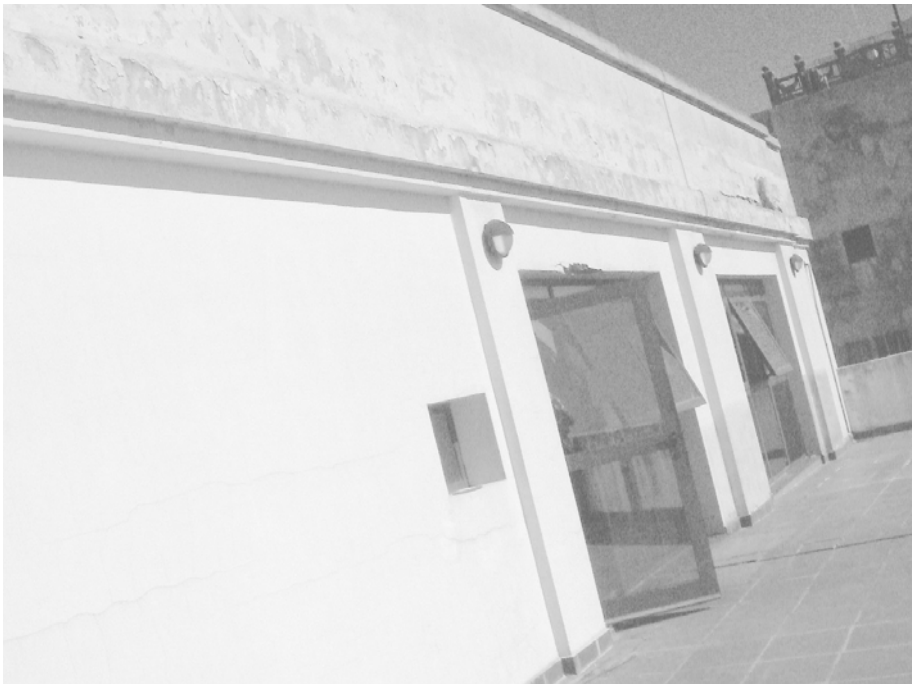
Foto N° 14 – Aquí se puede ver los daños en las paredes sobre el dintel y el piso levantado en la junta de dilatación.
