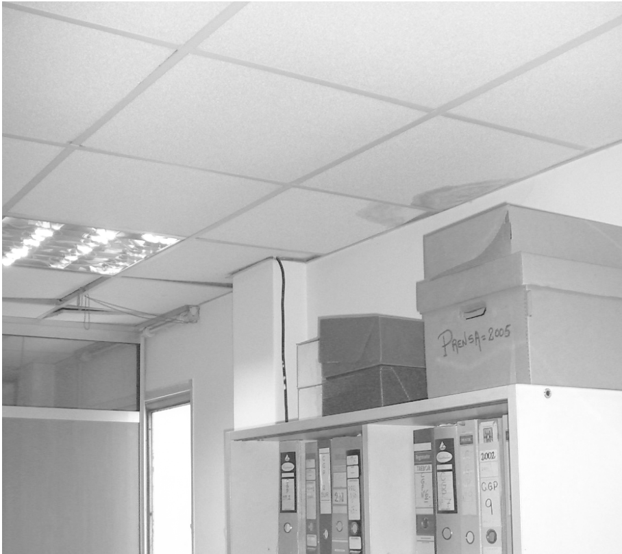
Foto N° 5 – Rastros de humedad por filtración en el cielorraso, con paneles deteriorados y conductores de electricidad “expuestos” colgando. Se pueden observar cajas de cartón apiladas por debajo de los lugares donde hay filtraciones de agua.
