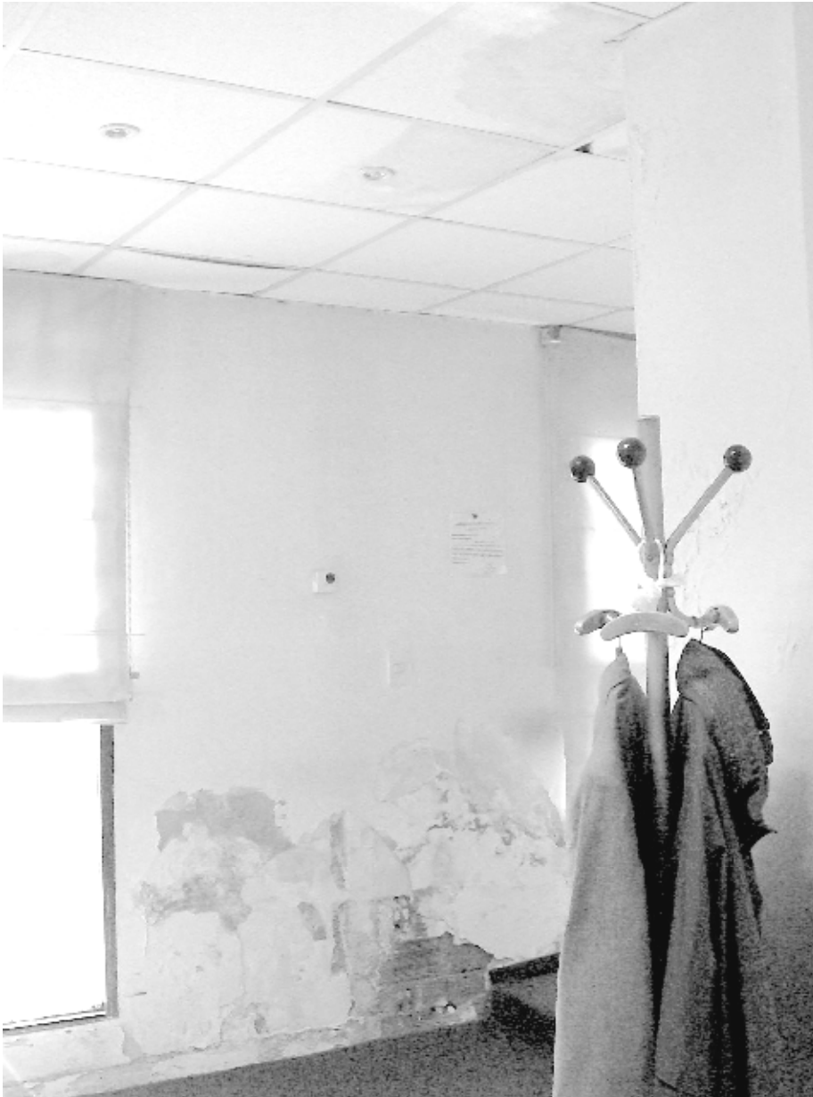
Foto N° 12 – En la presente vista se puede observar los daños producidos por el agua sobre el cielorraso y la pared que da a una terraza exterior.
