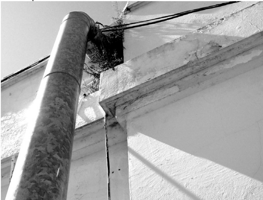
Foto N° 22 – En esta vista se observa la parte superior de la pared de la terraza con muestras de los daños producidos por el agua y plantas que surgen por las grietas.
