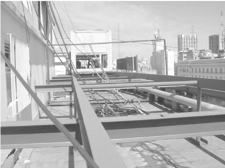
Foto N° 28 – Vista de una parte de la terraza sobre el piso 12 donde se observan las instalaciones de los equipos de aire acondicionado central con cables mezclados entre las cañerías.
