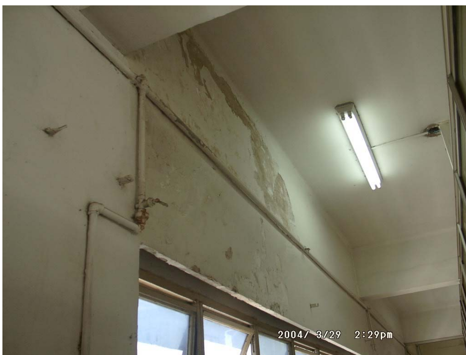
Sector de espera/Humedad en paredes y techos
