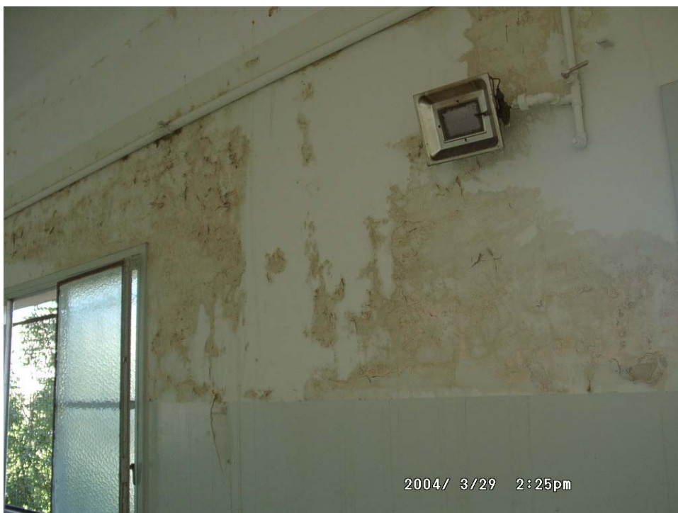
Sector de espera/Humedad en paredes y techos
