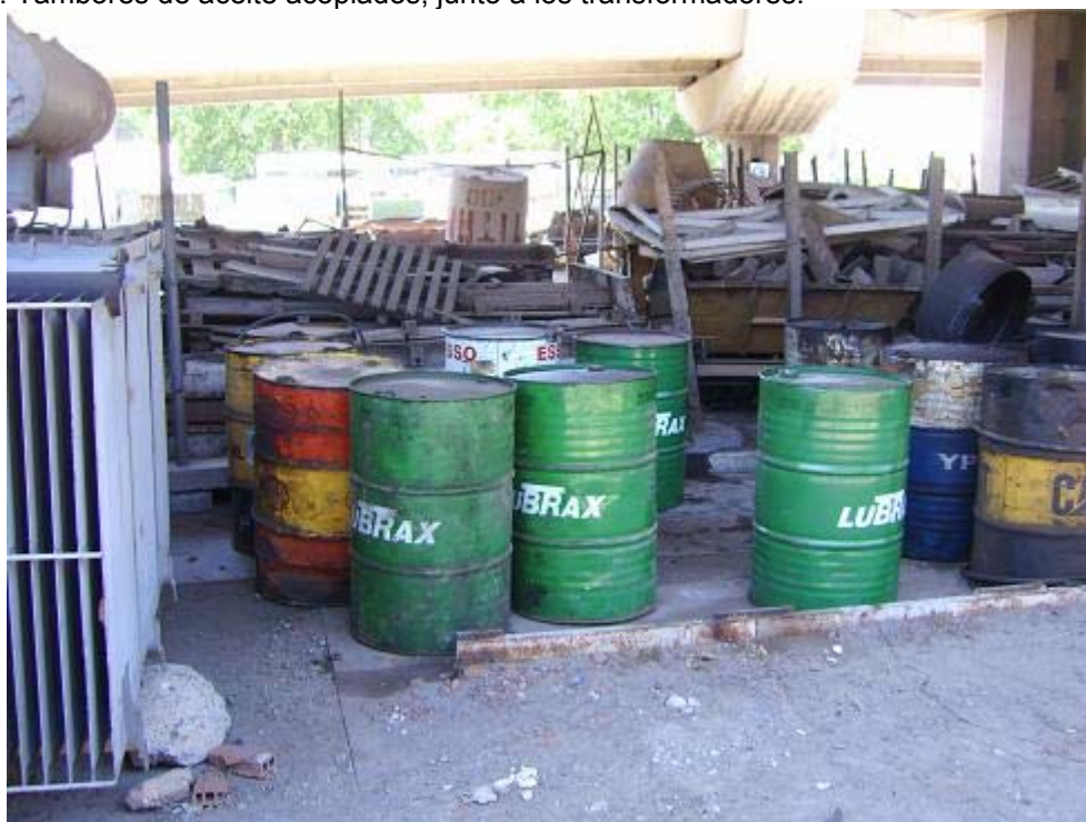
Foto 16. Tambores de aceite acopiados, junto a los transformadores.
