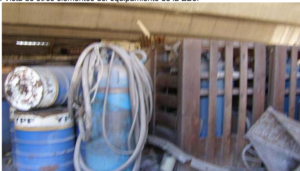
Foto 15. Vista de otros elementos del equipamiento de la EB5.
