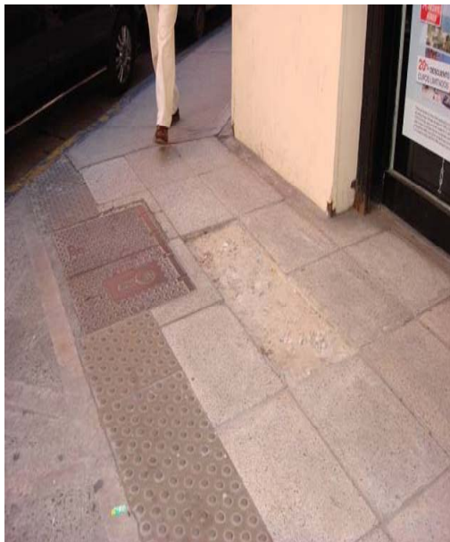
Foto 7 (17) – Acera con faltante de baldosón y hundimiento - Reclamo en trámite pendiente
