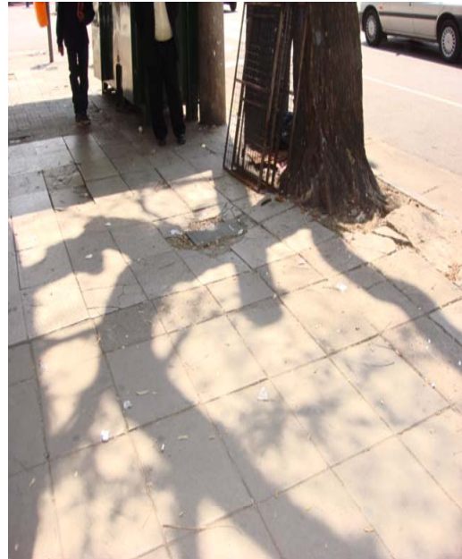
Foto N° 10 (20) – Acera afectada por raíces, con hundimiento y piezas faltantes - Reclamo en trámite pendiente
