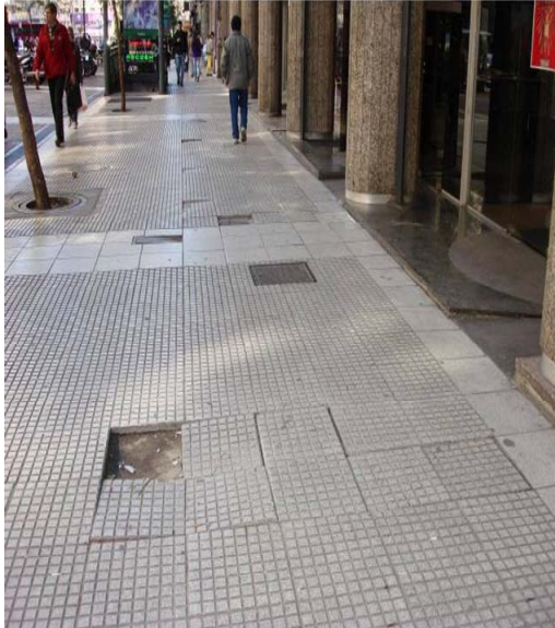
Foto N° 1 (23) – Acera con hundimiento, baldosas faltantes y sueltas - Reclamo en trámite pendiente
