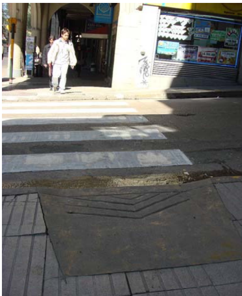
Foto N° A15 (73) – Rampa faltante en la vereda de enfrente y cuneta deteriorada que impide su normal uso - Reclamo en trámite pendiente
