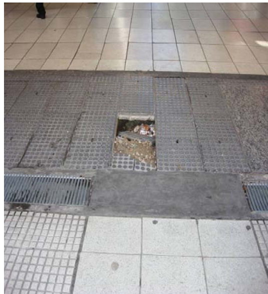
Foto N° 4 (15) – Acera con hundimiento y baldosas faltantes - Reclamo en trámite pendiente
