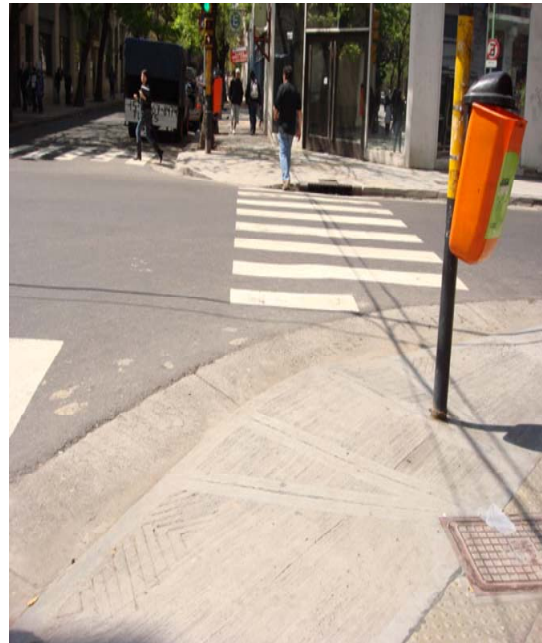
Foto N° 14 (13) – Rampa construida en forma antirreglamentaria respecto de la Ley N° 962
