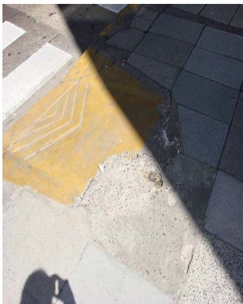
Foto N° 11 (2) – Rampa premoldeada deteriorada y antirreglamentaria- Reclamo en trámite pendiente
