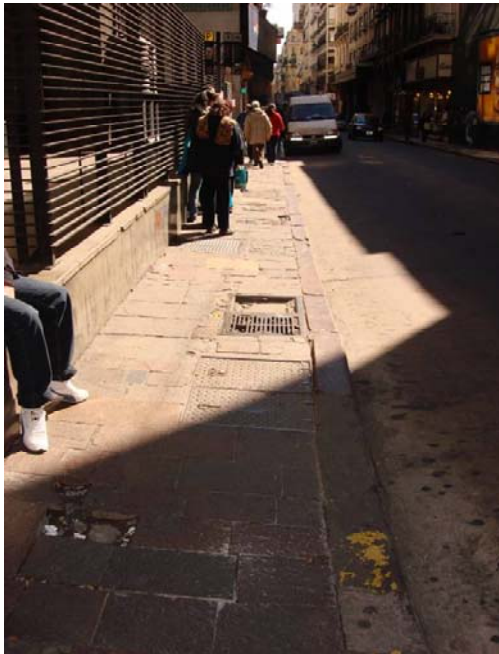
Foto N° 5 (39) – Acera con baldosas faltantes y ausencia de tapa de servicios - Reclamo en trámite pendiente
