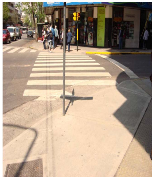
Foto N° 16 (37) – Rampa construida en forma antirreglamentaria respecto de la Ley N° 962
