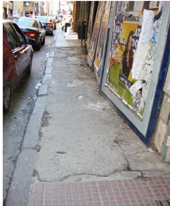
Foto N° 6 (38) – Acera deficientemente reparada - Reclamo en trámite pendiente
