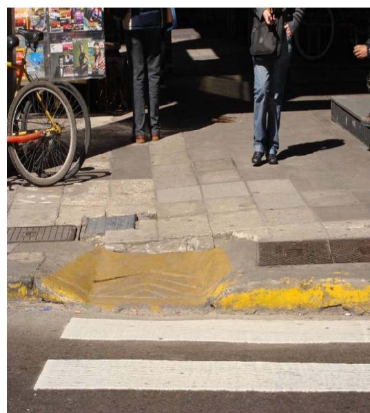
Foto N° 8 (2) – Rampa antirreglamentaria y deteriorada - Reclamo en trámite pendiente
