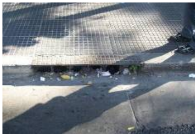
Foto N° 3.5 Av. Rivadavia 6909 (Inexistencia de reja horizontal y tapa de inspección)
