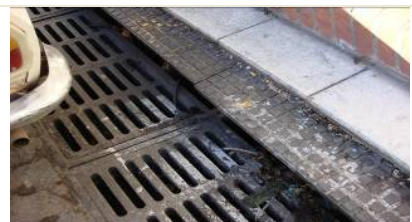
Foto N° 1.13 Sumidero Av. Libertador 4918
