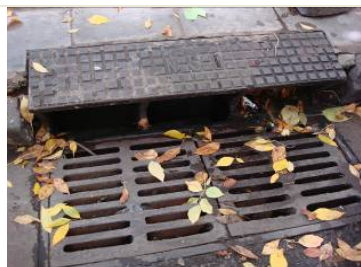
Foto N° 1.23 Sumidero Av. F. Lacroze 1910
