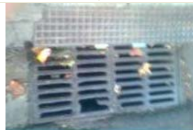
Foto N° 1.54 Sumidero Cabildo 505 – Fecha 05/05/2011 - Se mantiene la anomalía
