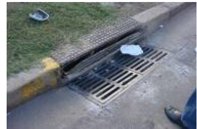
Foto N° 2.18 San Martín 4102 (Reja vertical dañada)
