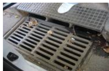
Foto N° 2.12 San Martín N° 4843 (Reja horizontal problema de medida)
