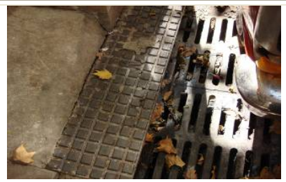
Foto N° 1.28 Sumidero T. García 1909
