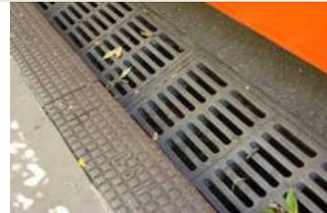
Foto N° 1.49 Sumidero Av. F. Lacroze 1906
