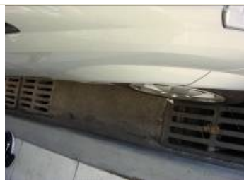
Foto N° 1.51 Sumidero Av. Libertador 4802
