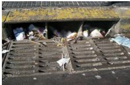
Foto N° 3.8 Av. Rivadavia 7308 (Suciedad en el sumidero)
