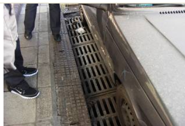
Foto N° 1.15 Sumidero Av. Libertador 4818
