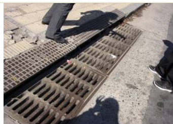
Foto N° 1.21 Sumidero Av. F. Lacroze 2510
