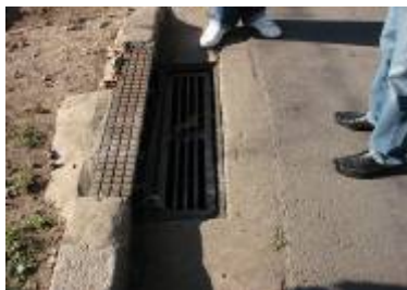
Foto N° 2.4 Zamundio N° 3252 (Reja horizontal casera)
