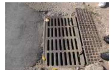
Foto N° 2.15 Constituyentes N° 3497 (aro de seguridad desoldado)
