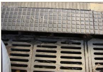
Foto N° 1.14 Sumidero Av. Libertador 4894
