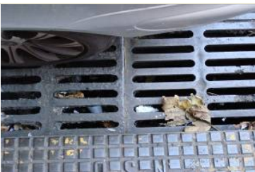
Foto N° 1.20 Sumidero C. de la Paz 693
