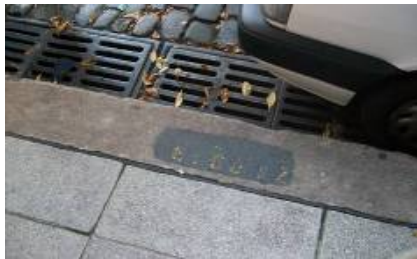
Foto N° 3.1 Terrada 490 (Número y zona ilegible del sumidero)-
