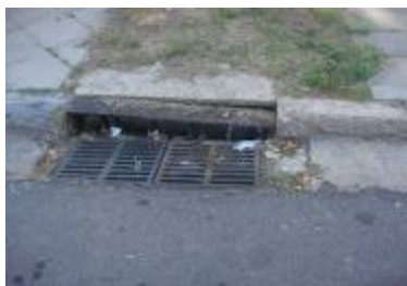
Foto N° 2.7 Gral. Artigas N° 3200 (reja vertical caída)
