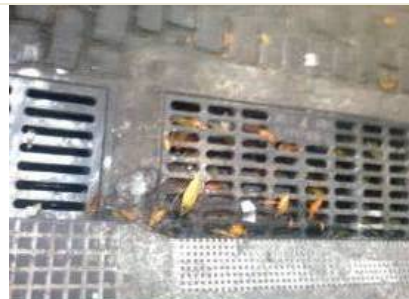
Foto N° 1.46 Sumidero Olleros 2411 – Fecha 05/05/2011 Se mantiene la anomalía
