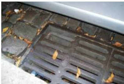
Foto N° 3.6 Terrada 490 (Reja rota)
