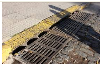
Foto N° 1.12 Sumidero Av. Libertador 4980
