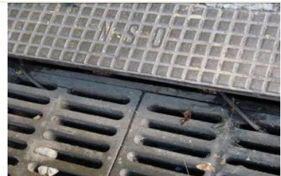
Foto N° 1.19 Sumidero Av. F. Lacroze 2448
