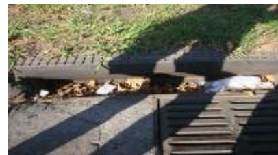
Foto N° 2.30 Calle Chorroarín esq. Warnes (Acera Rota)
