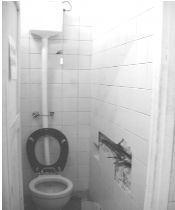
Foto N° 13 – Vista del interior de una de las cabinas del baño de caballeros con el inodoro descentrado donde se puede observar la pared rota con las cañerías
