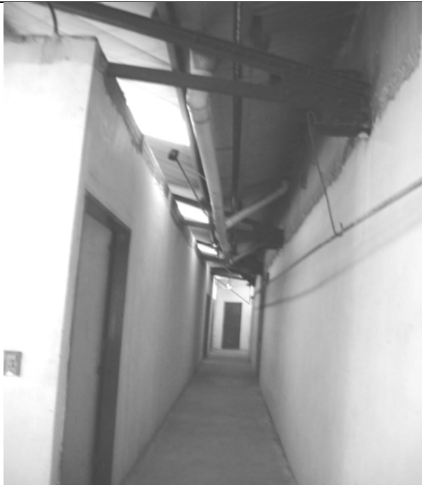
Foto N° 38 – En la presente vista se puede observar en la planta alta un pasillo junto a la medianera, donde se observa: falta de pintura en todas las paredes, ventanas sin colocar y detalles de albañilería sin terminar.
