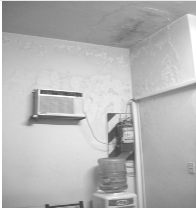
Foto N° 18 – En un local de PB se puede observar humedad en las paredes y el techo en este sector hay un equipo de AA split del que sale un cable que esta alimentado por un toma externo de electricidad que pasa sobre un matafuego tipo ABC (con la carga vigente) apoyado sobre la chapa reglamentaria.
