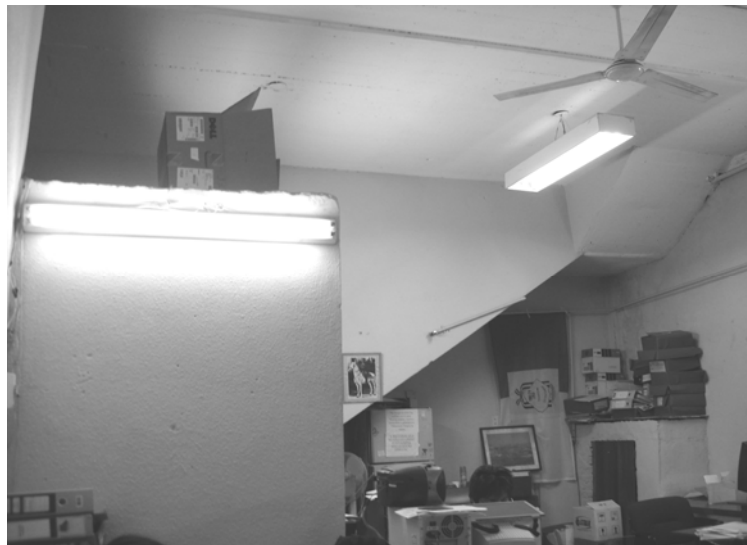
Foto N° 21 – En un local de PB se puede observar sobre la pared izquierda una llave de corte de electricidad exterior alimentada por cables de electricidad expuestos y encintados y un tubo fluorescente, este tubo esta aplicado sobre una pared detrás de la cual hay un local sanitario de damas que ventila al espacio cubierto del acceso vehicular, en este lugar anteriormente habría una ventana.
