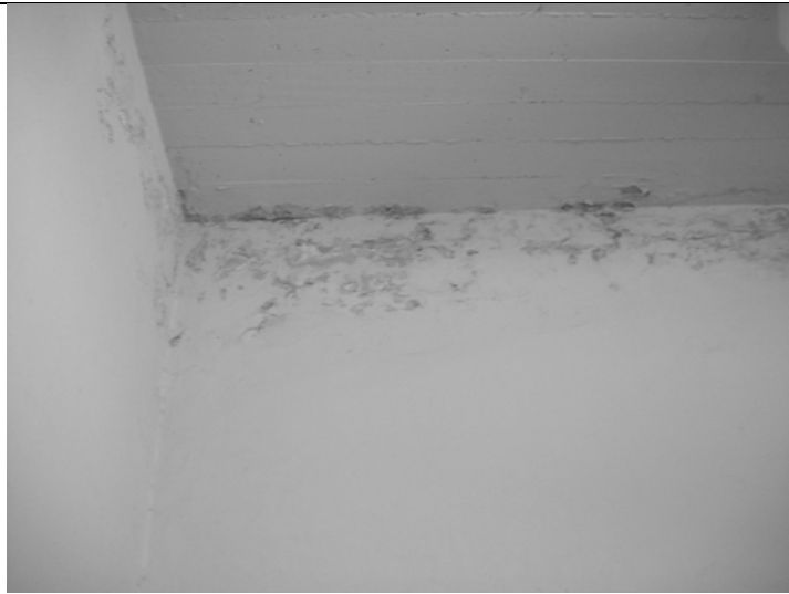
Foto N° 20 – En un local de PB se puede observar humedad en las paredes y el techo.
