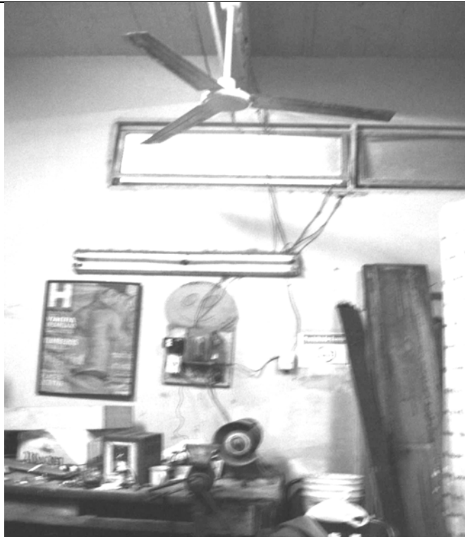
Foto N° 33 – En la presente vista se puede observar en el taller de armas sobre la pared varios tomas y llaves de corte de electricidad montados sobre una madera con la presencia de cables expuestos y encintados.
