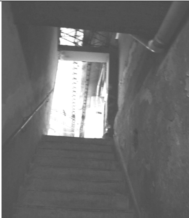
Foto N° 49 – En la presente foto se puede ver la escalera que viene de la planta alta con muestras de humedad en las paredes y los revoques destruidos.
