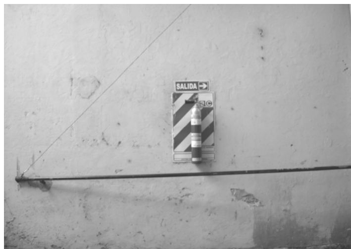
Foto N° 9 – Vista de la pared medianera cerca del acceso de vehículos con el revoque en mal estado y falto de pintura, en la misma hay colocado un matafuego tipo BC sobre la chapa reglamentaria.
