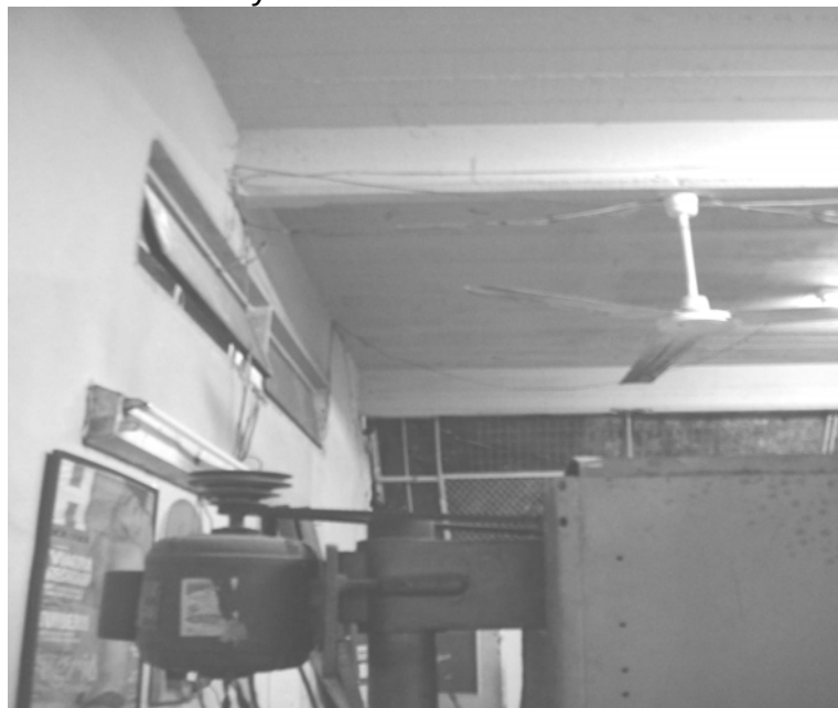
Foto N° 36 – En la presente vista se puede observar en el taller de armas en la parte superior de la pared de la izquierda dos ventilucos y varios cables de
