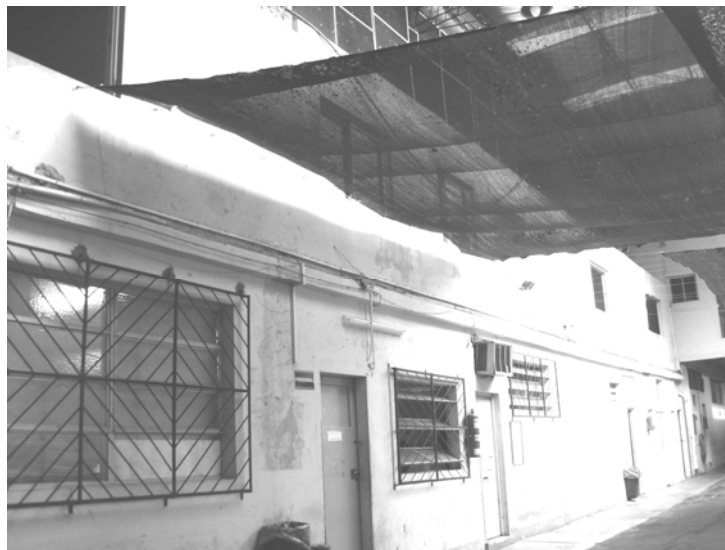
Foto N° 7 – Vista de la pared izquierda de el acceso de vehículos, donde podemos observar a tres mts de altura la presencia de cables expuestos encintados, un matafuego tipo ABC con la carga vigente y un tubo de la luz de emergencia.
