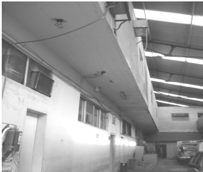
Foto N° 16 – Vista desde el interior del acceso de vehículos en la parte del fondo, donde se observan materiales de construcción y elementos en desuso en el piso y donde podemos observar que todo este sector tiene una cubierta superior con estructura de cabriadas de perfiles metálicos y chapas galvanizadas lo que
