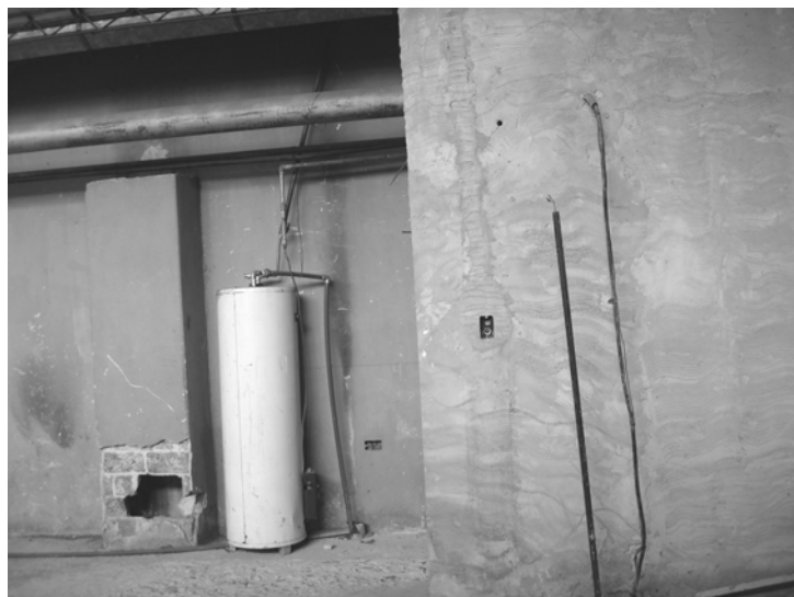
Foto N° 50 – En la presente foto se puede ver en la planta alta un termo para agua caliente instalado en forma provisoria junto al ducto de un elevador anulado con un orificio en la base. Todo este sector no tiene terminaciones en las paredes y el piso, a la derecha se observan cables de electricidad expuestos que salen de un caño y al lado otro conductor eléctrico corre unido a otro cable (es de notar que en este piso hay gente que trabaja en una oficina terminada y pasa por este sector al entrar y salir).
