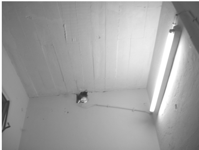
Foto N° 23 – Tubo de iluminación fluorescente alimentado por cables de electricidad expuestos que vienen de otro local a través de un orificio en la pared.
