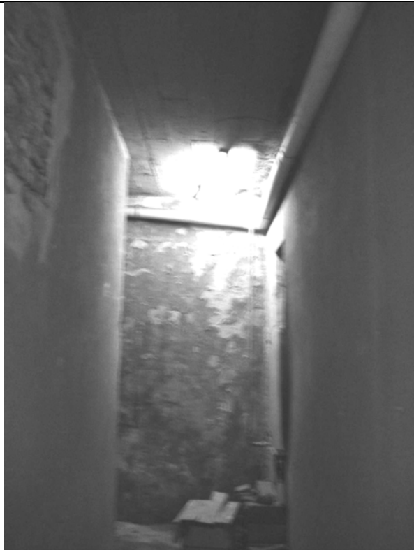
Foto N° 48 – En la presente foto se puede ver en el pasillo antes de la escalera de acceso a la planta alta, las paredes junto a la medianera con revoques destruidos con signos de humedad y materiales tirados en el piso.
