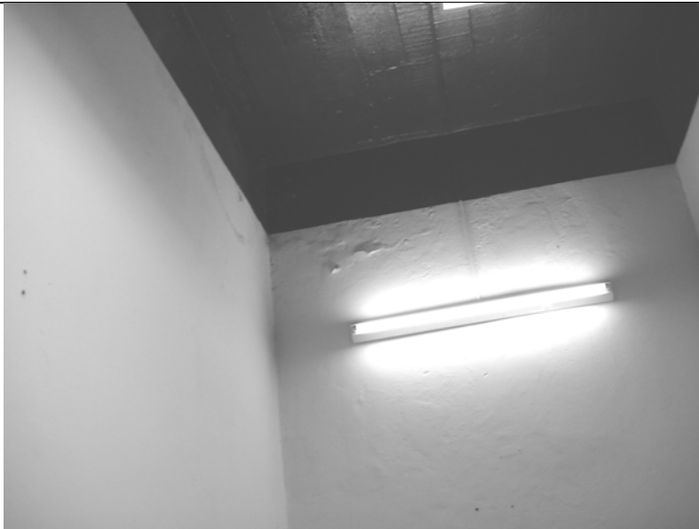
Foto N° 24 – Tubo de iluminación fluorescente instalada sobre una pared con signos de humedad en el revoque. Es de notar que todos estos locales están iluminados en forma artificial.
