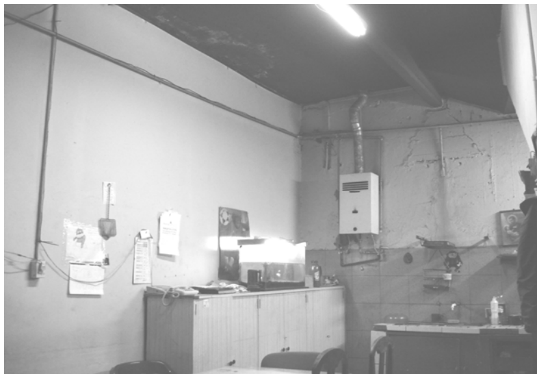
Foto N° 34 – En la presente vista se puede observar en el taller de armas en la pared a la izquierda un toma de electricidad exterior del cual salen dos cables de electricidad expuestos y en la parte superior otro cable que cuelga y baja unido al
