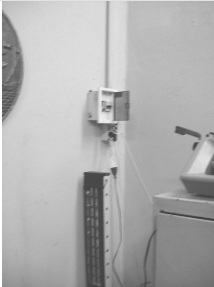
Foto N° 29 – Dentro del local depósito y taller de armas podemos observar una llave de corte térmica instalada en una caja exterior de la que salen cables de electricidad expuestos.
