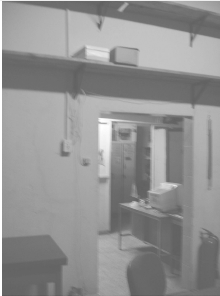
Foto N° 26 – Estantería de madera dentro del depósito de ropa para el personal, por debajo pasan adheridos a la pared cables de electricidad expuestos y encintados que alimentan a un toma y una llave de corte, en un rincón apoyado en el suelo un matafuego tipo ABC con la carga vigente.
