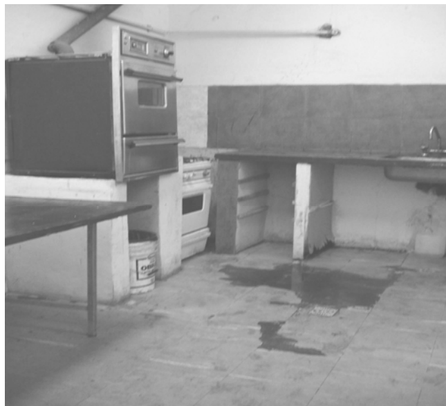
Foto N° 19 – En un local de cocina se puede observar el solado con el revestimiento roto, falta la campana con ventilación forzada al exterior (este ambiente ventila e ilumina al espacio cubierto del acceso vehicular).
