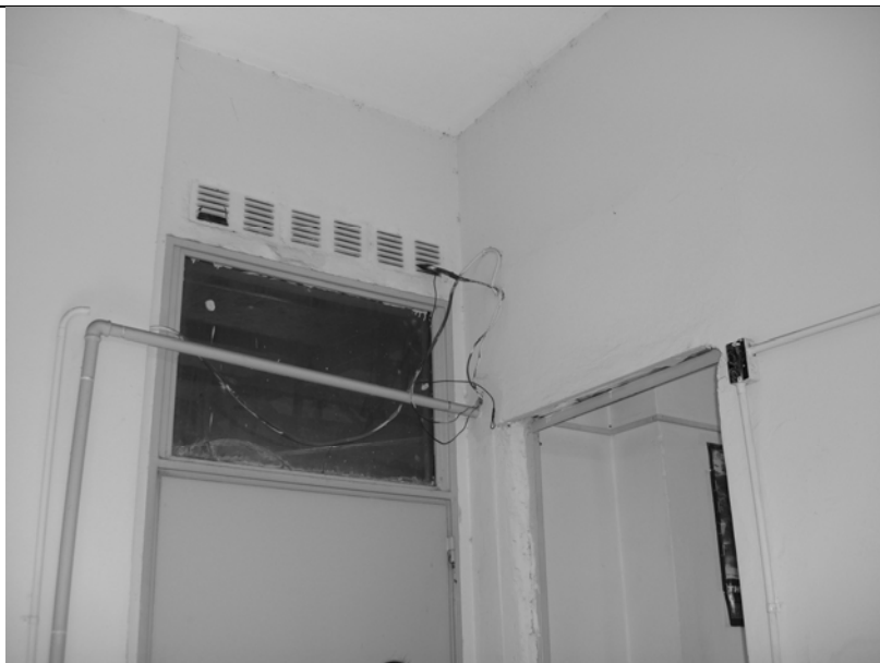
Foto N° 35 – En la presente vista se pueden observar cables expuestos y encintados que pasan de un ambiente a otro por un orificio en la pared y una caja de distribución sin tapa y con los cables expuestos.
