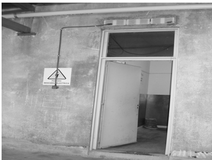
Foto N° 40 – En la presente vista se pueden observar en el nivel sobre primer piso la terraza cubierta con un tinglado, en la parte superior de la puerta de acceso al mismo se observa un caño corrugado de electricidad que pasa al interior por la ventilación y ya en el interior sigue el cable de electricidad expuesto colgando.
