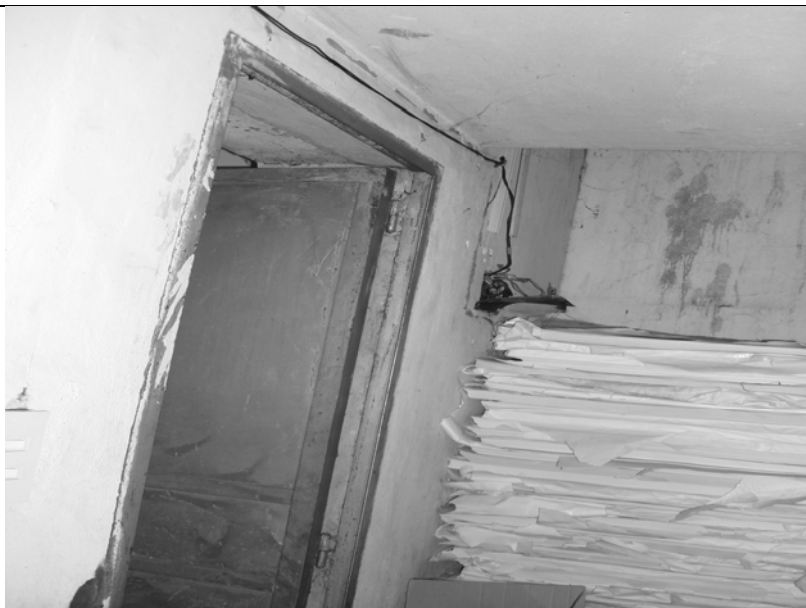
Foto N° 19 – En la presente vista se puede apreciar en el sótano en una pared y sobre una pila de resmas de papel, un centro de electricidad con la tapa abierta y del mismo salen varios cables expuestos y encintados dos de los cuales se desplazan adheridos a la pared con grasas.
