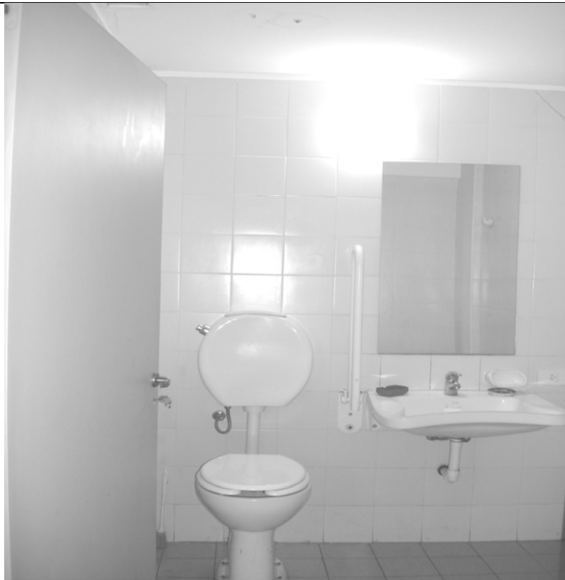
Foto N° 25 – En la presente vista se puede observar el interior del baño para discapacitados, es denotar que en la puerta del mismo no figura el tipo de local "baño para discapacitados" .
