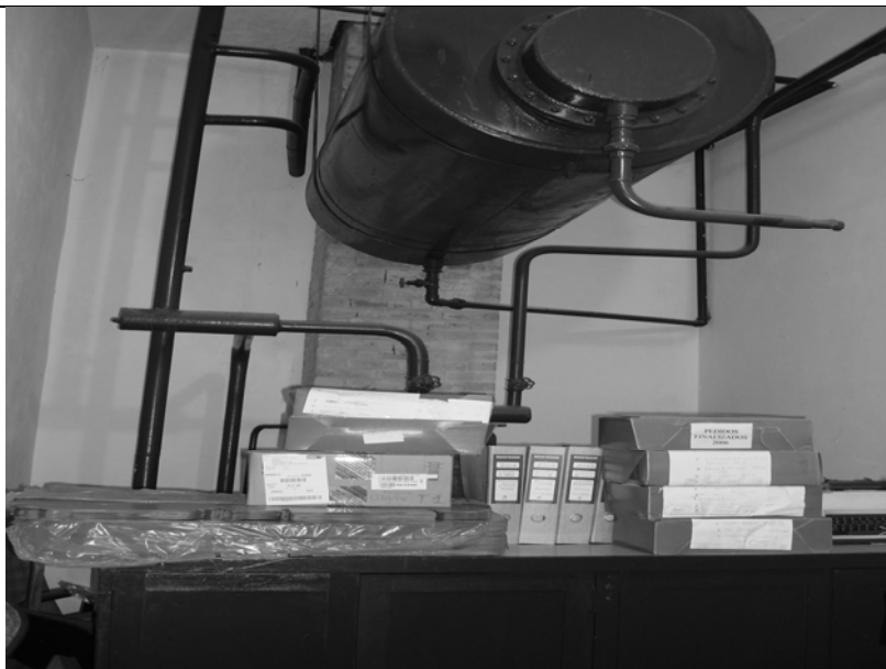
Foto N° 23 – En la presente vista se puede apreciar un lugar usado como depósito que anteriormente era la sala de calderas (la misma esta detrás de esta pila de biblioratos y cartones) en la parte superior se puede apreciar el tanque intermediario con toda la cañería como si estuviera en funcionamiento.
