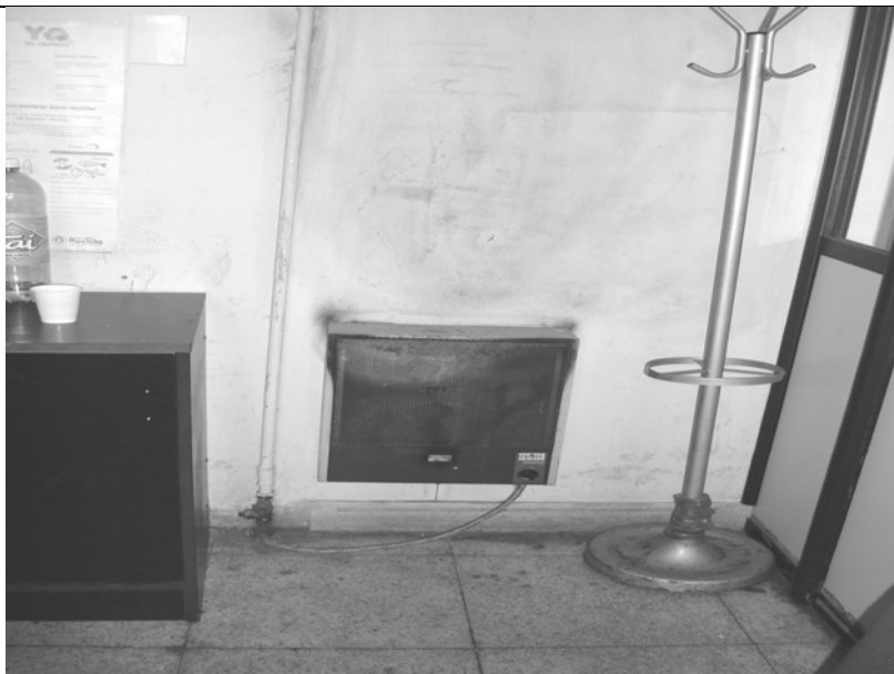
Foto N° 27 – En la presente vista se puede observar una estufa sin tiro balanceado que tiene la conexión del gas con un caño flexible no autorizado.
