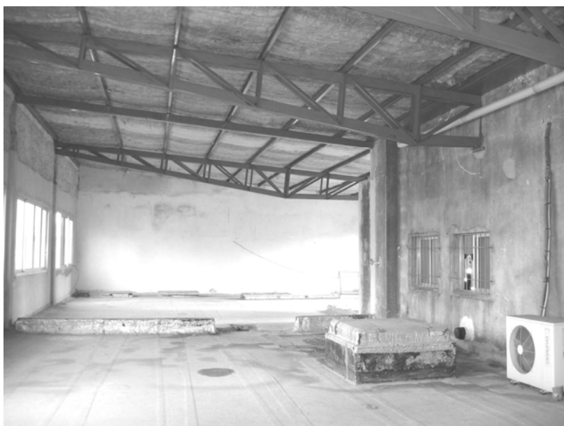
Foto N° 38 – En la presente vista se pueden observar en el nivel sobre primer piso la terraza cubierta con un tinglado de estructura de hierro, el mismo presenta el aspecto de una obra sin terminar con problemas de proyecto como la ubicación de las ventanas, ventilaciones de estufas, equipos de aire acondicionado, etc. que debieran dar al exterior y que dan a este ambiente.
