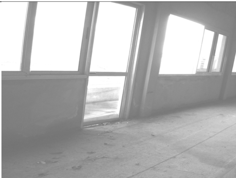
Foto N° 37 – En la presente vista se pueden observar en el nivel sobre primer piso en la terraza cubierta con un tinglado detalles del solado y una pared con carpintería de aluminio que da al exterior, es de notar que la puerta no puede abrir pues el contrapiso exterior es mas alto que el interior y la puerta choca contra el mismo.
