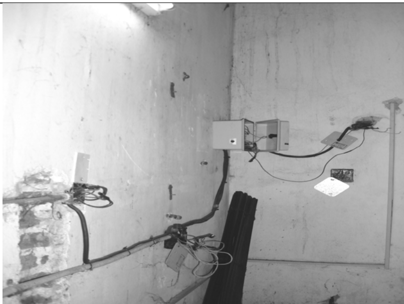
Foto N° 21 – En la presente vista se puede apreciar en una pared del sótano cables que salen expuestos y encintados de centros de electricidad y otros salen de un tablero seccional exterior y pasan a otro ambiente a través de la pared.
