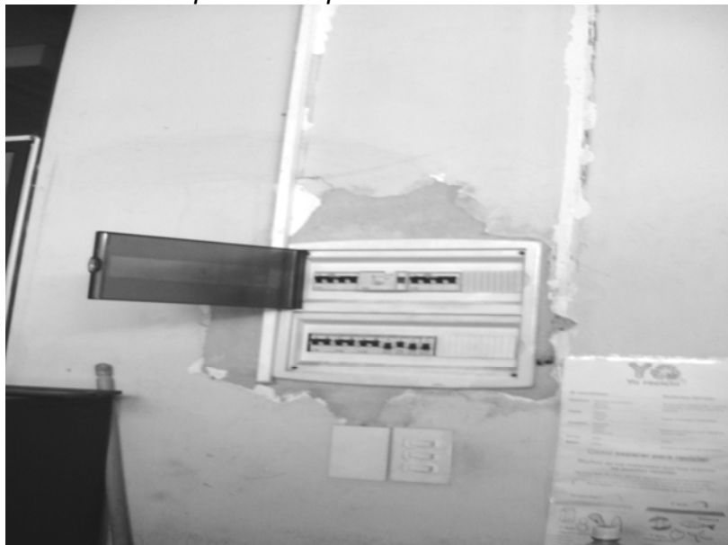
Foto N° 26 – En la presente vista se puede observar un tablero de electricidad seccional con llaves térmicas de corte y una llave de corte "diferencial".
