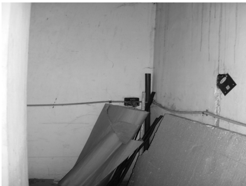
Foto N° 22 – En la presente vista se puede apreciar en una pared del sótano cables que salen expuestos y encintados de un centro de electricidad, debajo de la misma se puede apreciar un rollo de cartón otros elementos, sobre la pared de la derecha un centro de derivación eléctrica con la tapa corrida dejando expuestos los cables de electricidad.
