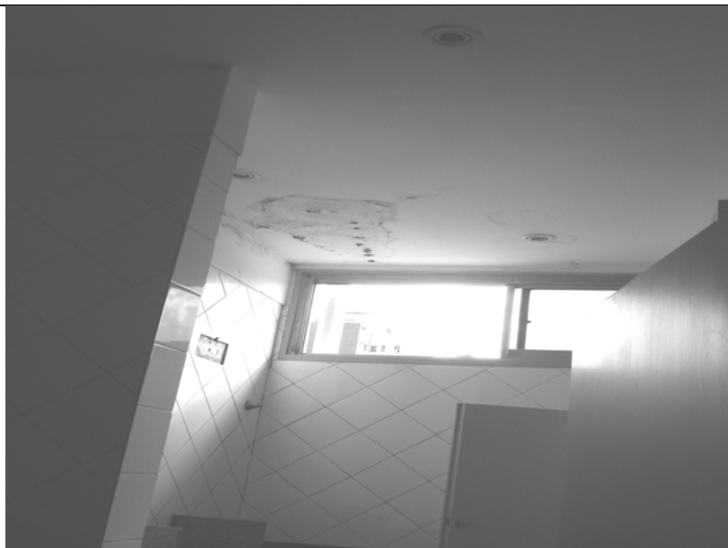
Foto N° 31 – En la presente vista se puede observar en un sanitario con el cielorraso deteriorado con huellas de humedad por filtraciones de agua.
