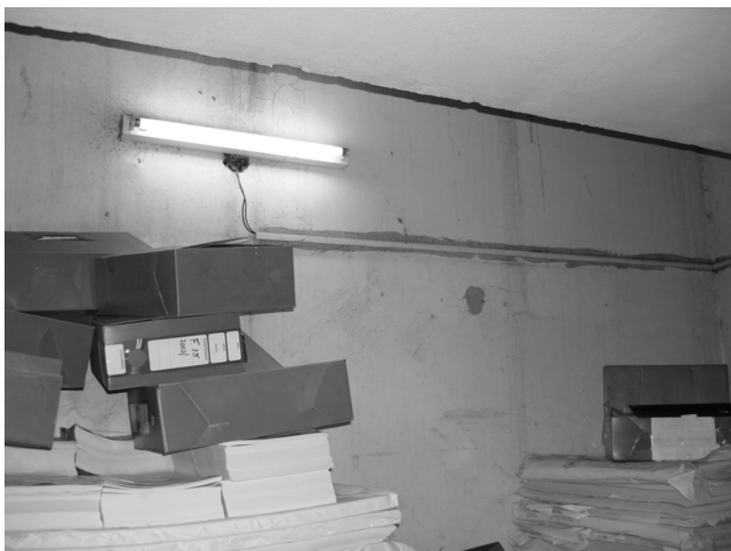
Foto N° 20 – En la presente vista se puede apreciar en el sótano en una pared y sobre una pila de resmas de papel, un centro de electricidad con la tapa abierta del cual salen varios cables expuestos y encintados dos de los cuales se desplazan por la pared y entran en un cable canal de plástico.
