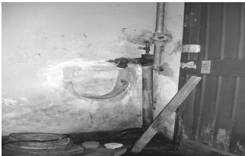
Foto N° 11 – En la presente vista se puede apreciar en un ángulo del interior del estacionamiento que da a un portón en una salida de vehículos anulada, un nicho en la pared donde debiera estar la manguera contra incendio, la misma esta en el suelo enroscada junto con elementos de demolición . En la parte superior se observan los caños de alimentación de agua a este sistema junto a la llave de paso sin el manijón de accionamiento de la misma. La pared presenta huellas de humedad provenientes de filtraciones de estos caños y en medio de estos elementos un cable de electricidad expuesto y encintado .
