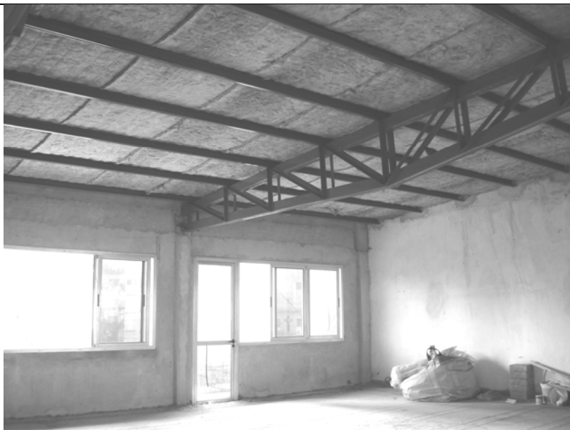
Foto N° 39 – En la presente vista se pueden observar en el nivel sobre primer piso la terraza cubierta con un tinglado de estructura de hierro, en la misma se puede observar esta obra realizada con un contrato, paralizada y a medio terminar.
