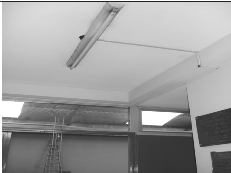
Foto N° 7 – En la presente vista se puede apreciar en primer plano un tubo de iluminación fluorescente sin ningún elemento de seguridad que impida la caída del mismo, al fondo a través de la puerta que accede al estacionamiento de vehículos se puede observar la estructura del tinglado.
