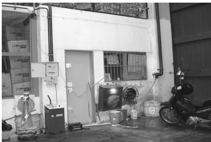
Foto N° 12 – En la presente vista se puede apreciar en un ángulo del interior del galpón posterior junto al estacionamiento, una zona con depósitos de elementos y en la pared del frente un tablero de electricidad con llaves térmicas y un disyuntor de corte para seguridad, por detrás corre un cable de electricidad expuesto, al costado de la puerta una cabina del sistema contra incendio descolgada de la pared con la manguera (sin la lanza) y al costado la llave de accionamiento de este sistema en la cual esta conectada una manguera fina (1/2") para lavar el piso o los camiones , entre estos elementos hay elementos de limpieza, una batería, un cargador de baterías, baldes, etc.
