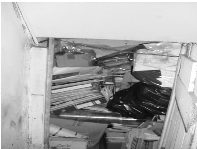
Foto N° 24 – En la presente vista de un sector del sótano se puede apreciar un depósito de elementos de escritorio donde hay documentación y en la parte superior de este recinto se observa la presencia de un cable de electricidad expuesto .
