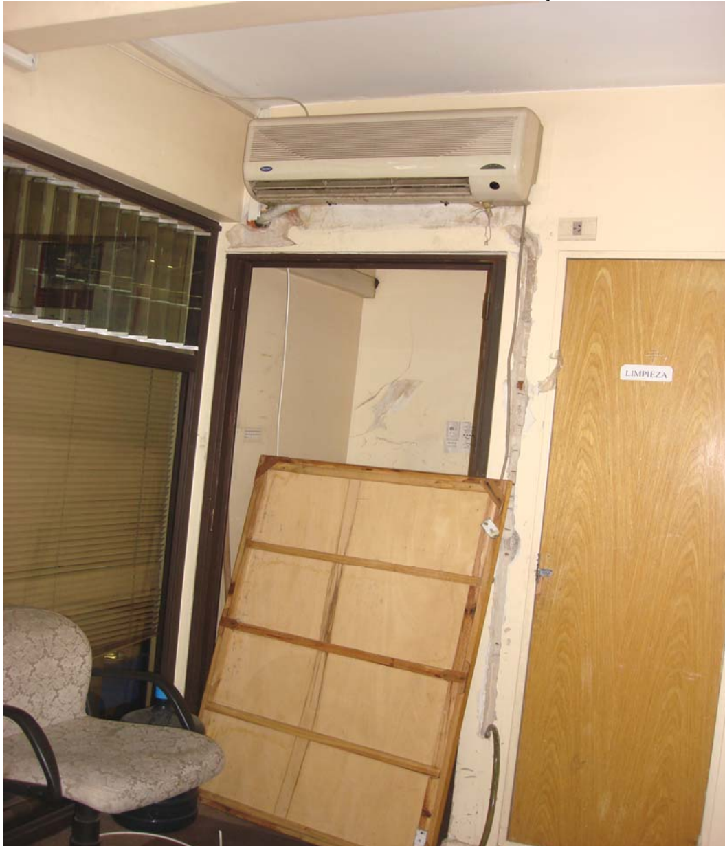
Foto N° 6 _ La presente vista muestra en un espacio común, un sector deteriorado, donde observamos tanto la pared sin puerta (detrás de ésta un espacio donde se almacenan bidones de agua) deteriorada y la superficie con canaletas abiertas y cables expuestos.
