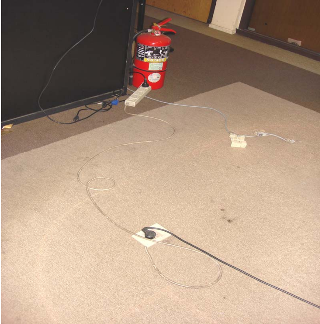
Foto N° 4 _ La presente vista del espacio común frente a las oficinas muestra un matafuegos apoyado en el piso fuera del lugar reglamentario y tomas de piso del que sale un cable que alimenta una “zapatilla” con tomas múltiples y cerca de este toma, cables expuestos que salen de dos orificios en el piso.
