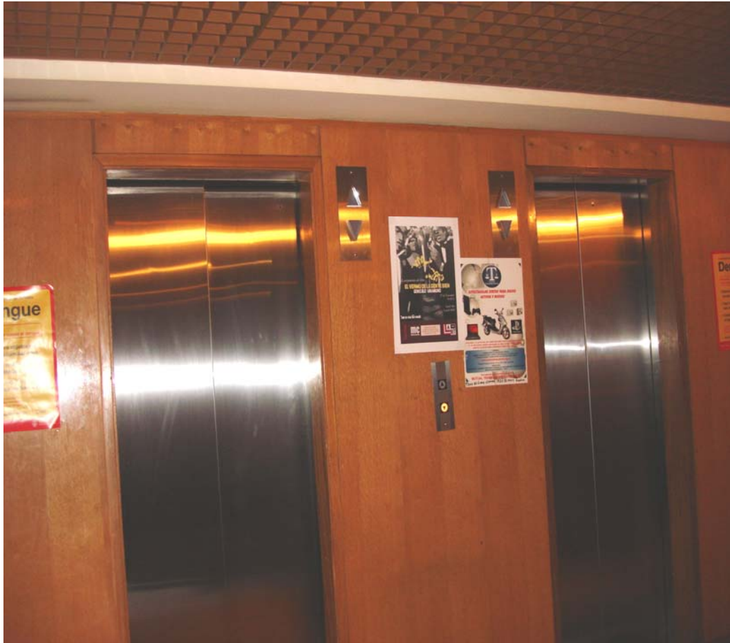
Foto N° 1 – En la presente vista se puede observar el palier del 8° piso, donde no se ven fijados a la pared los planos de evacuación.
