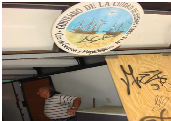
FOTO N° 4 PUERTA DE ENTRADA DE VIDRIO ROTA ESCUDO DEL CGP N° 13
