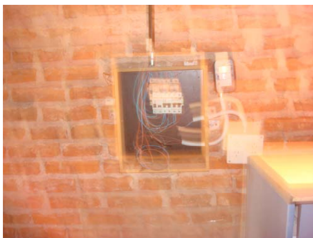
FOTO N° 14 TABLERO SIN PROTECCIÓN FALTA DE CABLE A TIERRA CABLES EXPUESTOS SIN TAPA PROTECTORA
