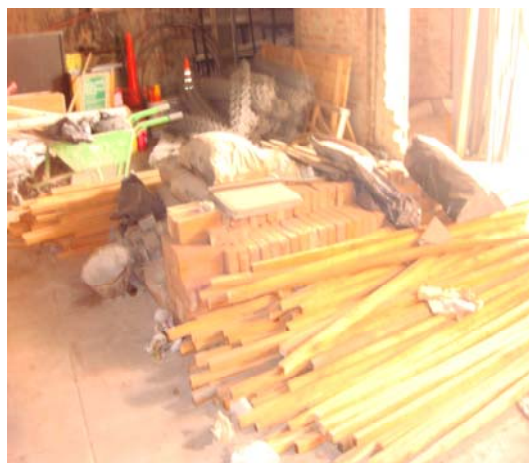
FOTO N° 11-CANTIDAD DE MATERIAL EN EL PISO FALTA DE TARIMAS DISTRIBUCIÓN DE MATERIAL ORDEN Y LIMPIEZA LUZ NATURAL COMO ARTIFICIAL, BAÑO SIN TERMINAR.
