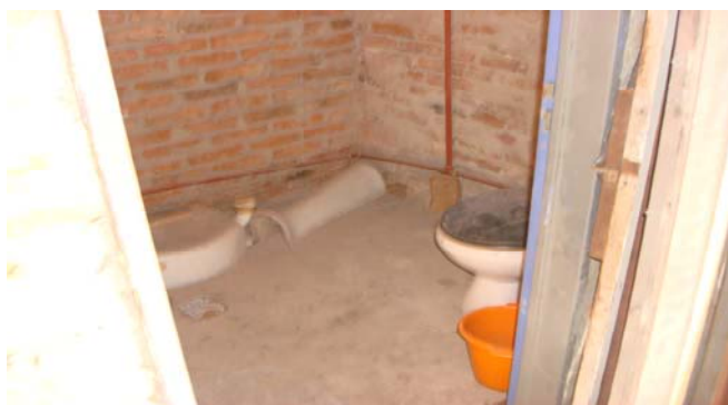
FOTO N° 15 FALTA EN BAÑO TERMINACIÓN, INSTALACIÓN Y LIMPIEZA
