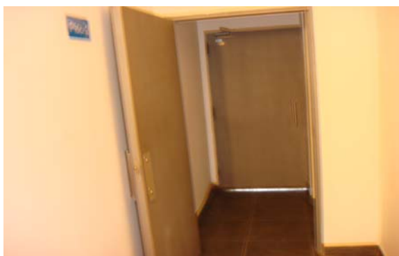
FOTO N° 17 FALTA DE SEÑALÉTICA EN PUERTAS Y PAREDES .
