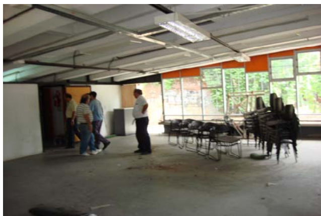
FOTO N° 7. MUESTRA DE PENDIENTE DE TECHO SEGÚN LAS OFICINAS EL ESPACIO DONDE SE DESEMPEÑABAN DICHAS OFICINAS MALA DISTRIBUCIÓN LUMÍNICA.
