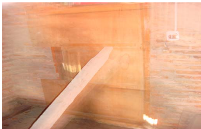
FOTO N° 13 TRABA DE SEGURIDAD DE PUERTA, INSTALACIÓN DE LLAVE DE LUZ SIN TAPA, PARED SIN REVOQUE
