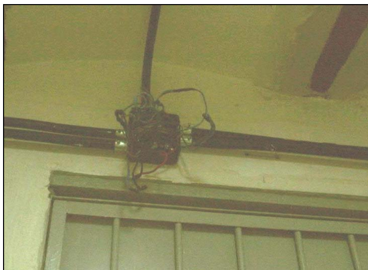
Vista de los cables a la vista, en la instalación recientemente ejecutada en el sector de Sala de Profesores.
