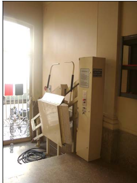
Vista del montaescalera instalado en el acceso del establecimiento para salvar un desnivel de aproximadamente de 0,70m.
