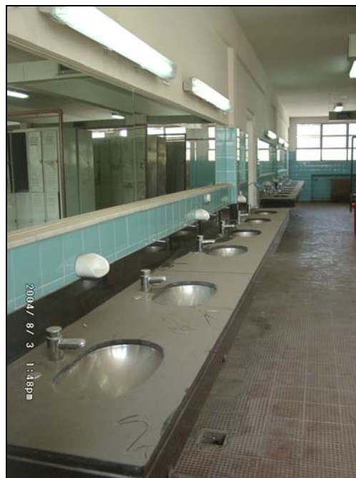
Vista de los sanitarios de damas inhabilitados por falta de mantenimiento y de personal.
