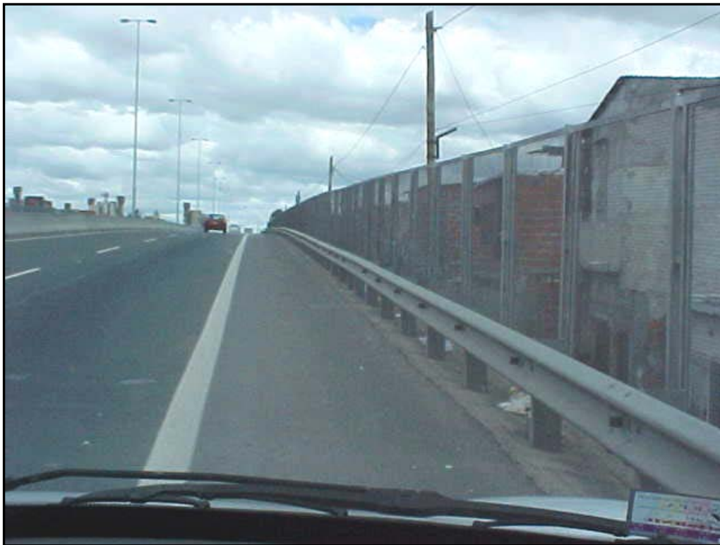
18/11/04. Banda B. Rampa de elevación. Intrusión de viviendas en la Franja No Edificable. Rejas de Protección
