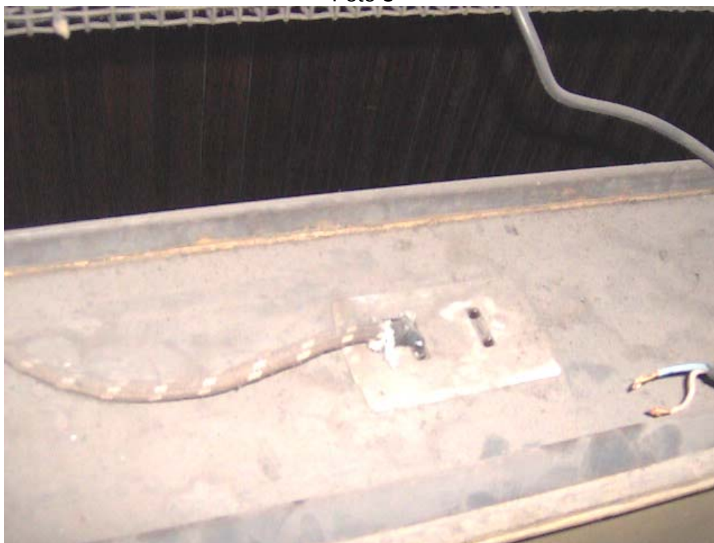
Ver “Debilidades” N° 37. Se ve claramente el tipo de cable y la condiciones en que se encuentra la instalación.
