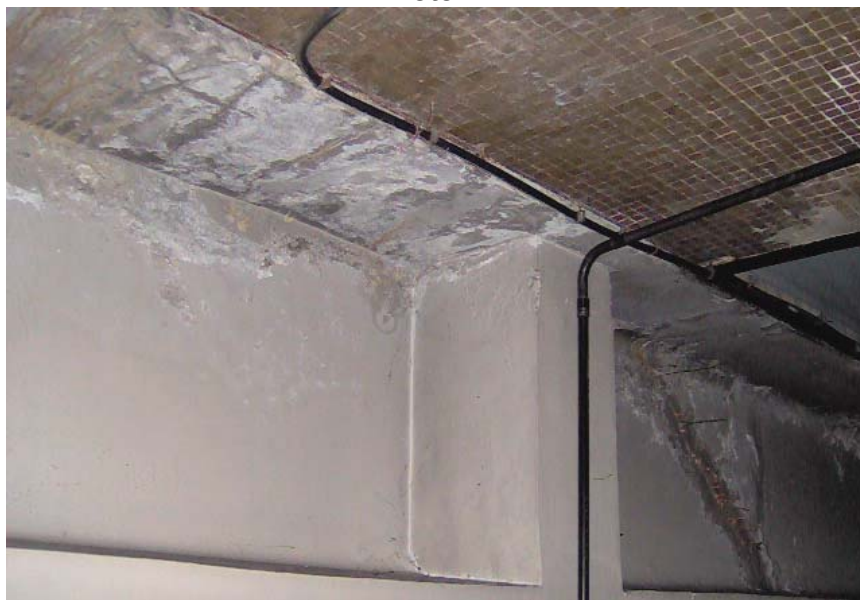
Ver "Debilidades" N° 47 a). Filtraciones en la losa
