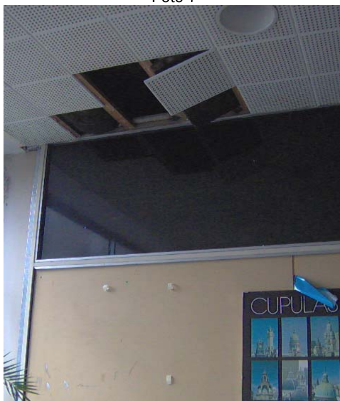
Ver “Debilidades” N° 48. Bloques del cielorraso
