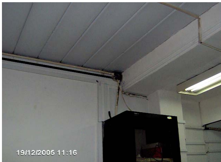
Cables expuestos en caja de distribución abierta
