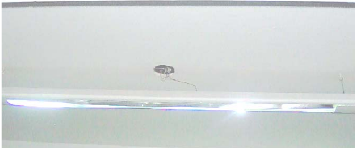
Foto N°12: Se observan cables expuestos que salen de una boca y alimentan un artefacto de iluminación
