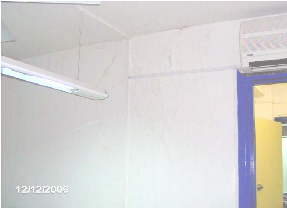
Foto N° 8 – En una pared de la oficina de Mantenimiento Barrial se observan los efectos de una filtración de un tanque de agua del piso superior.
