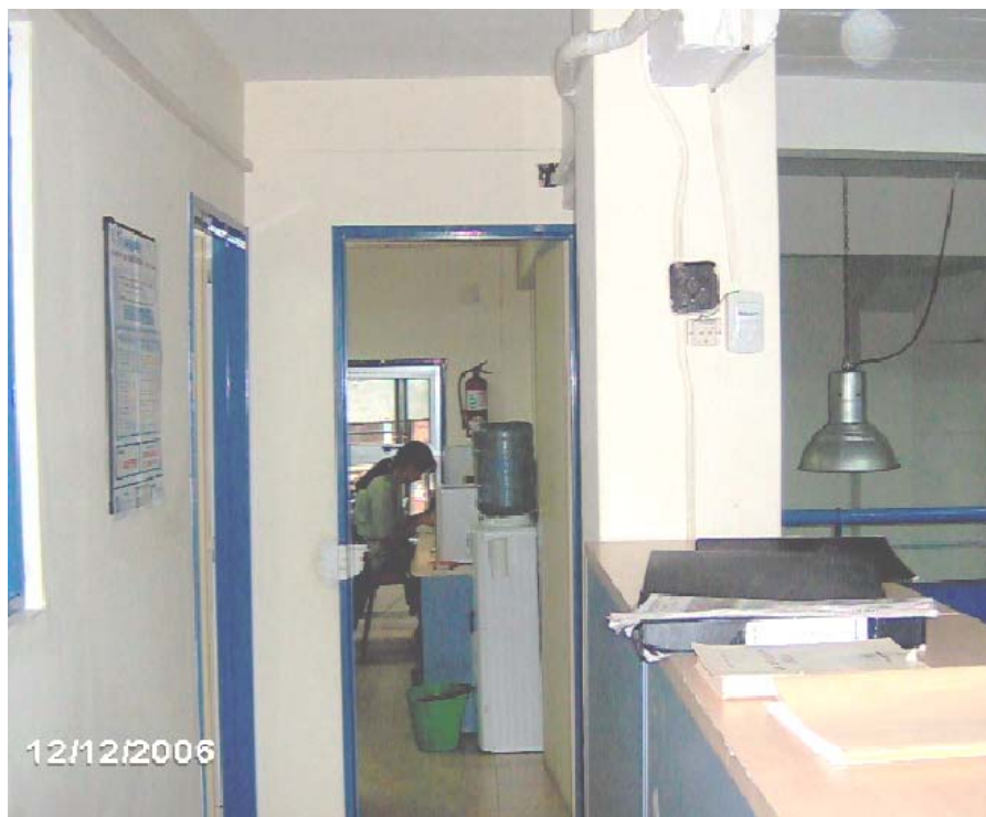
Foto N° 9 –Acceso a la oficina de la directora administrativa. A la derecha un mostrador y detrás de este la baranda que balconea a la PB. Sobre el mostrador se observa una caja de derivación eléctrica embutida y sin tapa, que presenta conductores expuestos.
