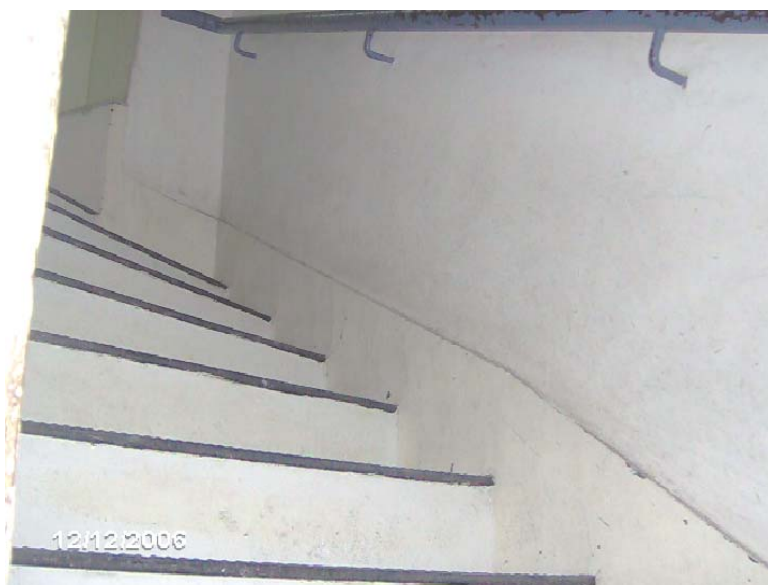
FOTO N° 10 – ESCALERA POR LA QUE SE ACCEDI DESDE PB AL ENTRESPISO, NO PRESENTA CONDICIONES PARA QUE ACCEDAN DISCAPACITADOS AL PISO SUPERIOR. ES ANGOSTA Y COMPENSADA.
