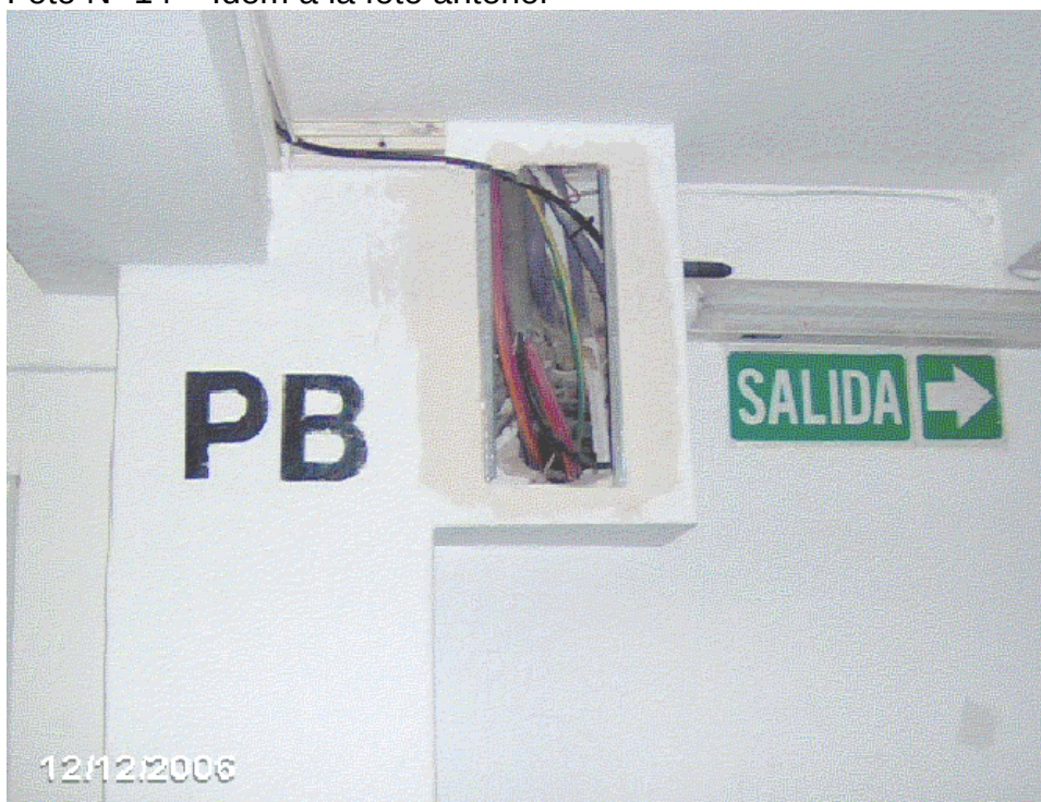
FOTO N° 15 – EN PLANTA BAJA, EN LA SALIDA DE VEHÍCULOS SOBRE BERUTTI SE PUEDE OBSERVAR UNA CAJA DE DERIVACIÓN ELÉCTRICA SIN TAPA CON CABLES EXPUESTOS.
