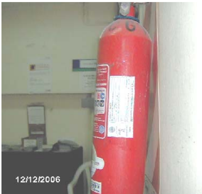
FOTO Nº 4 – MATAFUEGO TIPO, HAY VARIOS Y ESTÁN COLOCADOS EN SUS BASES, TIENEN FECHA DE VENCIMIENTO 24/08/07, ESTÁN COLOCADOS EN LUGARES ESTRATÉGICOS Y CUMPLEN CON UNO CADA 200 M2 COMO MARCA EL CE.
