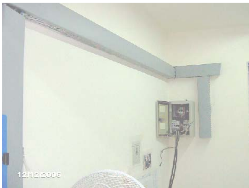
FOTO N° 5 – OFICINA DEL ASESOR PARA DISCAPACITADOS DEL CGP 2, MIDE 1,80 x 3,60 M., NO TIENE VENTANAS POR LO QUE LA VENTILACIÓN ES MALA Y SE SIENTE OLOR A HUMEDAD. SE OBSERVA UN TABLERO DE ELECTRICIDAD SECCIONAL CON CUATRO LLAVES TÉRMICAS Y UN DISYUNTOR ELÉCTRICO QUE PRESENTA CABLES EXPUESTOS Y ENCINTADOS QUE SALEN POR EL FRENTE DE LA CAJA .
