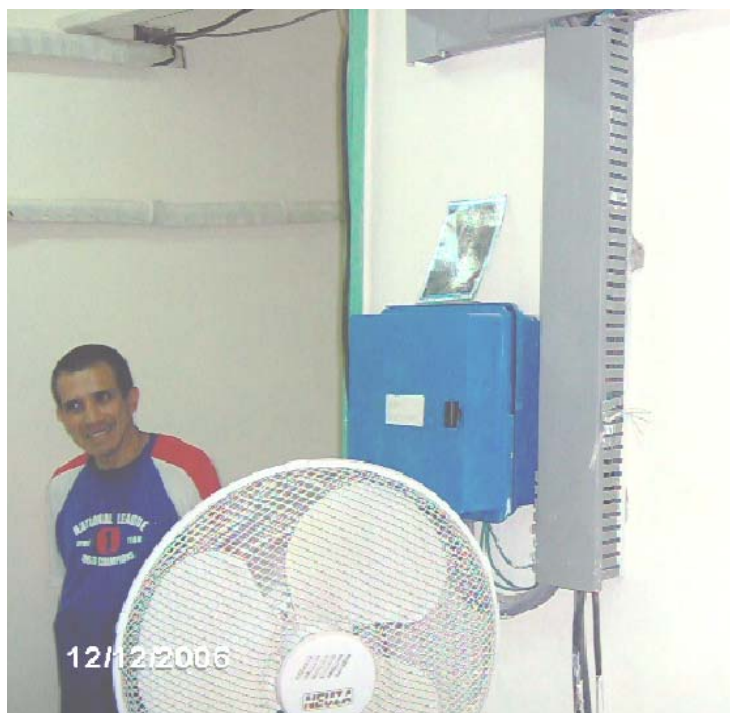
Foto N° 6 – Se observa un tablero de AA con cables expuestos en la salida del mismo y en el cielorraso alimentando un artefacto de iluminación .
