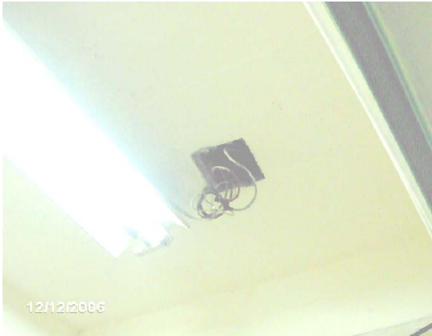
FOTO N° 7 – EN EL CIELORRASO DEL SECTOR DE MANTENIMIENTO BARRIAL SE OBSERVA UNA BOCA DE ELECTRICIDAD CON CABLES EXPUESTOS ENCINTADOS QUE ALIMENTAN UN ARTEFACTO DE ILUMINACIÓN.
