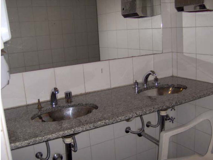
Foto N° 7. se observan las griferías de los lavatorios de los baños públicos de pb, falta de los pomos en las canillas. Estos elementos que faltan y otros desperfectos tanto en los sanitarios (falta de las tapas de los inodoros) como en la instalación eléctrica (cables expuestos, lámparas quemadas, etc) no se arreglan pues falta una persona que cubra el servicio de mantenimiento, en la práctica algunos arreglos los realizan empleados administrativos, que no es lo apropiado.
