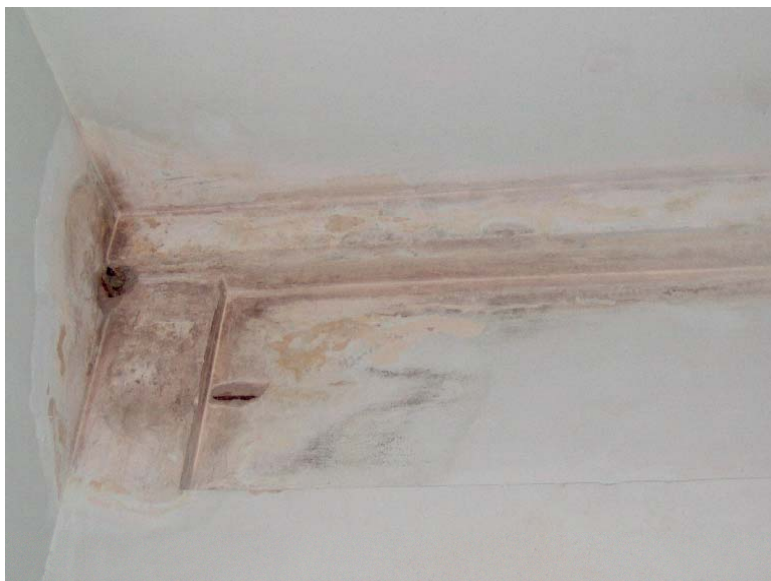
Foto N° 17 – Deterioro en una pared y cielorraso producida por humedad dentro de la vivienda.
