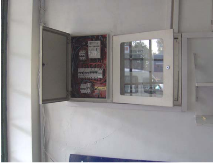
Foto N° 11. Tablero de electricidad principal en planta baja sin contratapa y con cables expuestos.
