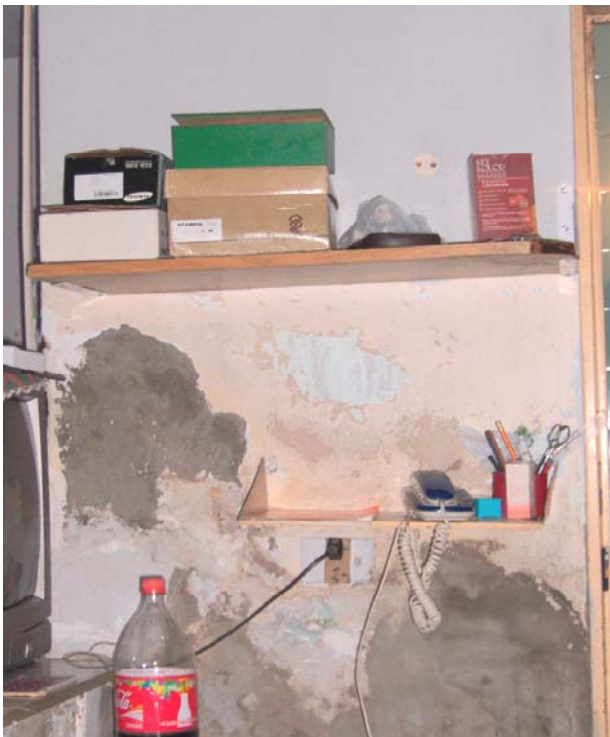
Foto N° 20 – Deterioro en una pared producida por humedad dentro de la vivienda en el segundo piso.
