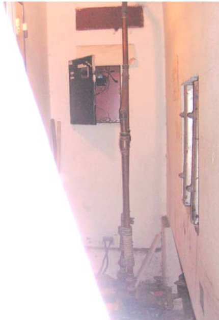
Foto n° 8. Tanque de bombeo y abajo las bombas de agua, en la parte superior podemos ver el tablero de la bomba con cables expuestos y sin sobretapa.
