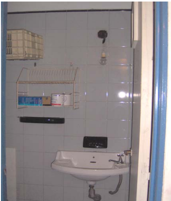
Foto N° 10. Baño de P.B, frente al recinto de las bombas. Se observa la boca de luz sin tapa, con los cables de electricidad expuestos y encintados.
