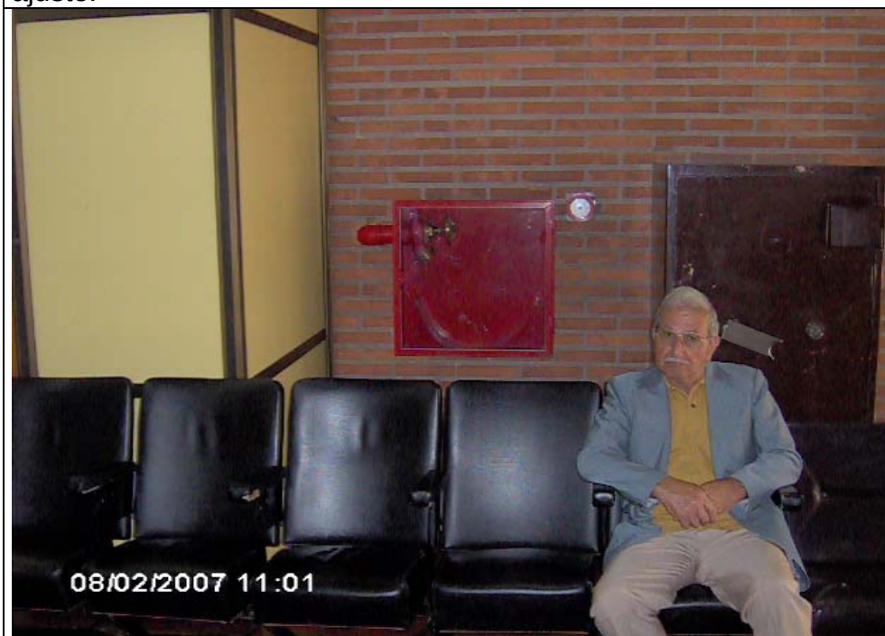
Observación 2: Foto N° 2 - Gabinete hidrante con faltantes de
