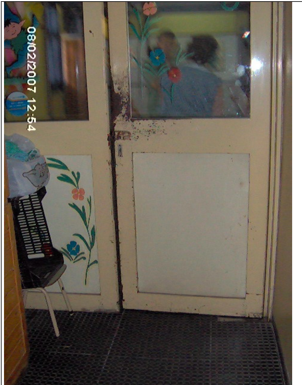
Observación Nº 8 - Foto Nº 17 – Puerta única de acceso al jardín maternal semi obstruida, y de sentido y dispositivo de apertura antirreglamentario.
