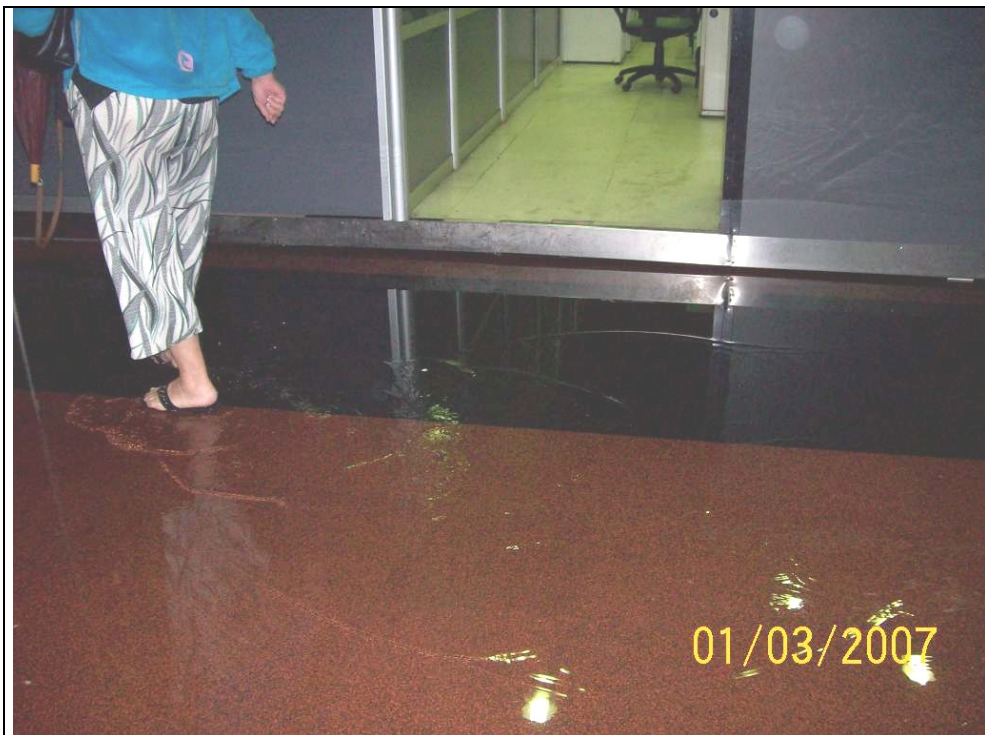
Observación N° 5: Foto N° 13 – Esgurrimiento del agua de lluvia desbordada, hacia la zona central del hall, evidenciando una falla en las pendientes del solado.
