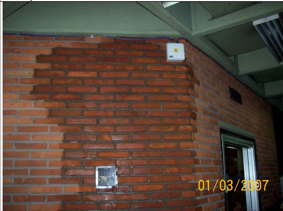
Observación N° 5: Foto N° 14 – Filtraciones del muro de mampostería, provenientes de la losa y la claraboya perimetral de vidrio existente sobre el hall central de P. Baja.
