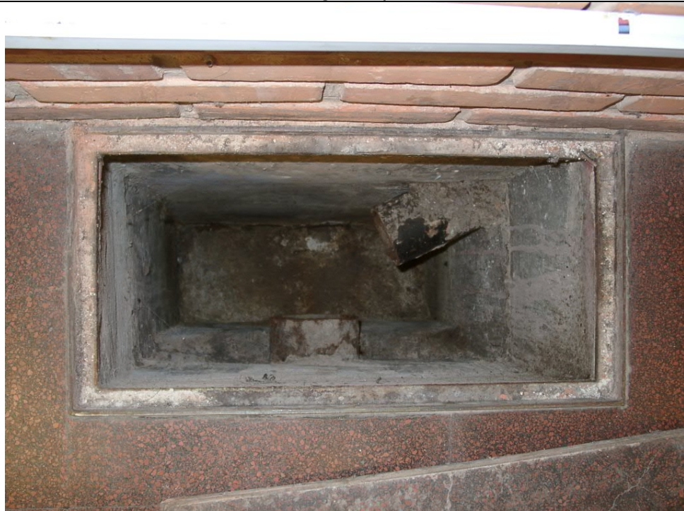
Observación Nº 5: Foto Nº 12 – Boca de acceso pluvial existente en el sector fotografía. Su ventilación supuestamente evitaría el colapso de la red de desagüe pluvial de P. Baja.
