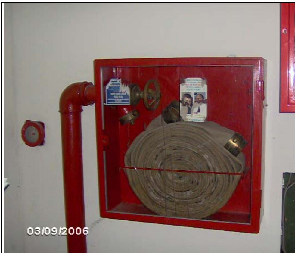
Observación 2: Foto N° 1 – Hidrante con faltante de lanza y llave de ajuste.
