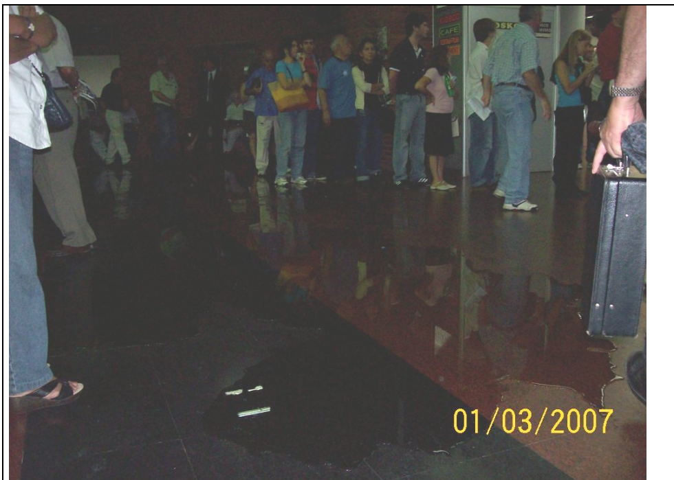
Observación Nº 5: Foto Nº 11 – Inundación del hall central producida por el colapso de los caños de lluvia y el consiguiente desborde de las bocas de desagüe tapadas.
