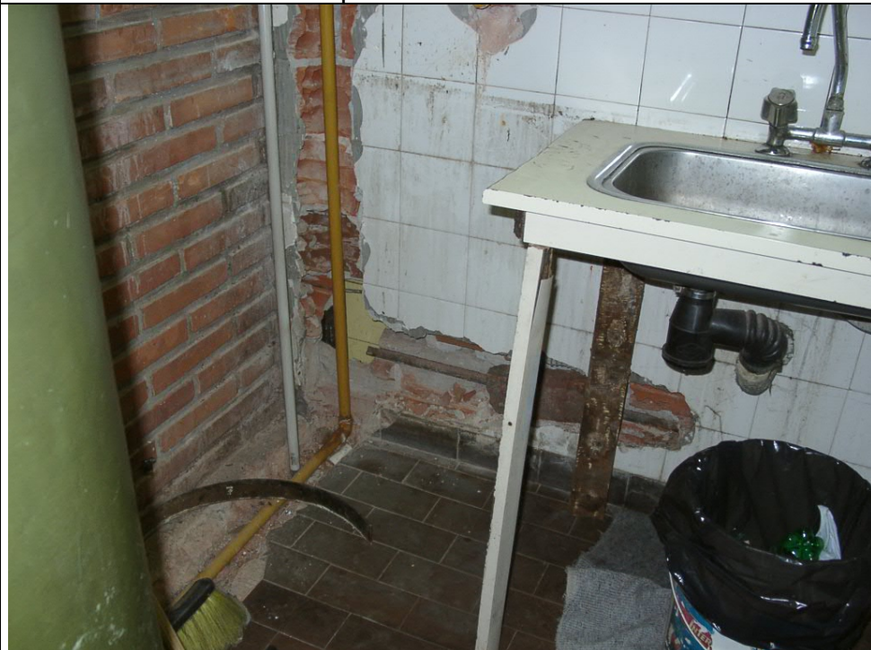
Observación N° 7 - Foto N° 16 –Caño de gas existente en el office de P. Alta, cuya pérdida dio origen al corte de dicho fluido por parte de la empresa Metrogas.
