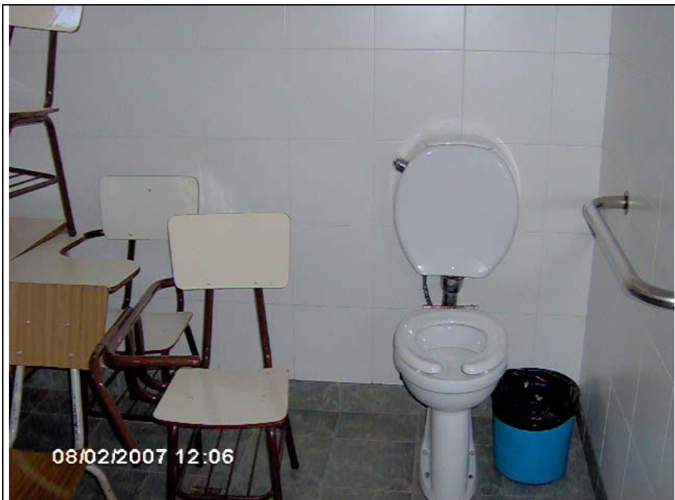
Observación N° 6: Foto N° 15 – Baño acondicionado para personas discapacitadas en el cual se observa la existencia de sillas y mesas estibadas a manera de depósito en su interior.
