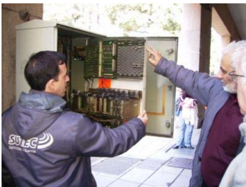
FOTO 10 – Avda. Alem y Avda. Corrientes. Controlador GE de Siemens
