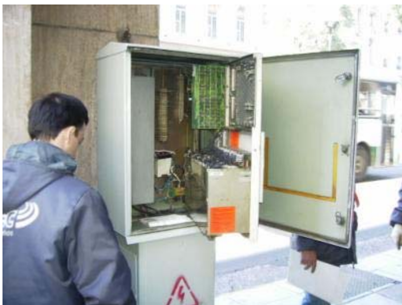
FOTO 9 – Avda. Alem y Avda. Corrientes. Controlador GE de Siemens
