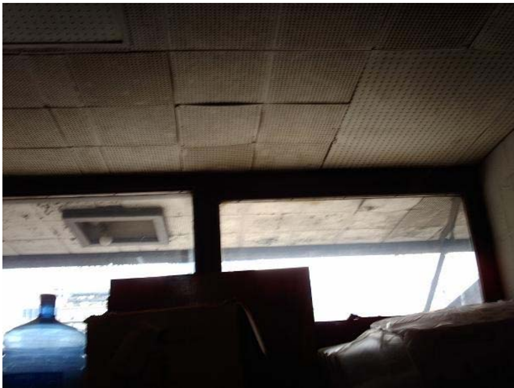
Techo en mal estado y circulación de corrientes de aire desde el exterior
