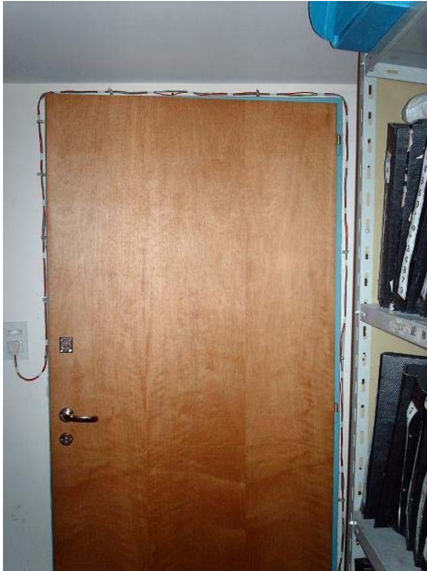
Instalación eléctrica clandestina
