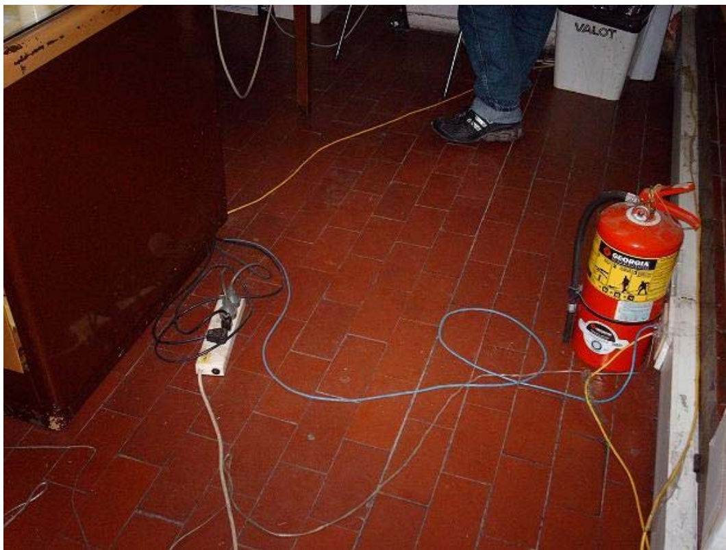
Desorden en las instalaciones eléctricas
