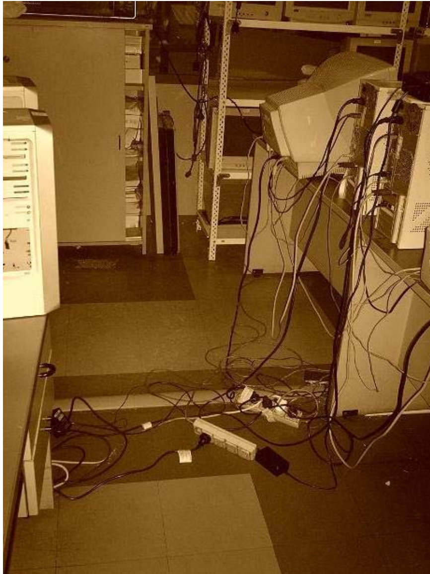
Sistemas Informáticos del IVC, sobrecarga de las instalaciones eléctricas. 6º piso
