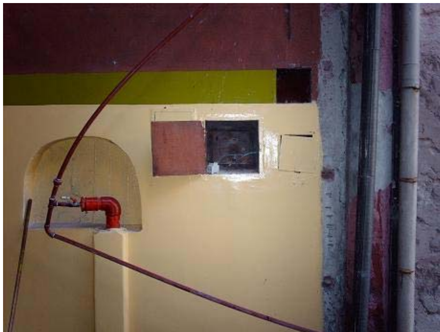
Conexión precaria de agua
