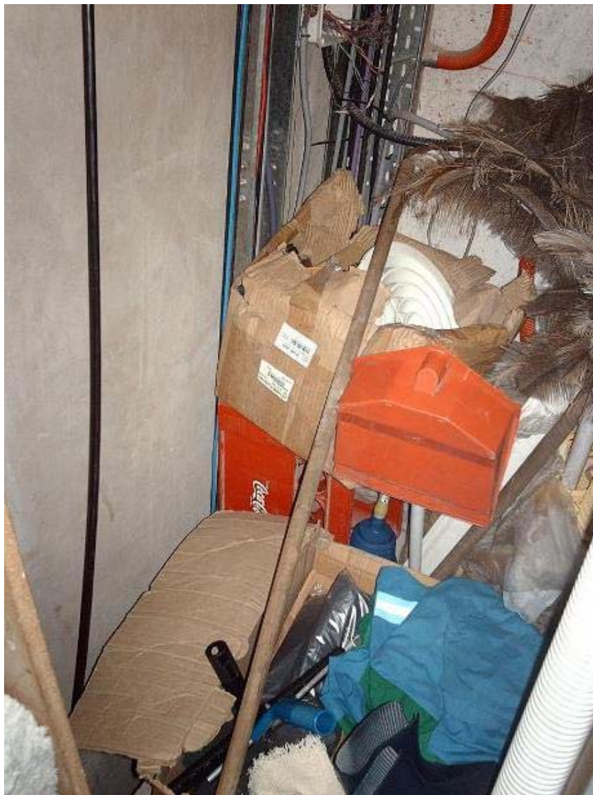
Almacenamiento de elementos con riesgo de incendio
