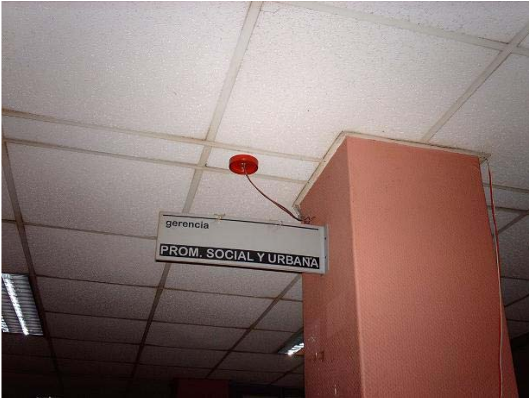
Elemento del sistema de alarma de incendios canibalizado.
