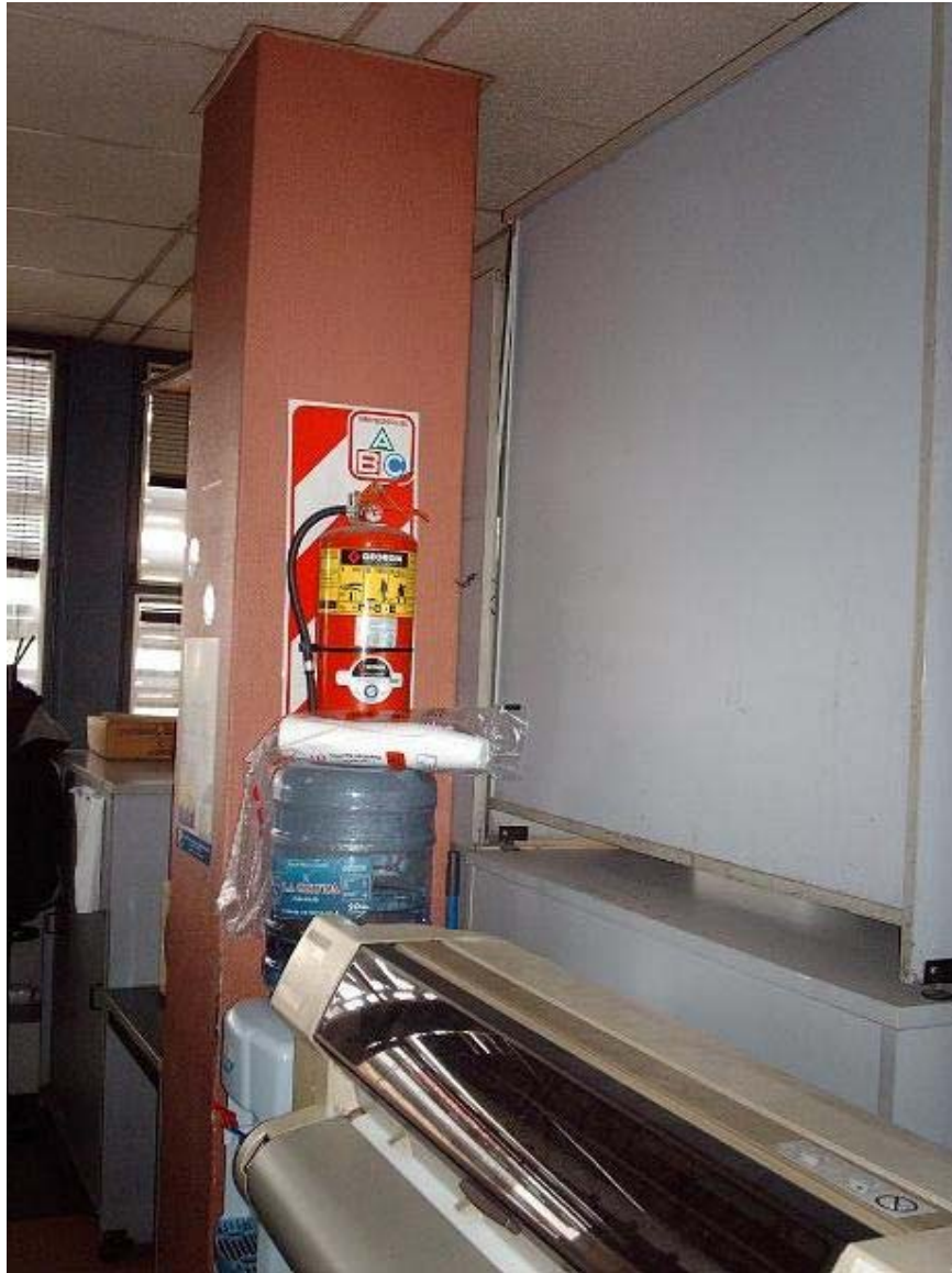
Otro ejemplo de mala ubicación de extintores u obstrucción 6º piso
