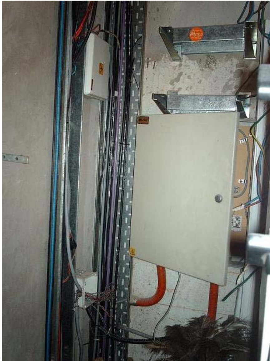
Falta de orden y limpieza en los espacios de servicios generales
