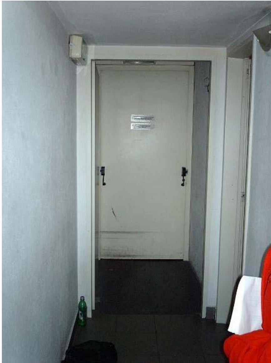
Falta barral antipánico, el mismo se observa ausente por daño.
