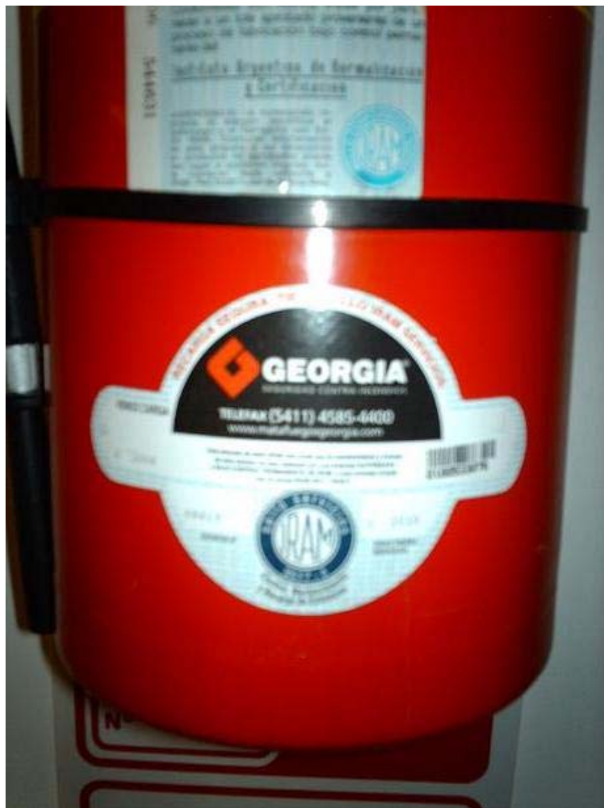
Extintores vencidos en abril de 2008.
