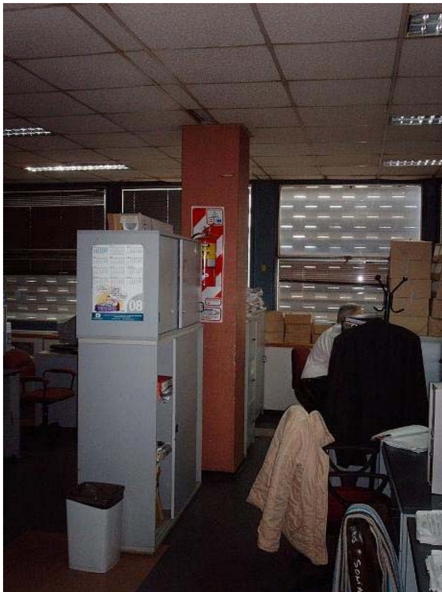
Extintores de incendio mal ubicados u obstruidos. 6º piso
