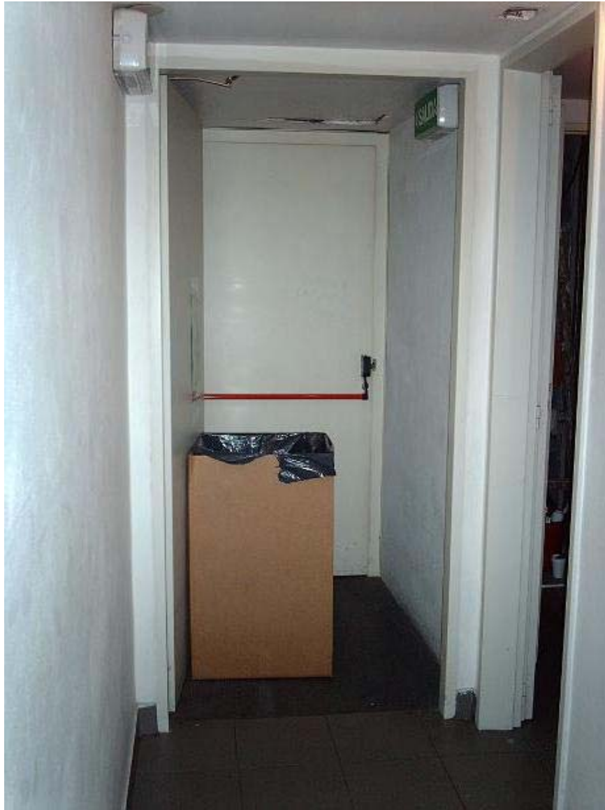
Puerta de salida abierta y obstaculizada. No se cumple el doble cierre de caja de escalera.
