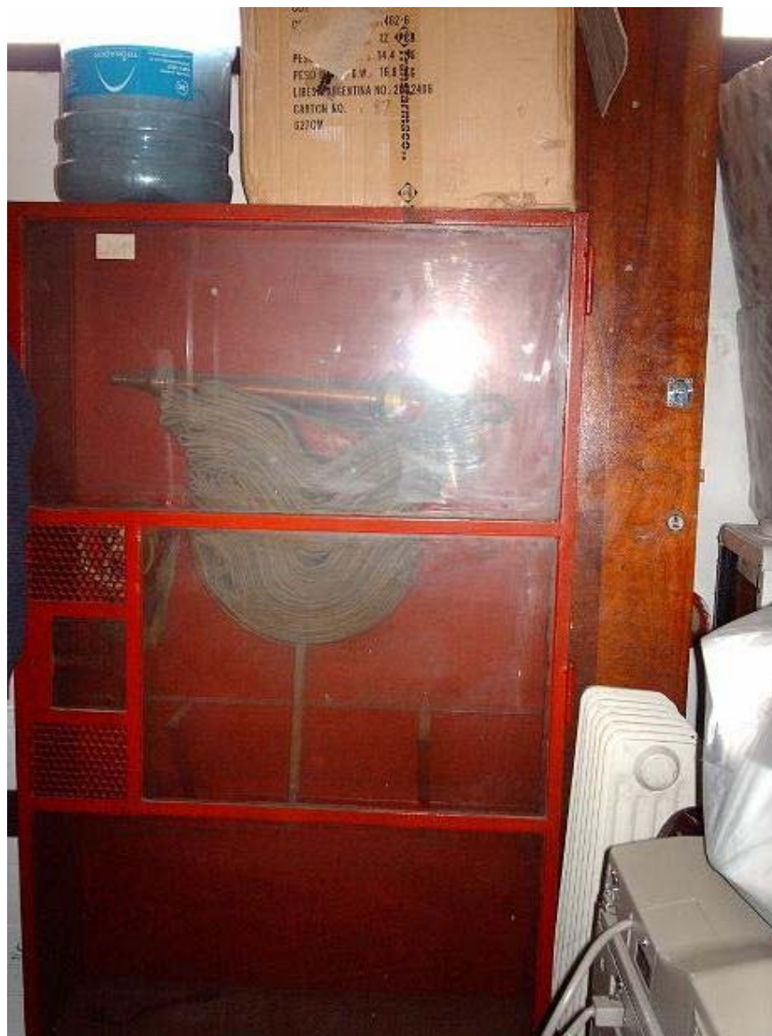
Instalación fija en mal estado
