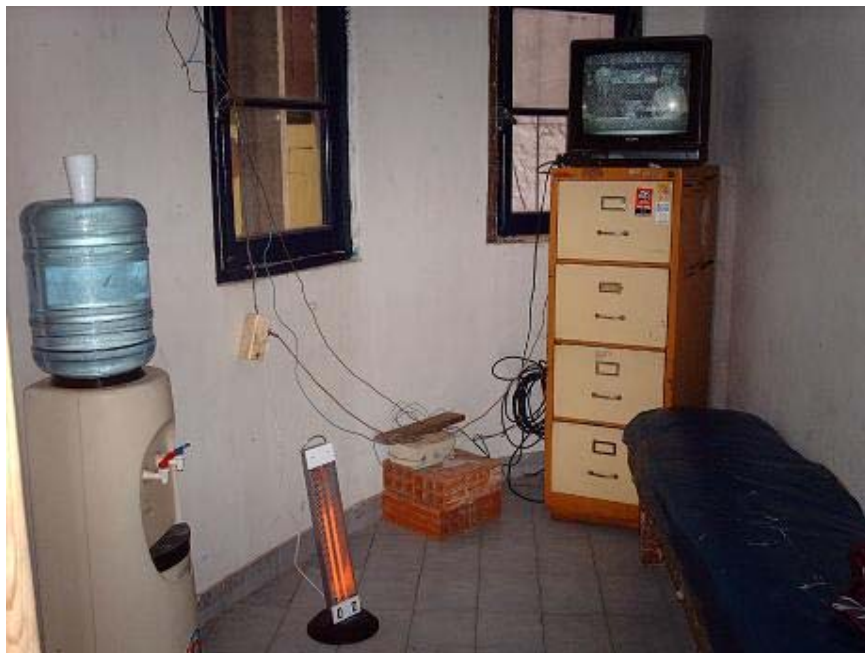
Sobrecarga de instalación precaria.
