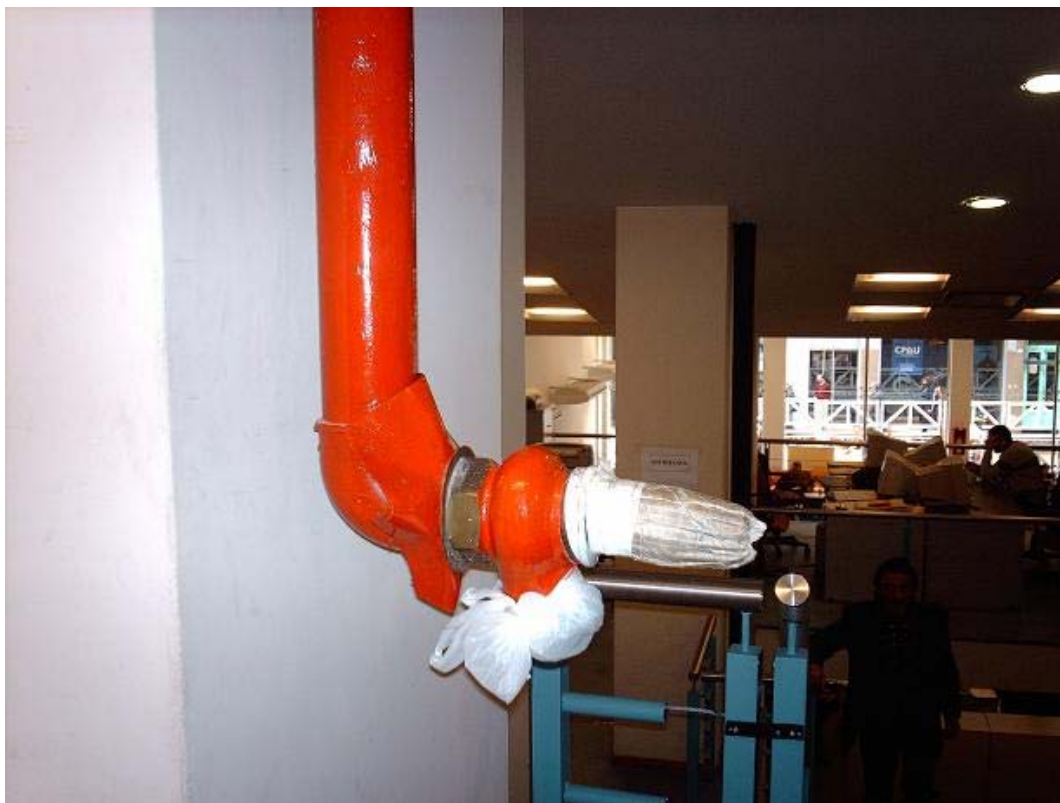
Instalaciones fijas de incendio sin habilitar.
