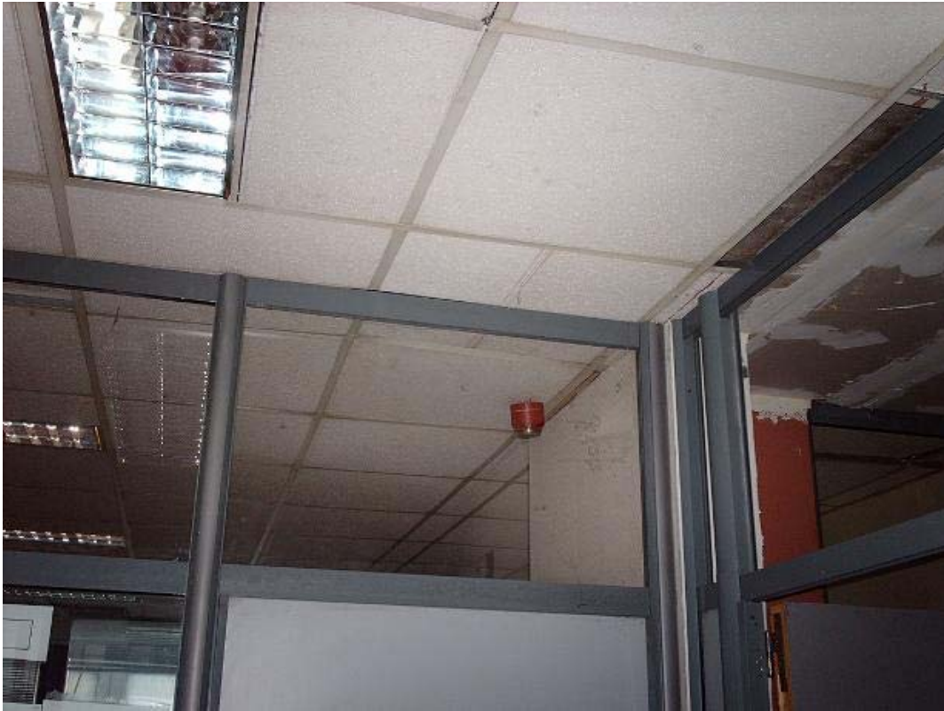
Baliza de incendio sin operar.
