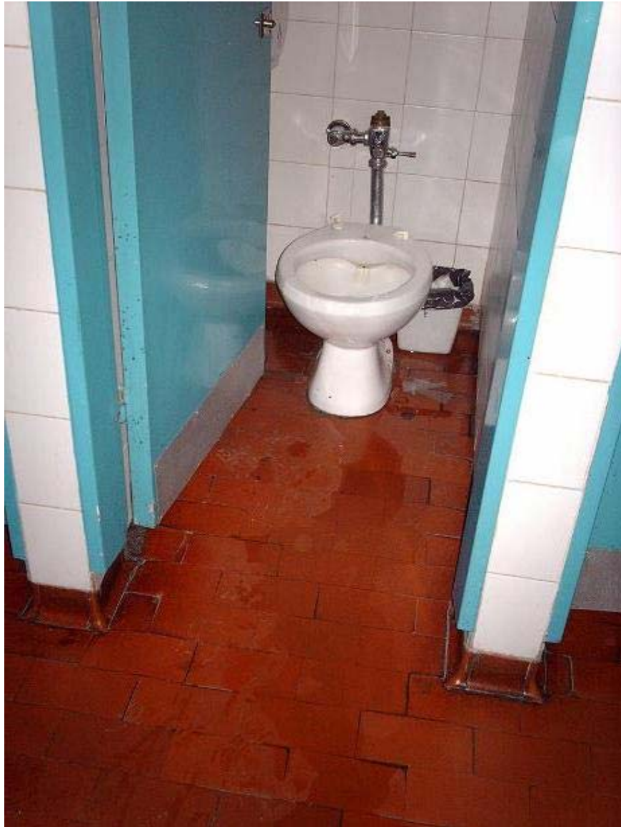
Baño de mujeres en 6º piso, perdidas de agua.
