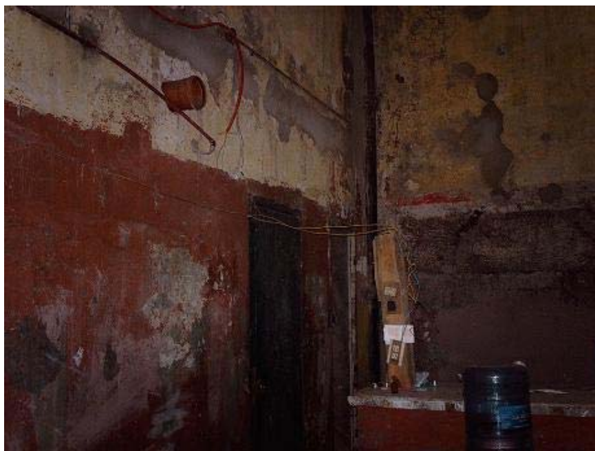
Estado general de las instalaciones malo
