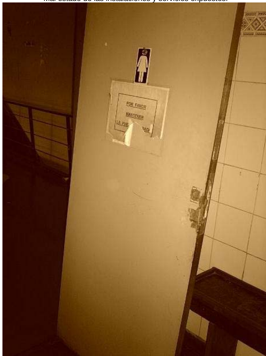
Accesos a baños en mal estado
