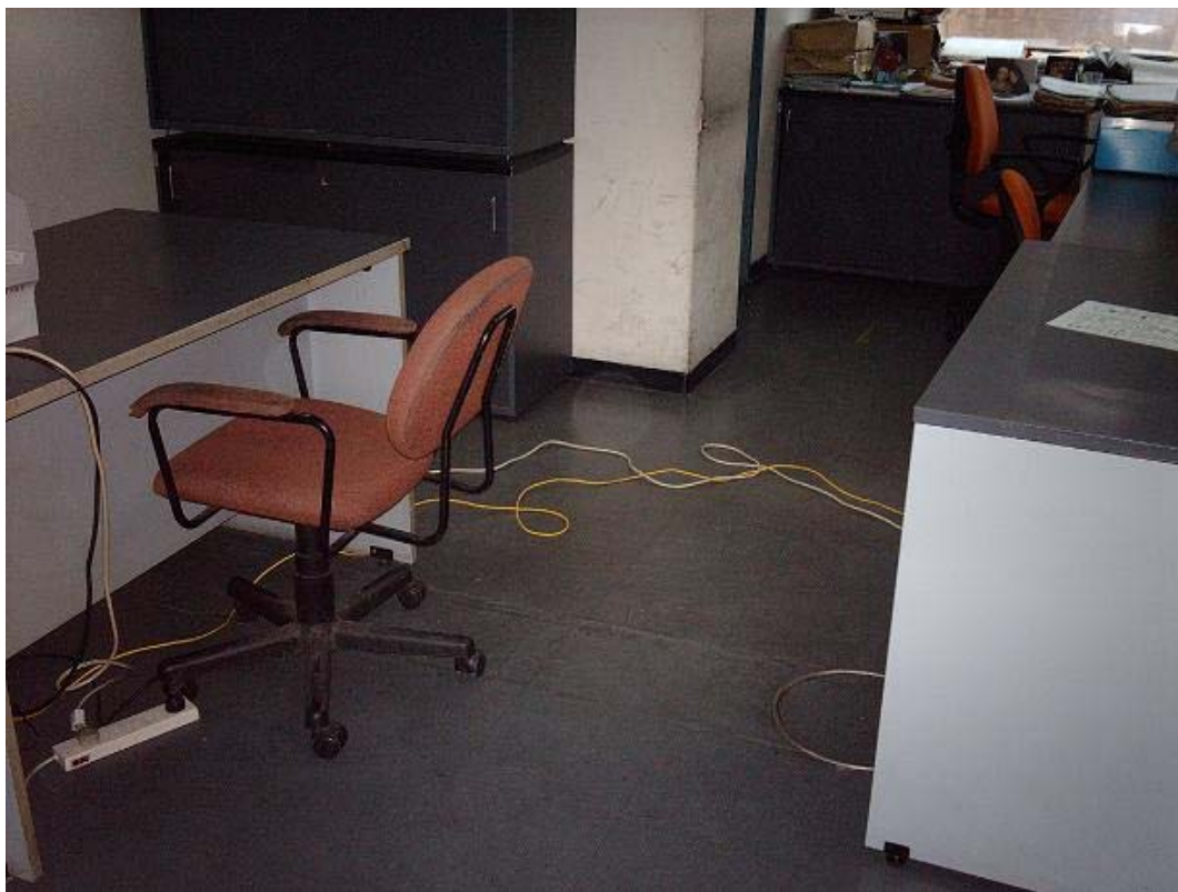
Instalaciones y prolongaciones eléctricas no reglamentarias. 6º piso
