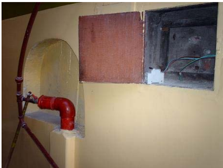
Vista en detalle de la conexión de agua
