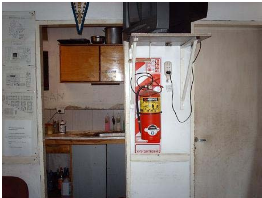
Estado general del lugar y ubicación de extintores
