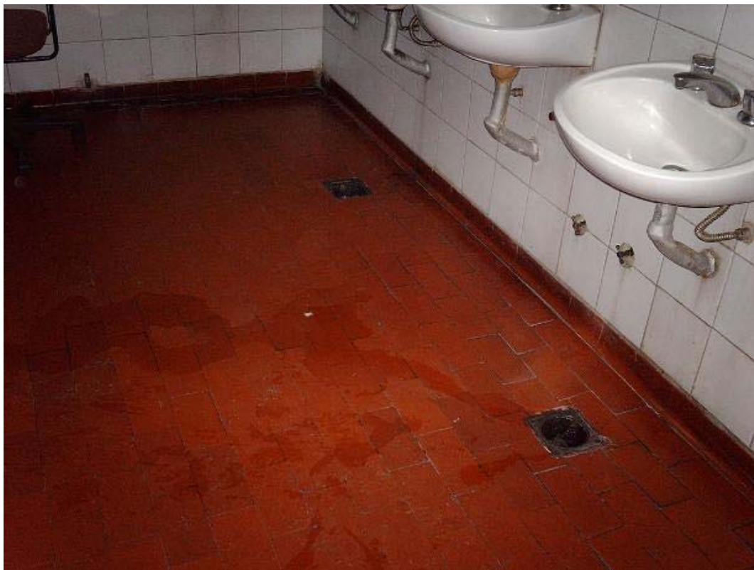
Carencia de rejillas, pérdidas de agua y mal estado general de baños.
