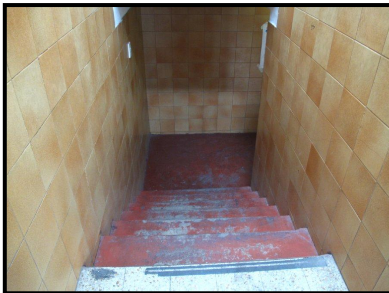
E. C. N°24 DE14 "Dr. Dalmacio Vélez Sarsfield" Domicilio: Av. Del Campo 1340 Hay escaleras sin barandas ni cintas antideslizantes.
