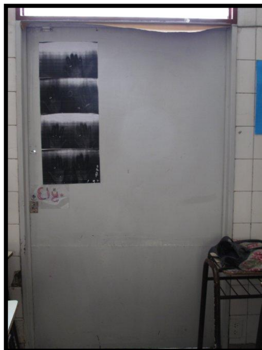
E. C. N°24 DE14 "Dr. Dalmacio Vélez Sarsfield" Domicilio: Av. Del Campo 1340 Existe una salida de emergencia para la cual se debe atravesar un aula. La misma no tiene barra antipánico ni señalética correspondiente.
