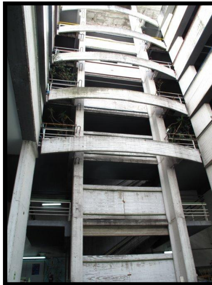
E.E.M. N°3 DE 7 “Sin Nombre ” Domicilio: Padilla 1051 El establecimiento se desarrolla en 5 niveles y 1 subsuelo no cumpliendo con lo indicado por el CRAE para el desplazamiento del alumnado. No cuenta con rampas ni otro medio alternativo para salvar desniveles. Hay un sector destinado para el ascensor que se encuentra tapeado por paneles fenólicos en forma precaria poniendo en riesgo a los transeúntes.
