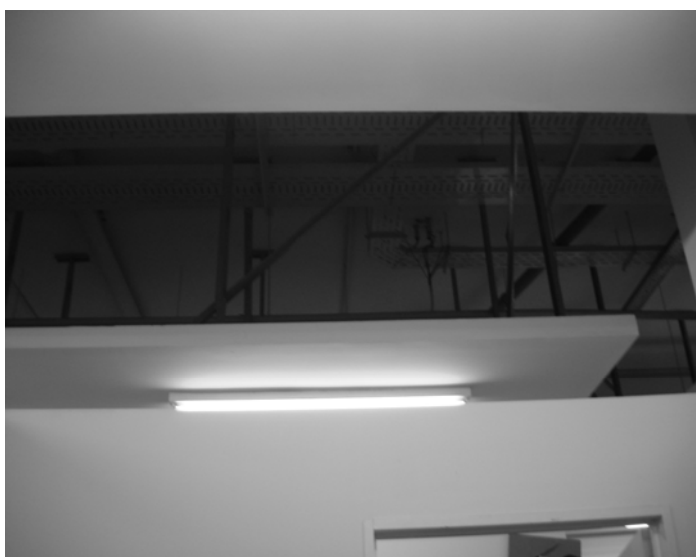
Foto N° 17: Vista desde el hall de entrada de un sector del cielorraso donde podemos observar el sobretecho de más de dos metros de altura por donde pasa toda la infraestructura de servicios.
