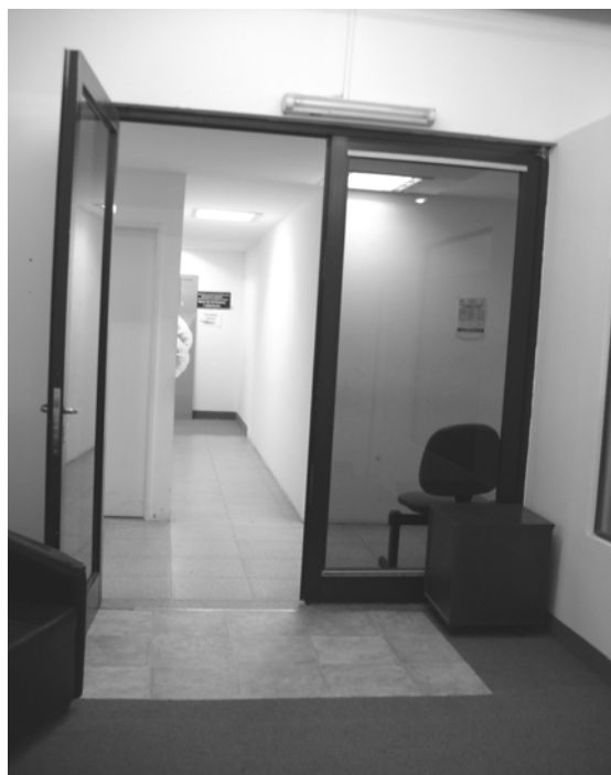
Foto N° 6 – Vista del acceso al sector de este Organismo, en la misma se puede observar la falta de planos de evacuación colocados en las paredes.
