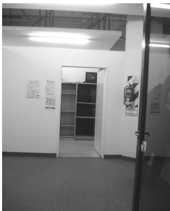
Foto N° 14: Vista de un sector del hall de entrada donde podemos observar el sobretecho de más de dos metros de altura por donde pasa toda la infraestructura de servicios y un matafuego con la carga vigente colgado en una pared.
