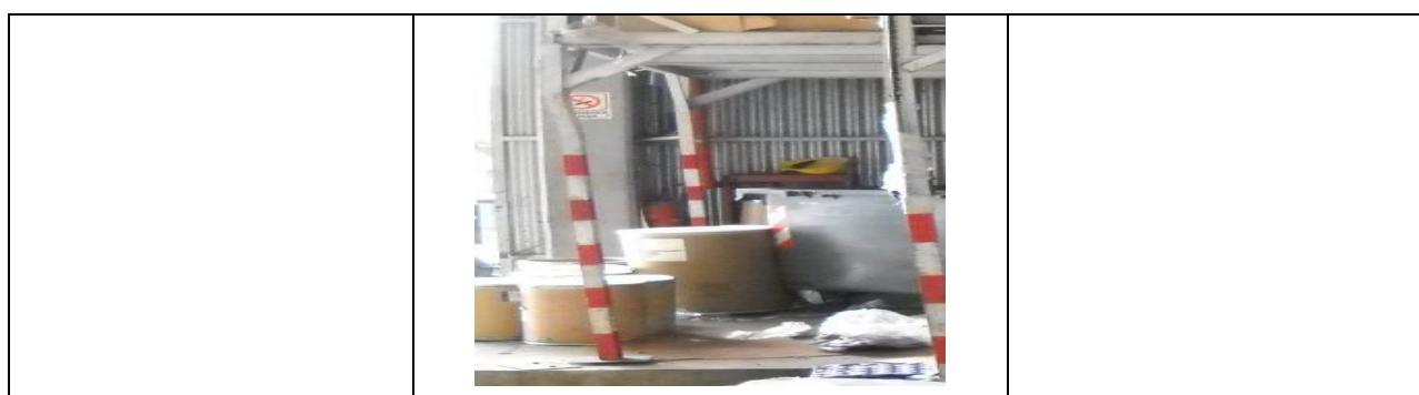
Foto N° 22: Estructura de entrepiso golpeada y ladeada.
