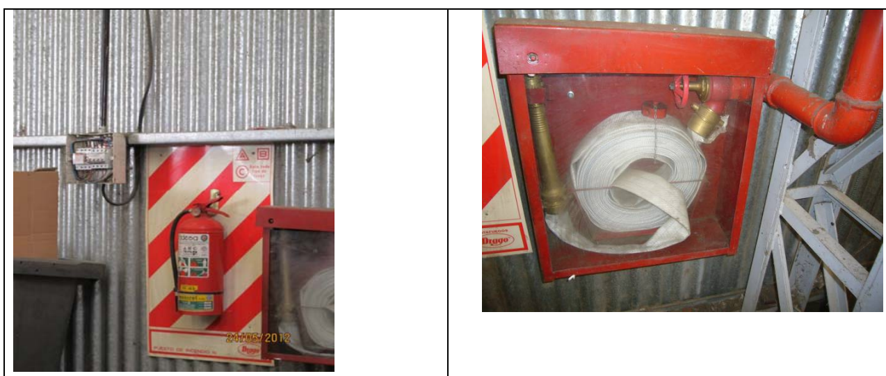
Fotos N° 8 y 9: Equipos Extintores e Instalación de Nichos Hidrantes.
