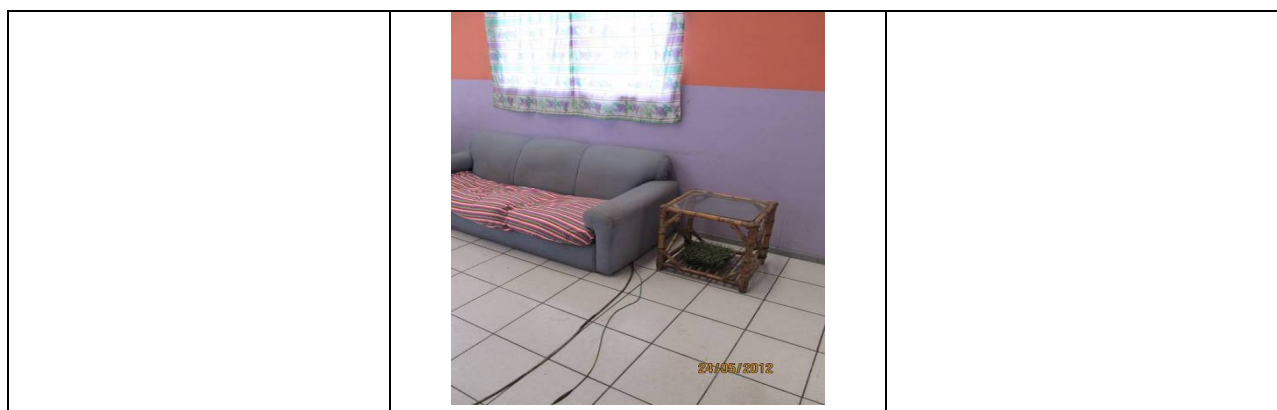
Foto N° 19: Instalaciones y prolongaciones eléctricas no reglamentarias, utilizadas para la conexión entre la báscula para pesar camiones, en el acceso al Centro Verde y la computadora que registra el peso del camión con el material reutilizable y reciclable, ubicada en el interior de la oficina.
