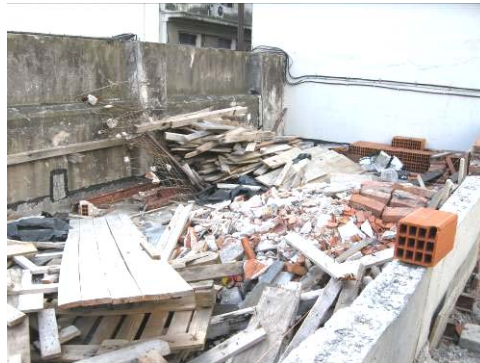
Escombros y materiales en la terraza, sobrecargando la losa del edificio histórico.
