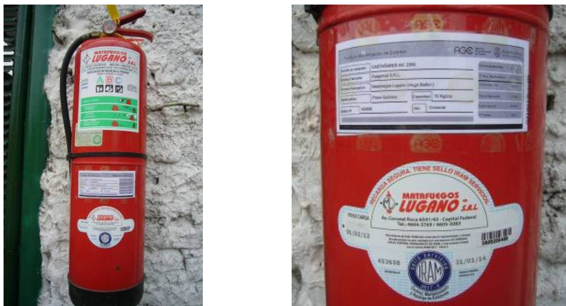
Fotos Nº 8 y 9: Equipos Extintores y Etiqueta de control.
