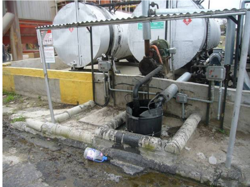
Foto N° 24: Desbordes de material asfáltico.
