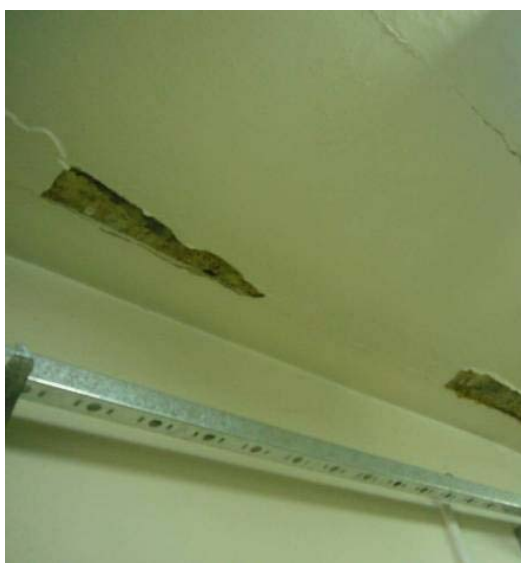
Foto N° 13: Filtraciones en cielorraso. Nueva instalación eléctrica exterior.
