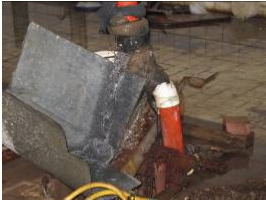
Foto 45: Bombas depresoras de napa freática. Galería XVI.
