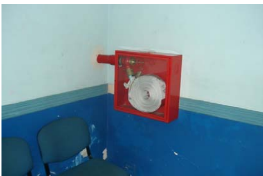
Foto 40: Hidrante sector administrativo.
