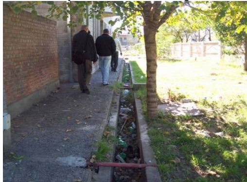
Foto 12: Rejillas faltantes en desagües.
