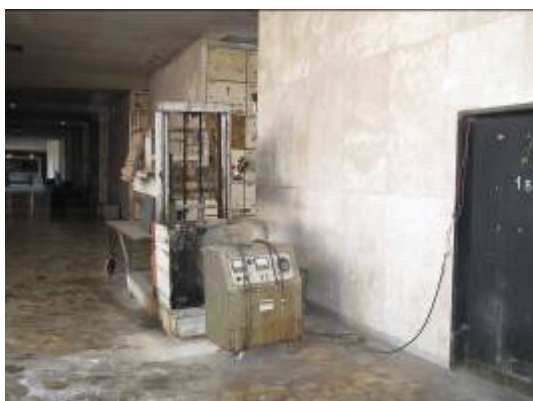
Foto 13: Elevador de ataúdes en desuso.
