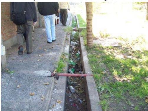
Foto 11: Rejillas faltantes en desagües.
