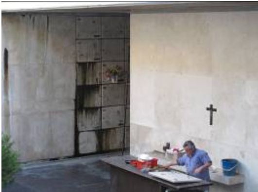
Foto 57: Nichos deteriorados por filtraciones.
