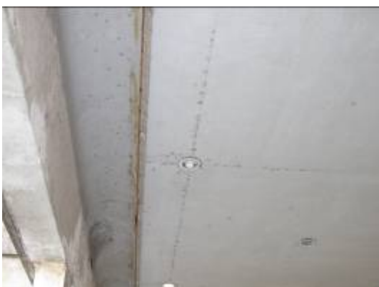
Foto 7: Grietas y filtraciones.
