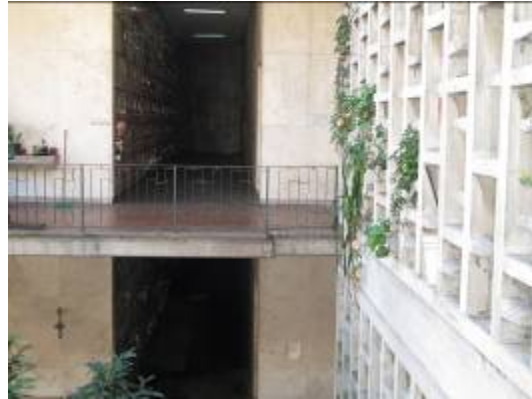
Foto 70: Losa vencida en circulaciones.
