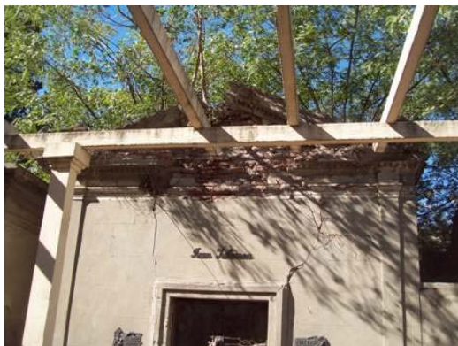
Foto 24: Bóvedas en estado de abandono.
