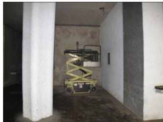
Foto 56: Elevador de ataúdes en desuso.
