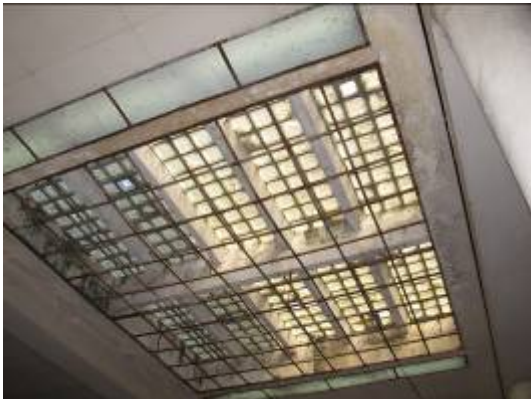
Foto 17: Iluminación cenital. Filtraciones.
