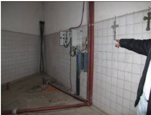
Foto 53: Sala de bombeo automatizado galería XVII.
