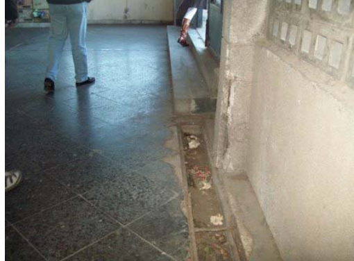
Foto 10: Rejillas faltantes en desagües.
