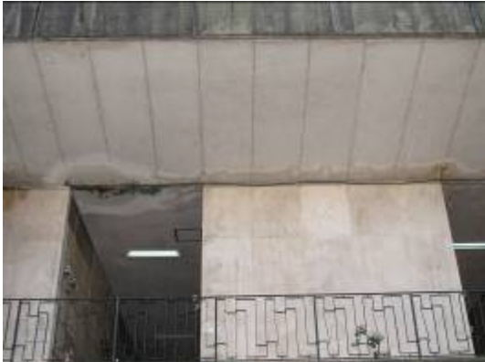
Foto 51: Filtraciones. Cielorraso deteriorado.
