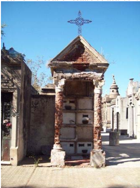
Foto 25: Bóvedas en estado de abandono.
