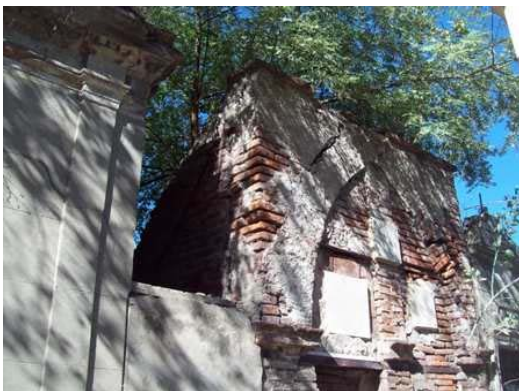
Foto 23: Bóvedas en estado de abandono.
