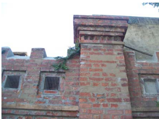
Foto 17: Muro exterior. Crecimiento de malezas.
