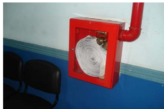
Foto 41: Hidrante sector administrativo.
