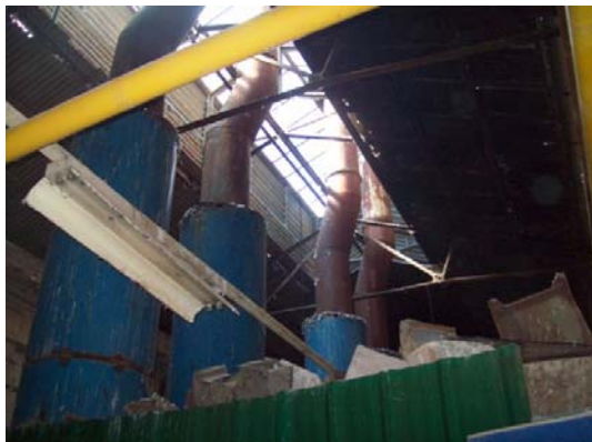
Foto 22: Hornos en desuso y estado edilicio.
