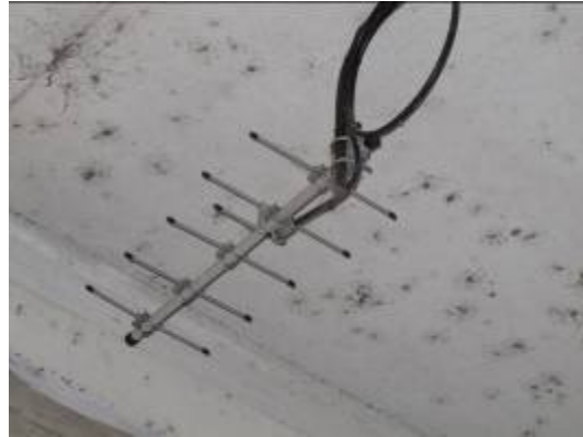
Foto 46: Antena (fuera de servicio) de captación funcionamiento de bombas depresoras. Gal. XVI.
