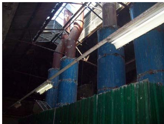
Foto 21: Hornos en desuso y estado edilicio.
