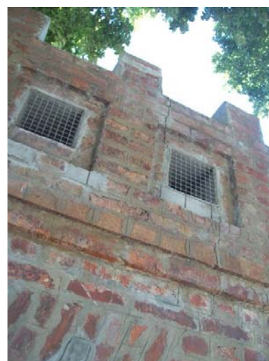
Foto 18: Muro exterior. Grietas.
