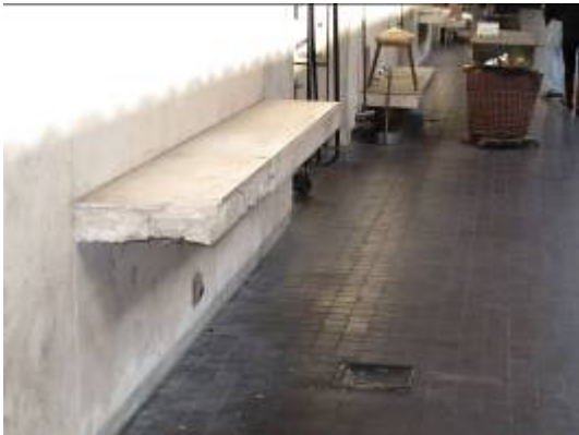
Foto 47: Exterior de galerías. Solados deteriorados
