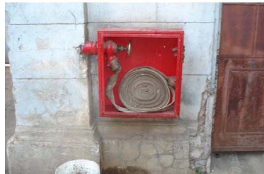
Foto 39: Hidrante sector operativo.
