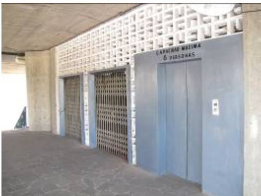
Foto 1: Montacargas y ascensor galería XVIII.
