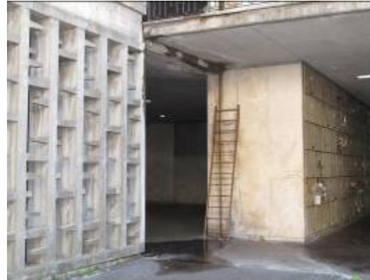
Foto 52: Filtraciones. Cielorraso deteriorado.
