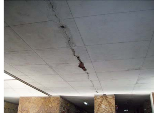
Foto 8: Grietas y filtraciones en losas.
