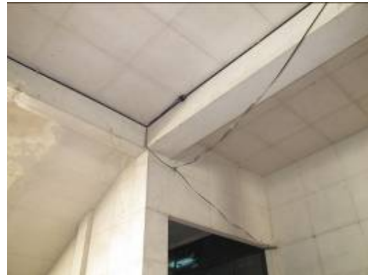
Foto 18: Instalaciones eléctricas y de baja tensión.
