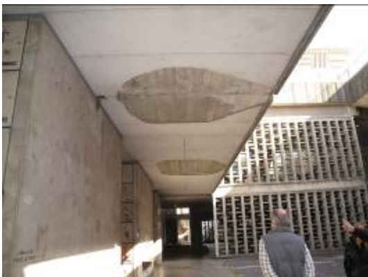
Foto 49. Exterior de galerías. Cielorraso deteriorado.
