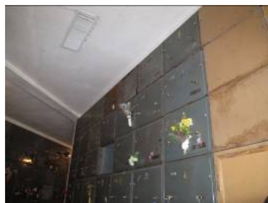
Foto 26: Nichos con tapas metálicas deterioradas.
