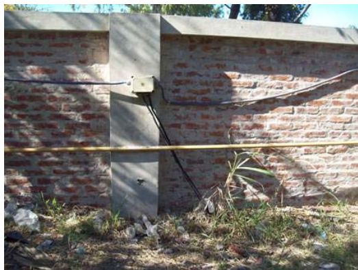
Foto 18: Instalaciones s/muro Av. Castañares.
