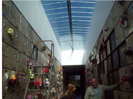
Foto 4: Losa modificada en pasillo. Anulación de filas superiores..
