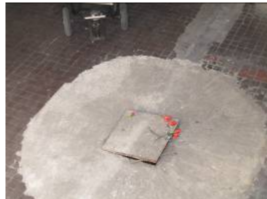
Foto 38: Pozo de desagüe.
