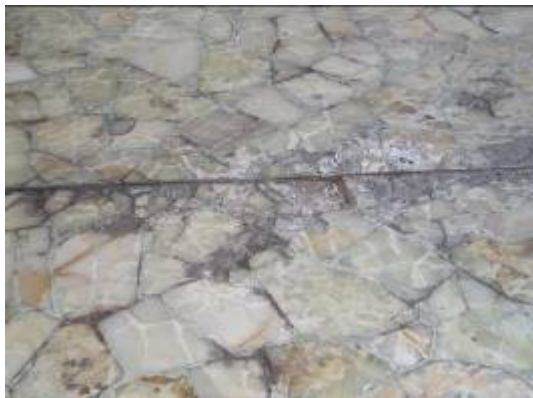
Foto 9: Solados originales deteriorados.
