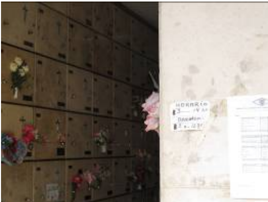
Foto 35: Pasillo con bajo nivel de iluminación.
