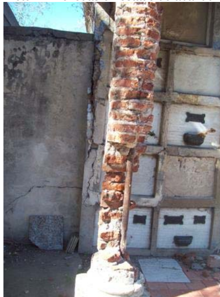
Foto 26: Bóvedas en estado de abandono.
