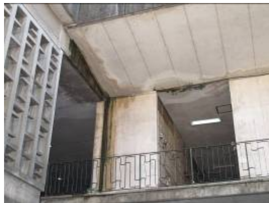
Foto 50. Filtraciones. Cielorraso deteriorado.
