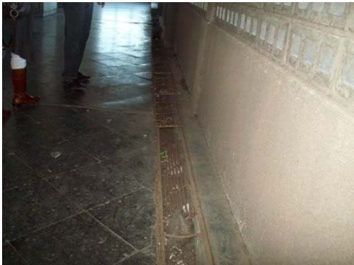
Foto 9: Rejillas faltantes en desagües.
