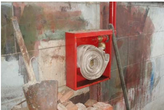
Foto 38: Hidrante sector operativo.
