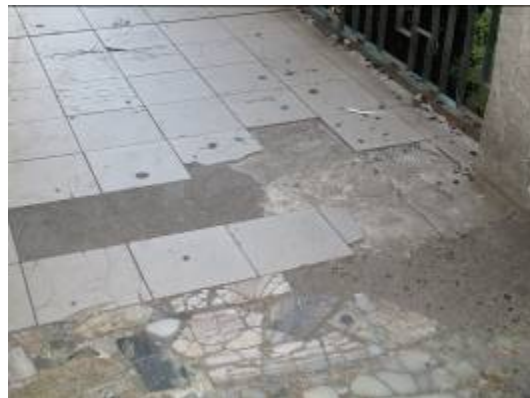
Foto 10: Diferentes tipo de solados deteriorados.
