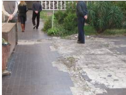
Foto 48: Exterior de galerías. Solados deteriorados
