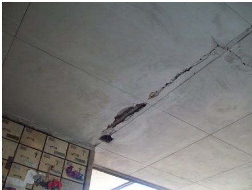
Foto 7: Grietas y filtraciones en losas.
