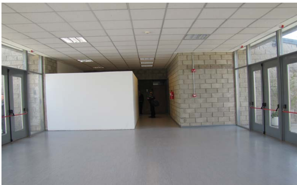
Foto N° 4 – La presente vista ejemplifica distribución y acceso de matafuego, manguera dentro de cabina reglamentaria y pulsador de alarma
