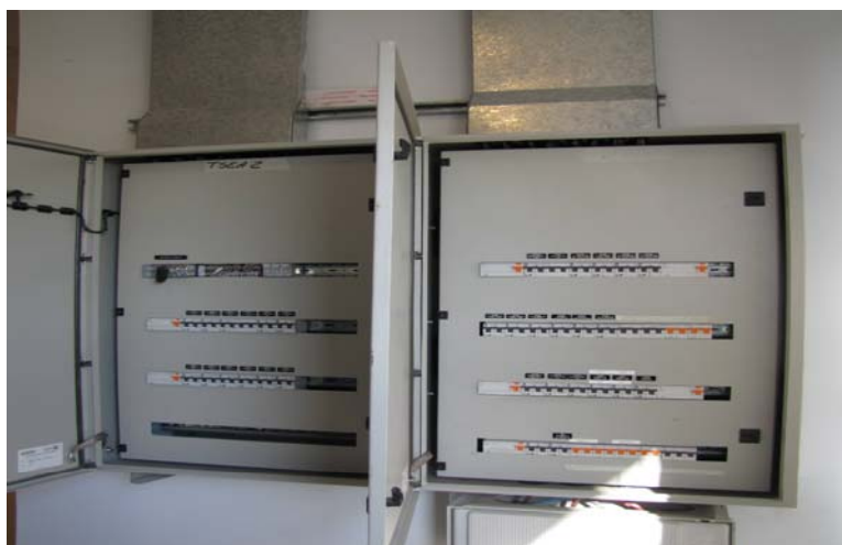
Foto N° 8 – Imagen de dos tableros seccionales con tapa y contratapa reglamentarias y todas las llaves térmicas mas los disyuntores de corte diferenciales.
