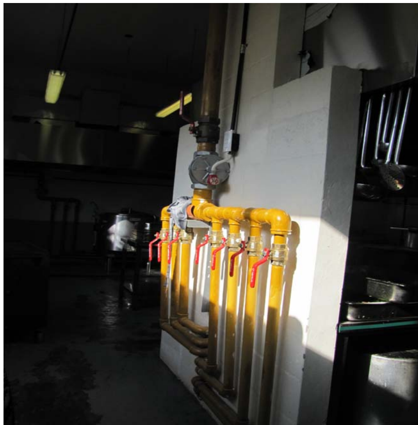
Foto N° 24 – Vista de colectora de caños de gas con las llaves de corte y en la parte superior la dispositivo automático de corte general.
