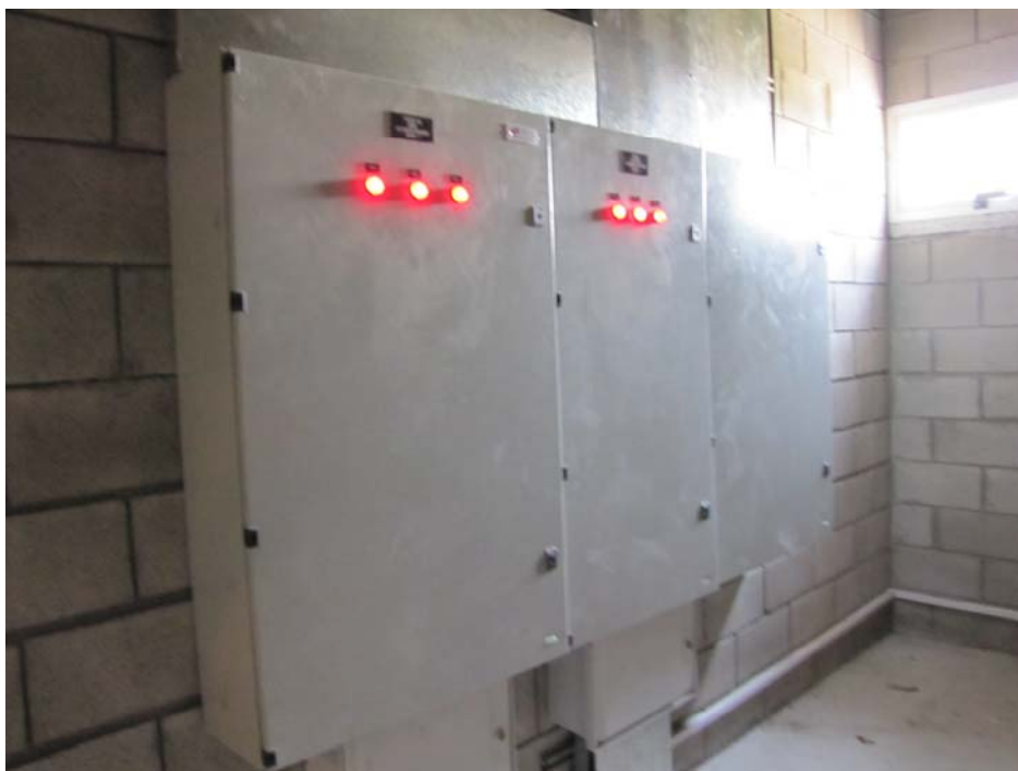
Foto N° 12 – En la presente vista podemos ver dentro de un lugar cerrado los tableros de electricidad generales.
