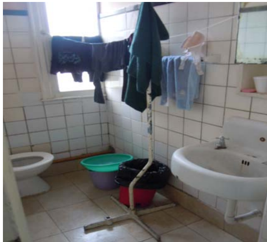
POCA PRIVACIDAD, BAÑOS EN MALAS CONDICIONES - EQUIPAMIENTO Y MOBILIARIO OBSOLETO
