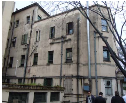
FACHADAS CON FALTA DE MANTENIMIENTO
