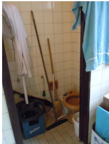
BAÑOS EN MAL ESTADO
