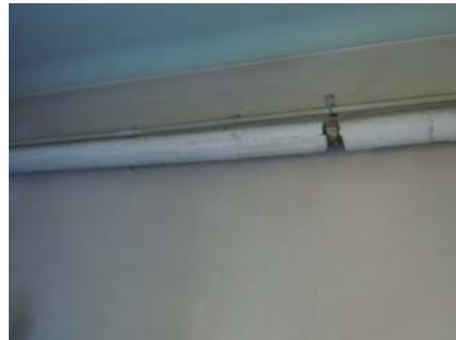
MESADAS ROTAS - ASBESTO
