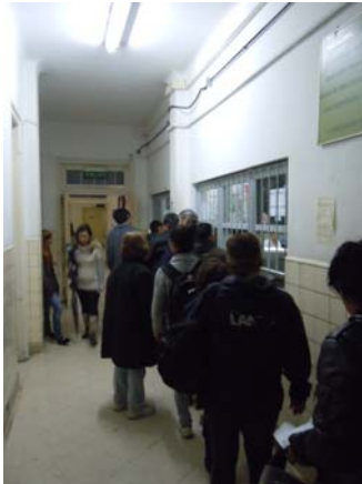
ATENCION EN MEDIO DE UN PASILLO – PISOS DETERIORADOS
