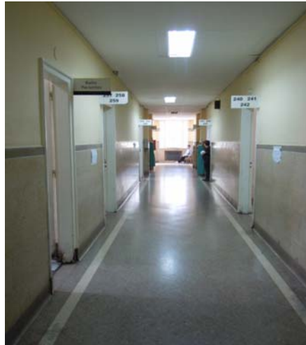
PASILLO CENTRAL, CIELORRASOS EN MALAS CONDICIONES
