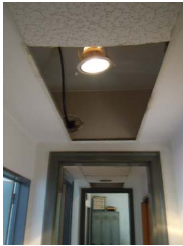
CIELORRASO NUECO DETERIORADO POR FILTRACIONES
