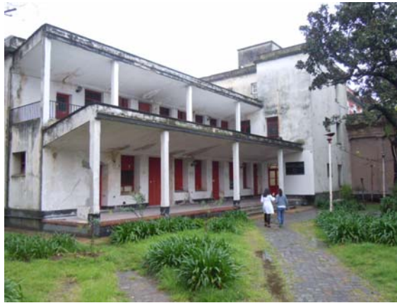
AREAS EXTERIORES EN MAL ESTADO
