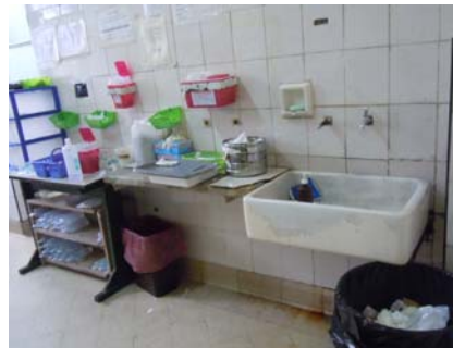
OFFICE EN MALAS CONDICIONES
