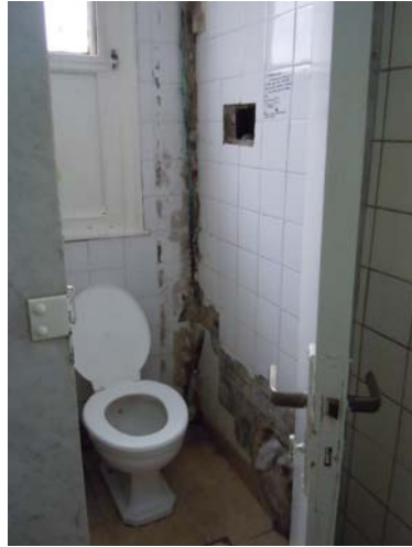
BAÑOS EN MUY MAL ESTADO
