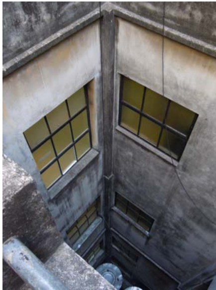
FALTA DE PINTURA EXTERIOR
