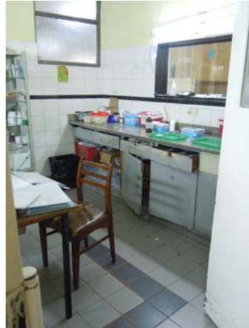
MOBILIARIO EN OFFICE EN MAL ESTADO
