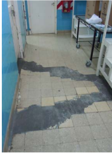
PISOS ROTOS – MARCOS ROTOS
