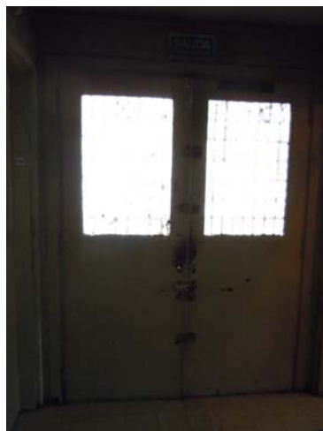
SALIDA DE EMERGENCIA OBSTRUIDA Y CERRADA
