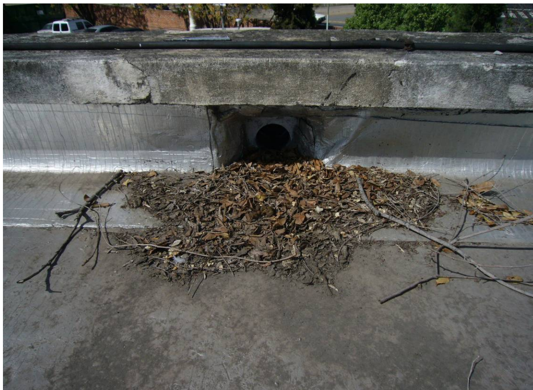
Foto 28. Ausencia de rejilla que evite el ingreso al sistema de elementos extraños.
