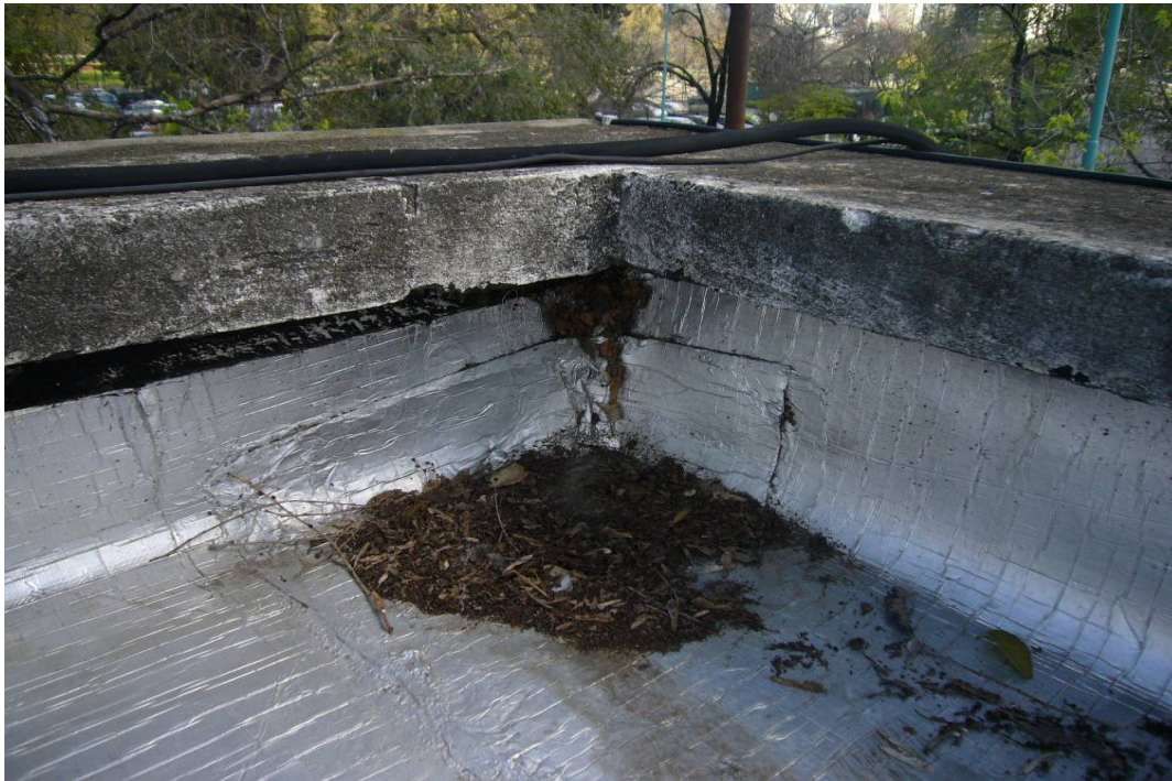
Foto 29. Deficiencias en el sellado del ángulo de la azotea.
