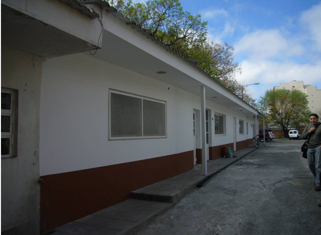
Foto 2. Frente interno pintado con reja
