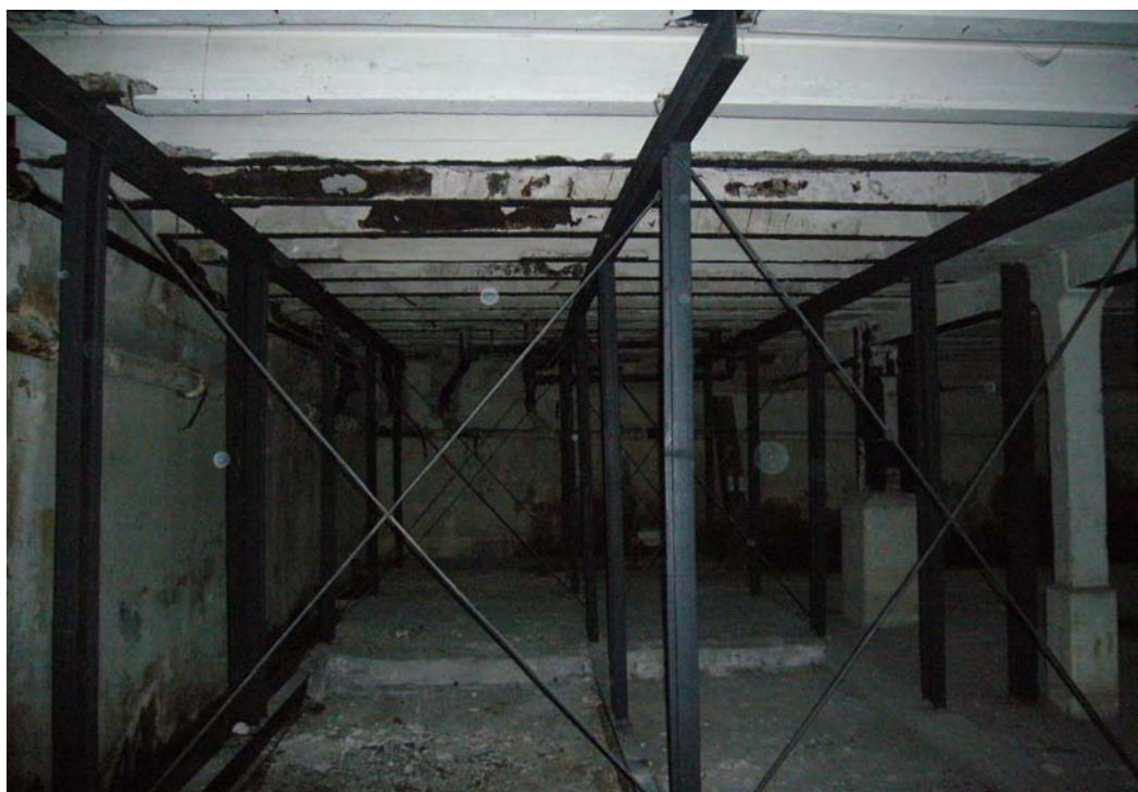
Foto 15: Estructura de apuntalamiento existente. Se desconoce el originante.
