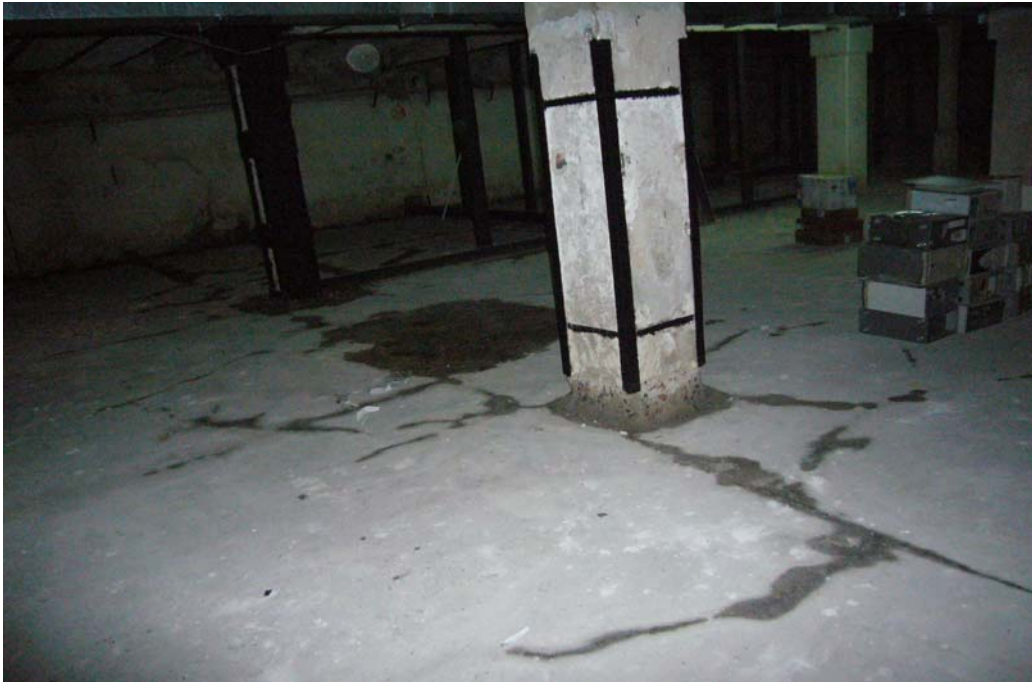
Foto 18: Humedad surgente en todo el subsuelo
