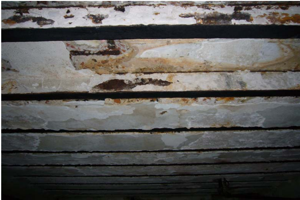
Foto 12: Humedad que afecta los perfiles metálicos de la bovedilla
