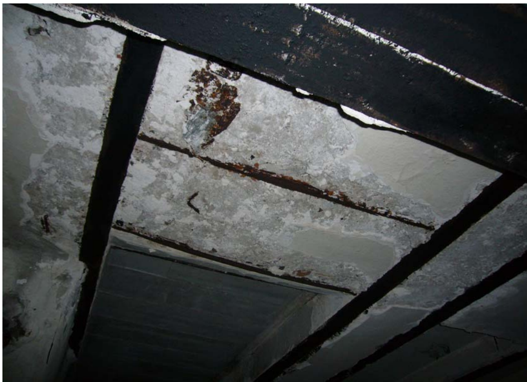
Foto 4: Vigas metálicas con presencia de oxido
