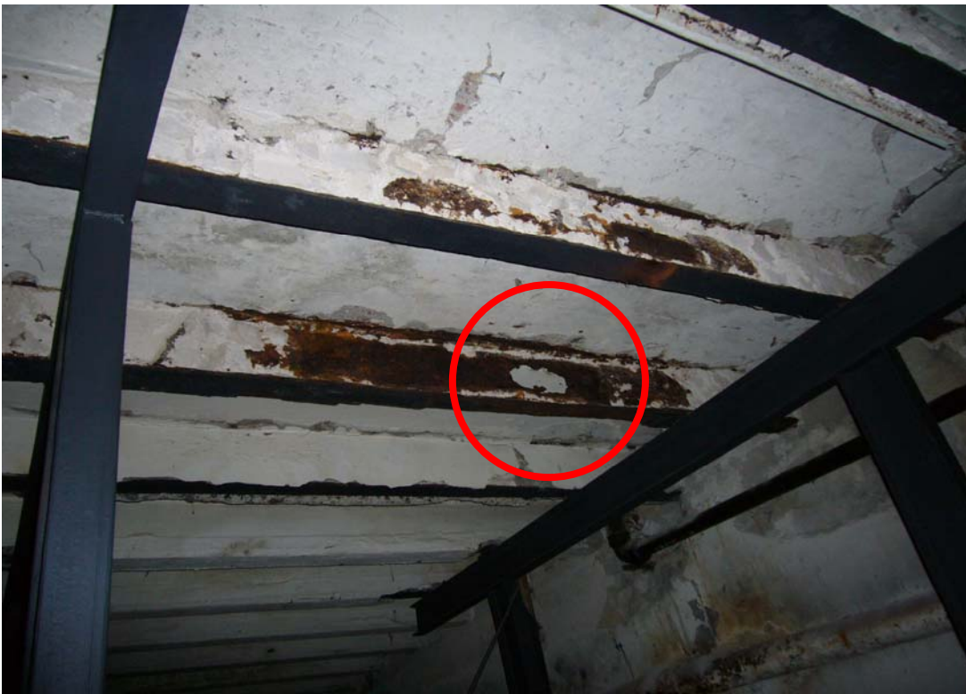
Foto 11: Perfiles con perforación del alma por oxidación. Apuntalamiento existente.
