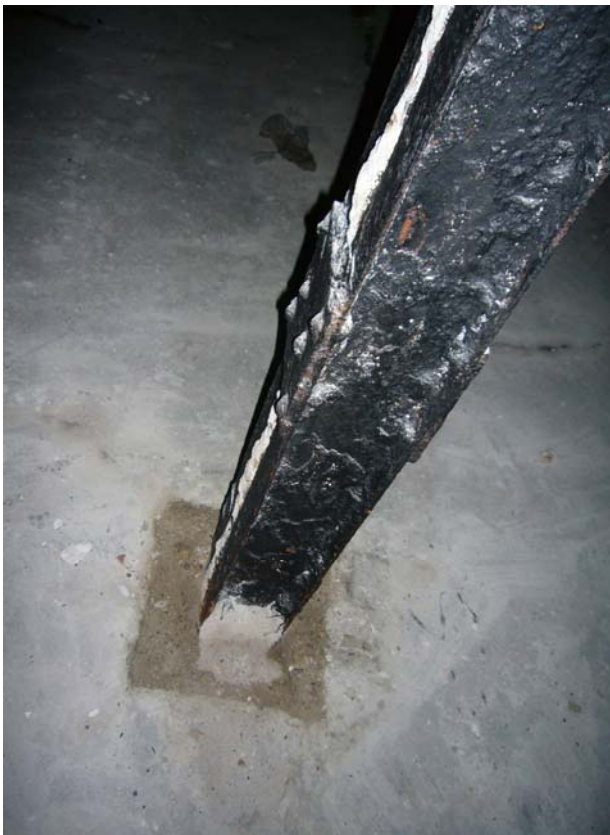
Foto 19: Columna pintada. Base húmeda.
