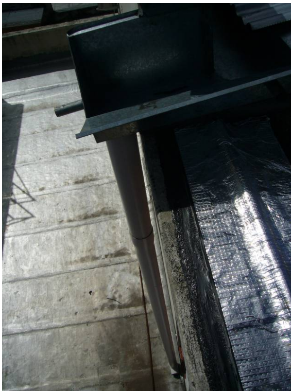
Foto 39. Caño pluvial de PVC sin grampas de fijación.
