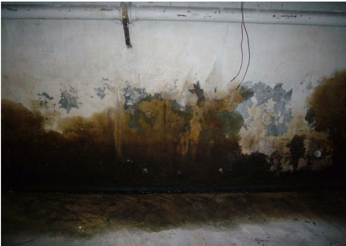
Foto 7: Humedad de cimientos
