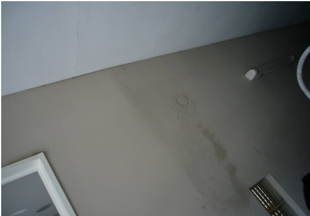
Foto 50. Humedad de filtraciones del techo afectando la instalación eléctrica
