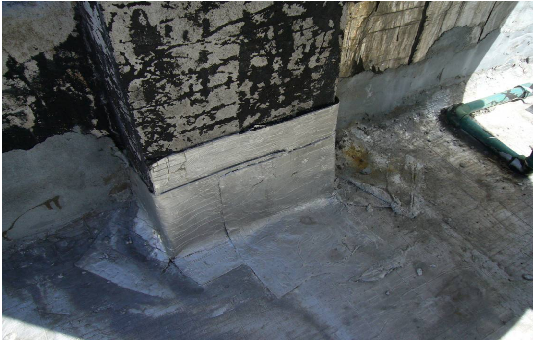
Foto 32. Deficiencias en el sellado de bordes de la membrana
