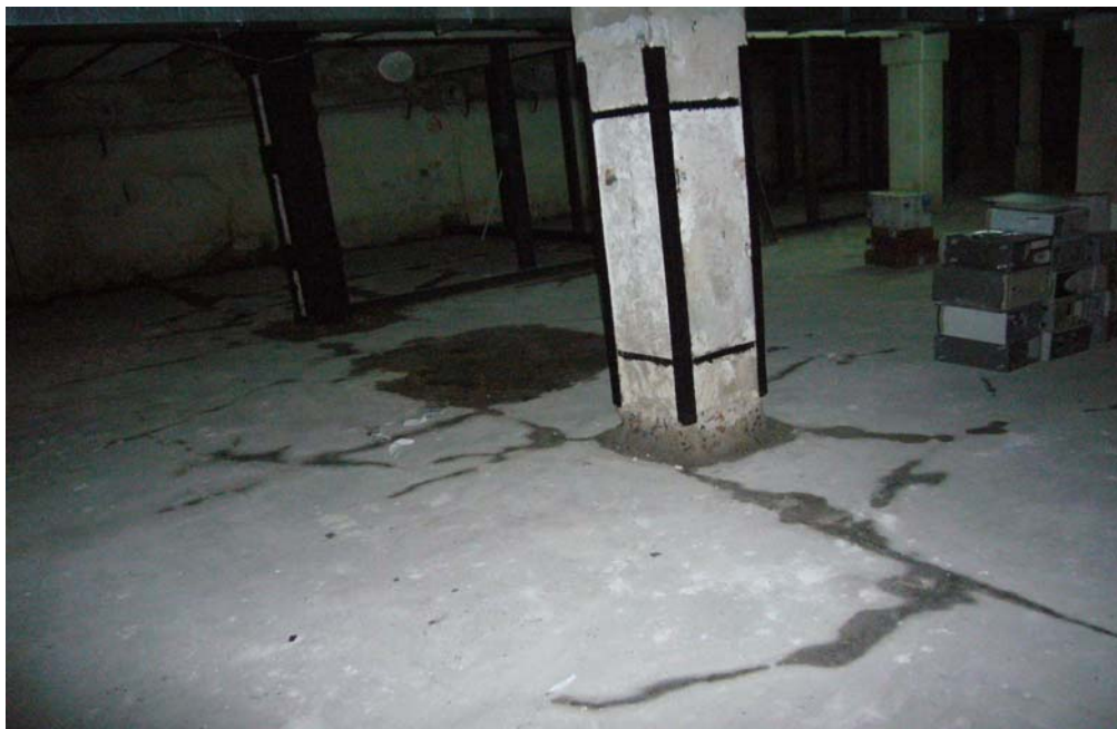
Foto 20: Humedad bajo el solado
