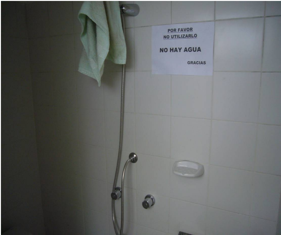
Foto 17. Baño con problemas
