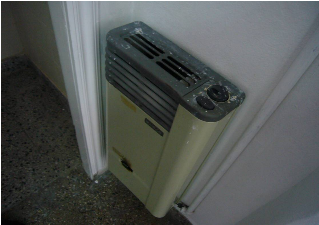
Foto 12. Falta de cuidado del equipamiento preexistente durante los trabajos ejecutados
