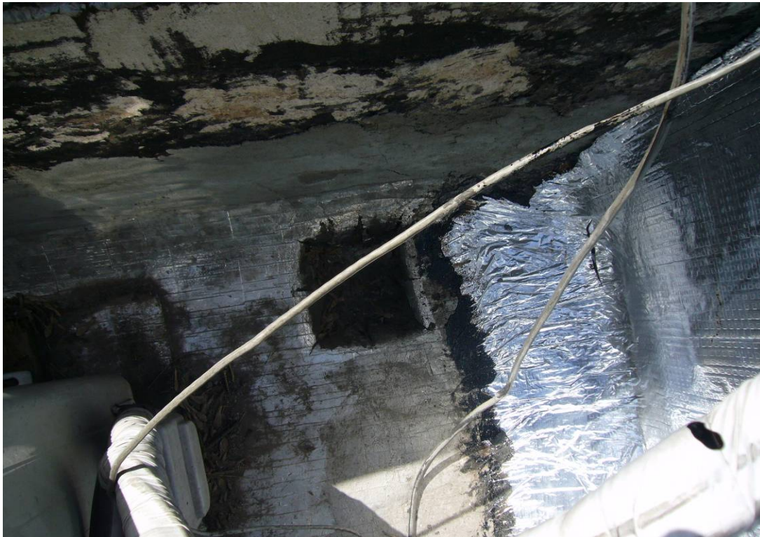
Foto 42. Ausencia de rejilla
