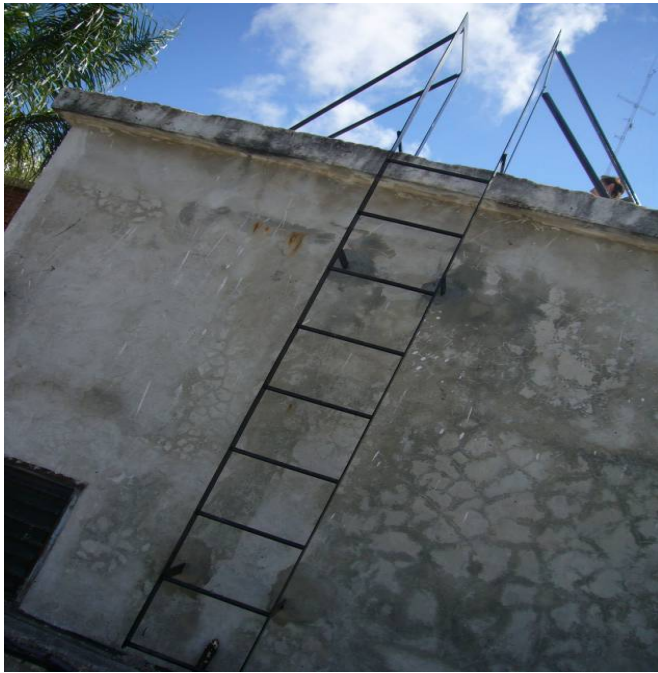
Foto 31. Escalera gato y revoques con humedad
