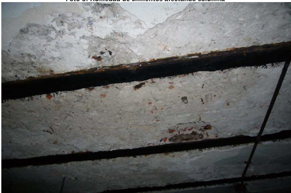
Foto 9: Colapso de los revocos de la bovedilla por oxidación de los perfiles de hierro
