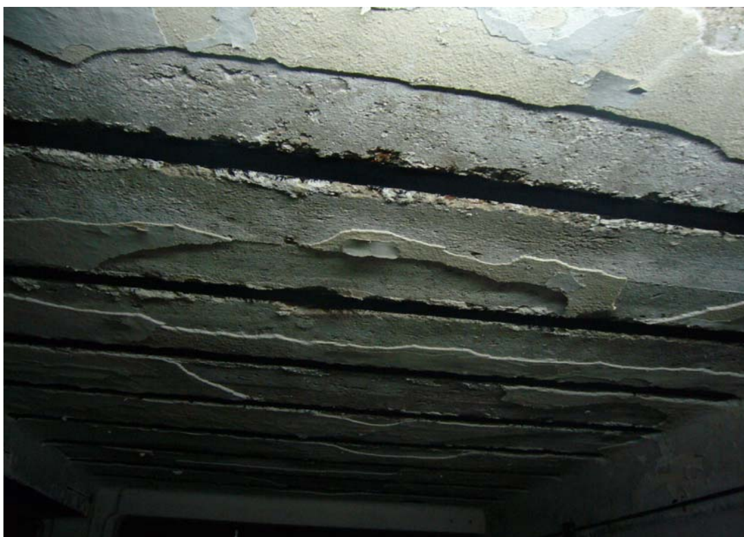
Foto 5: Vigas de la bovedilla con presencia de oxido
