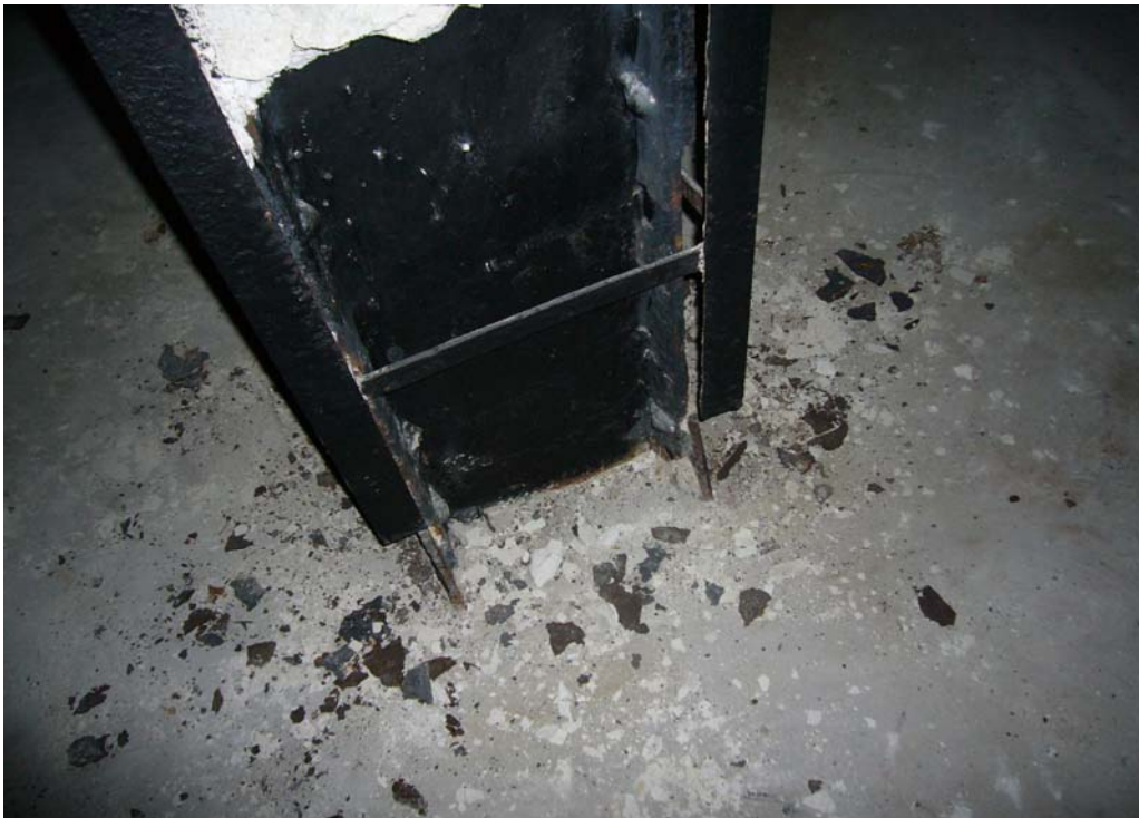
Foto 3: Columna con esquirlas de oxido sobre el solado
