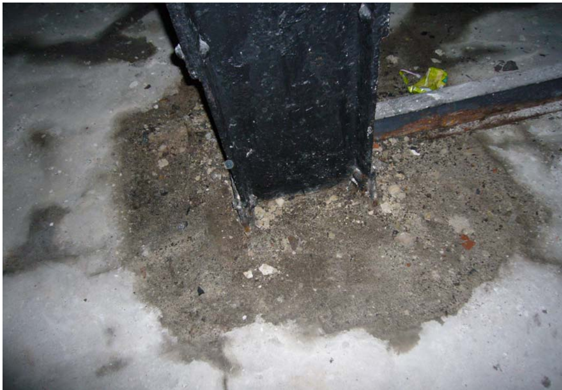
Foto 8: Humedad de cimientos afectando columna
