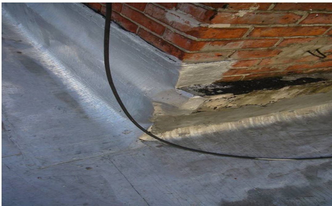
Foto 54. Incorrecta aplicación de membrana en el escalón
