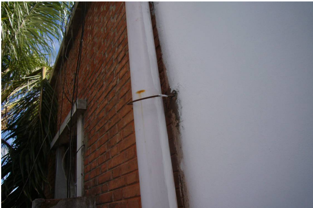
Foto 45. Inadecuada fijación de la cañería de desagüe
