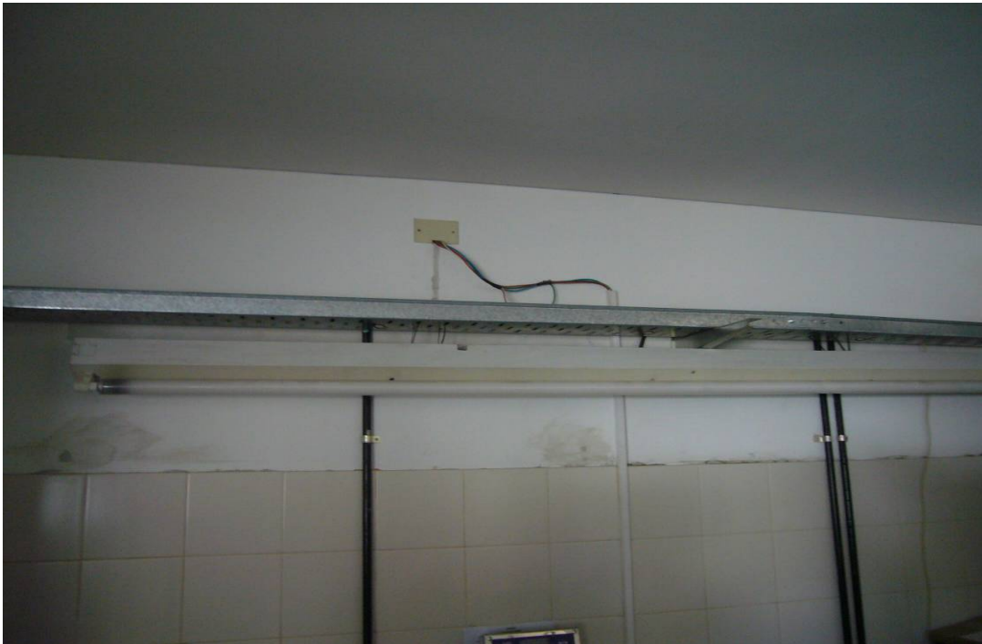
Foto 4. Conexiones eléctricas y revestimiento cerámico.
