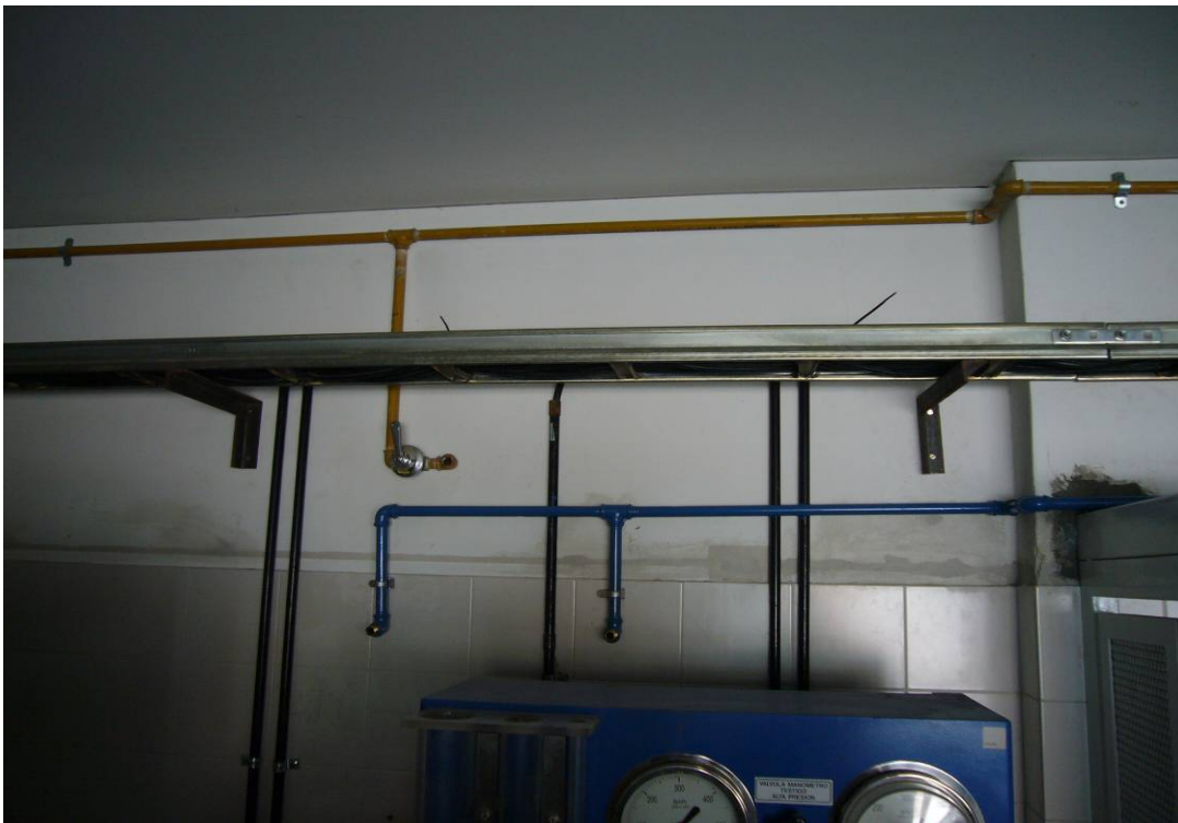
Foto 5. Instalación de gas fuera de reglamento e instalación de cañerías para nitrógeno (azul)
