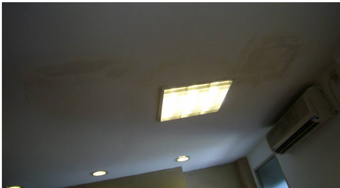
Foto 47. Filtraciones en el cielorraso bajo el nuevo techo
