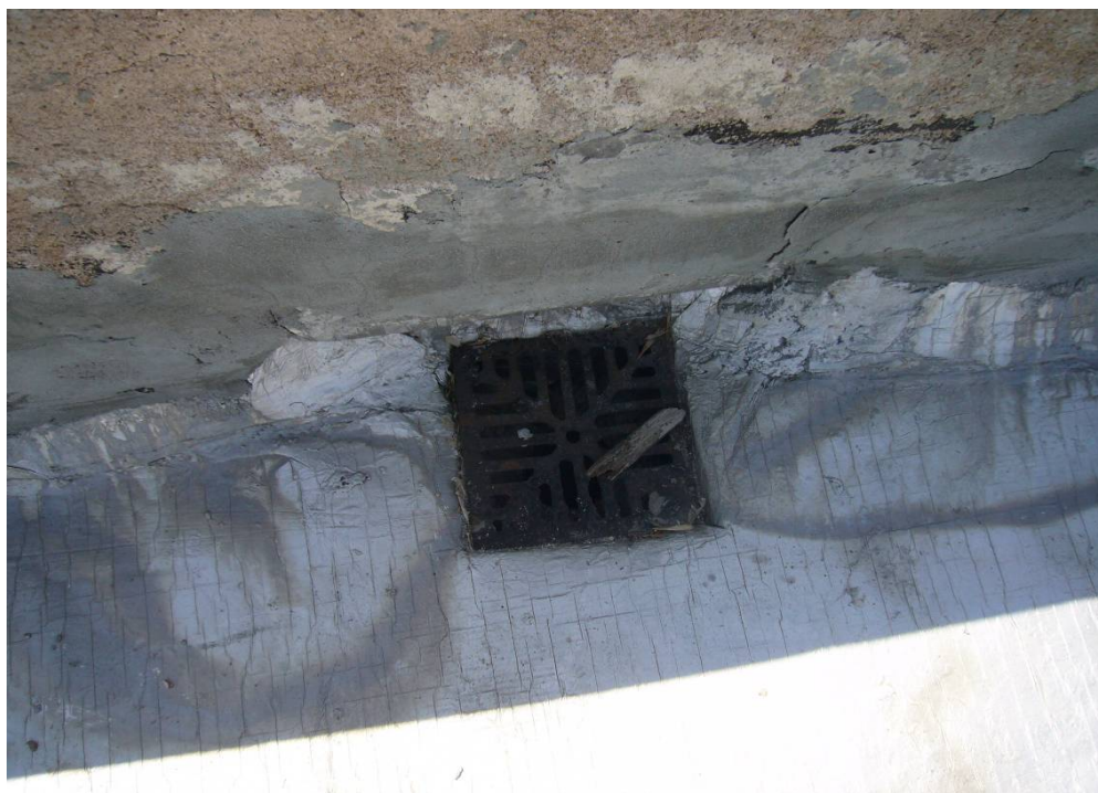
Foto 60. Rejilla sin reja de protección exigida por Pliegos.
