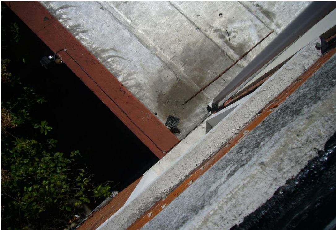
Foto 40. Desagüe a terraza vecina
