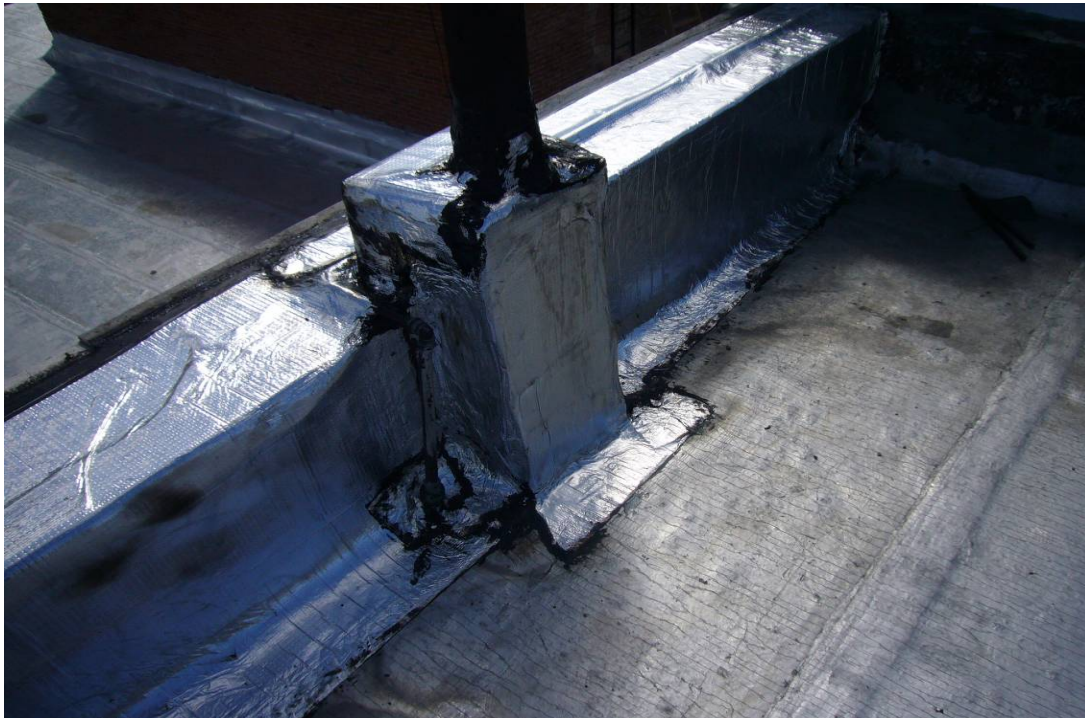
Foto 36. Muros revestidos en membrana. Reparaciones que no concuerdan con las reglas del arte.
