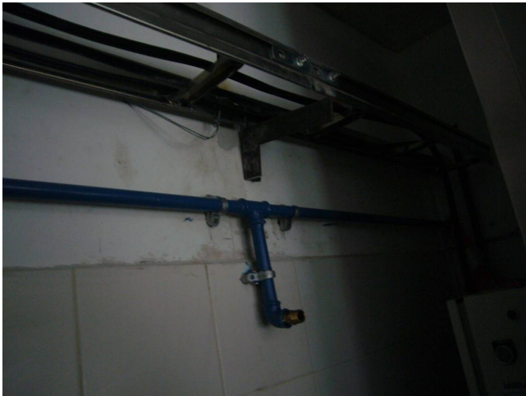
Foto 8. Instalación para nitrógeno
