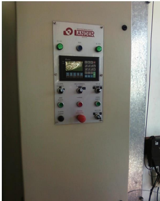
Foto N° 11: Vista de los controles del Puente.
