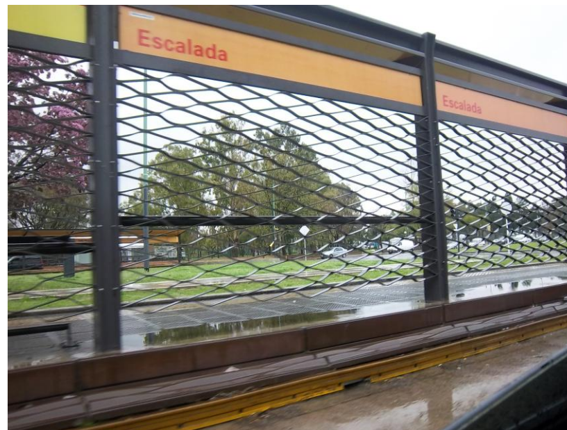
Foto N° 2 – Botazos rotos - Metrobús Corredor Sur
