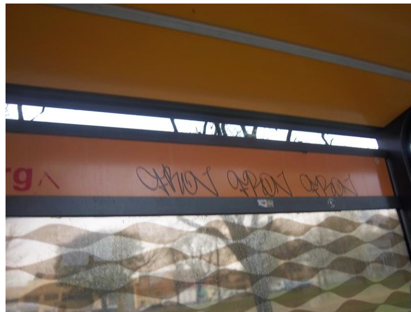
Foto 4 – Graffitis – Metrobús Corredor Sur
