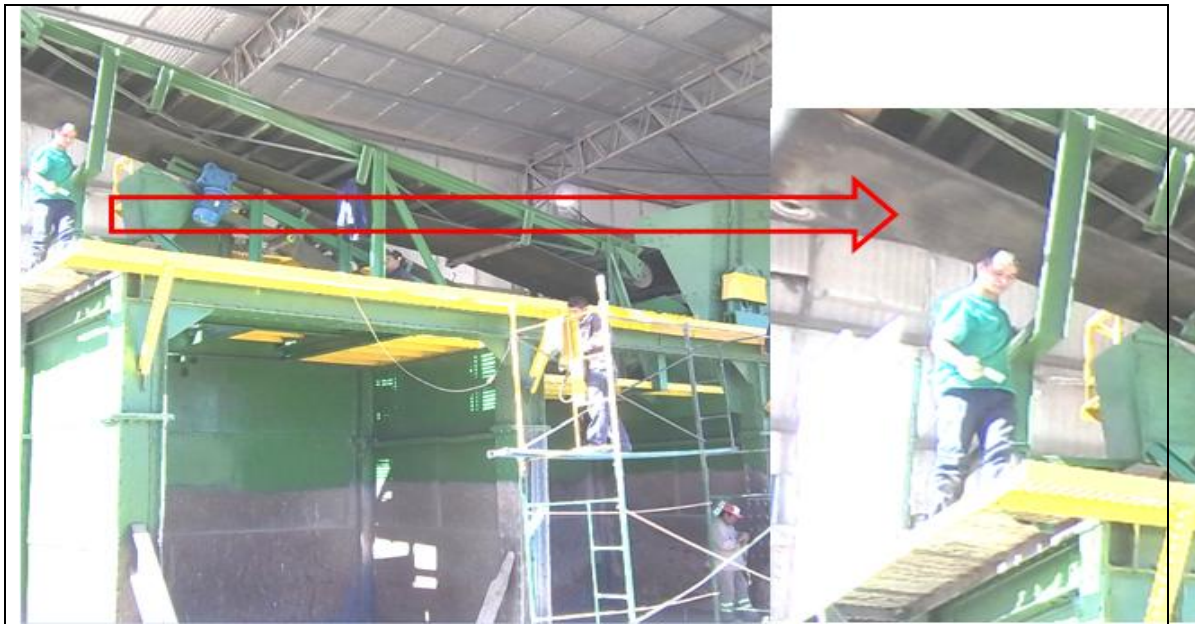
Foto N° 66. Sin casco, sin guantes, sin arnés
