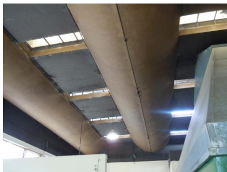
Falta de pintura
