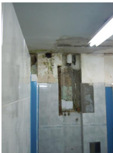
Baños en regular estado con muchas filtraciones
