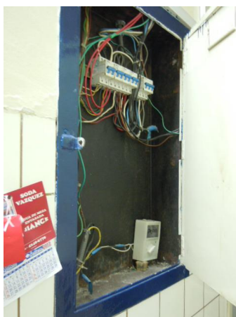
Instalación eléctrica en malas condiciones
