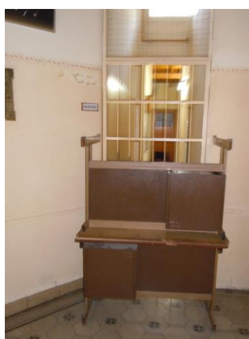
Salida de emergencia bloqueada
