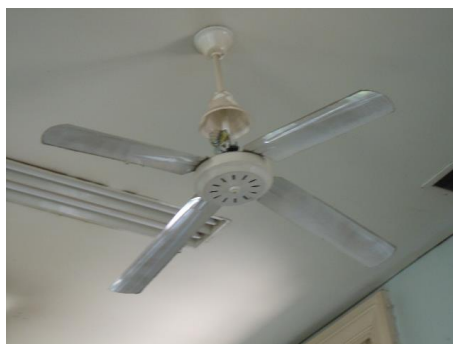
Ventiladores rotos – sala de estar y comedor en buen estado Gral.
