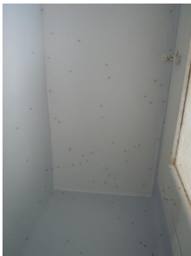
Gran cantidad de mosquitos por falta de mosquiteros
