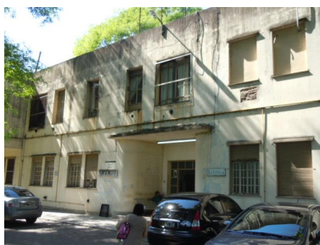
Exterior en malas condiciones de mantenimiento
