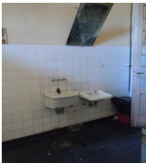
Baños en muy mal estado y obsoletos
