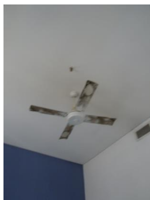
Ventiladores y luminarias muy sucios
