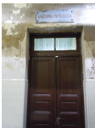
Lucarnas tapiadas, estado general de abandono
