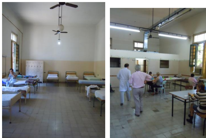
Dormitorios y salas de estar en regulares condiciones
