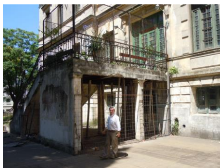
Losa de salida de emergencia con riesgo de colapso
