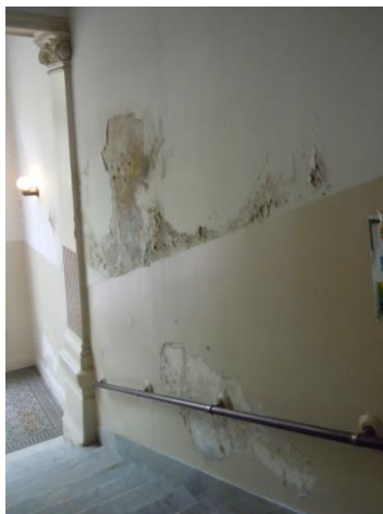
Humedades por filtraciones
