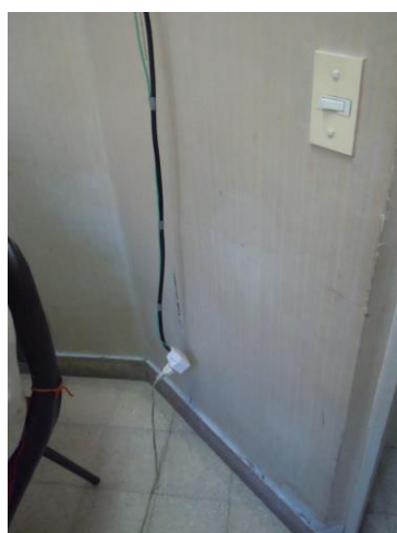
Instalación eléctrica en muy malas condiciones y muy antigua
