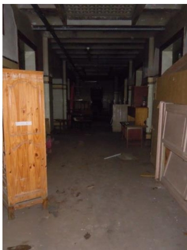
Subsuelo en un estado total de abandono
