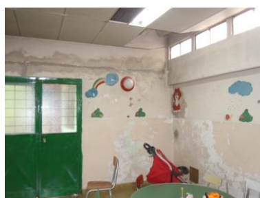
Filtraciones y humedades
