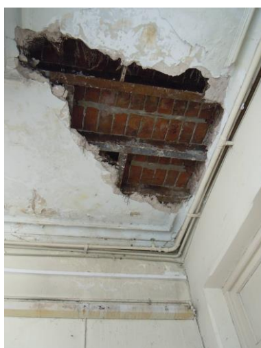
Carpinterías pandeadas, cielorrasos caídos
