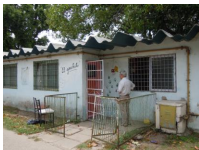
Exterior en malas condiciones
