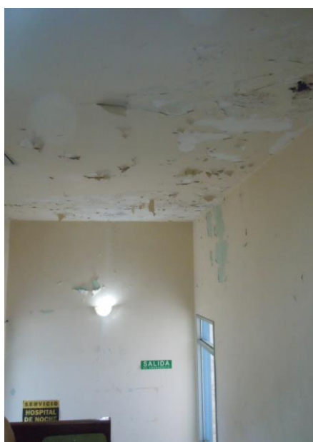
Filtraciones en caja de escalera y paredes
