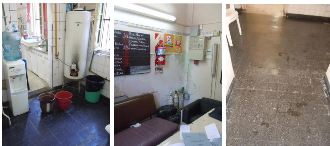
Office con goteras, filtraciones, baldosas flojas
