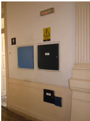
Instalación eléctrica en buenas condiciones
