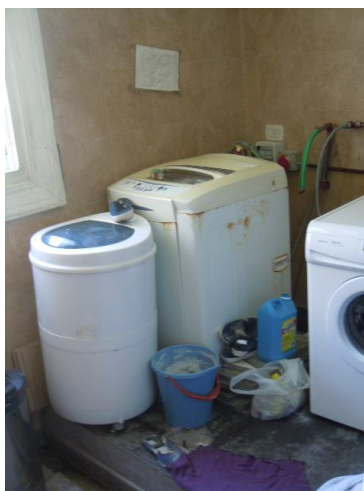
Lavadero general en regulares condiciones
