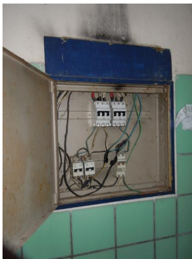
Instalación eléctrica en malas condiciones
