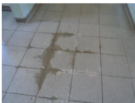
Humedades por filtraciones – cerámicas de piso flojas
