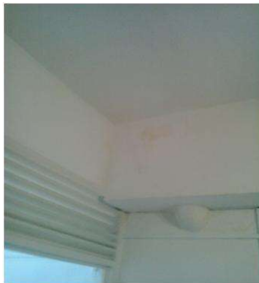
Foto N° 4: CESAC N° 9 Manchas de humedad y ausencia de aire acondicionado, lo que pudiera afectar la conservación de los medicamentos.
