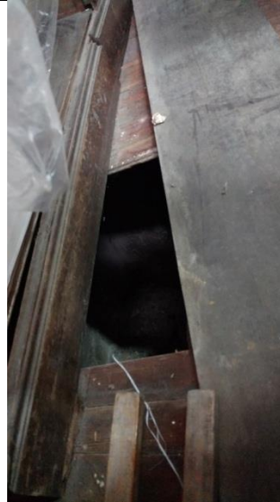
Biblioteca Antonio Devoto. Detalle de un agujero en el que se aprecia el espacio de unos 100cm entre los listones de madera y el piso del edificio.
