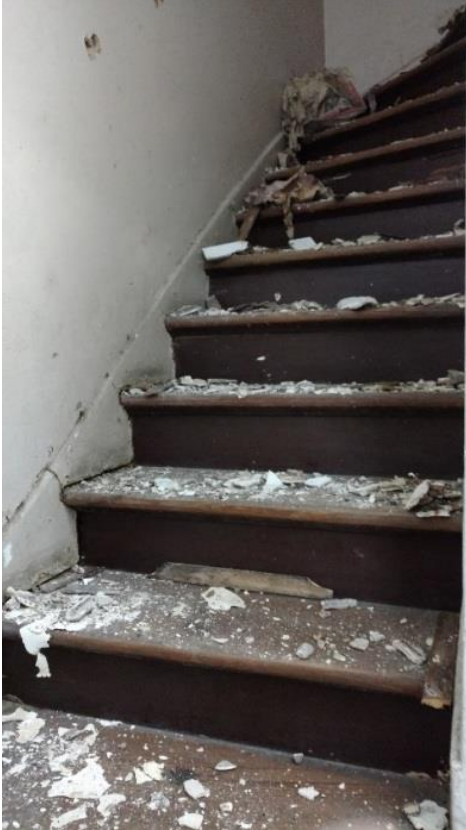
Biblioteca José Hernández. Vista de la escalera que da acceso a la sala de consulta desde la planta inferior. Se advierten los desprendimientos del material del techo.
