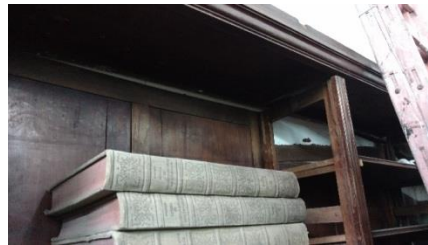
Biblioteca Antonio Devoto. El espacio (o luz) que se observa en el fondo de la estantería da cuenta de que el piso flotante ha cedido a su peso.
