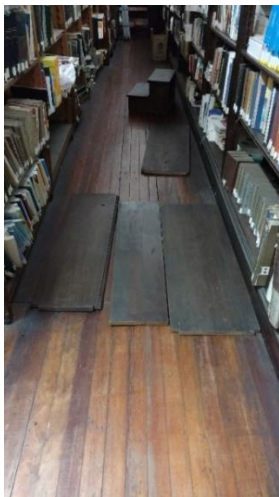
Biblioteca Antonio Devoto. Detalle del deterioro del piso de madera. En este caso, en los pasillos del librario.
