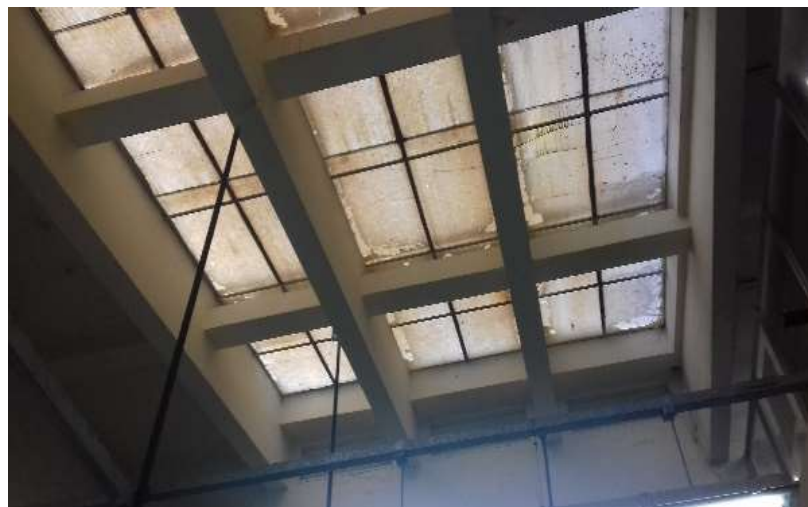
Taller de alumnos. Techo con goteras y problemas de filtraciones.
