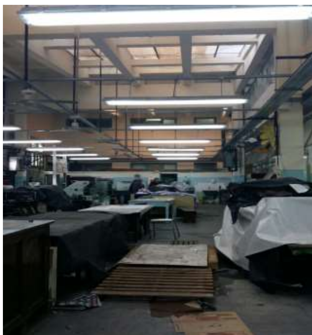
Taller de alumnos. Las maquinas deben ser cubiertas para que el agua que cae del techo los días de lluvia no caigan sobre las máquinas y las arruinen y sobre los alumnos. Piso lleno del agua que cae del techo.
