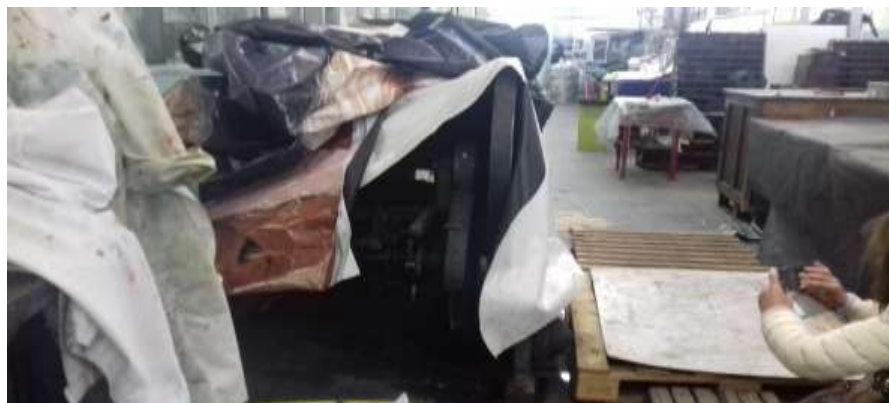
Taller de alumnos. Las maquinas deben ser cubiertas para que el agua que cae del techo los días de lluvia no caigan sobre las máquinas y las arruinen y sobre los alumnos.
