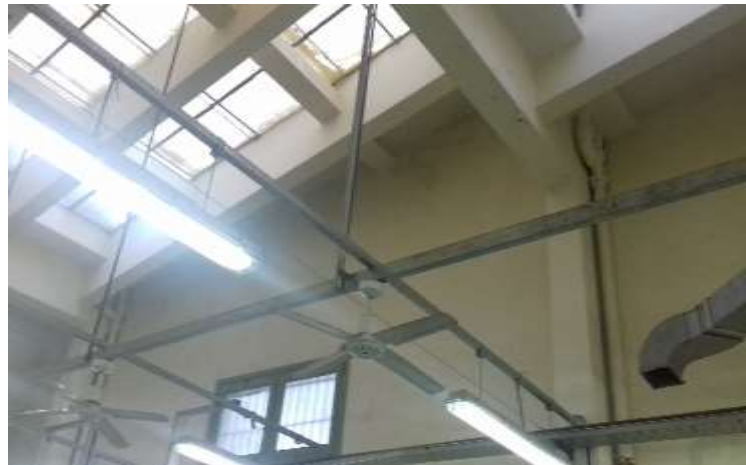
Lugar: Taller de alumnos. Taller de alumnos. Techo con goteras y problemas de filtraciones.
