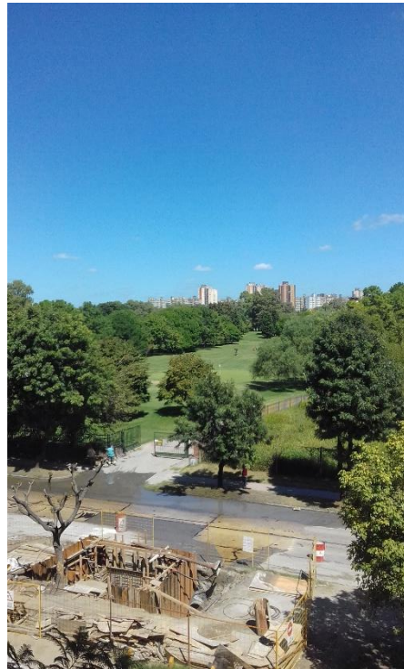
Cámaras de empalme pluvial Av. Escalada.
