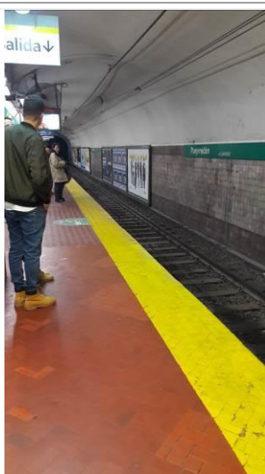
Foto N° 101 Línea D – Est. Pueyrredón Sobre borde de andén, no posee señalización horizontal para no videntes
