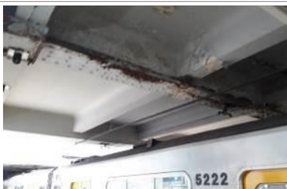
Foto N° 17 Línea C – Est. Retiro Desprendimientos en cielorraso
