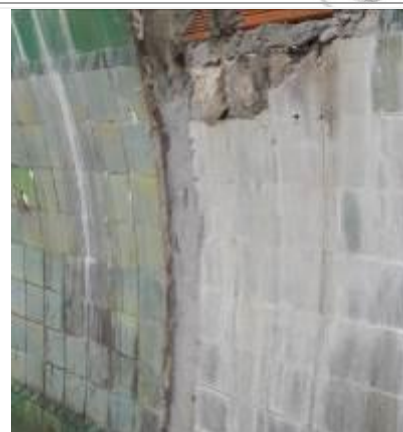
Foto N° 34 Línea E – Est. Jujuy Desprendimiento de revocos.
