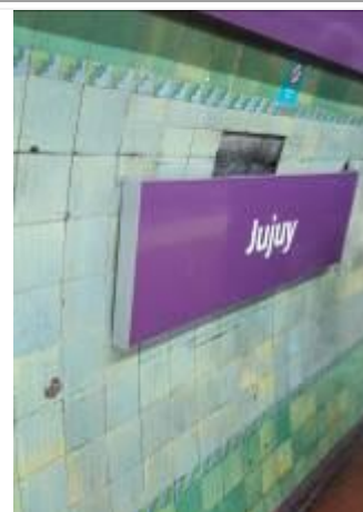
Foto N° 32 Línea E – Est. Jujuy En revestimiento falta cerámicos.
