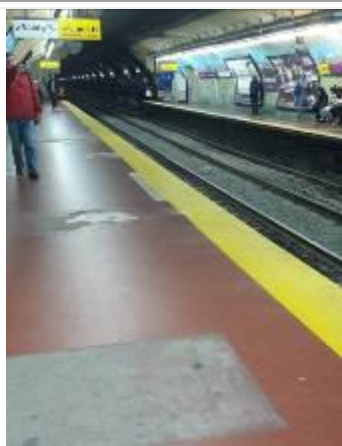
Foto N° 31 Línea E – Est. Jujuy Solados con parches
