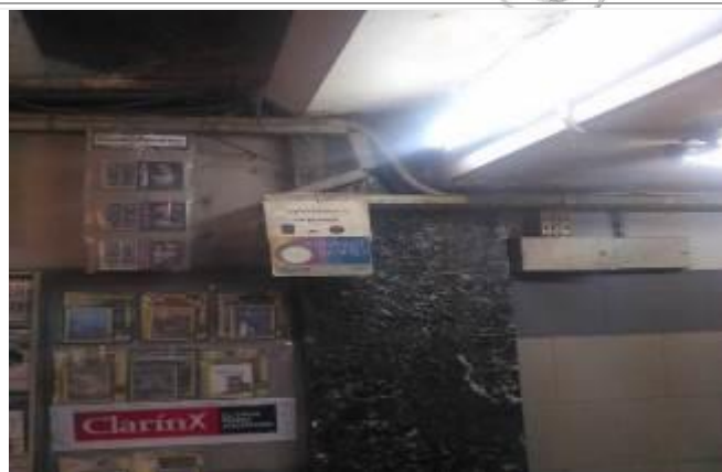
Foto N° 52 Línea C – Est. Constitución Artefactos de iluminación sin protección anti caídas y riesgo eléctrico
