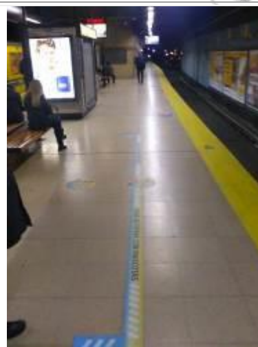
Foto N° 60 Línea E – Est. Virreyes Artefactos de iluminación sin protección anti caídas
