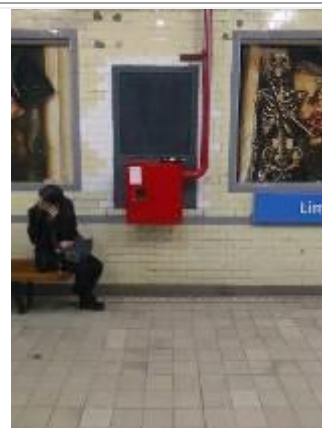
Foto N° 79 Línea A – Est. Lima Hidrante inaccesible en caso de emergencia
