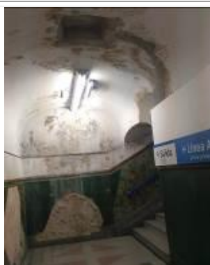
Foto N° 21 Línea C – Est. Avenida de Mayo Cielorraso cementado y falta de cerámicos en pared
