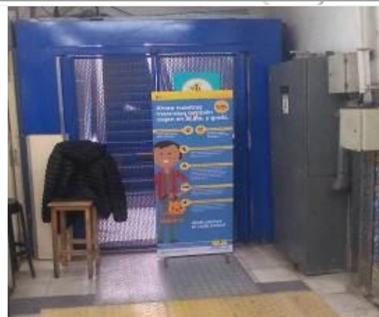
Foto N° 68 Línea C – Est. Diagonal Norte (Nudo C; D y B) Escalera mecánica fuera de servicio
