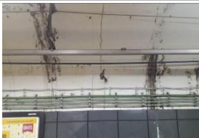
Foto N° 8 Línea B – Est. Carlos Pellegrini Superficies con humedad por filtración
