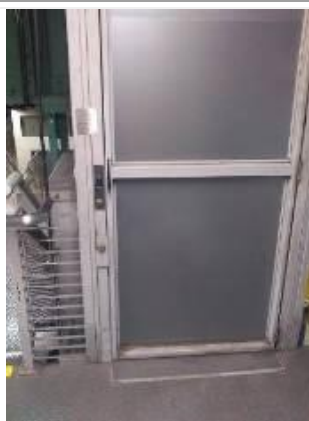
Foto N° 65 Línea A – Est. Plaza Miserere Monta carga sin funcionamiento
