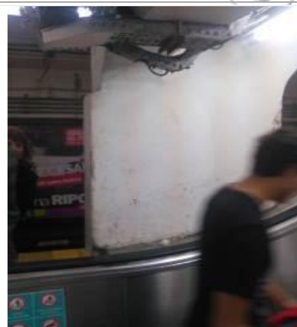
Foto N° 48 Línea B – Est. Pueyrredón Sobre escalera mecánica riesgo eléctrico.
