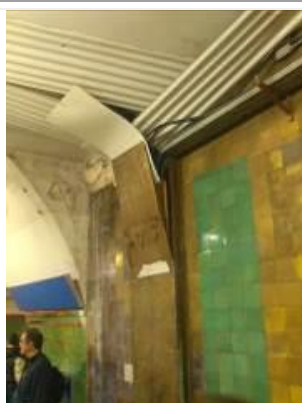
Foto N° 23 Línea C – Est. Avenida de Mayo Chapas por filtración en cielorraso y pared
