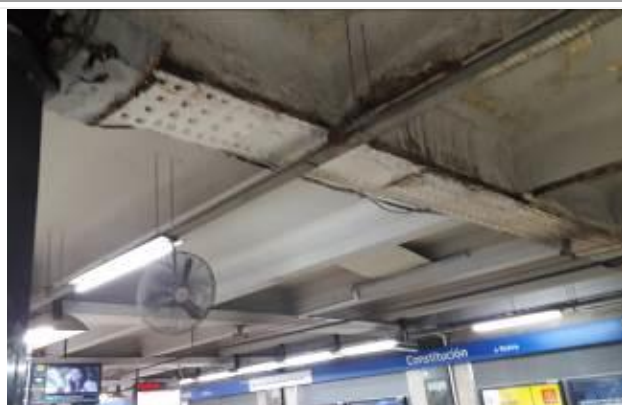
Foto N° 15 Línea C – Est. Constitución Sobre vías cielorrasos deteriorado por filtraciones.
