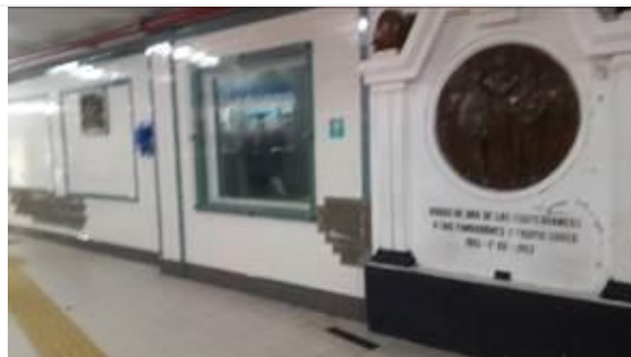
Foto N° 2 Línea A – Est. Plaza de Mayo Faltantes de cerámicos en mural de valor patrimonial
