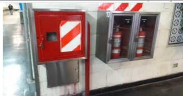
Foto N° 83 Línea D – Est. Congreso de Tucumán Hidrante con tapa inaccesible en caso de emergencia
