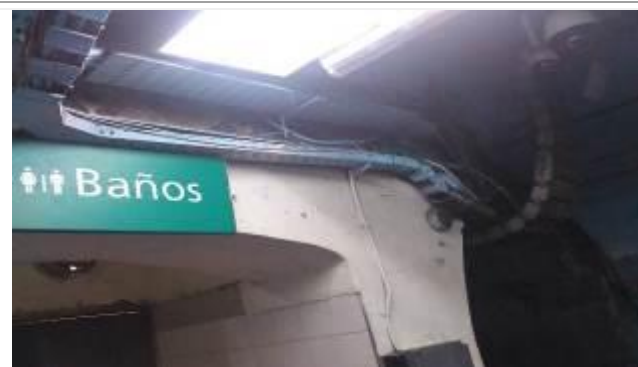
Foto N° 54 Línea D – Est. Catedral Artefactos de iluminación sin protección anti caídas y riesgo eléctrico
