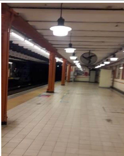
Foto N° 88 Línea A – Est. Lima Falta señalización horizontal para no videntes en andén
