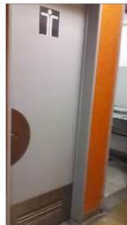
Foto N° 12 Línea B – Est. Juan M. de Rosas Sanitario H° cerrado c/llave
