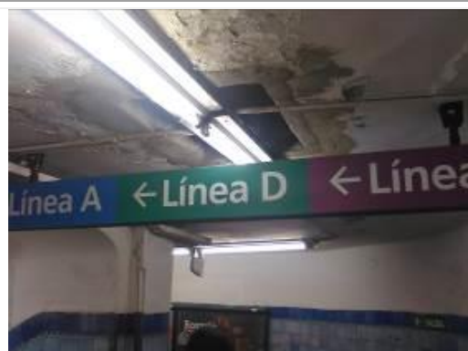
Foto N° 26 Línea D – Est. Catedral Cielorraso con parches cementicios
