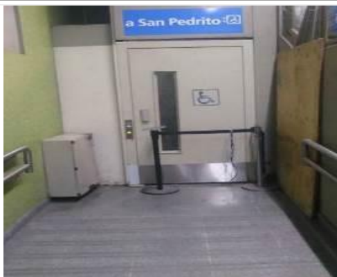
Foto N° 63 Línea A – Est. San Pedrito Ascensor Fuera de Servicio
