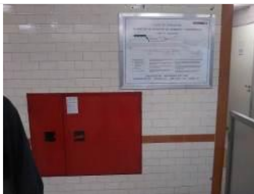
Foto N° 80 Línea A – Est. Perú Hidrante inaccesible en caso de emergencia
