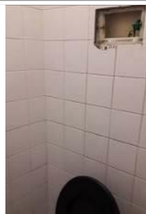
Foto N° 4 Línea A – Est. San Pedrito Sanitarios de Hombre y Mujer con depósito empotrado incompleto
