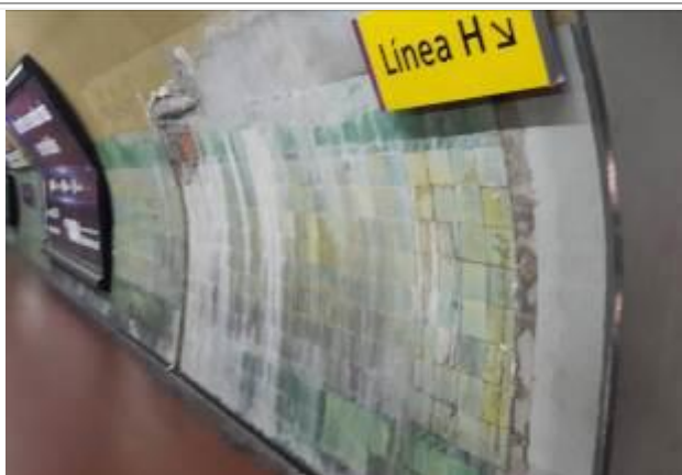
Foto N° 33 Línea E – Est. Jujuy Revestimiento deteriorado con salitre por humedad.
