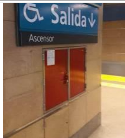
Foto N° 77 Línea A – Est. San Pedrito Hidrante con tapa inaccesible en caso de emergencia (Chapa y candado)
