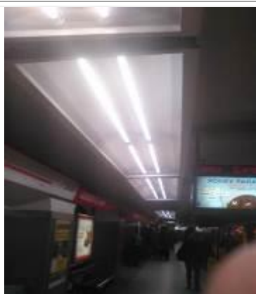
Foto N° 45 Línea B – Est. Leandro N. Alem Artefactos de iluminación sin protección anti caídas
