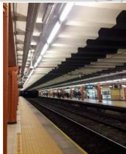
Foto N° 44 Línea A – Est. Lima Artefactos de iluminación sin protección anti caídas
