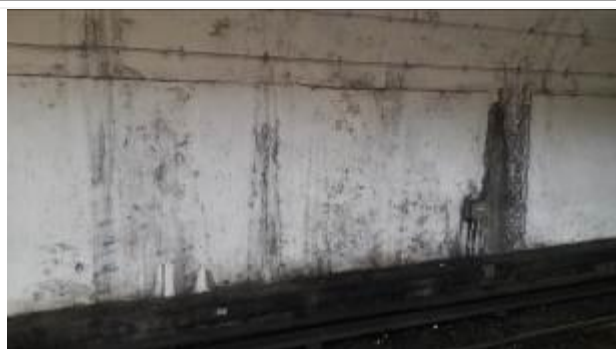
Foto N° 5 Línea B – Est. Leandro N. Alem Superficies manchadas por humedad
