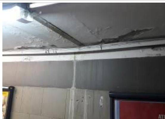
Foto N° 6 Línea B – Est. Leandro N. Alem Acceso con desprendimientos en cielorraso
