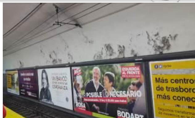
Foto N° 30 Línea D – Est. Pueyrredón Cielorraso con desprendimientos
