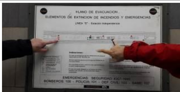
Foto N° 84 Línea E – Est. Independencia Faltan 4 (cuatro) matafuegos, según lo indicado en el plano de evacuación
