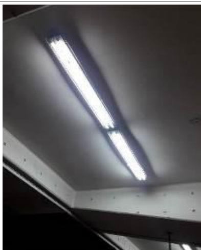
Foto N° 55 Línea D – Est. Congreso de Tucumán Artefactos de iluminación sin protección anti caídas
