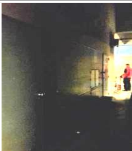
Foto N° 76 Línea A – Est. San Pedrito Hidrante de difícil acceso en zona en penumbra
