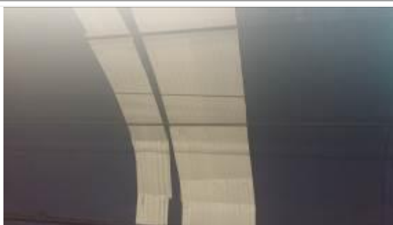
Foto N° 35 Línea E – Est. Bolívar Filtraciones cubiertas con chapa
