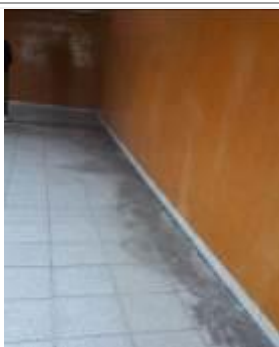
Foto N° 9 Línea B – Est. Juan M. de Rosas Piso con cerámica manchado
