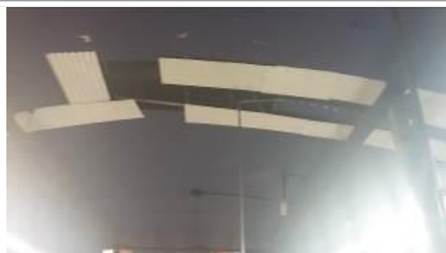
Foto N° 36 Línea E – Est. Bolívar Filtraciones cubiertas con chapa
