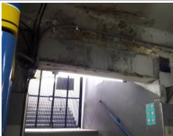
Foto N° 13 Línea C – Est. Constitución En acceso cielorrasos deteriorado por filtraciones
