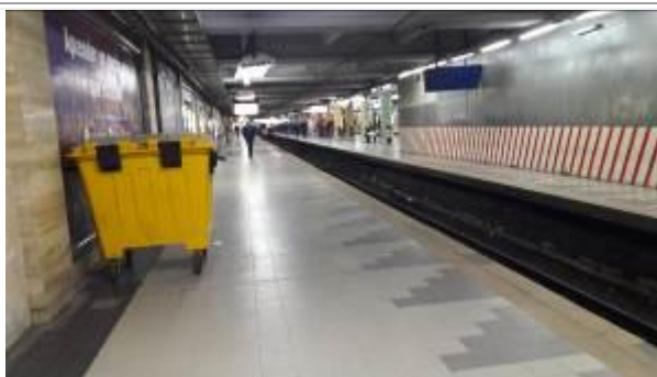
Foto N° 51 Línea C – Est. Retiro Artefactos de iluminación sin protección anti caídas
