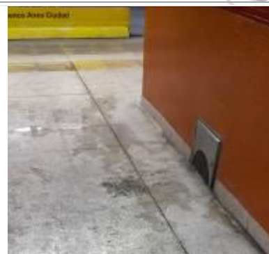
Foto N° 10 Línea B – Est. Juan M. de Rosas Piso resbaladizo
