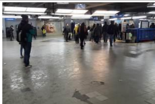
Foto N° 16 Línea C – Est. Retiro Piso Resbaladizo y con faltantes de cerámicos.
