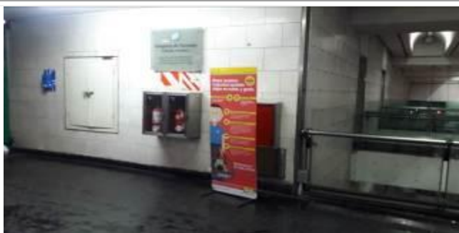
Foto N° 82 Línea D – Est. Congreso de Tucumán Hidrante inaccesible oculto detrás de cartel de propaganda.
