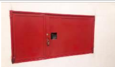
Foto N° 81 Línea B – Est. Juan M. de Rosas Hidrante con tapa inaccesible en caso de emergencia
