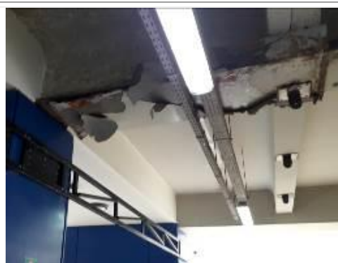
Foto N° 18 Línea C – Est. Retiro Desprendimientos en cielorraso
