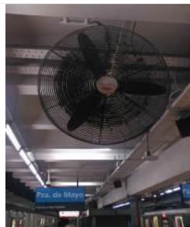
Foto N° 42 Línea A – Plaza de Mayo Artefactos de iluminación sin protección anti caídas y Ventilador con suciedad.
