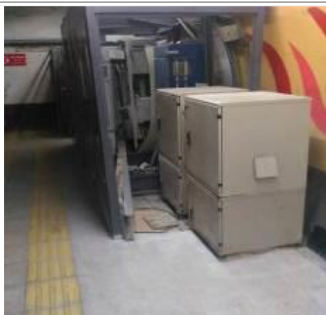
Foto N° 47 Línea B – Est. Pueyrredón Sobre andén riesgo eléctrico.
