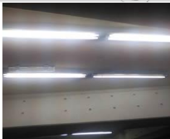
Foto N° 56 Línea D – Est. Congreso de Tucumán Artefactos de iluminación sin protección anti caídas
