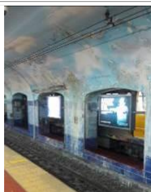
Foto N° 27 Línea D – Est. Catedral Cielorraso con parches cementicios
