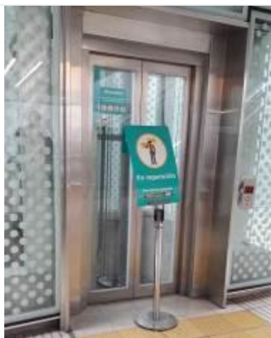
Foto N° 69 Línea C – Est. Retiro Ascensor fuera de servicio, por encontrarse en reparación
