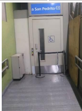
Foto N° 90 Línea A – Est. San Pedrito Falta señalización horizontal para no videntes hacia ascensor.
