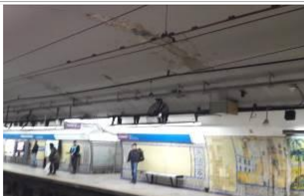
Foto N° 19 Línea C – Est. Independencia Sobre andén desprendimiento de cielorraso por filtraciones
