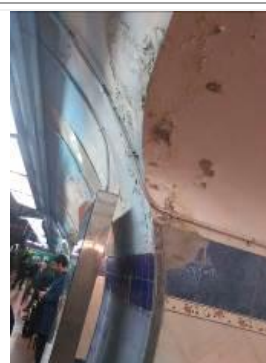
Foto N° 28 Línea D – Est. Catedral Cielorraso con desprendimientos
