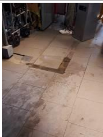
Foto N° 7 Línea B – Est. Leandro N. Alem Piso resbaladizo y solado con faltante de cerámico
