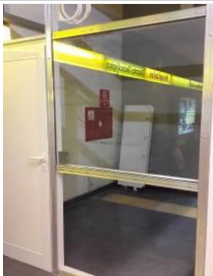
Foto N° 86 Línea H – Est. Hospitales Hidrante inaccesible en caso de emergencia
