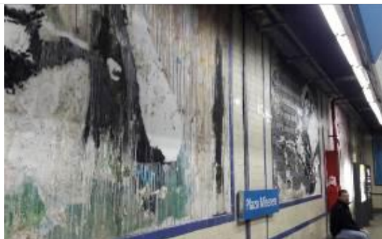
Foto N° 1 Línea A – Est. Plaza de Miserere Paneles de propaganda vandalizado con grafiti
