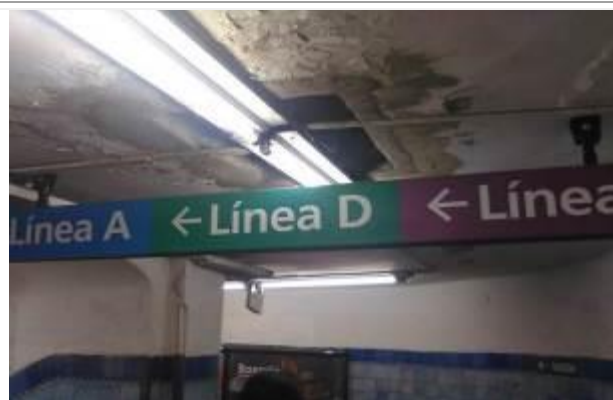
Foto N° 53 Línea D – Est. Catedral Artefactos de iluminación sin protección anti caídas
