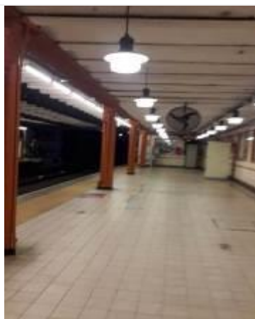
Foto N° 41 Línea A – Est. Perú Artefactos de iluminación sin protección anti caídas
