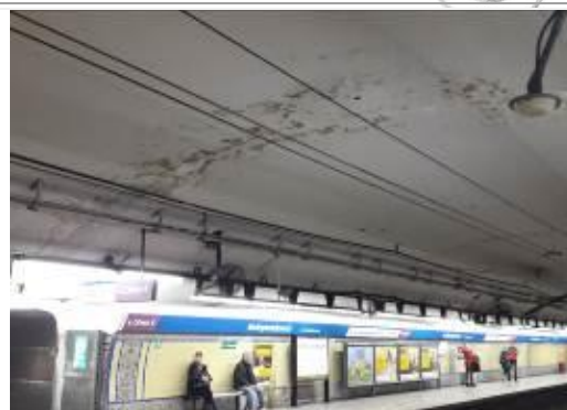
Foto N° 20 Línea C – Est. Independencia Sobre andén desprendimiento de cielorraso por filtraciones
