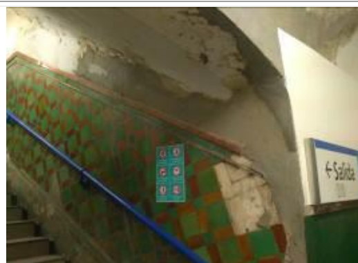
Foto N° 22 Línea C – Est. Avenida de Mayo Cielorraso cementado y falta de cerámicos en pared
