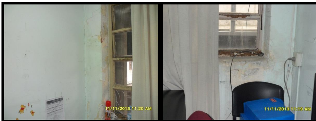
Paredes deterioras Área jurídica Familias en Sit. de Calle
