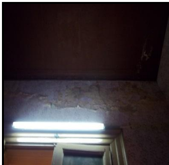
Humedad en habitación
