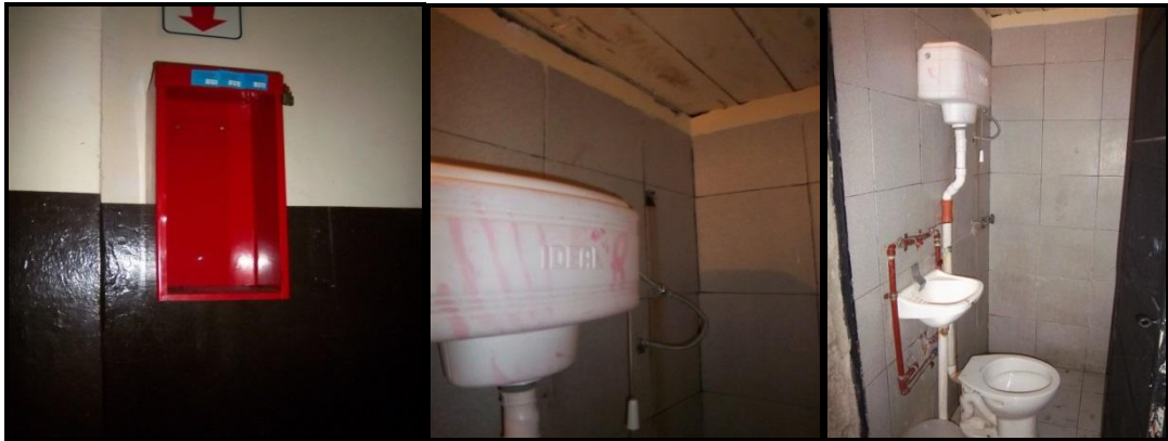
Falta de matafuegos
