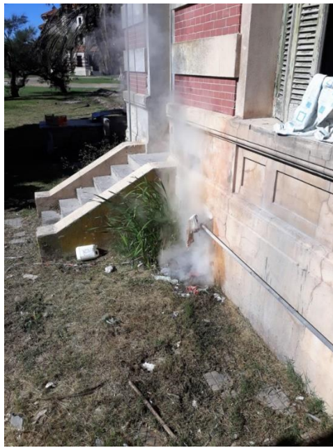
Foto 6: Fugas de vapor
