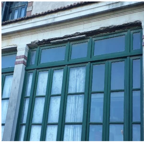
Foto 4: Mal estado de conservación dinteles Pabellón 1
