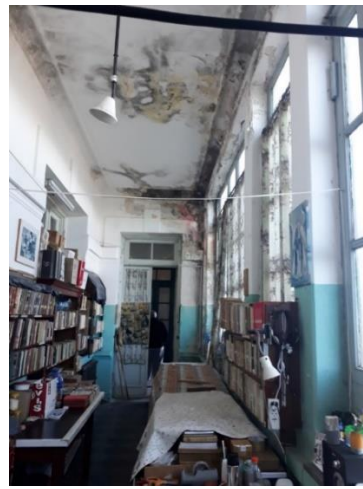
Foto 5: manchas de humedad en sector biblioteca
