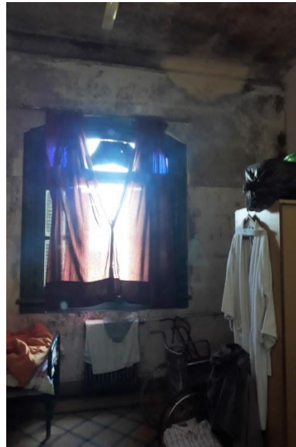
Foto 7: Pared afectada por humedad en dormitorios
