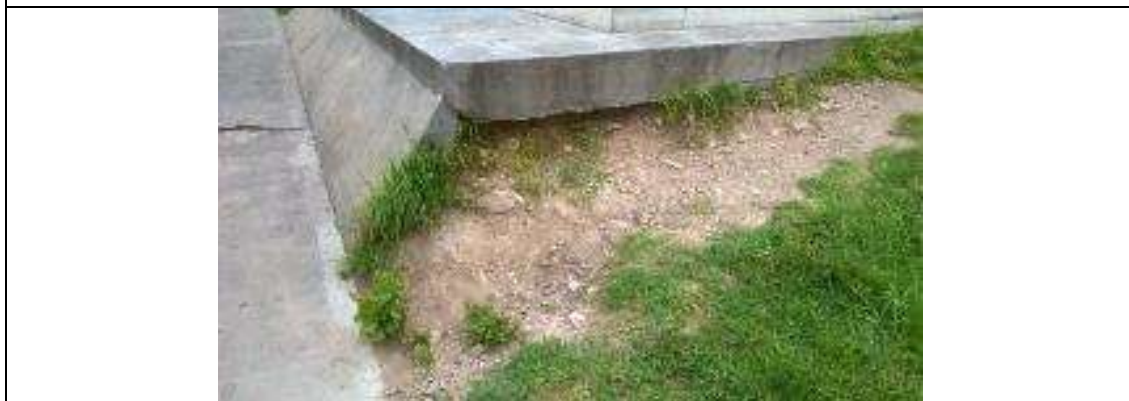
Falta de mantenimiento y deterioro del espacio público.
