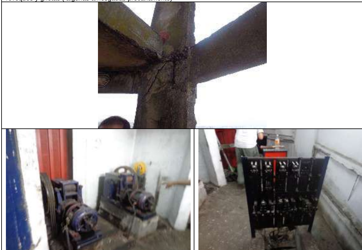
Sala de ascensores sin mantenimiento y con riesgos de electrocución por contactos eléctricos expuestos.
