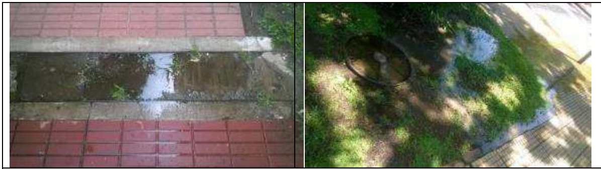
Anegamiento de agua por falta de escurrimiento.
