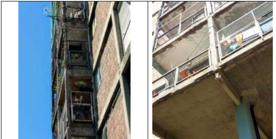
Edificio Torre: En los marcos de hormigón y ángulos externos de las losas desprendimientos por fallas de origen. Balcones: Hierros expuestos por desprendimiento del Hormigón. Barandas: inseguras por oxidación.
