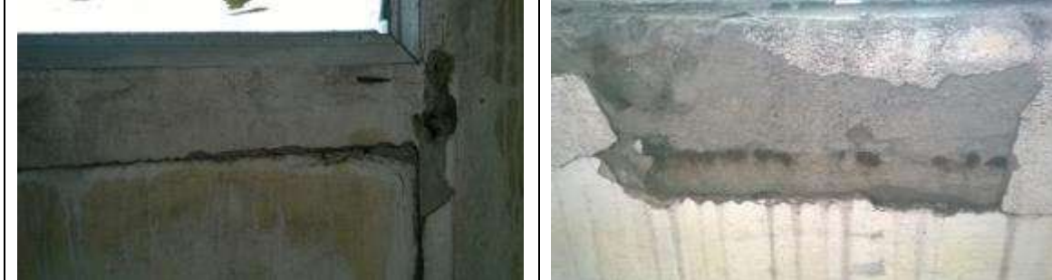
Las circulaciones verticales de escalera y ascensores han sido cerradas al exterior por falta de funcionalidad en el diseño original. Esto ha incrementado la oxidación de partes metálicas por impedimento del escurrimiento natural y fueron afectados los hormigones estructurales y no estructurales.
