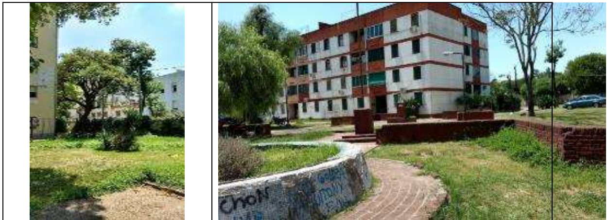
Roturas y vandalismo en muros-asiento. Bajo mantenimiento de espacios verdes y veredas.
