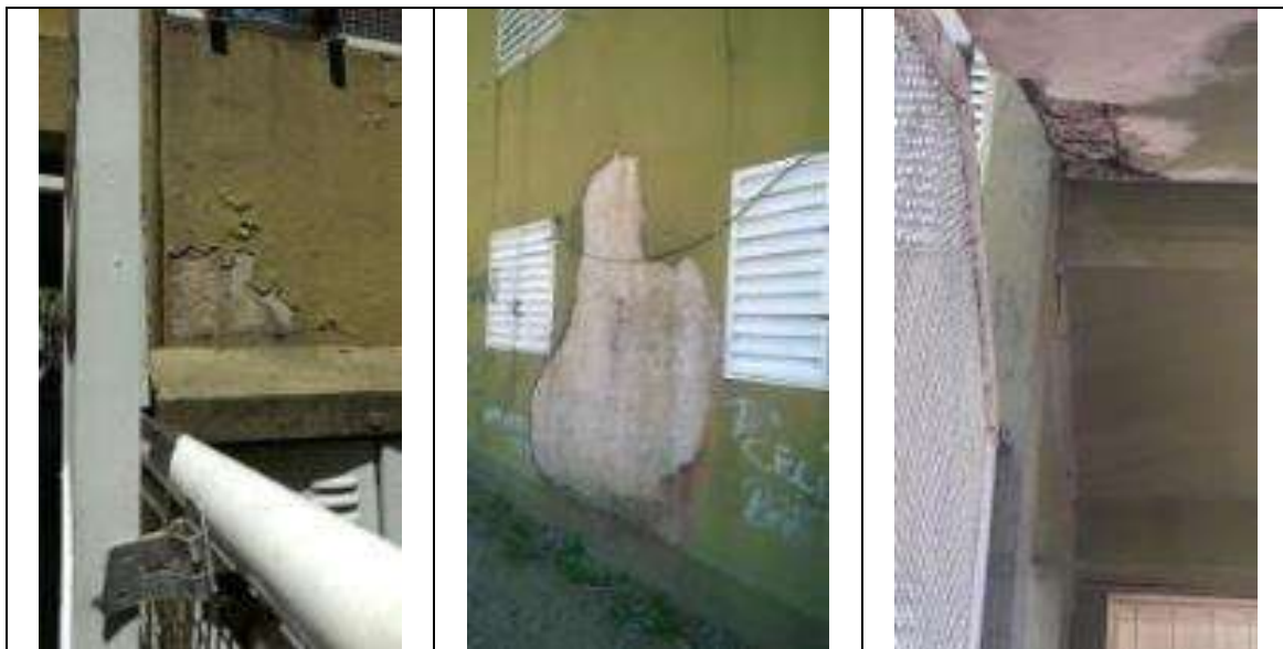
Desprendimientos de revoques.
