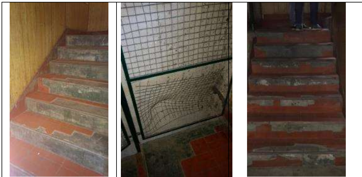
Escaleras: falta de cerámicos y cerramiento protector caída (a modo de baranda) se encuentra rota.
