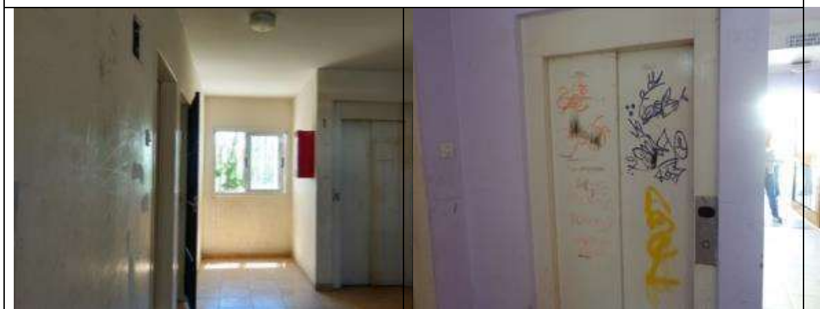
No hay ascensor: Aunque se realizó el hueco, nunca fue instalada la caja del ascensor ni la maquinaria. Vandalismo en pintura.
