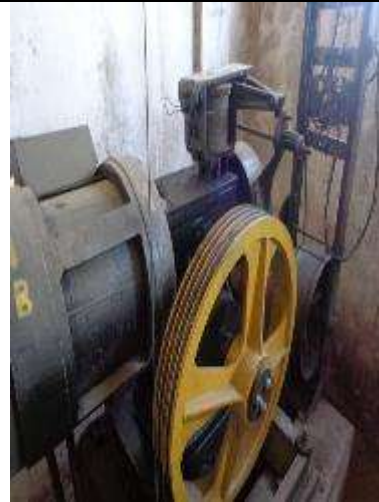
Deterioro en motores de ascensores en Torre
