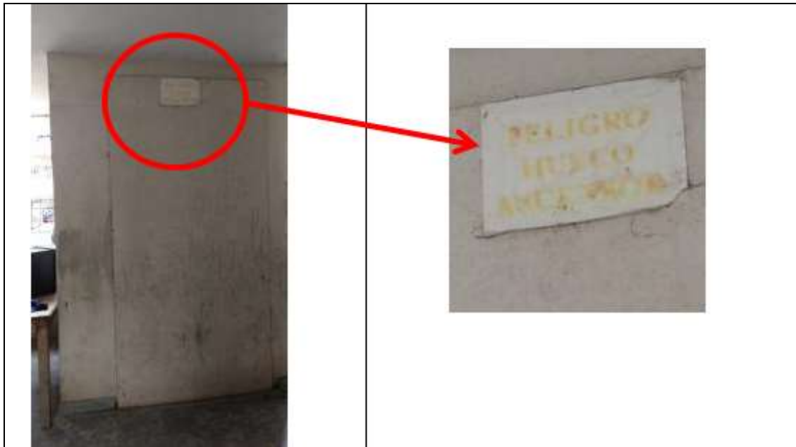
Los ascensores no fueron instalados en el barrio. Con placas de fenólico se tapiaron los huecos de ascensores.
