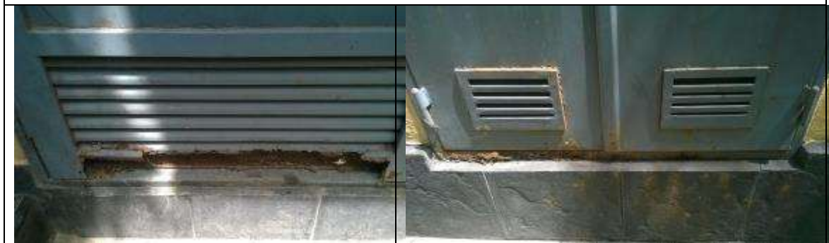
Oxidación en puertas / tapas de cabinas de servicios.
