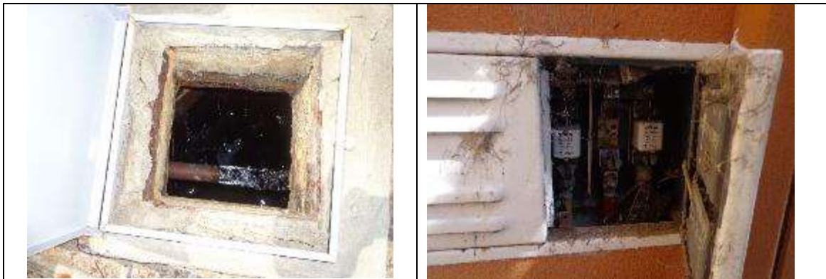
Falta de mantenimiento en cabina eléctrica y riesgo de contaminación en tanque de reserva
