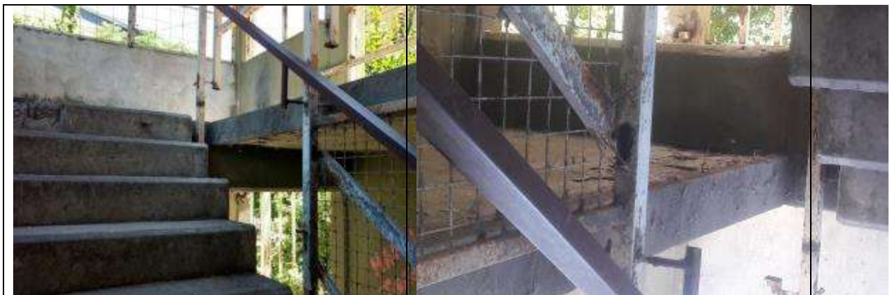
Se verificó en baranda escalera, ausencia de malla protectora de caída para niños.
