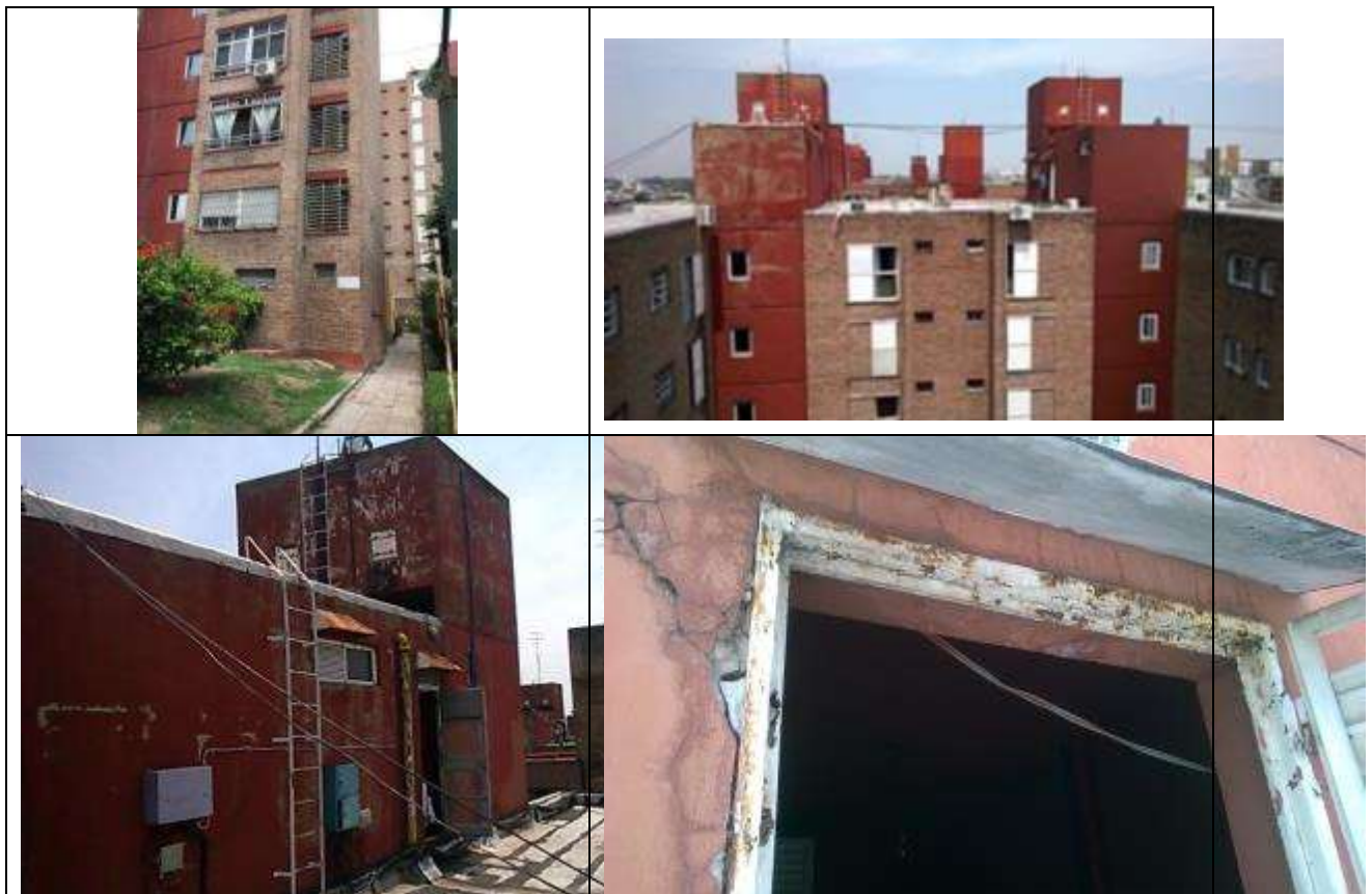
Azotea: De ladrillo recubierta con membrana. Se verificó oxidación en aberturas.
