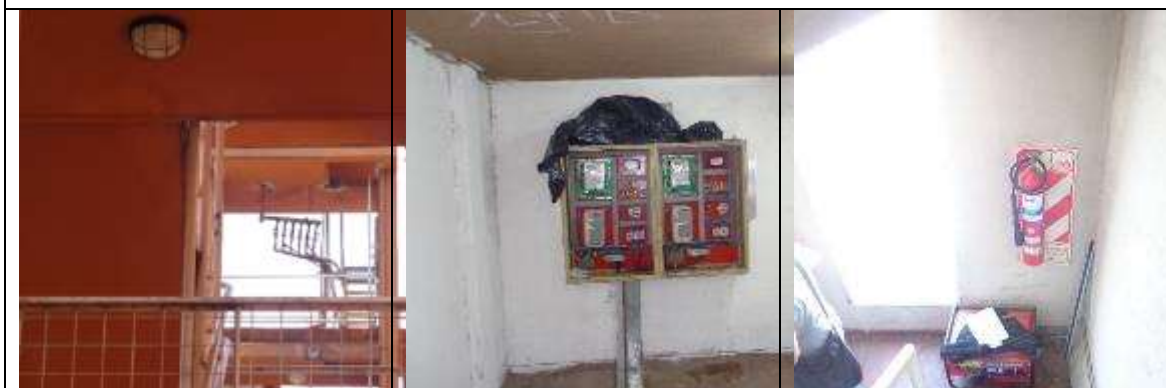
Barandas en mal estado. Riesgo de incendio en Sala de ascensores y falta de un sistema de red de incendio.
