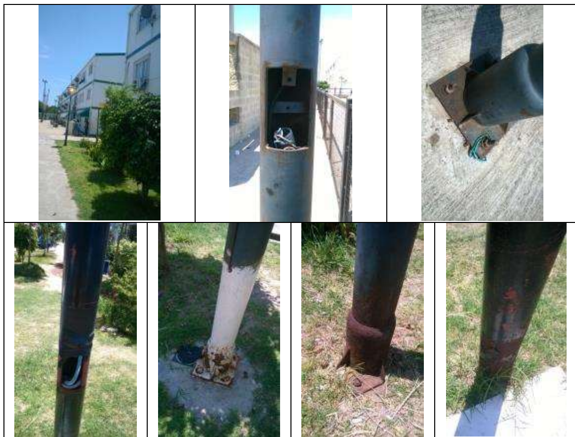
Espacio exterior: Columnas de alumbrado exterior con luces encendidas durante el día, cables expuestos y bases oxidadas.
