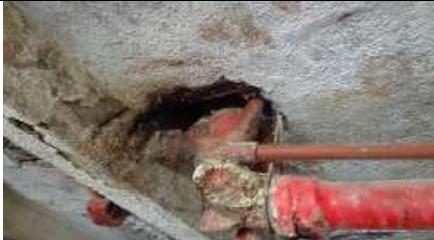
Perdidas en instalaciones de agua que pueden albergar vectores.
