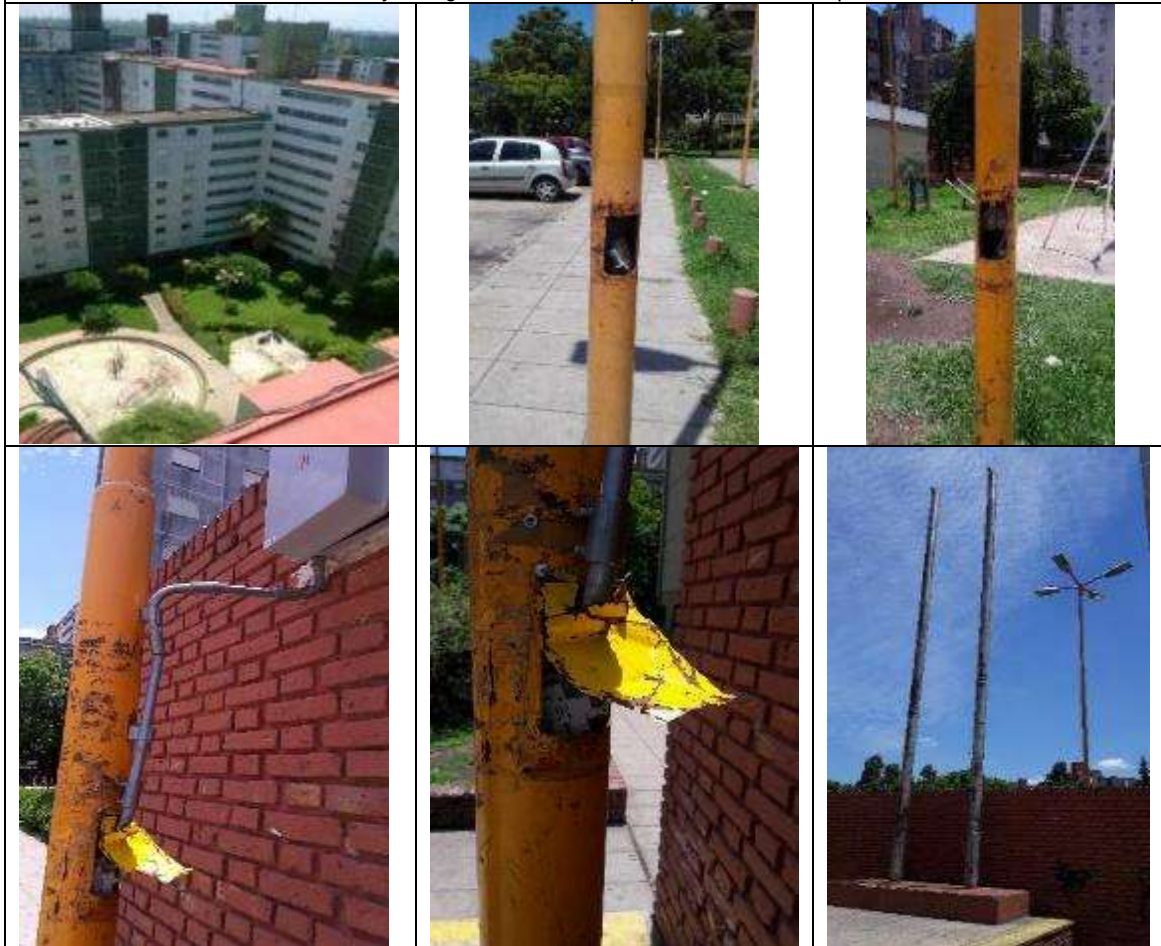
Instalación eléctrica clandestina y falta de tapas en columnas de alumbrado. Riesgo eléctrico.
