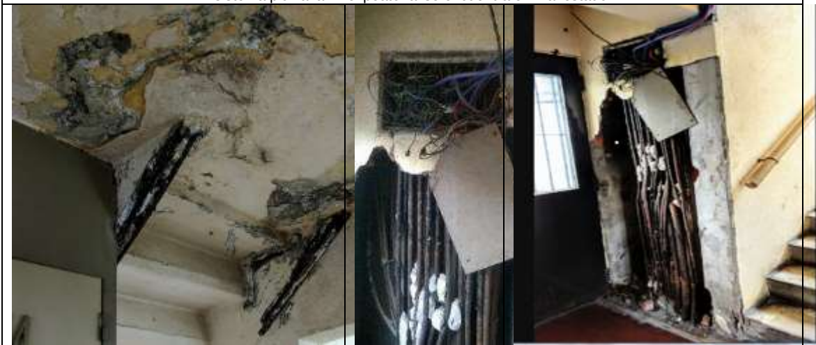
Montantes eléctricos abiertos y expuestos. Caños rotos o con pérdidas con gran circulación de agua por paredes y montantes.
