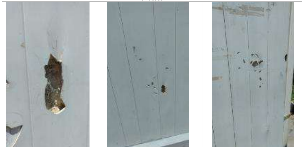
Sistema constructivo: Paneles Plasticos rellenos, se verificó roturas del mismo.
