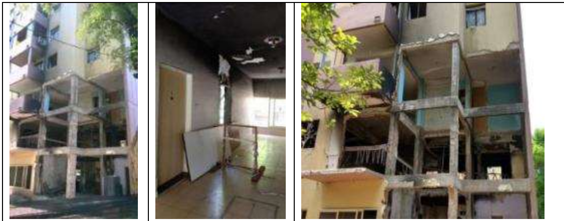
En un edificio del complejo departamento incendiado. Se verificó que los daños producidos abarcan 3 (tres) niveles del edificio.
