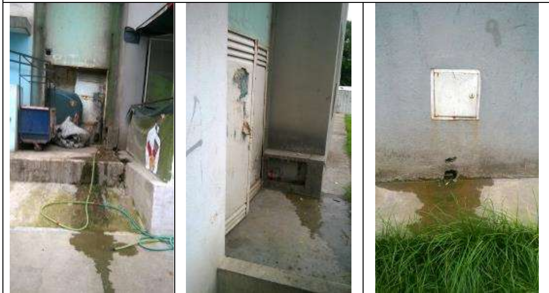
Filtraciones de canillas de servicio en planta Baja.
