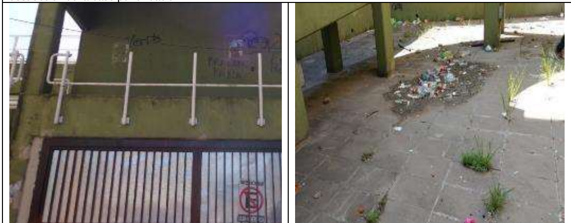
Barandas rotas y riesgo de caída. Falta de limpieza adecuada. Basura desparramada en espacio común
