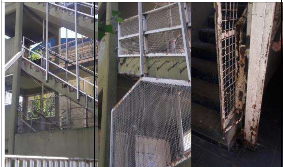
Escaleras: Ausencia de mantenimiento Cerramiento en los laterales de los escalones impidiendo el drenaje de agua. - Barandas rotas y oxidadas – En barandas, ausencia de protección, con riesgo de caída de niños.
