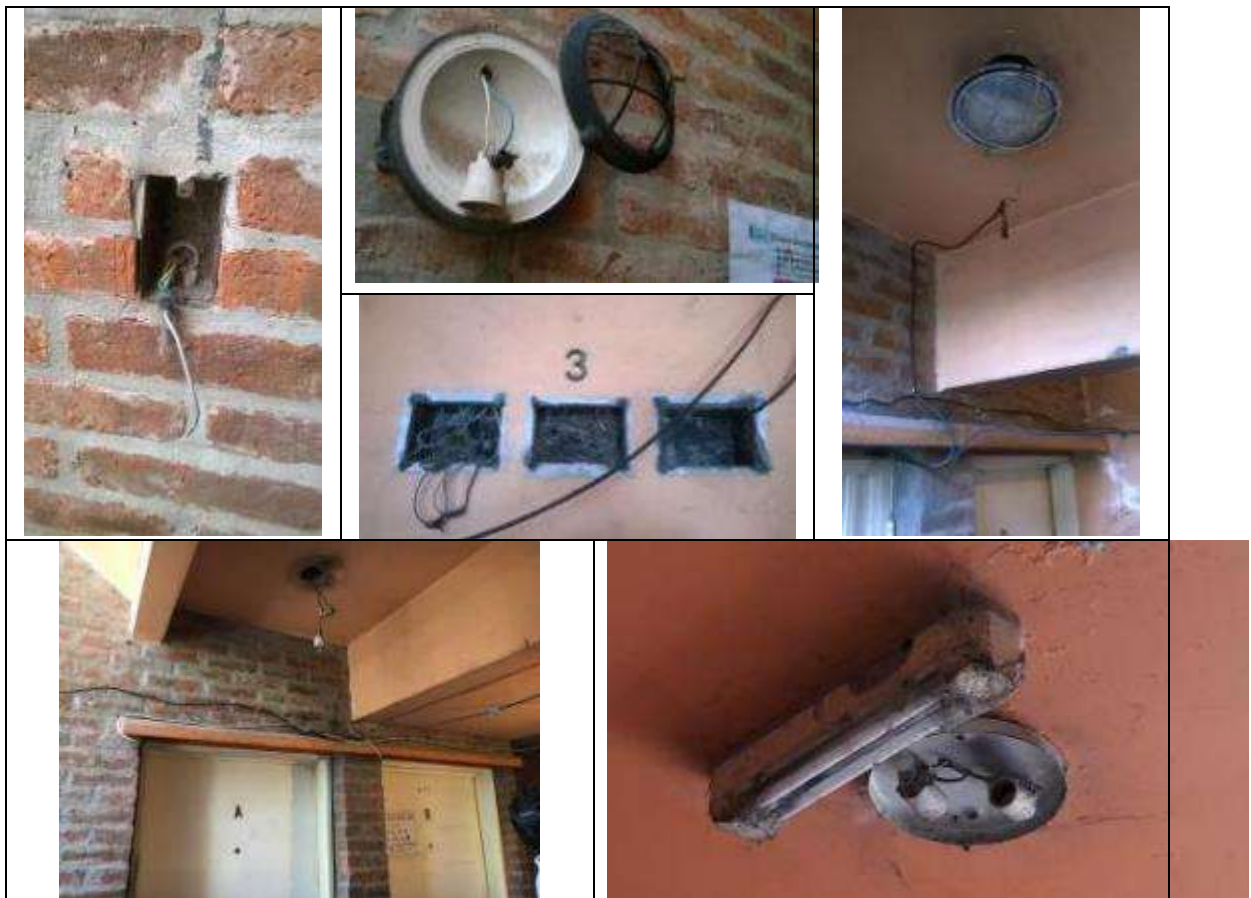
Vandalismo en artefactos de iluminación, artefactos sin luminarias, cables expuestos y ausencia de tapas protectoras en cajas de luz.
