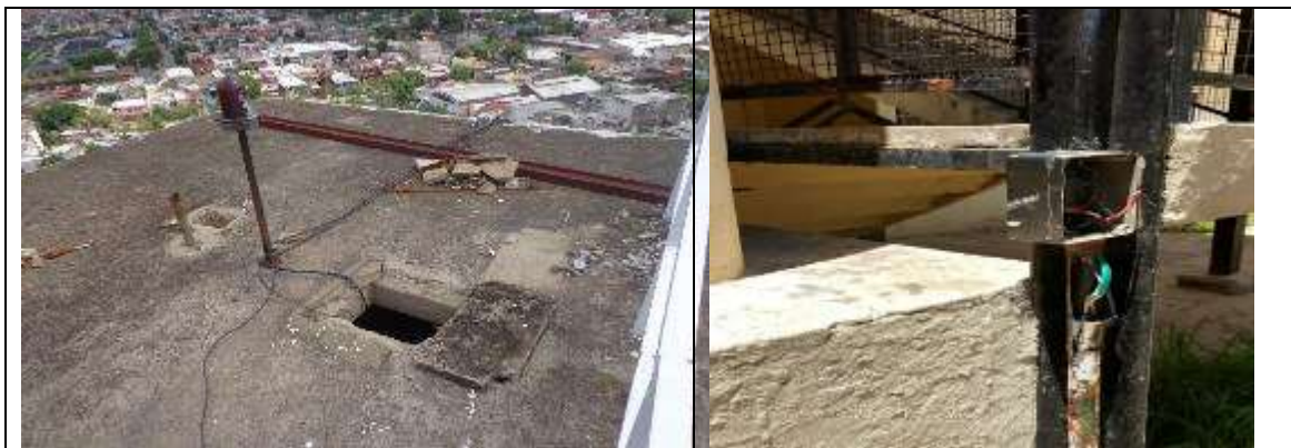
Tanques de agua sin trabajos de limpieza.
