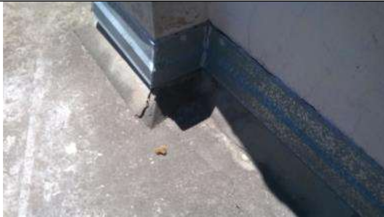
Techos de chapa y membrana en núcleos de escaleras y tanques. Se visualizan fisuras sobre carpeta.
