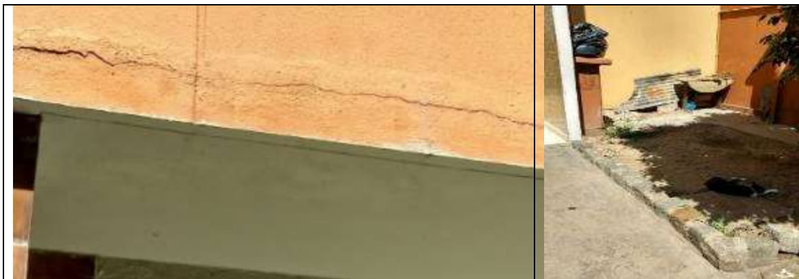
Rajaduras en fachadas y precariedad en espacio público.
