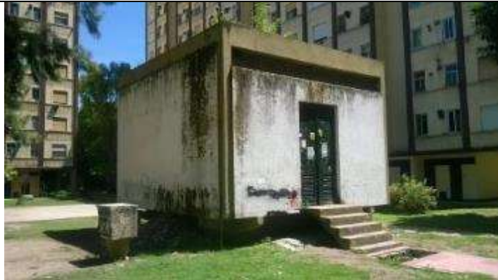
Escombros amontonados en sector de cámara de electricidad.
