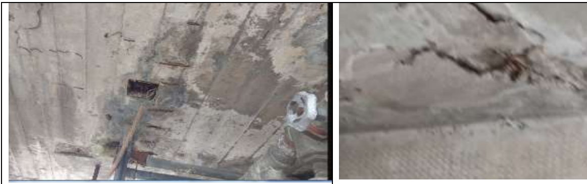
Fisuras en el Hormigón, desprendimiento de revoque que deja herradura a la vista.
