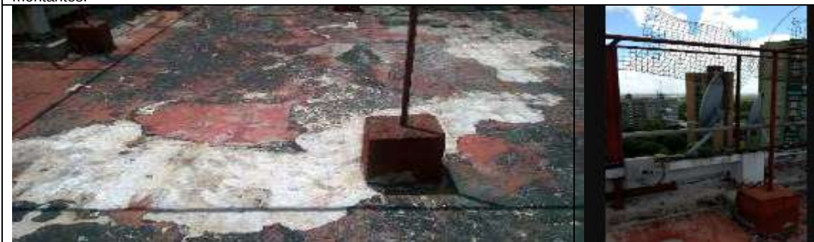
Las terrazas necesitan renovar su impermeabilización y muestran la vandalización de los alambros de protección por parte de las empresas de distribución del servicio de televisión.
