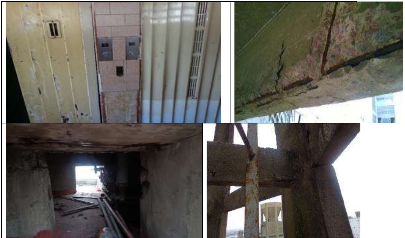
Basura debajo del tanque de agua y deterioro de la estructura de los mismos, mostrando fisuras, desprendimiento de revoques y grietas ( algunas arriesgadas precariamente)
