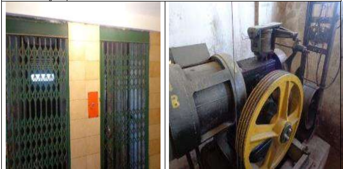
Deterioro en motores ascensor y ascensores sin funcionar
