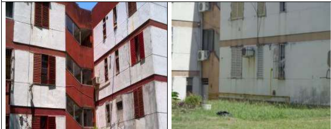
Celosías de madera afectadas por el paso del tiempo y la falta de mantenimiento.
