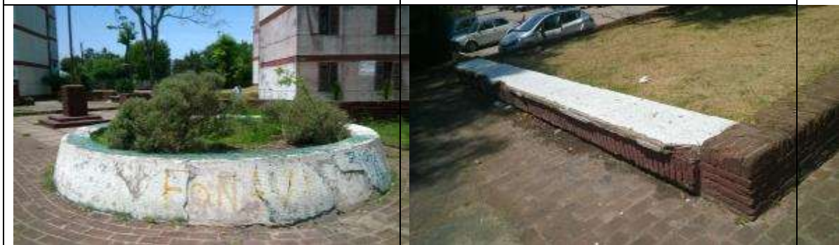
Falta de mantenimiento: bancos, canteros y cercos.
