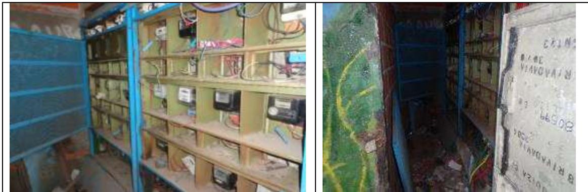
Sala de medidores de electricidad con tableros obsoletos y riesgos de electrocución.
