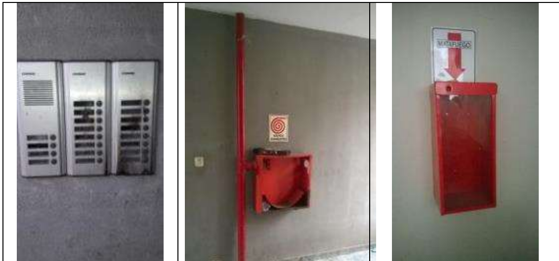
Vandalismo Portero electrico y matafuegos e hidrantes.
