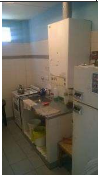
En cocina comunitaria caldera dual sin funcionamiento
