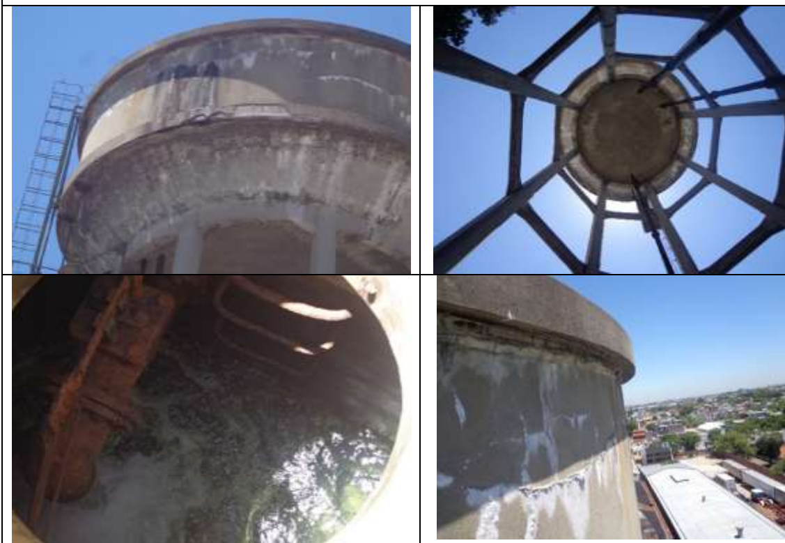
Detalle de la torre tanque donde se verifican las filtraciones ( acumulación de salitre)
