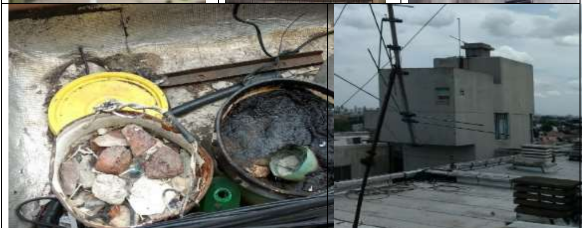
Se visitó la terraza de la torre xxx encontrándose arreglos y acumulación de basura, antenas de tv directamente sobre la cubierta.
