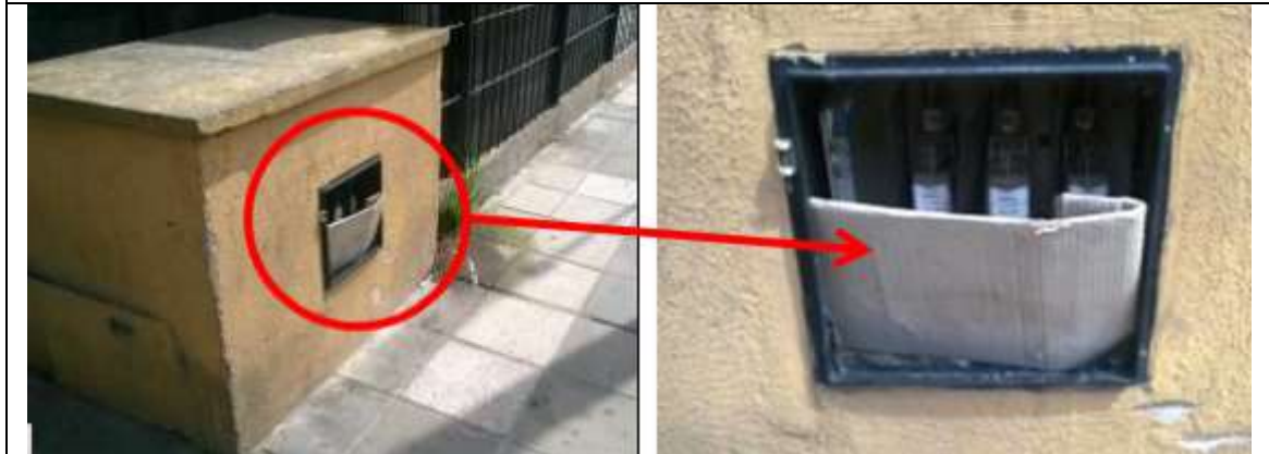
Peligro en caja de media tensión ausencia de tapa protectora.
