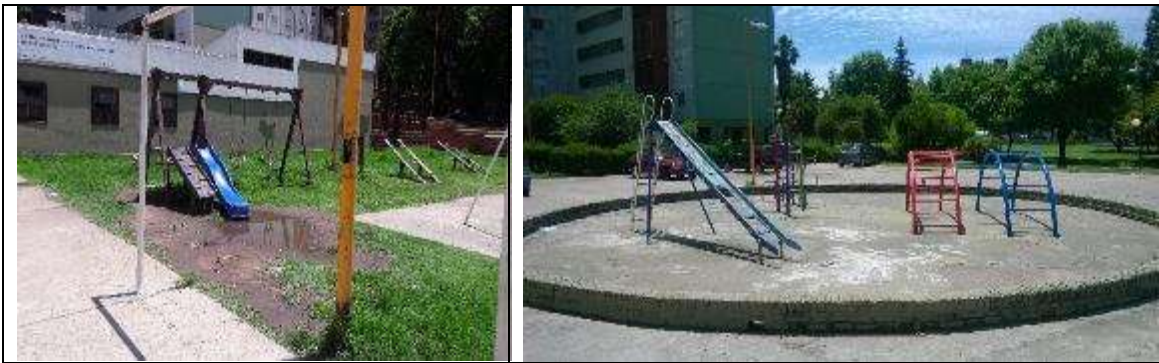
Falta de mantenimiento en espacio de juego para niños. La columna de luz sin tapa.
