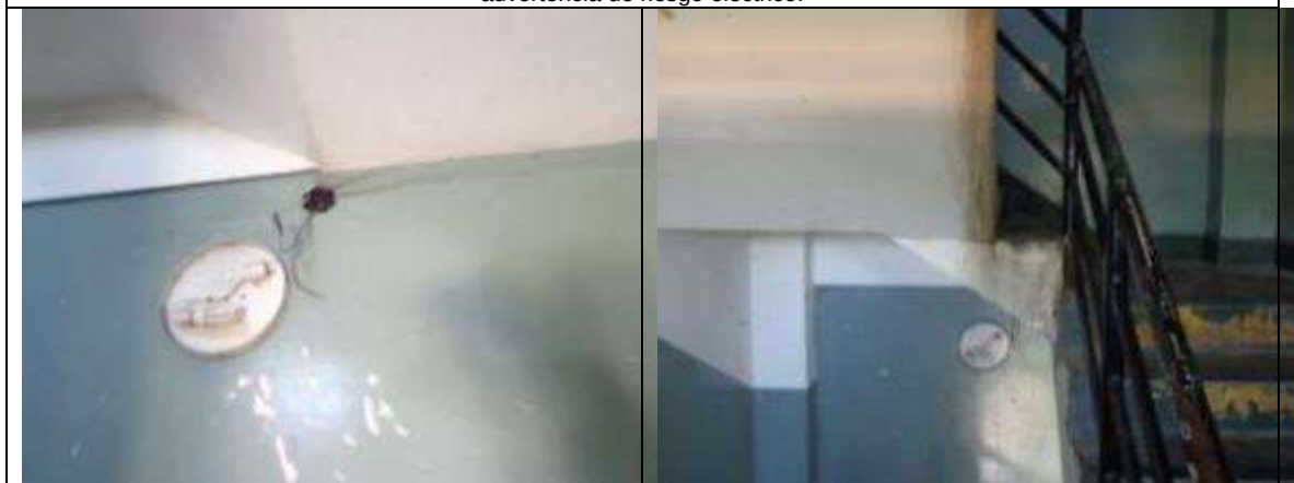
Cables sueltos en luminaria interior
