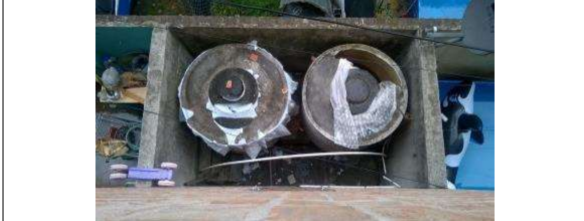
Tapas de tanques de agua rotos y basura en el compartimento.
