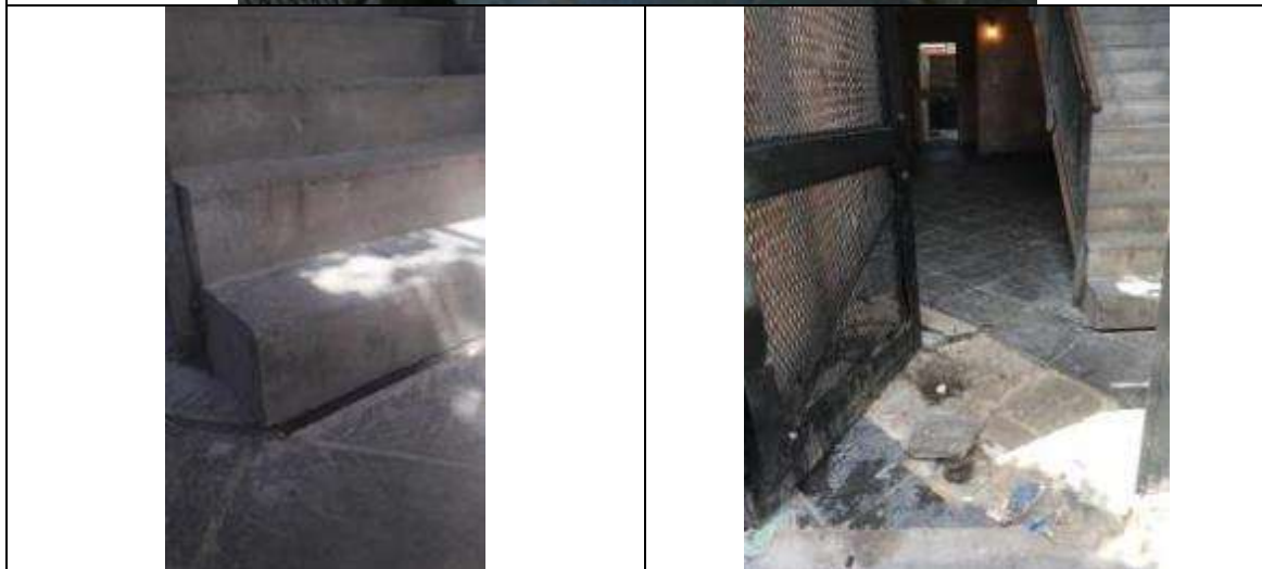
Acceso al edificio: las puertas de chapa con considerable oxidación del material. Edificios construidos sin estructura de base, derivando al hundimiento de los accesos y patios.
