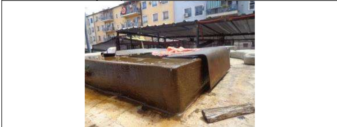
Desborde constante de cisterna.
