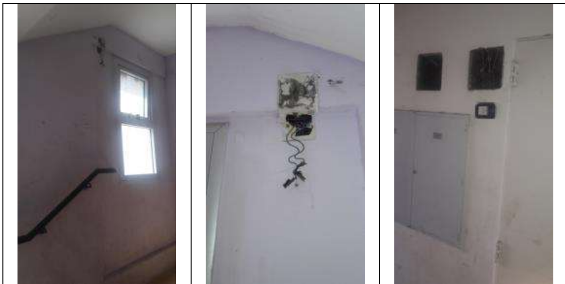
Interior de Edificio con cables expuestos por ausencia de luminarias y/o tapas de cajas de luz.
