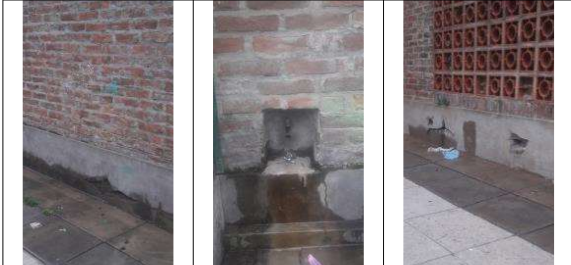
Humedad en paredes por caño de agua roto y filtración hacia la calle
