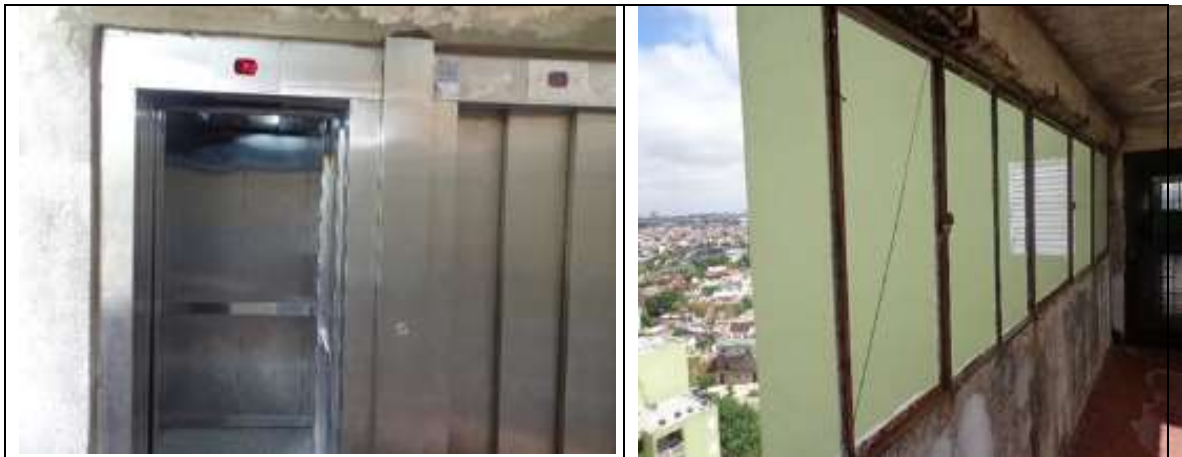
Ascensores: Mantenimiento no comprobado. Filtraciones continuas deterioran estructura y mantenimiento.
