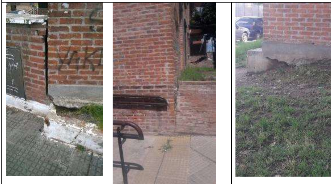
Se verifica una pronunciada diferencia de asentamiento de suelos entre la platea estructural y el nivel de vereda.
