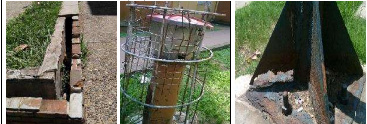
Falta de mantenimiento y conservación de muros-asiento con riesgo físico para los usuarios. Riesgo eléctrico en farolas bajas rotas por falta de mantenimiento. Riesgo de caída de la columna de iluminación por destrucción de la base por oxidación.
