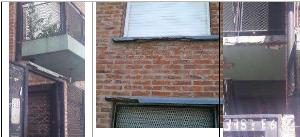
Dinteles y alfeizares colapsados por oxidación de hierros internos del hormigón. Fisuras en losas
