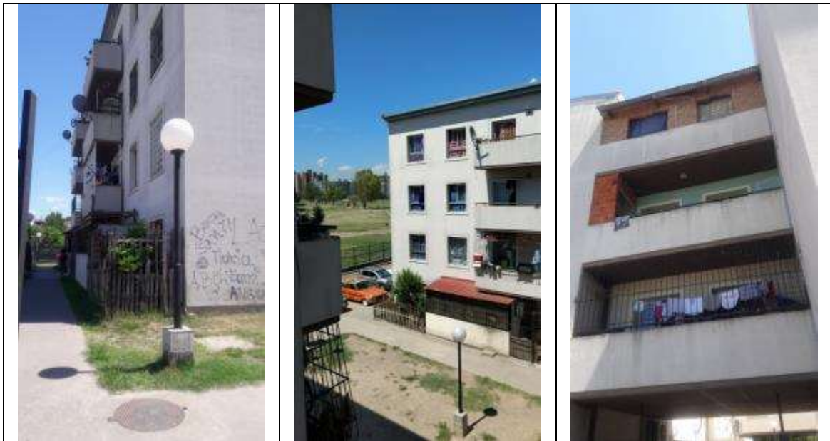
En Planta Baja Usurpación de espacios comunes. Se verifico, en algunos balcones cerramientos con mampostería de ladrillos.
