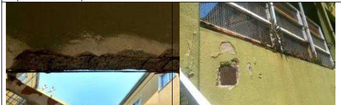
Se verifica desprendimientos de mampostería con hierros expuestos.
