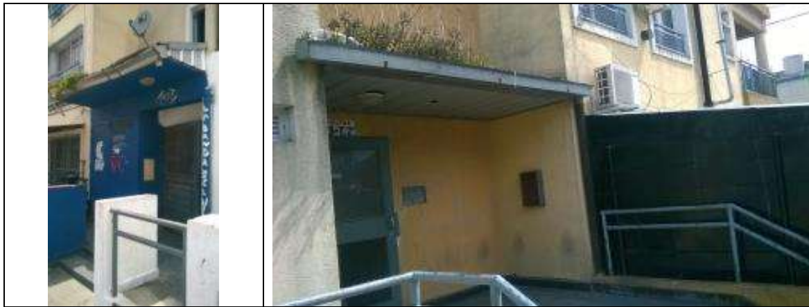
Canaleta de chapa tapada por vegetación
