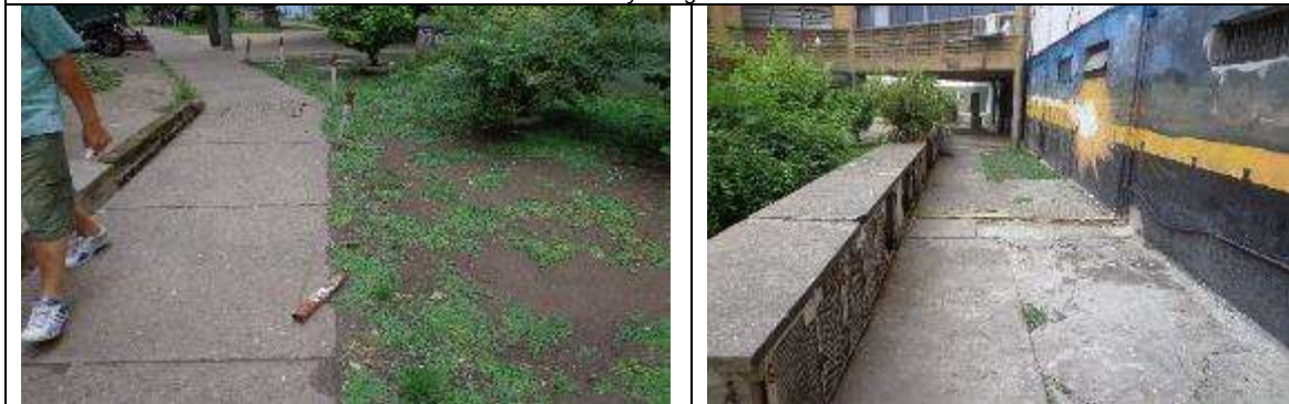
No hay delimitación de espacios comunes interiores y los medidores de gas presentan peligrosas condiciones y riesgos de pérdidas del fluido respecto a su estado de conservación.
