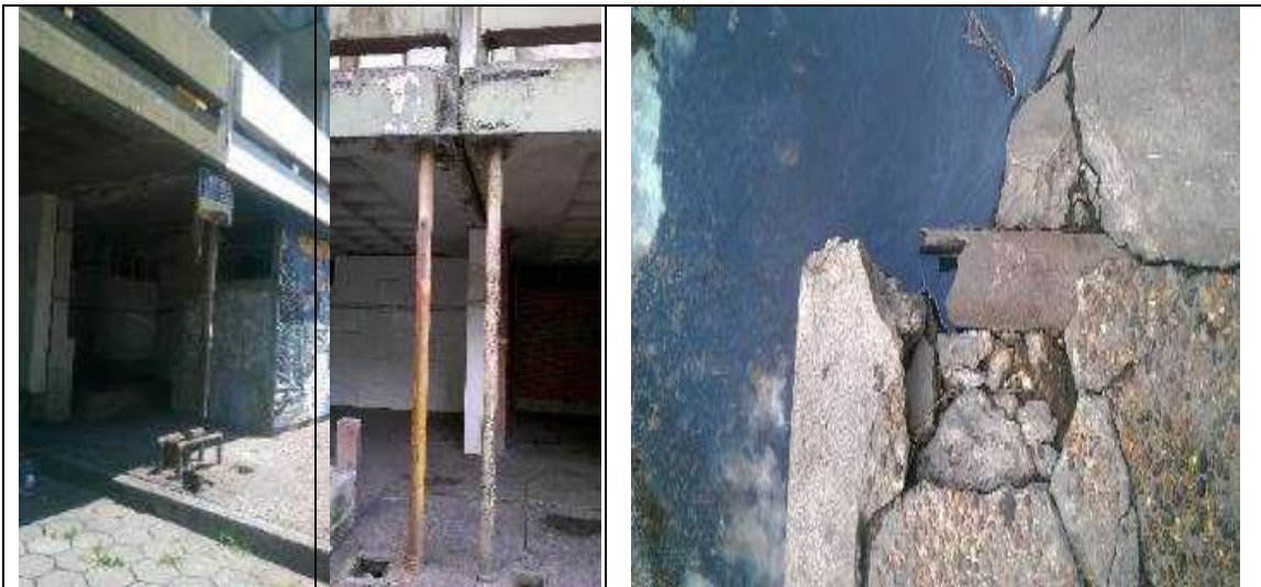
El sistema pluvial a nivel peatonal se encuentra en mal estado
