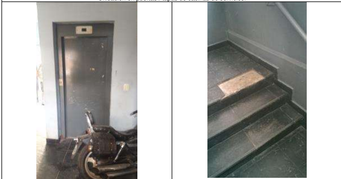
Aunque existe el hueco para el ascensor, el mismo nunca se habilitó falta la instalación de maquinaria y cabinas.
