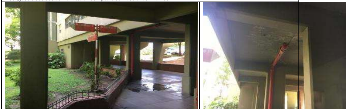
Se detectó agua sobre el solado por filtración en caño cloacal
