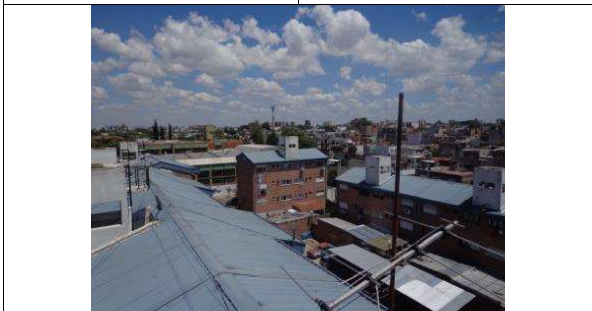
Techos de Chapa
