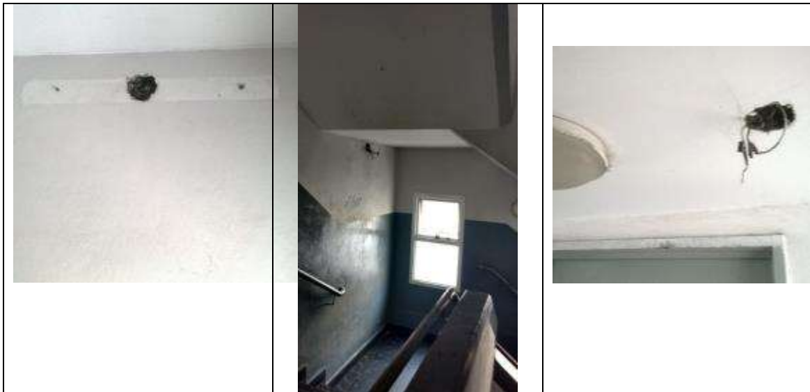
En interior de los edificios se verifico ausencia de luminarias, provocando cables sueltos en bocas de luz.
