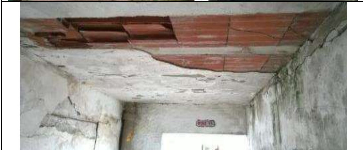
Envejecimiento de los elementos premoldeados de hormigón armado que componen el conjunto estructural
