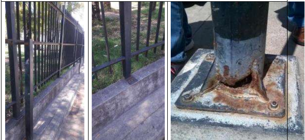
En un sector de la Reja perimetral se encuentra suelta, no anclada al muro. Importante oxidación de poste de luz.
