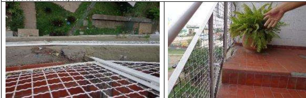
Barandas fuera de su empotramiento y oxidadas.
