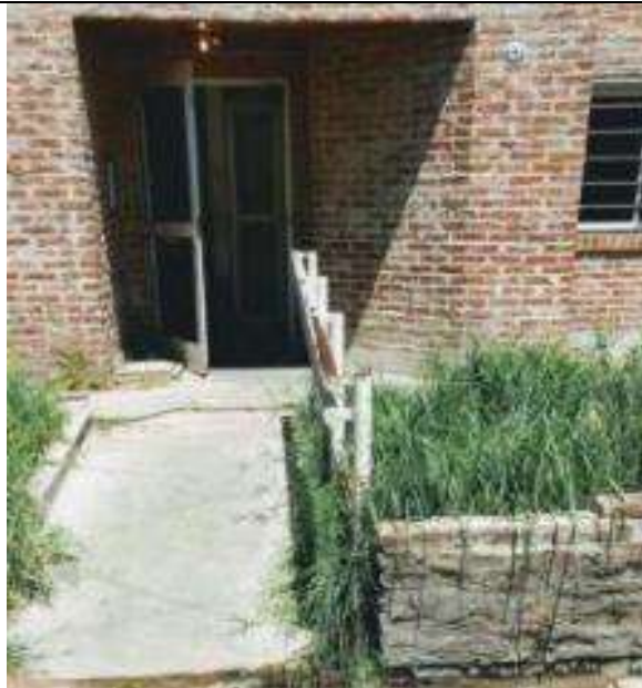
Rampa de acceso con fracturas ocasionando difícil la accesibilidad.
