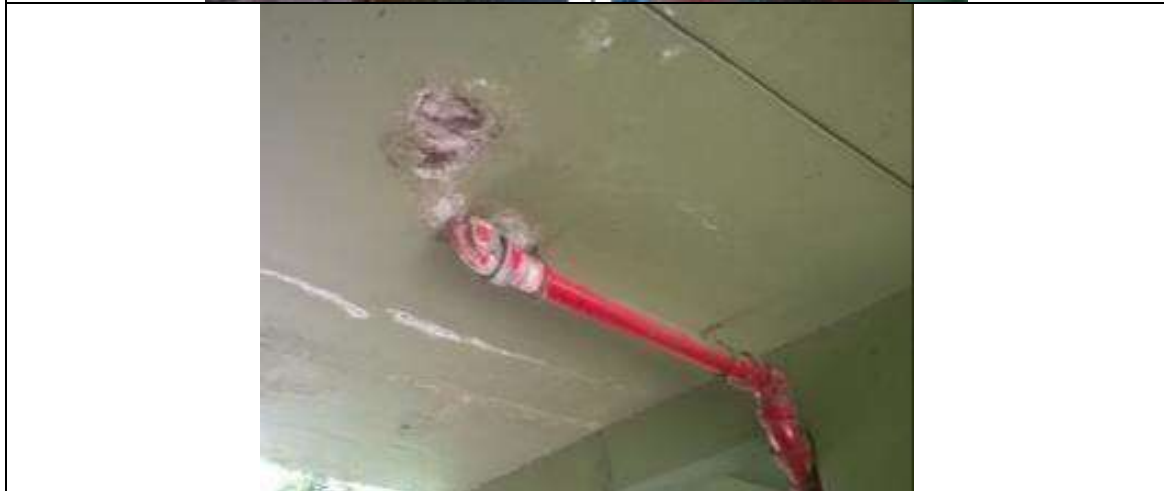
Desagües cloacales con oxidación con posibles filtraciones internas
