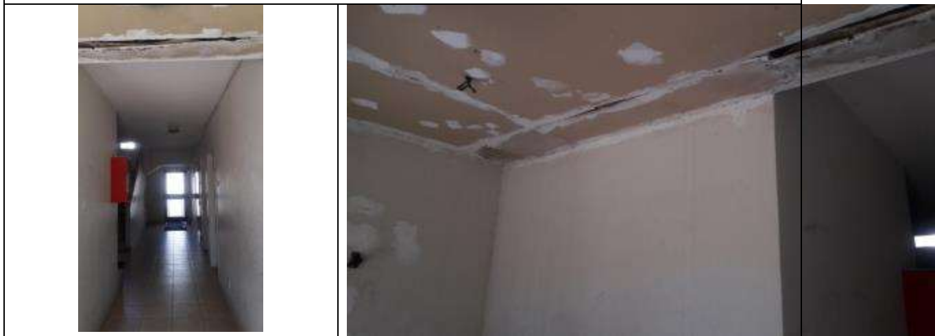
Cielorrasos sin terminar.
