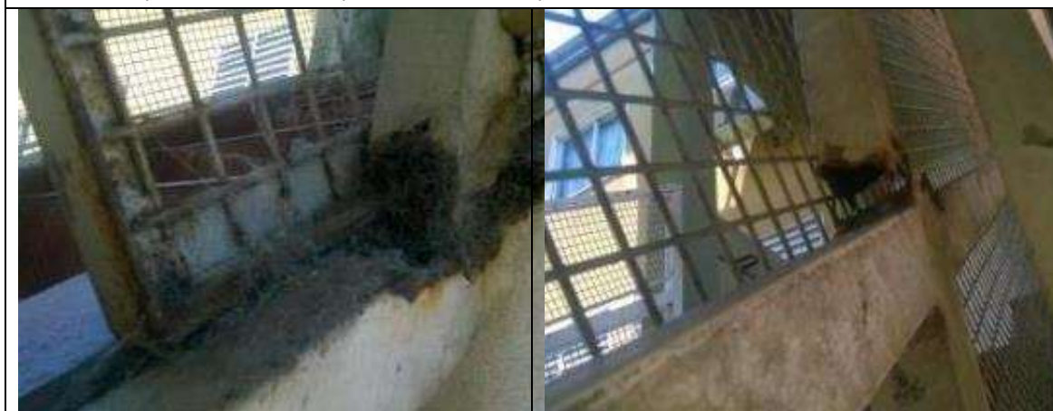
Rotura de barandas por oxidación
