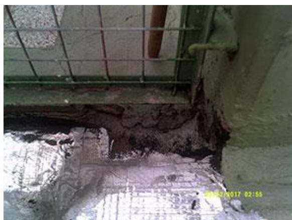
Fisuras de babeta perimetral sin sellar, ni cubrir con membrana.
