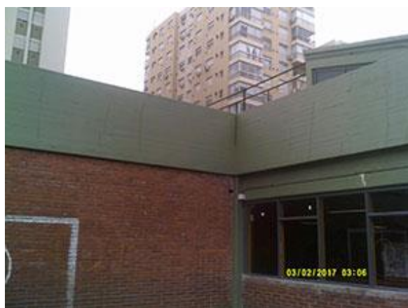
Fisura sin sellar que provoca filtraciones en el salón comedor de planta baja.
