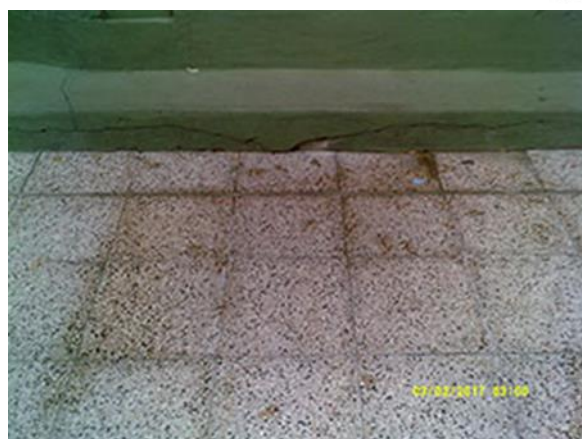
Fisura sin sellar en la terraza.
