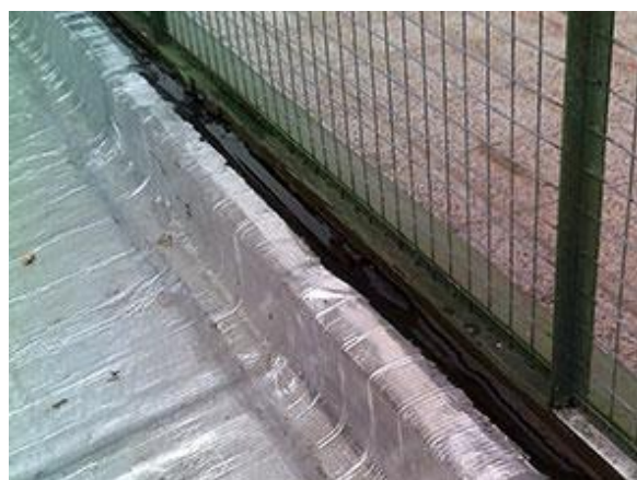
Murete que acumula agua en la hendidura del medio.
