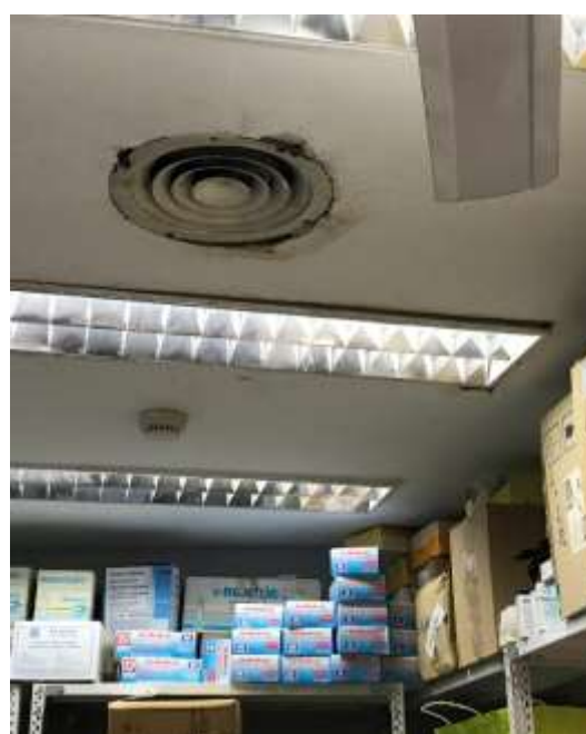
Foto N°8: Cesac N°19 Deterioro en la salida de la calefacción
