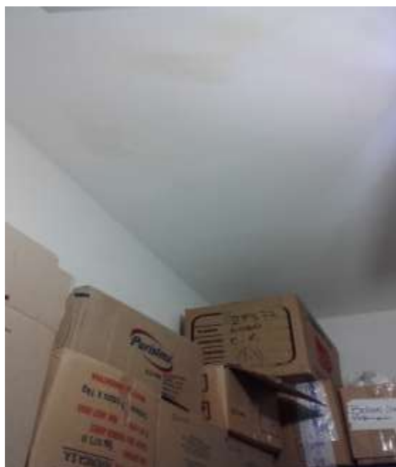
Foto N°7: Cesac N°9 Manchas de humedad, lugar muy caluroso
